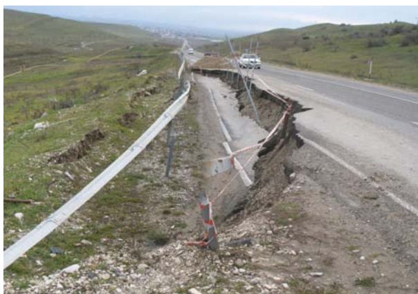
Рис. 2. Активизация оползневого процесса на 816 км федеральной автодороги «Кавказ» М-29 (ГУП «РЦ Дагестангеомониторинг»).
