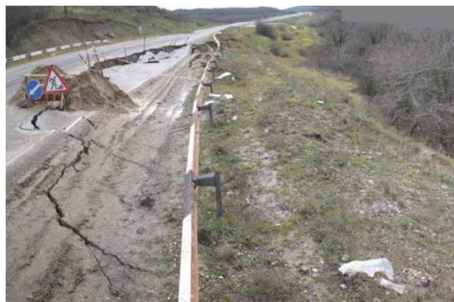
Рис.3. Активизация оползневого процесса на 814 км федеральной автодороги «Кавказ» М-29 (ГУП «РЦ Дагестангеомониторинг»).
