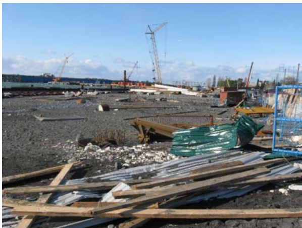
Рис. 5. Разрушенные штормовыми волнами конструкции на пляже в междуречье Псоу – Мзымта (ГУП «Кубаньгеология»).
