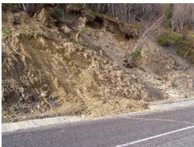
Рис. 1. Оползневые массы сползшие в бетонные лотки вдоль а/д Гузерипль – Лаго-Наки (ГУП «Кубаньгеология»).
