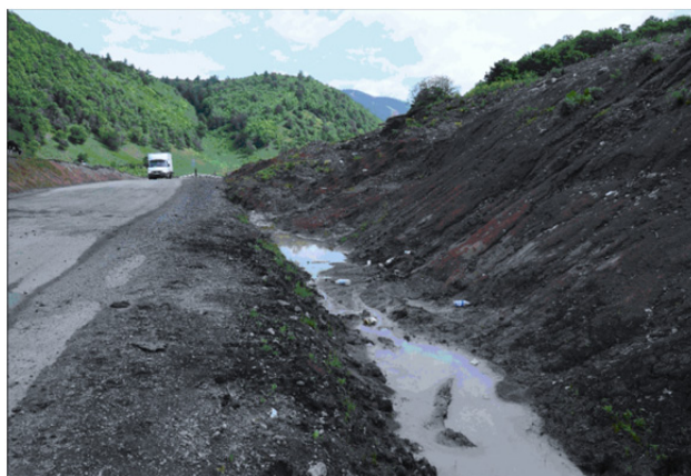
Рис.4. Оползень на дороге к горно-лыжному комплексу Аджигардак (ТЦ ГМГС по Челябинской области)
