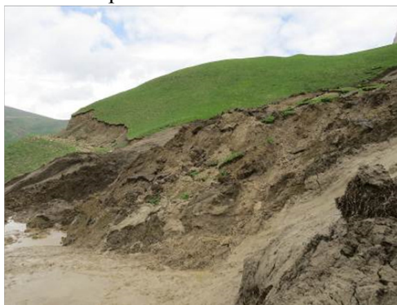
Рис.23. Центральная часть оползневого массива (ЮРЦ ГМСН)
