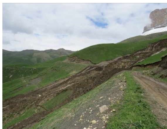
Рис.24. Участок автодороги Безенги – Булунгу, перекрытый оползневыми массами (ЮРЦ ГМСН)
