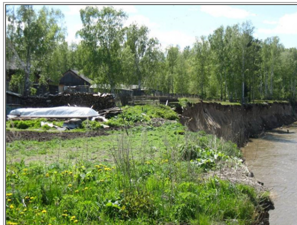
Рис.11. Разрушение усадьбы жилого дома по ул. Причулымской, 15/1 в с. Чердаты, Томская область (ОАО «Томскгеомониторинг»)
