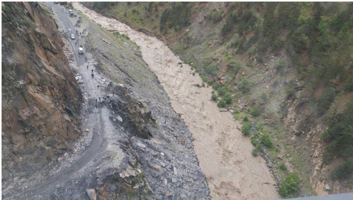
Рис.20. Участок активизации обвального процесса на автодороге Агвали – Сагада в Цунтинском районе Республики Дагестан (ГО СЧС по Республике Дагестан)
