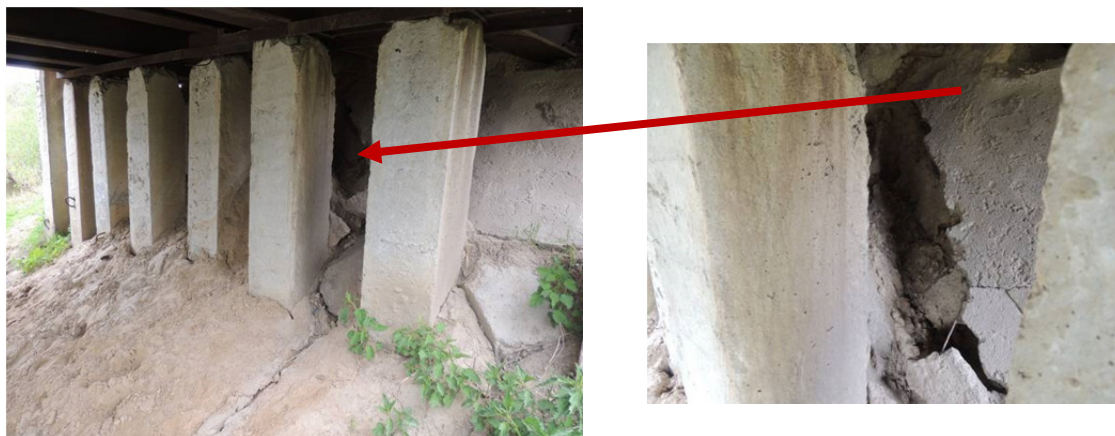
Рис.2. Частично деформирована бетонная стенка моста через р. Карга (с. Княжево) (ТЦ ГМСН по Тюменской области)
