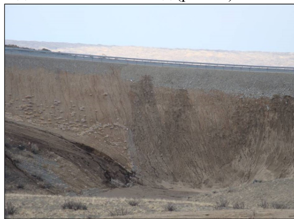
Рис.18. Следы плоскостной эрозии на искусственной насыпи у автодороги М-54, Республика Тыва (Тувинский ТЦ ГМСН)
