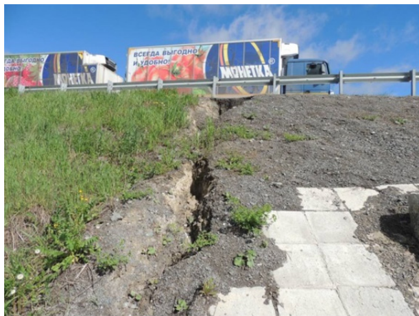
Рис.1. Эрозионная промоина на насыпном автомобильном мосту через р. Ушаковка (400 м южнее с. Елань) (ТЦ ГМСН по Тюменской области)
