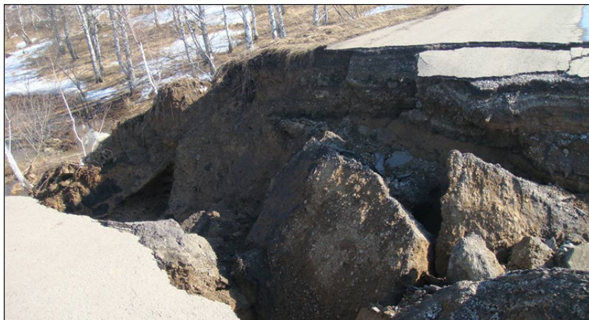
Рис.9. Размыв автомобильной дороги, Кемеровская область (ТЦ ГМСН по Кемеровской области)
