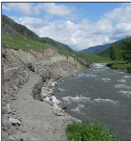
Рис.6. Размыв полотна дороги на уч. Эдиганская трасса, Республика Алтай (Алтайский ТЦ ГМСН)
