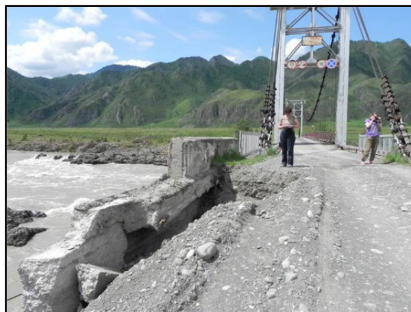
Рис.7. Размыв правой опоры Ороктойского моста, Республика Алтай (Алтайский ТЦ ГМСН)
