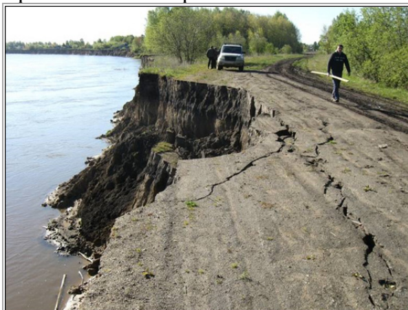
Рис.10. Разрушение автодороги Зырянское – Причулымск, Томская область (ОАО «Томскгеомониторинг»)
