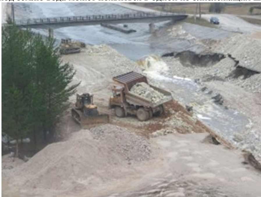
Рис.26. Засыпка карстового провала в русле р. Варган в г. Североуральске, Свердловская область (URL: http://nslovo.info/proval-na-severouralskom-vagrane-situaciya-napryazhennaya-video/ )
