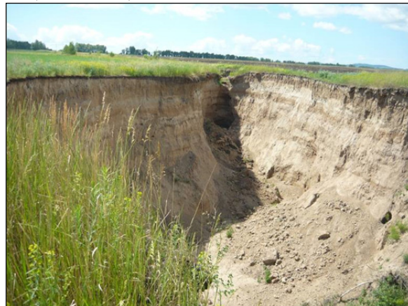
Рис.13. Вершина оврага на участке автодороги Минусинск – Беллык, 98 км, Красноярский край (ТЦ ГМСН по Красноярскому краю)
