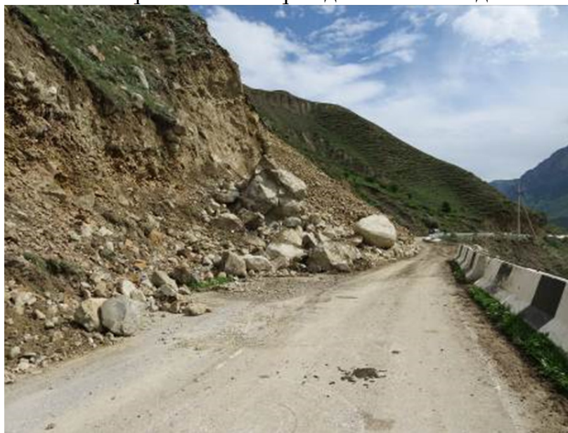
Рис.21. Обвал в верховом откосе автодороги Карасу – Безенги, на левом берегу р. Черек Хуламский, Кабардино-Балкарская Республика (ЮРЦ ГМСН)
