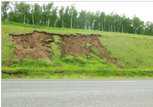
Рис.25. Оплывина на склоне вдоль объездного участка трассы М-53 (9 км), Красноярский край (ТЦ ГМСН по Красноярскому краю)
