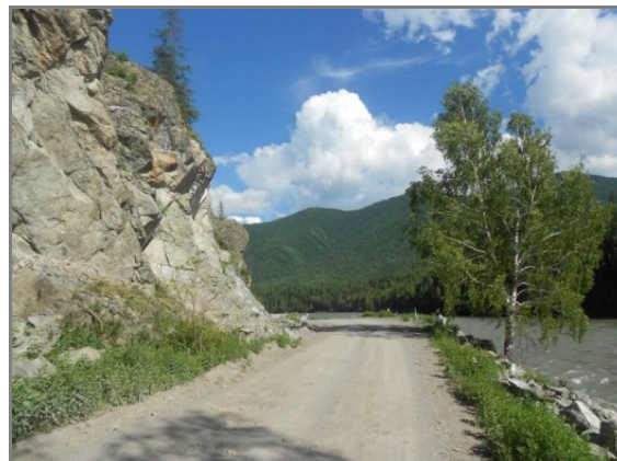
Рис.15. Обвалоопасный участок автодороги Усть-Кокса–Тюнгур, Республика Алтай (ТЦ ГМСН по Республике Алтай)
