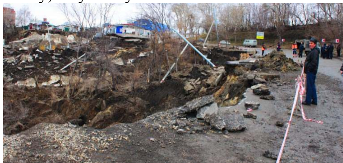
Рис.41. Участок активизации оползневого процесса на ул. Спуск Степана Разина, г. Ульяновск (ТЦ ГМСН по Ульяновской области)
