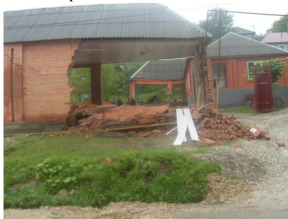
Рис.35. Разрушенный дом по пер. 8 Марта н.п. Ца-Ведено (ООО «Центр ГИДИС»)
