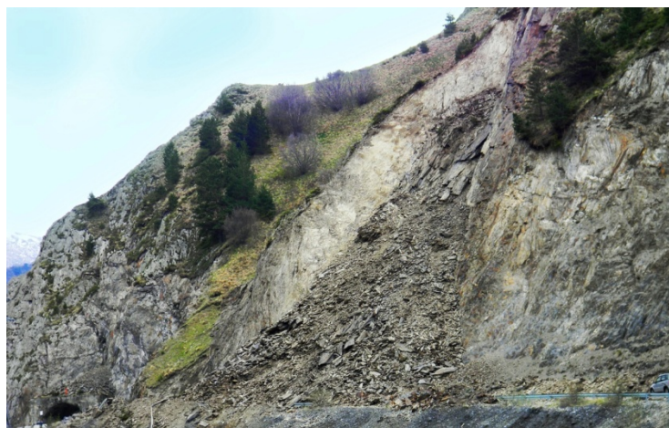
Рис.33. Обвал в верховом откосе объездной дороги на Мамисон (100 м от северного портала тоннеля) (ТЦ ГМСН по Республике Северная Осетия – Алания)
