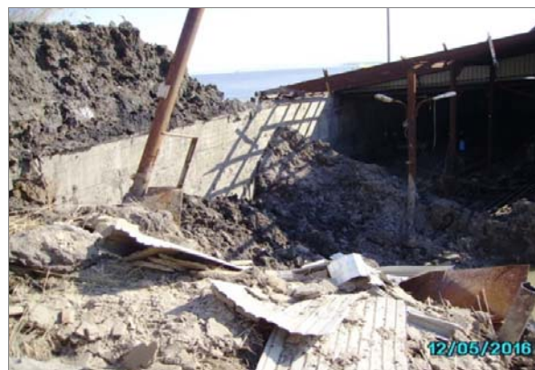
Рис.7. Частично разрушенная промзона штольни ОАО «Медхим», п. Новокашпирский, г. Сызрань, Самарская область (ТЦ ГМСН по Самарской области)
