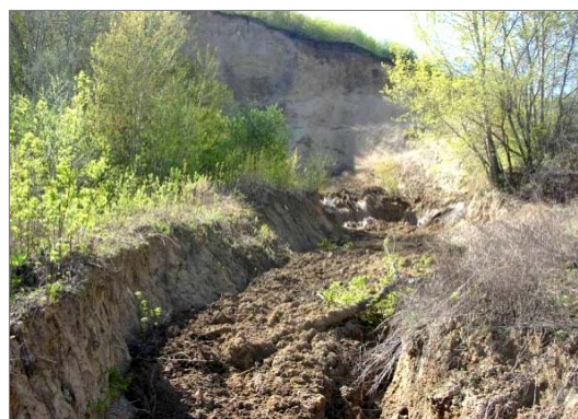
Рис.17. Оползни на участке ул. Квартал 953а, 481а, г. Барнаул, Алтайский край (Алтайский ТЦ ГМСН)
