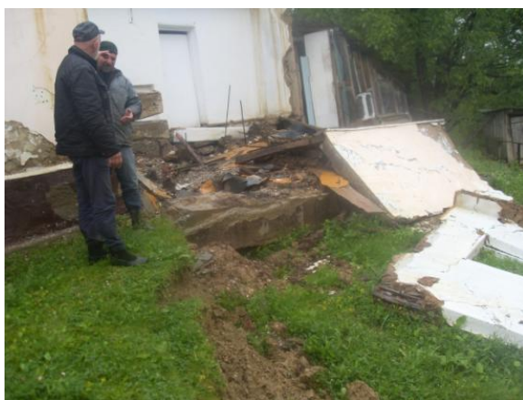
Рис.36. Разрушенный дом по ул. Чопа Хаджи, 1, с. Гуни (ООО «Центр ГИДИС»)
