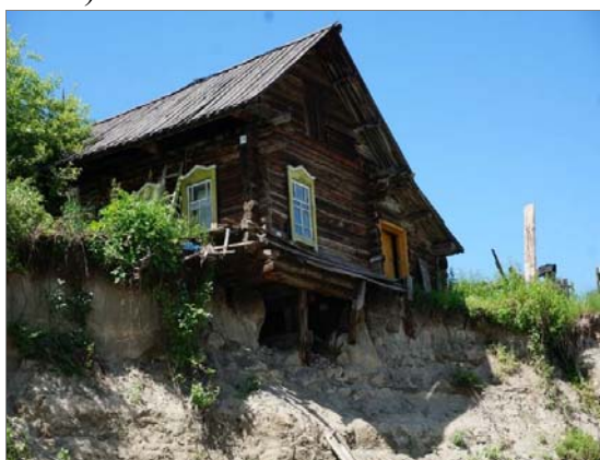
Рис.14. Участок разрушения уступа террасы в с. Мульта, Республика Алтай (ТЦ ГМСН по Республике Алтай)
