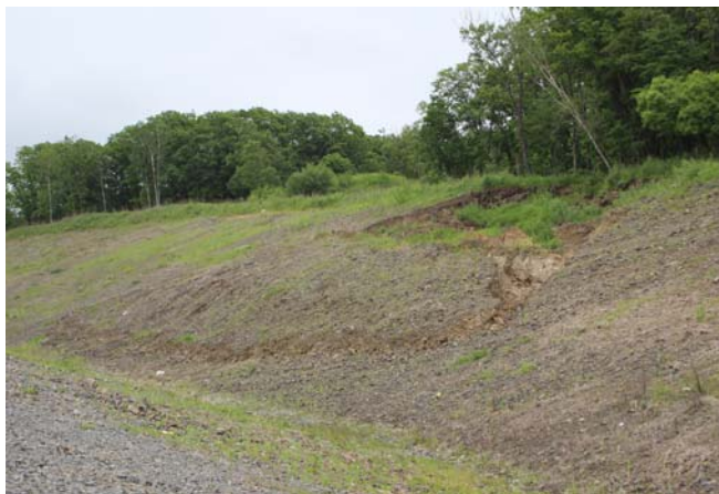
Рис.29. Оползень на участке 80,2 км ФАД А-370 Владивосток – Хабаровск (по состоянию на 22.06.2016 г.) (Приморский ТЦ ГМСН)
