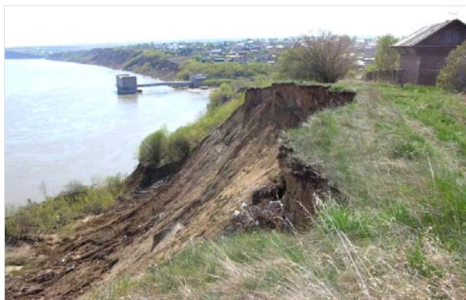
Рис.18. Участок разрушения бровки берегового склона на участке СНТ «Обь-2», г. Барнаул, Алтайский край (Алтайский ТЦ ГМСН)
