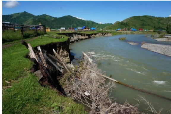
Рис.13. Участок активного разрушения террасы в с. Верх-Уймон, уч. Уймонская протока, Республика Алтай (ТЦ ГМСН по Республике Алтай)
