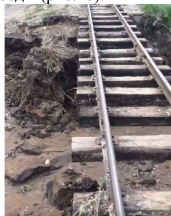
Рис.28. Разрушение полотна железной дороги, г. Чита, Забайкальский край (ТЦ ГМСН по Забайкальскому краю)
