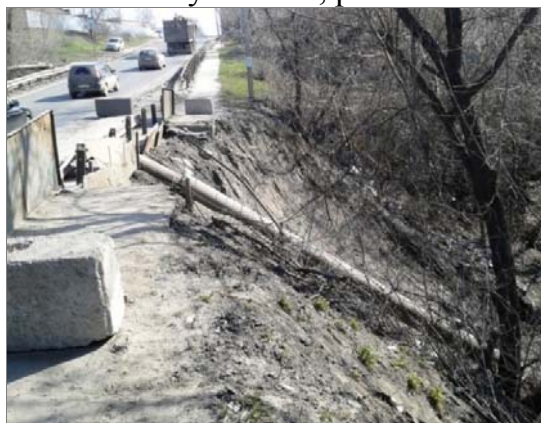
Рис.6. Участок развития оползня-спыва у насыпного моста по ул. Декабристов, г. Сызрань, Самарская область (ТЦ ГМСН по Самарской области)
