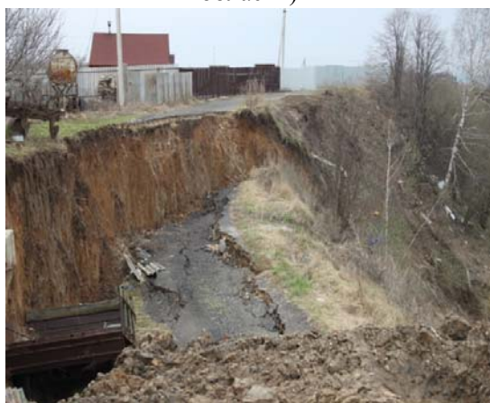
Рис.4. Участок развития оползневого процесса в п. Новинки Богородского района, Нижегородская область (ТЦ ГМСН по Нижегородской области)
