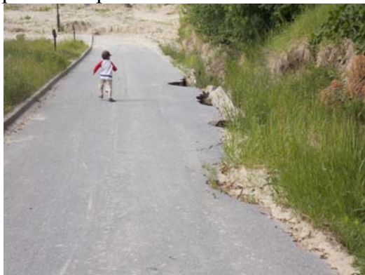
Рис. 10. Размыв и разрушение пешеходной дорожки к скульптурной группе «Мамонты» на территории «Археопарка» в г. Ханты-Мансийске (17.06.2016 г) (ТЦ ГМСН по Ханты-Мансийскому автономному округу)
