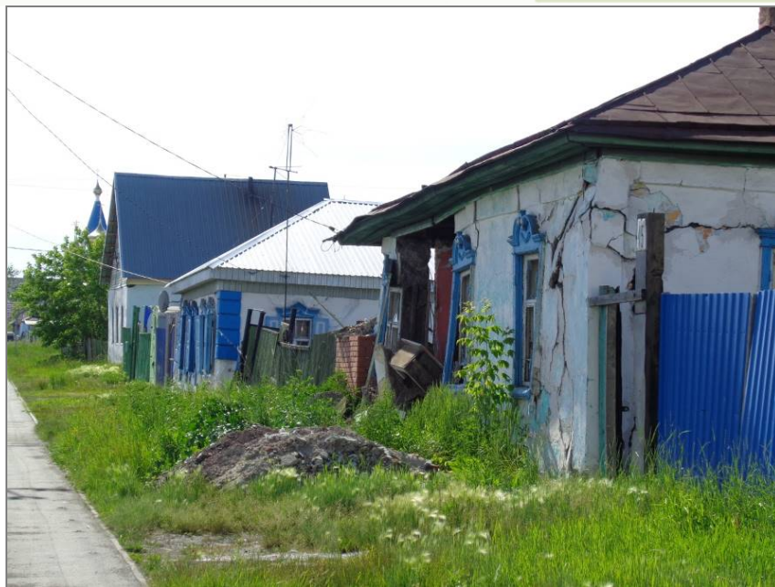
Рис. 104. Деформированные дома по ул. Карла Маркса, 45, г. Барабинск, Новосибирская область (ТЦ ГМСН по Новосибирской области)
