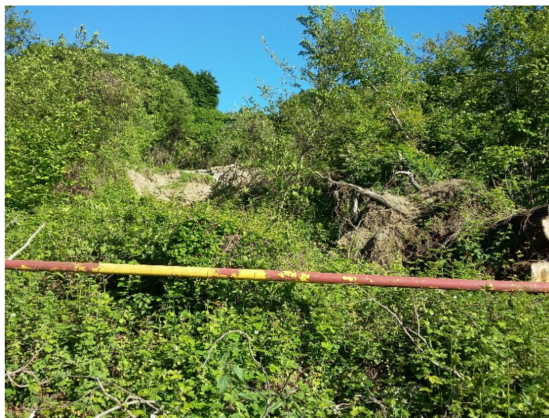
Рис. 44. Активный оползень в Хостинском районе г. Сочи (ФКУ «ЦУКС ЮРЦ МЧС России»)
