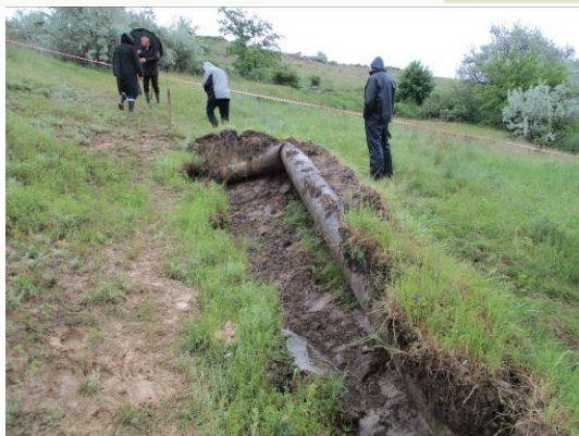
Рис. 64. Деформированная труба газопровода вследствие активизации оползневого процесса (ТЦ ГМСН по Ставропольскому краю)
