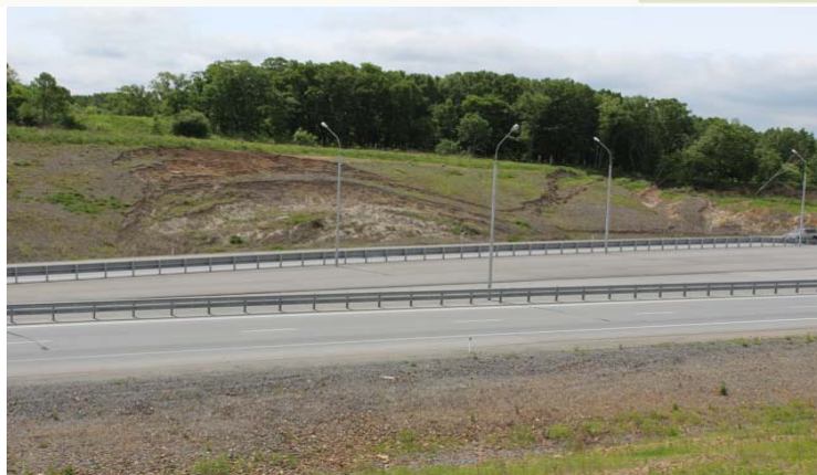
Рис. 26. Активные проявления оползневой процесса на участке 80,1 км а/д А-370 «Уссури» по состоянию на 06.06.2017 (Приморское отделение ДВРЦ ГМСН)
