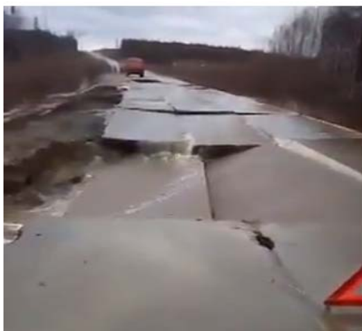
Рис. 17. Размытый участок дороги Белоярский – Бобровка (Белоярский район, ХМАО) (открытые источники информации)
