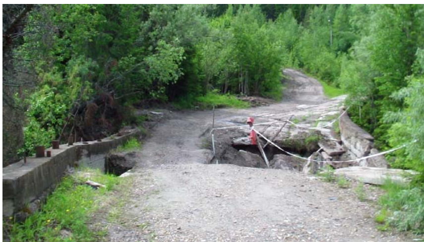
Рис. 14. Провал на ул. Сутормина, г. Ханты-Мансийск. Вид на запад (22.06.2017) (ТЦ ГМСН по Ханты-Мансийскому АО)
