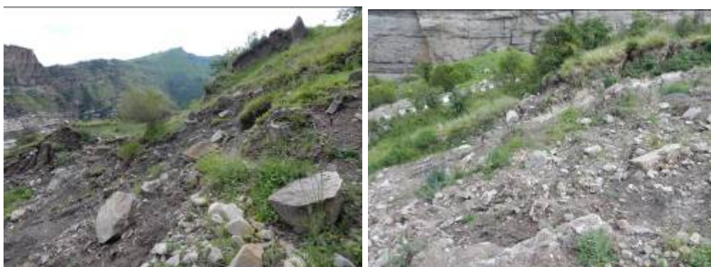
Рис. 54. Разрушенная в результате активизации оползневой процесса а/д Цуриб – Бацада в Гунибском районе (ТЦ ГМСН по Республике Дагестан)
