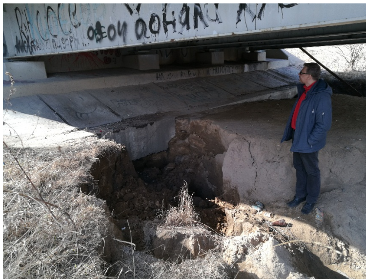
Рис. 33. Вершина оврага под правой полосой движения по мосту через р. Мга (ТЦ ГМСН по Ленинградской области)
