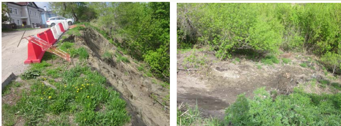
Рис. 12. Оползневой цирк (г. Тюмень, ул. Фридриха Энгельса, 16) (ТЦ ГМСН по Тюменской области)
