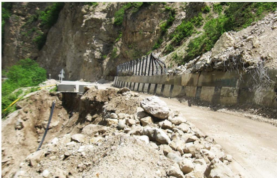
Рис. 63. Деформированный участок полотна а/д и камнеулавливающей стенки на обвальном осыпном участке «Святой Георгий» (ТЦ ГМСН по Республике Северная Осетия – Алания).
