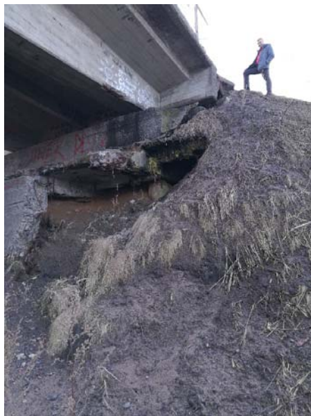
Рис. 34. Промоина под основанием моста через р. Мойка (ТЦ ГМСН по Ленинградской области)
