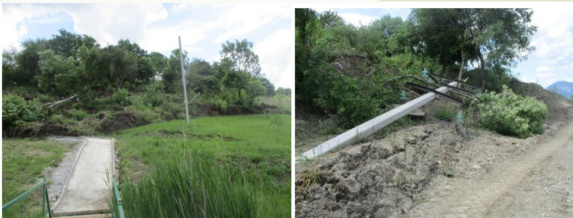
Рис. 68. Опоры ЛЭП и грунтовые дороги, деформированные в результате активизации оползневого процесса (ТЦ ГМСН по Ставропольскому краю)
