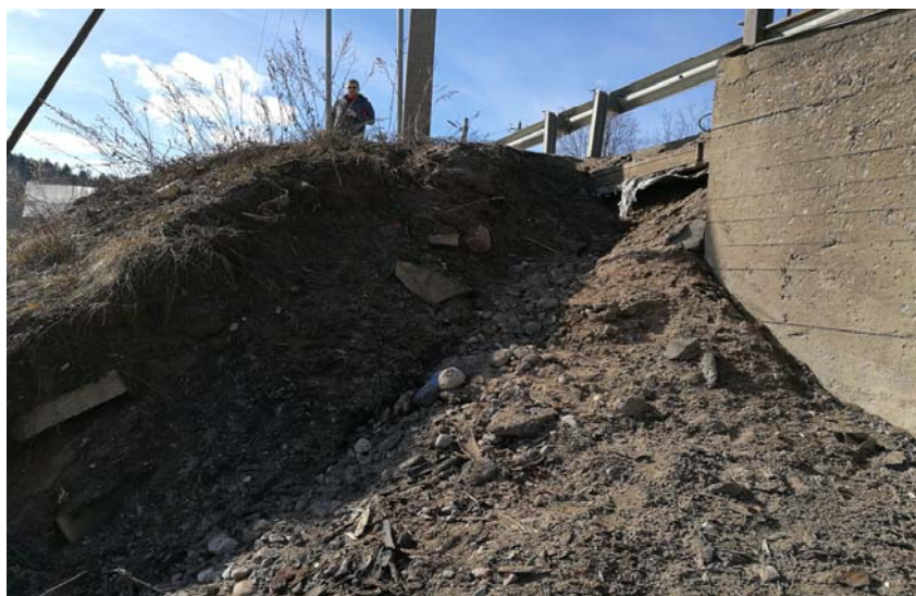
Рис. 38. Разрушенный отсыпки обочины моста через реку Погра в результате активизации процесса овражной эрозии (а/д г. Подпорожье – д. Валдома) (ТЦ ГМСН по Ленинградской области)
