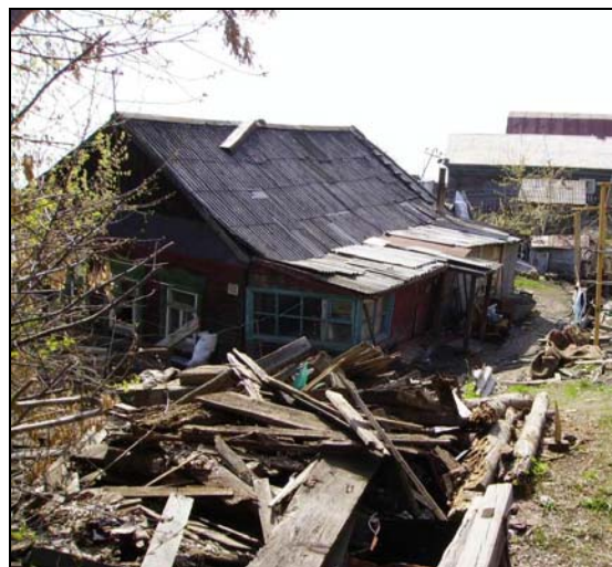
Рис. 77. Деформированный дом №152, газовая труба и опора ЛЭП. г. Сызрань, Самарская область. (ТЦ ГМСН по Самарской области)
