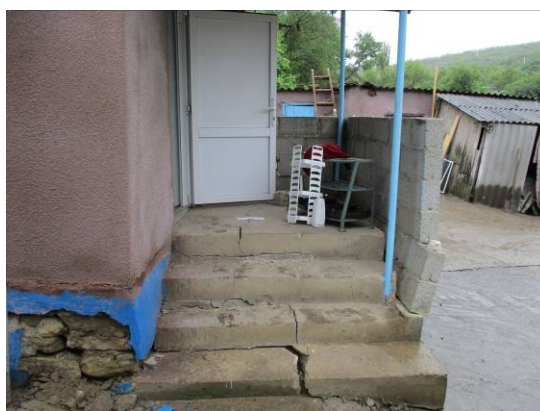
Рис. 65. Деформированный в результате активизации оползневого процесса дом по ул. Ленина, 21 (ТЦ ГМСН по Ставропольскому краю)
