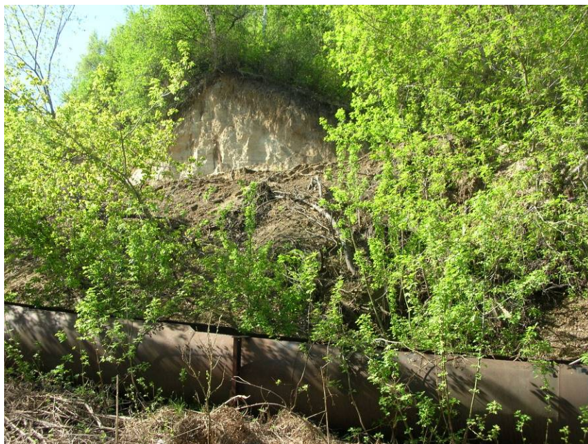
Рис. 86. Участок «Казачий спуск», активный оползень около трассы ГЗУ ТЭЦ-2, г. Барнаул (ТЦ ГМСН по Алтайскому краю)
