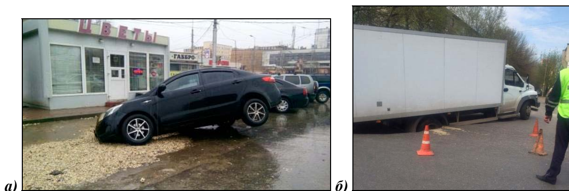
Рис. 4. Деформированный участок дорожного покрытия вследствие активизации суффозионного процесса в г. Рязани: а) на ул. Новоселов; б) на пересечении ул. Попова и ул. Новая (ТЦ ГМСН по Рязанской области)
