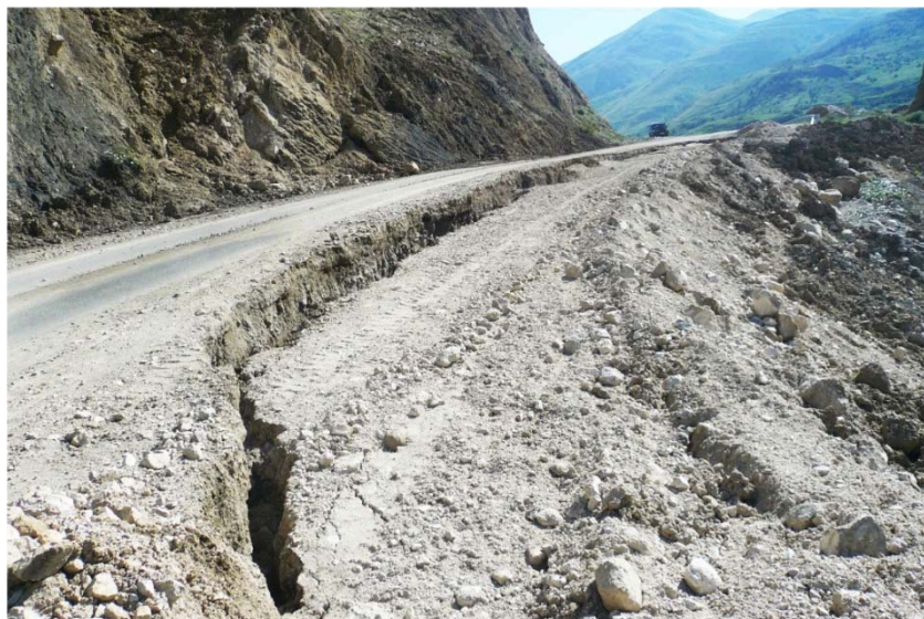
Рис. 60. Деформированный участок автодороги в Центральной части Низового оползня (ТЦ ГМСН по Республике Северная Осетия – Алания).
