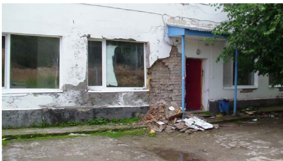
Рис. 16. Деформированный фасад здания на территории бывшей Ляминской РЭБ (г. Ханты-Мансийск, 2017 г.) (ТЦ ГМСН по Ханты-Мансийскому АО)
