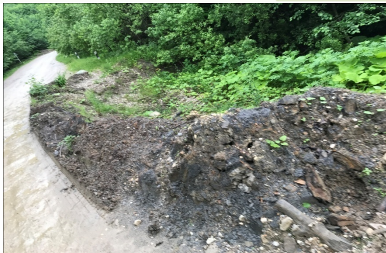
Рис. 73. Деформированное оползнем полотно дороги без покрытия с. Ведено – с. Дарго на интервале 15 м (ТЦ ГМСН по Чеченской Республике)
