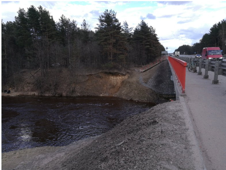
Рис. 35. Активный овраг у моста через р. Назия (автотрасса «Кола») (ТЦ ГМСН по Ленинградской области)
