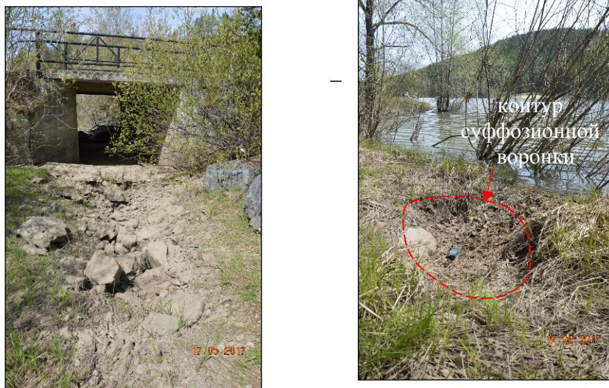
Рис. 19. Водосброс на правобережном участке дамбы (слева) и суффозионный провал (справа). г. Трехгорный, Челябинская область (ТЦ ГМСН по Челябинской области)
