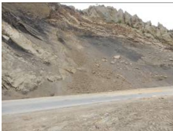
Рис. 49. Активное обвальное-осыпное проявление в верховом откосе автодороги «Буйнакский перевал» (ТЦ ГМСН по Республике Дагестан)
