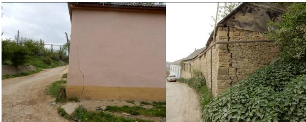
Рис. 51. Деформированные в результате активизации оползневого процесса дома по ул. Махмудова в Приреченском районе г. Буйнакск (ТЦ ГМСН по Республике Дагестан)
