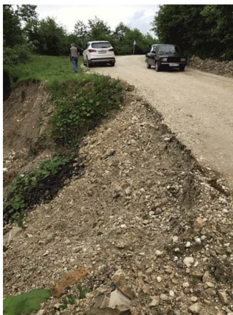
Рис. 74. Деформированное оползнем полотно дороги с. Ведено – с. Дарго на интервале 8 м. (ТЦ ГМСН по Чеченской Республике)
