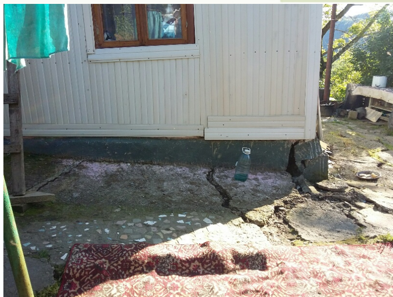
Рис. 46. Активный оползень в Хостинском районе г.Сочи (ФКУ «ЦУКС ЮРЦ МЧС России»)
