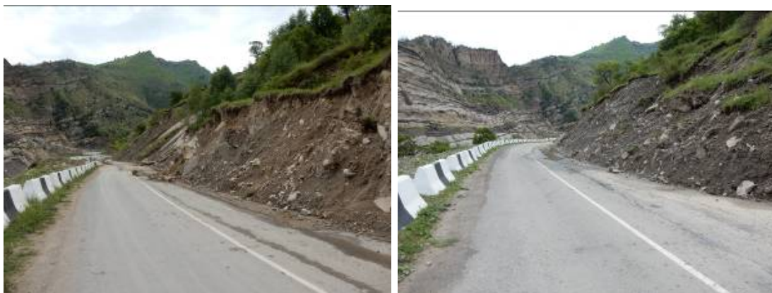
Рис. 55. Деформированная в результате активизации оползневой процесса а/д «Гуниб-Цуриб» в Гунибском районе. (ТЦ ГМСН по Республике Дагестан)
