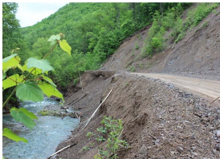
Рис. 25. Активное проявление гравитационно-эрозионных процессов на участке 276,1 км а/д Находка-Кавалерово по состоянию на 07.06.2017 (Приморское отделение ДВРЦ ГМСН)
