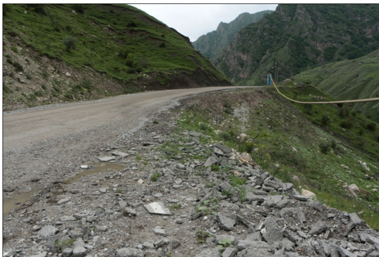
Рис. 59. Активный оползень на пересечении с а/д Урвань-Уштулу, в 2,5 км ниже с. Верхняя Балкария. Участок детальных наблюдений «Верхняя Балкария» (ТЦ ГМСН по Кабардино-Балкарской Республике)
