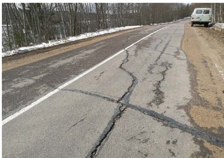
Рис. 40. Трещины закола на а/д пос. Важины – дер. Усланка, вызванные активизацией оползневого процесса (ТЦ ГМСН по Ленинградской области)
