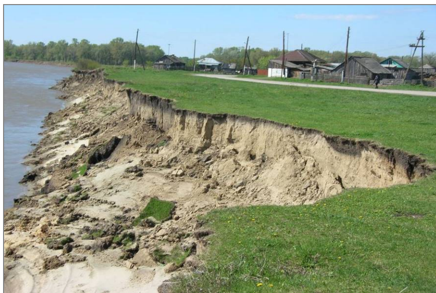
Рис. 90. Проявления оползневого процесса на правом береговом склоне р. Чумыш, уч. Новотроицкий, Алтайский край (ТЦ ГМСН по Алтайскому краю)
