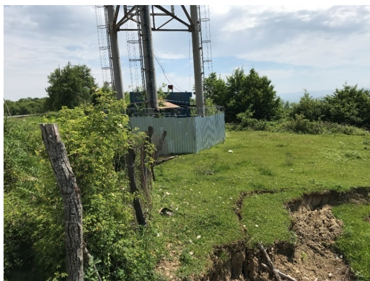
Рис. 72. В зоне воздействия оползня находится базовая станция связи. с. Первомайское (ТЦ ГМСН по Чеченской Республике)
