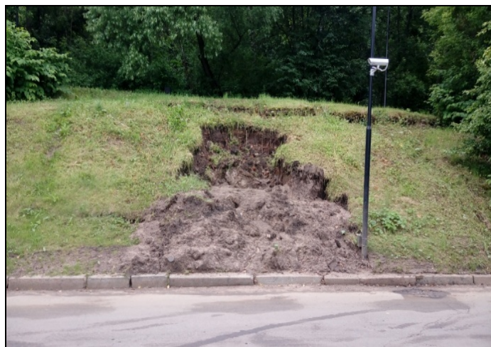
Рис. 31. Активный оползень в откосе на набережной р. Москва (ТЦ ГМСН по г. Москва)
