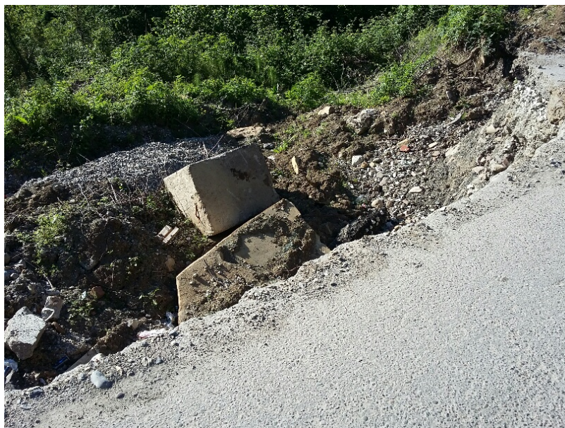
Рис. 45. Активный оползень в Хостинском районе г. Сочи (ФКУ «ЦУКС ЮРЦ МЧС России»)
