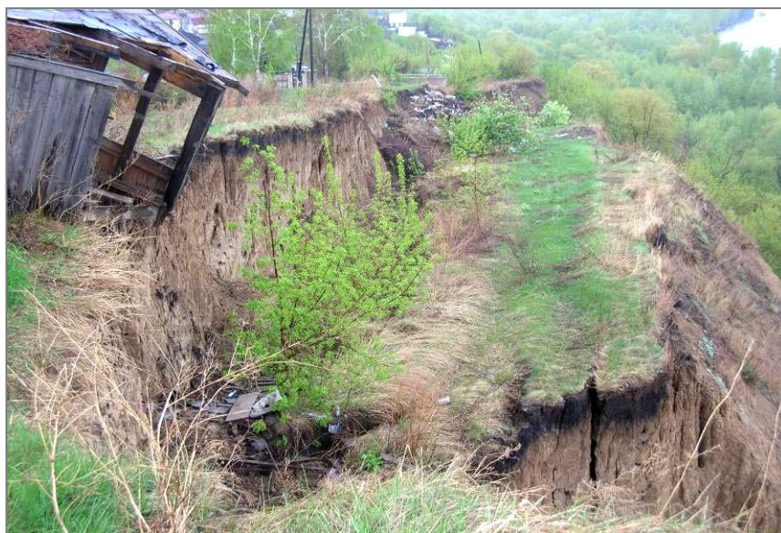
Рис. 84. Проседающий оползневой блок на ул. Якутская, 1, г. Барнаул (ТЦ ГМСН по Алтайскому краю)
