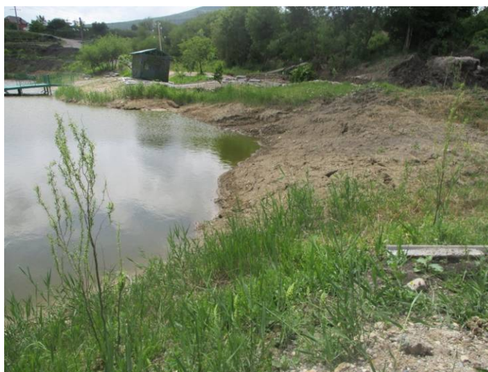
Рис. 69. Оползневыми смещениями деформирована северо-западная часть дамбы пруда. (ТЦ ГМСН по Ставропольскому краю)
