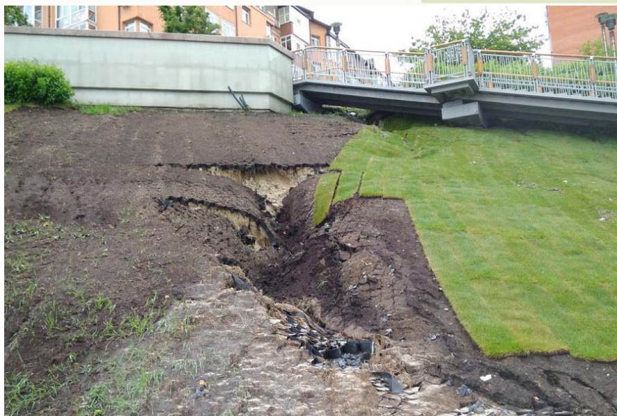
Рис. 10. Промоина на склоне набережной в г. Тюмень (ТЦ ГМСН по Тюменской области)
