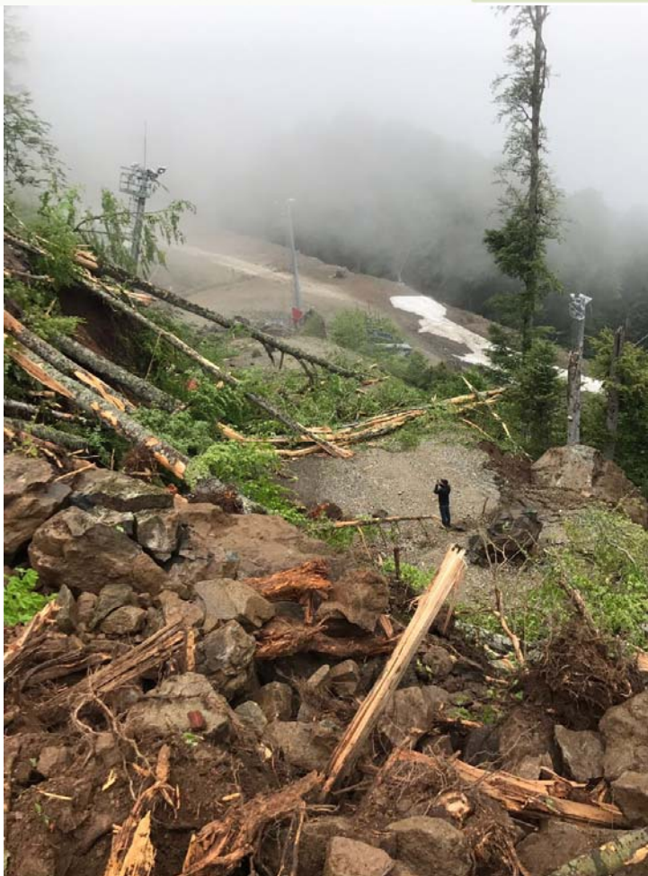
Рис. 48. Участок деформации опор кресельной канатной дороги К-8 в языковой части оползня (ФКУ «ЦУКС ЮРЦ МЧС России»)
