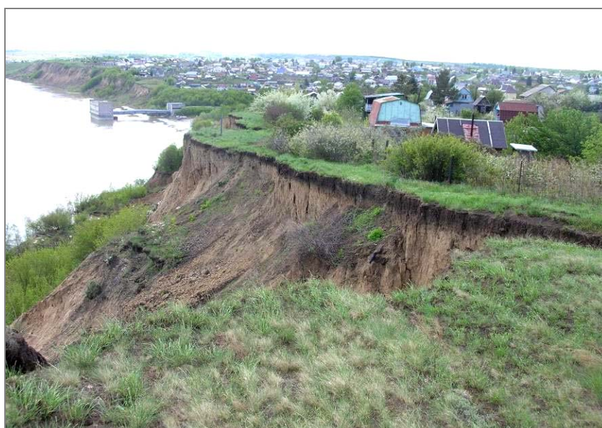
Рис. 89. Участок СНТ «Обь-2», продвижения бровки берегового склона в сторону садовых участков, г. Барнаул (ТЦ ГМСН по Алтайскому краю)
