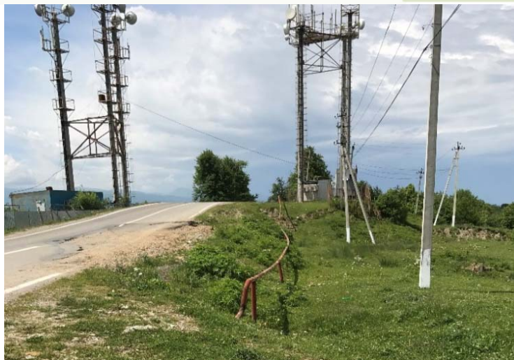
Рис. 71. Деформированные оползнем полотно дороги, линия газопровода. с. Первомайское (ТЦ ГМСН по Чеченской Республике)
