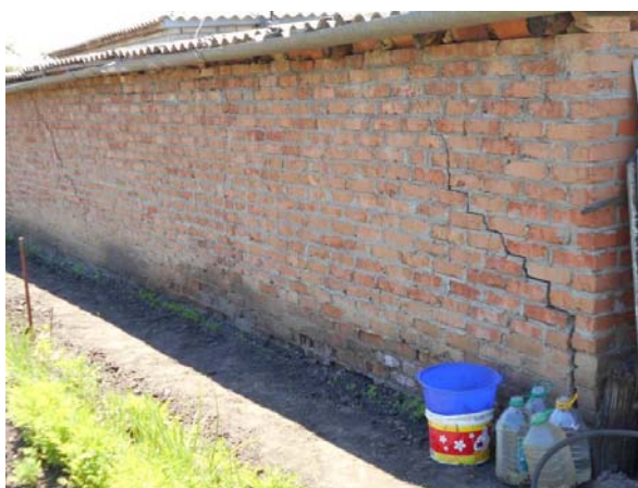
Рис. 58. Трещины в стене хозяйственной постройки по ул. Подгорная, 66, образование которых вызвано активизацией оползневого процесса (ТЦ ГМСН по Карачаево-Черкесской Республике)
