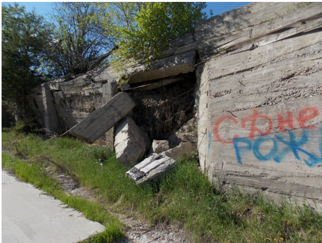
Рис. 15. Деформированная подпорная стенка на территории бывшей Ляминской РЭБ (г. Ханты-Мансийск, 2017 г.) (ТЦ ГМСН по Ханты-Мансийскому АО)
