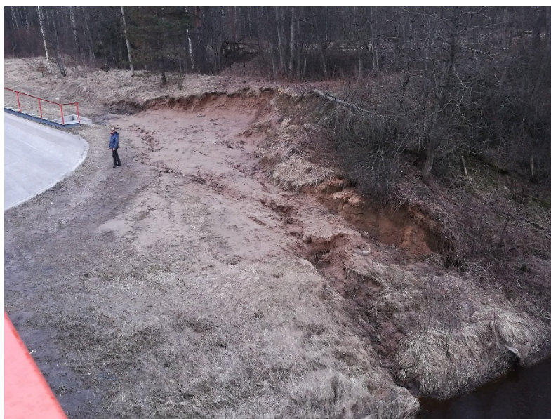
Рис. 36. Активный овраг у моста через р. Лава (автотрасса «Кола») (ТЦ ГМСН по Ленинградской области)
