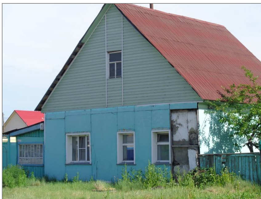
Рис. 105. Деформированный дом по ул. Карла Маркса, 46, г. Барабинск, Новосибирская область (ТЦ ГМСН по Новосибирской области)
