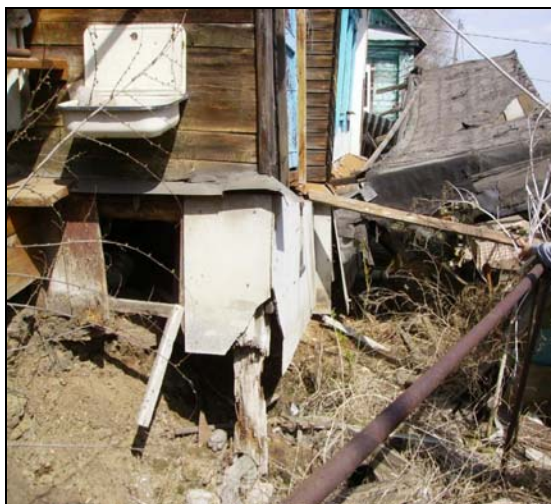
Рис. 76. Бровка оползневого уступа под домом №142 по ул. Декабристов. г. Сызрань, Самарская область. (ТЦ ГМСН по Самарской области)
