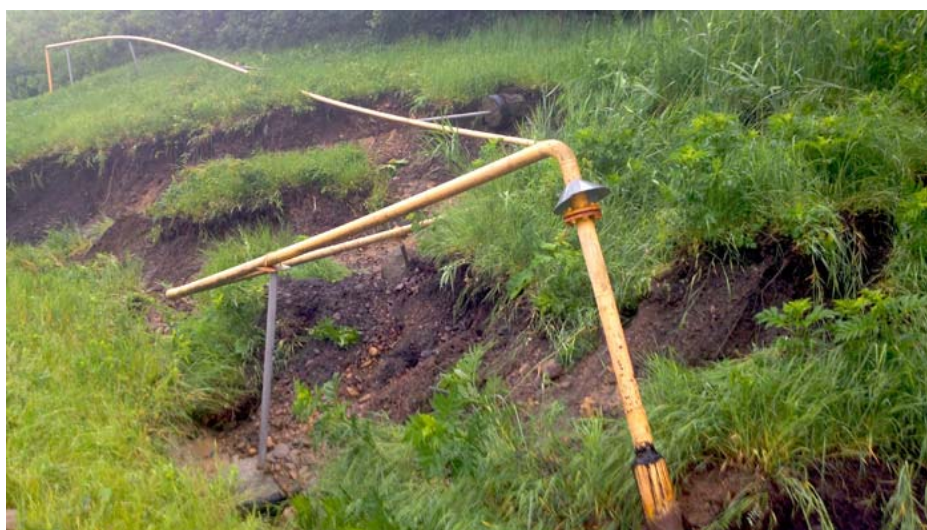
Рис. 41. Поврежденный участок газопровода в результате активизации оползневой процесса (открытые источники информации)
