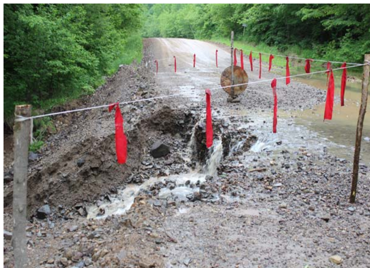
Рис. 24. Разрушенный участок дорожного полотна в результате активизации процесса оврагообразования, при переливе поверхностных вод на участке 278, 2 км а/д Находка-Кавалерово по состоянию на 07.06.2017 (Приморское отделение ДВРЦ ГМСН)
