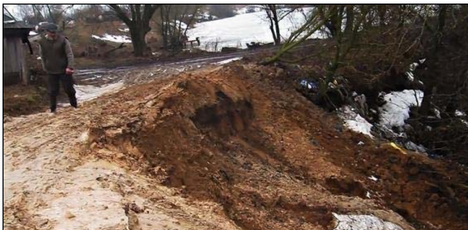
Рис. 29. Деформированный участок грунтовой дороги в результате активизации оползневого процесса на ул. Шумная в с. Стебаево, Липецкого района (ТЦ ГМСН по Липецкой области)
