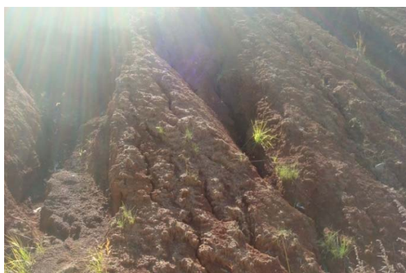
Рис. 13. Промоины на придорожном склоне, 117 км автодороги Хабаровск – Бикин, Хабаровский край
