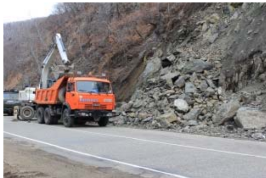
Рис. 12. Участок активизации осыпного процесса на 244 км автодороги Осиновка – Р. Пристань, Приморский край (14.11.2018)
