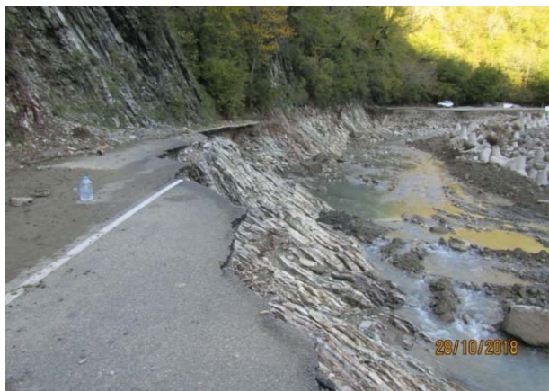
Рис.25. Участок активизации эрозионно-обвальных процессов на автодороге п. Макопсе – а. Наджиги вдоль правобережного уступа р. Макопсе, Лазаревский район МО г. Сочи, Краснодарский край
