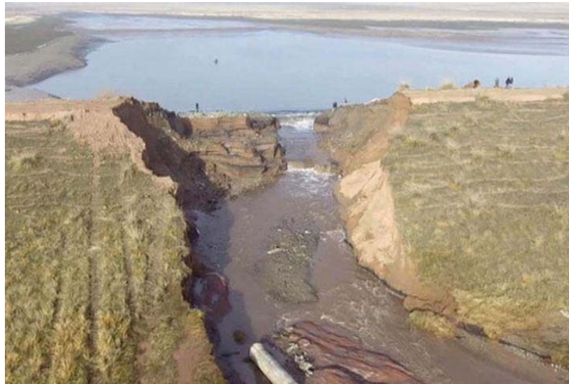
Рис. 34. Разрушенная дамба в с. Московское, Республика Хакасия (данные из открытых источников)
