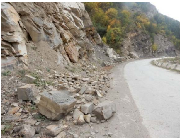
Рис. 28. Опасный обвально-осыпной склон в верховом откосе автодороги Гуниб – Цуриб в 3,0 км северо-западнее с. Кулла, Гунибский район, Республика Дагестан
