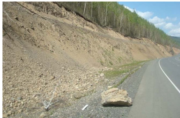
Рис. 18. Обвальные отложения на придорожном склоне, 136 км автодороги Лидога – Ванино, Хабаровский край
