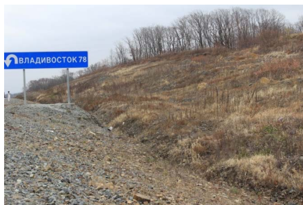
Рис. 10. Участок активизации оползневого процесса на пункте наблюдения «Раздольное 2», Приморский край (13.11.2018)
