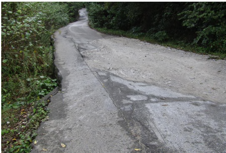
Фото 23.2020.0055. Оползневые деформации на автодороге с. Черешня – п. Ахштырь
