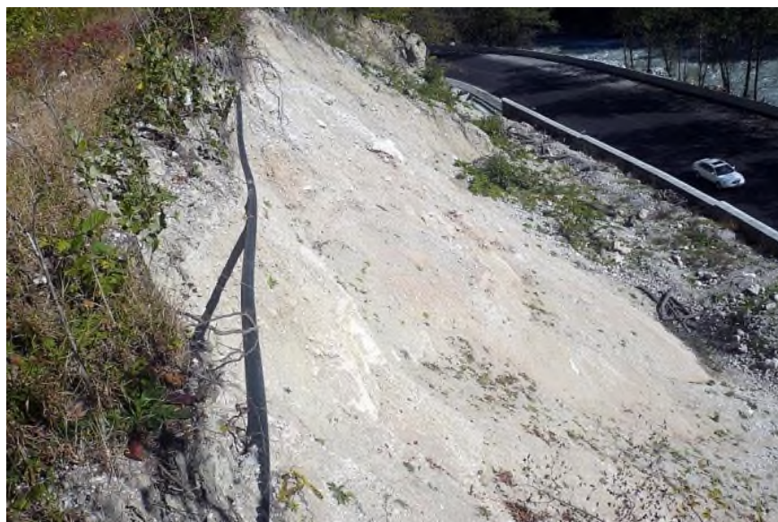
Фото 15.2020.0056. Оползень в верховом откосе ТрансКАМапк 605
