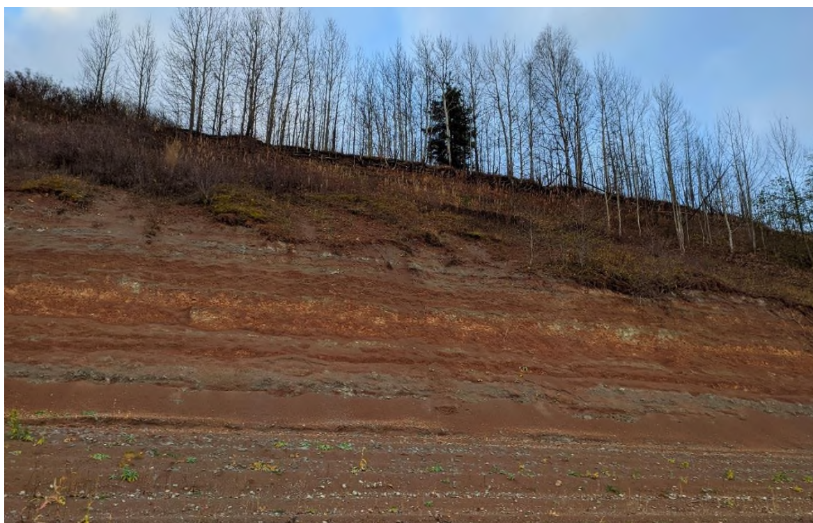
Фото 29-2020-0003 (а) район ДОКа, вблизи ж/д станции Заовражье. Активное проявление оползневого процесса
