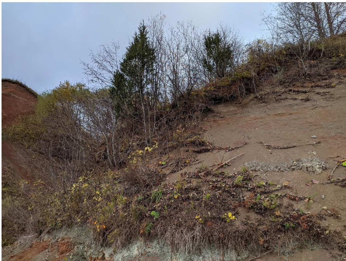
Фото 29-2020-0002 (б). ж/д станция Заовражье, ул. Мостозавод, 63А. Активное проявление процесса овражной эрозии
