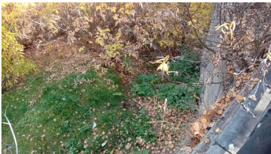
Фото 43.2020.0003. Вершина промоины, выходящая к фундаменту смотровой площадки на ул. Набережной Грина г. Кирова Кировской области
