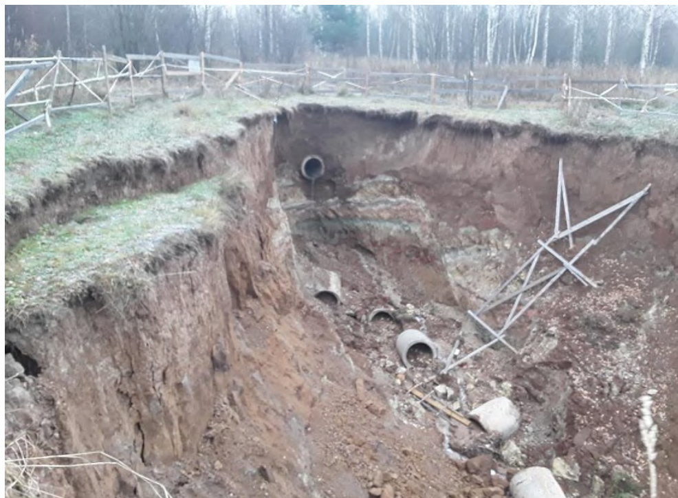
Фото 21.2020.0001. Разрушение земель в центральной части г. Чебоксары около парка «Лакреевский лес», Чувашская Республика
