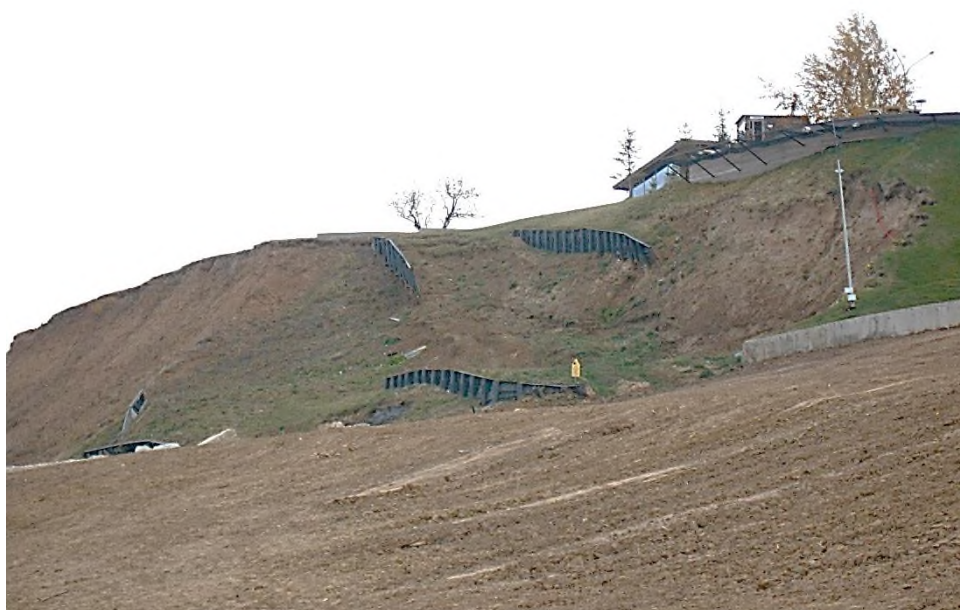
Фото 16.2020.0004. Активизация и сход оползня скольжения по ул. Большая Волга, на территории гостиничного комплекса «Камский трофей», пгт. Камское Устье, Республика Татарстан
