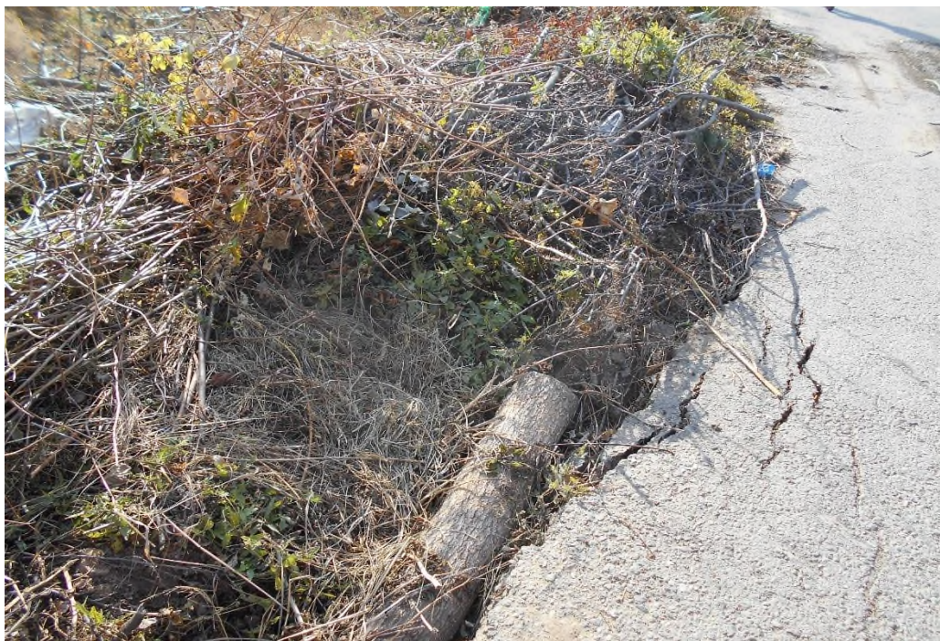
ото 16.2020.0011. Сход оползня проседания по адресу ул. Комсомольская разрушает уличную дорогу у дд. 4-6, пгт. Камское Устье, Республика Татарстан
