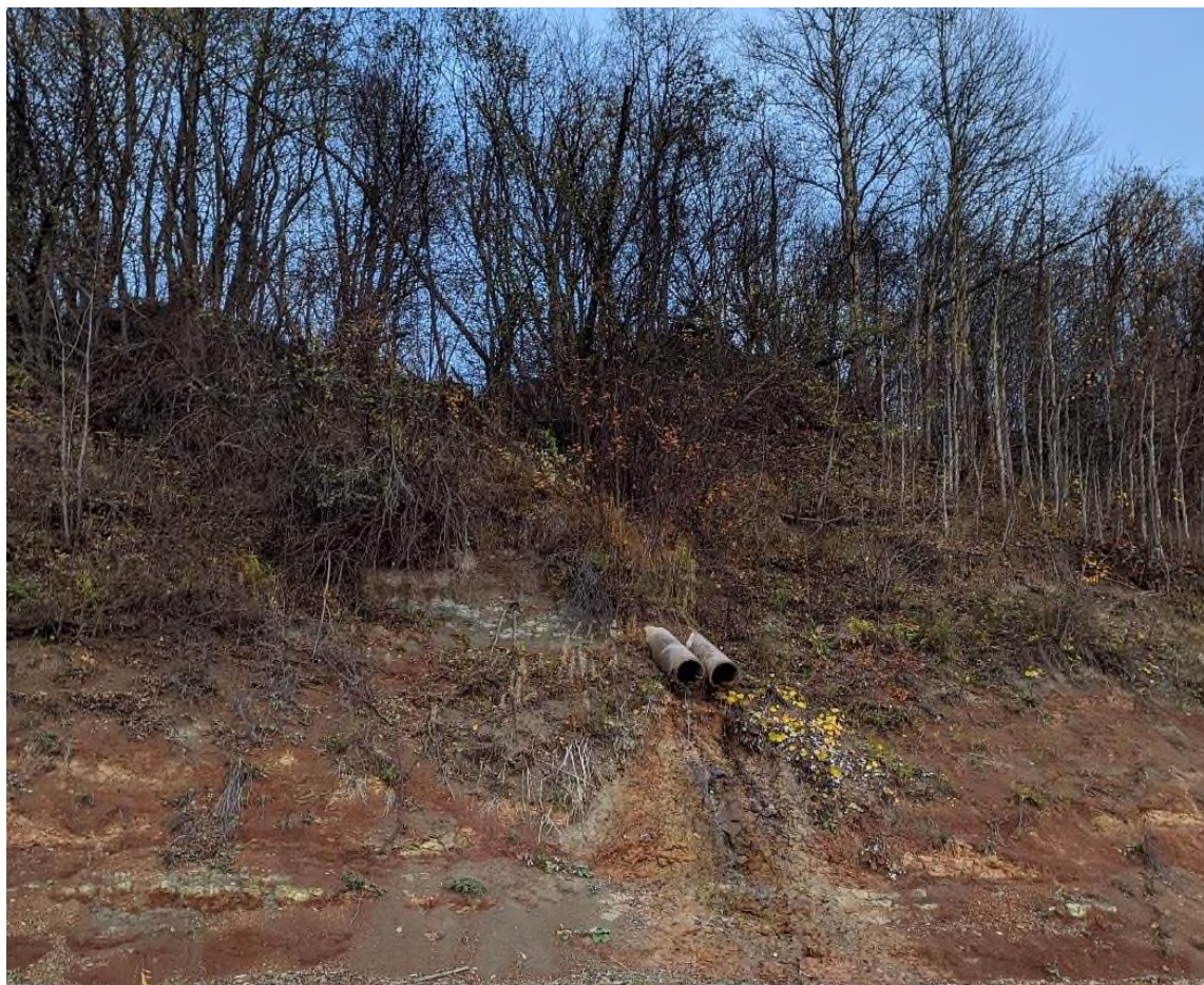
Фото 29-2020-0003 (б) район ДОКа, вблизи ж/д станции Заовражье. Активное проявление оползневой процесса
