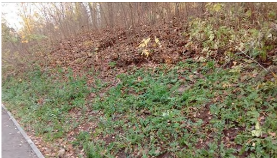
Фото 43.2020.0004. Стенки срыва дернового покрова в нижней части правого борта Раздерихинского оврага г. Кирова Кировской области
