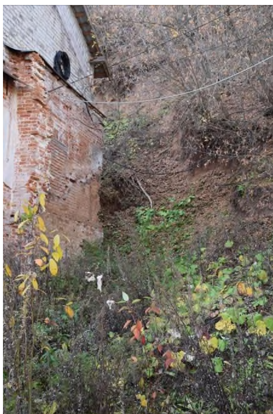
Фото 43.2020.0005. Подрезка основания склона р. Вятка за зданием ул. Пристанская, д. 5 г. Кирова Кировской области
