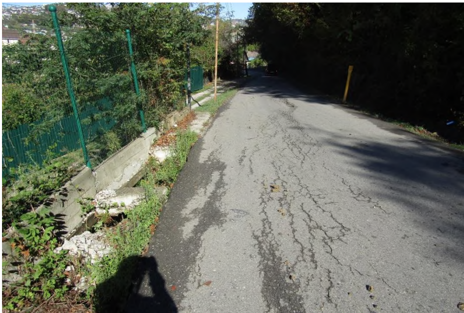
Фото 23.2020.0056. Оползневые деформации на автодороге на западной окраине с.Черешня
