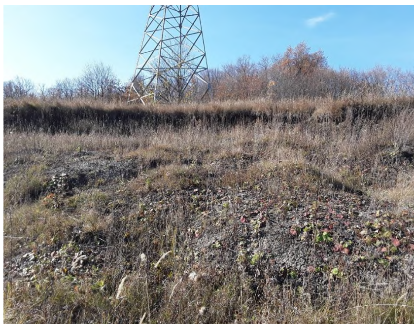
Фото 21.2020.0004. Разрушение насыпи, на которой расположена линия ЛЭП, восточная окраина с. Порецкое, Чувашская Республика
