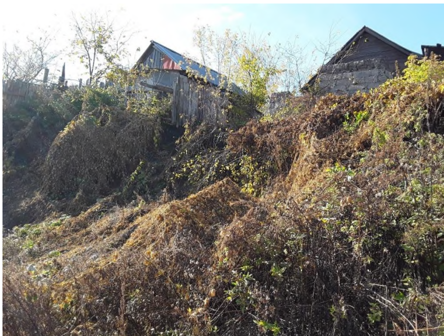
Фото 21.2020.0003. Разрушение земель восточная окраина с. Порецкое ул. Комсомольская, Чувашская Республика
