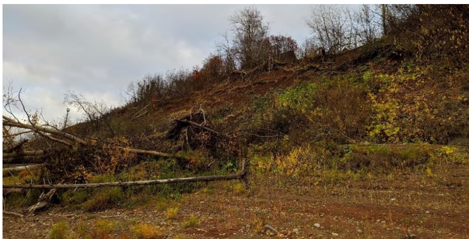
Фото 29-2020-0001 (а). г. Котлас, район ДОКа, ж/д станция Заовражье, ул. Мостозавод, 107, лестница близ ж/д моста. Активное проявление оползневого процесса
