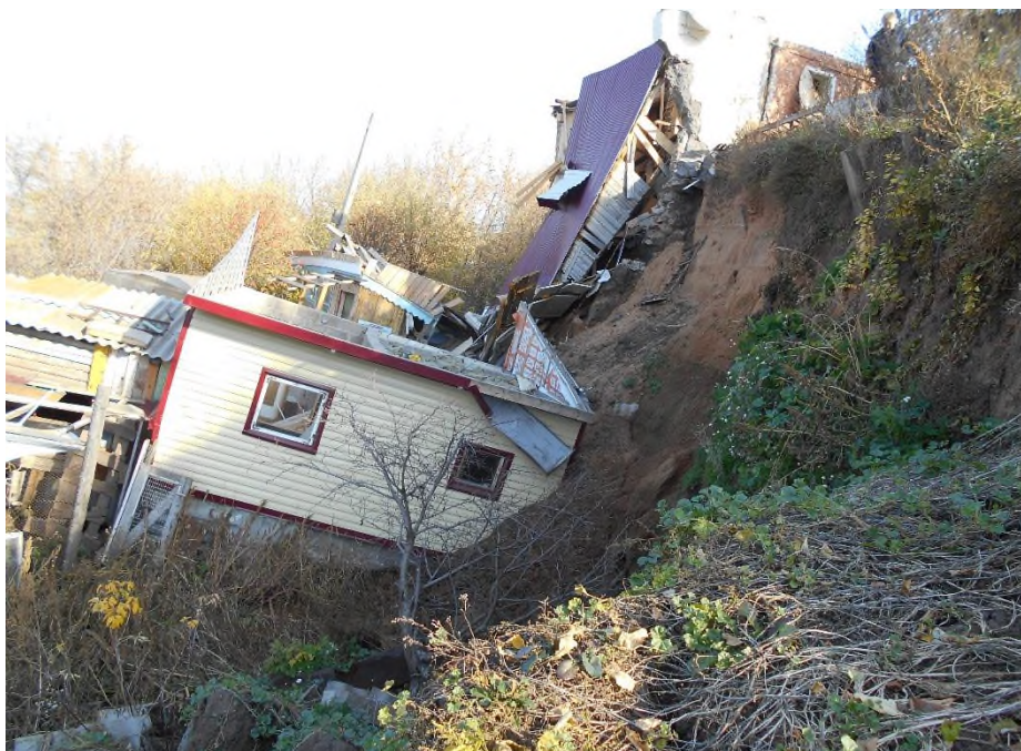
Фото 16.2020.0001. Развитие оползня проседания по ул. Маринина д.53, г. Чистополь, Республика Татарстан
