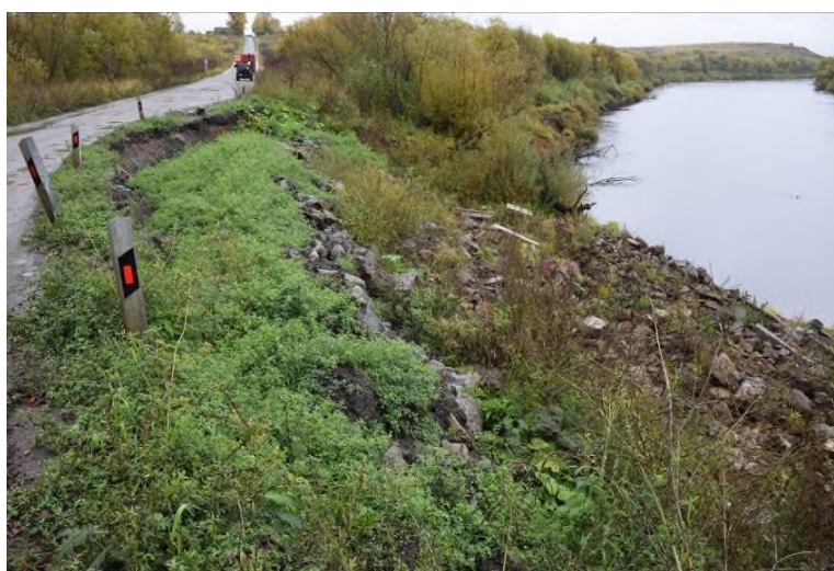
Фото 43.2020.0010. Развитие оползневого процесса на склоне р. Кама на 50 км автодороги Кирс – Южаки в районе с. Лойно Верхнекамского района Кировской области
