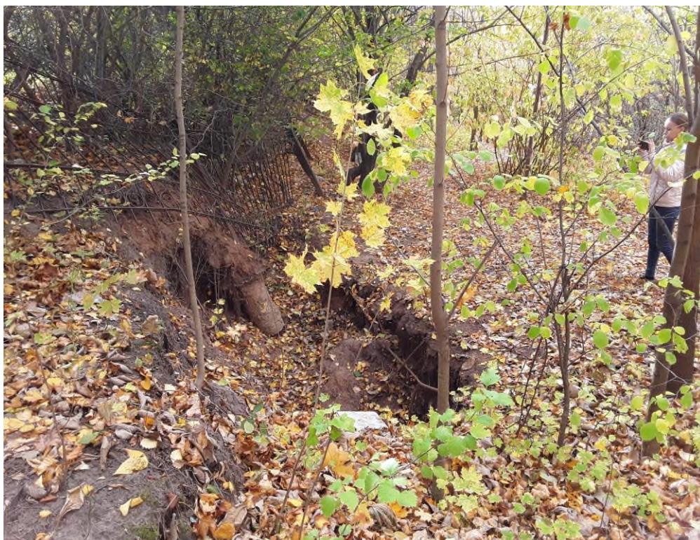
Фото 21.2020.0002. Деформация забора и разрушение земель многоквартирного дома по ул. Семёна Ислукова г. Чебоксары, Чувашская Республика
