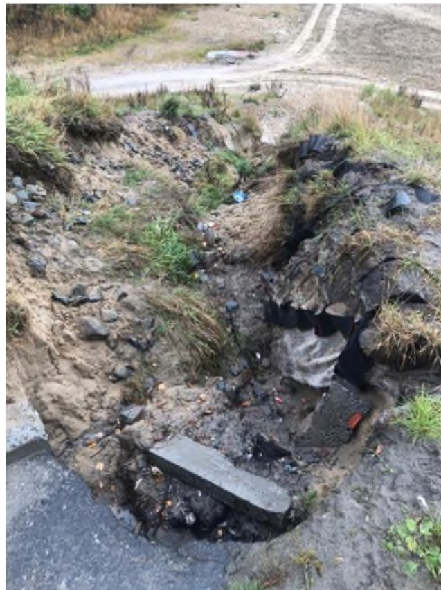
Фото 86.2020.00017. Активизация суффозии на смотровой площадке в г. Сургут, ХМАО-Югра
