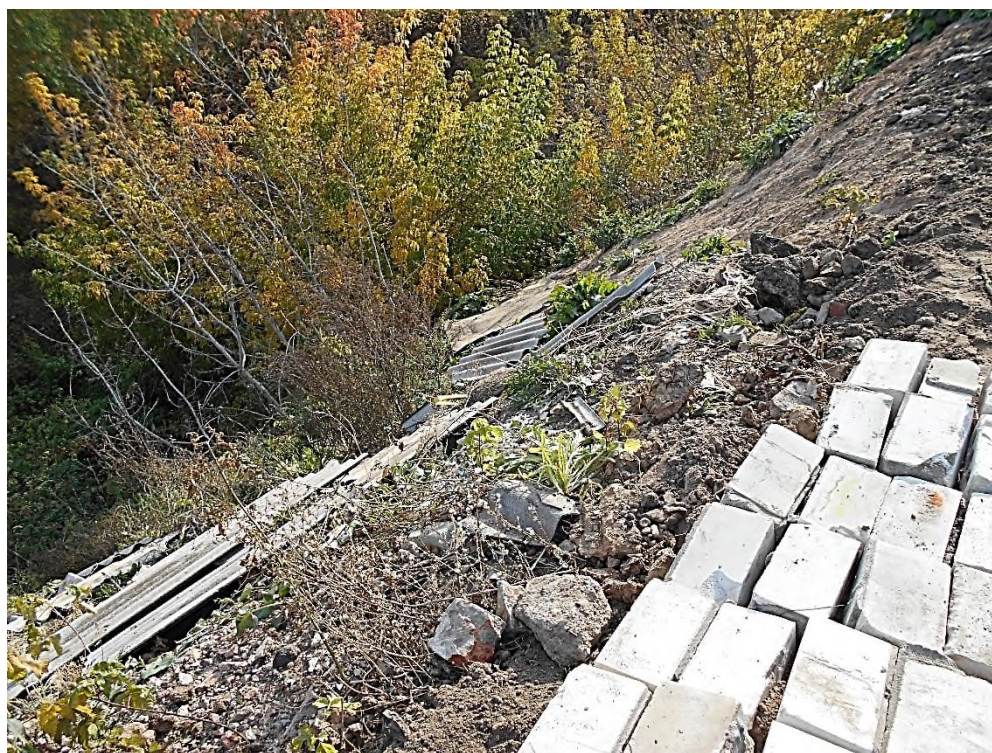
Фото 16.2020.0008. Укрепление оползневого борта оврага в начале ул. И. Федорова, оползень разрушает уличную дорогу, г. Казань, Республика Татарстан
