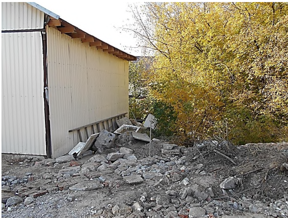
Фото 16.2020.0010. Обрыв оползня у северной стены дома 22 по ул. 2-ая Бадаева, засыпанный привозным строительным мусором, г. Казань, Республика Татарстан
