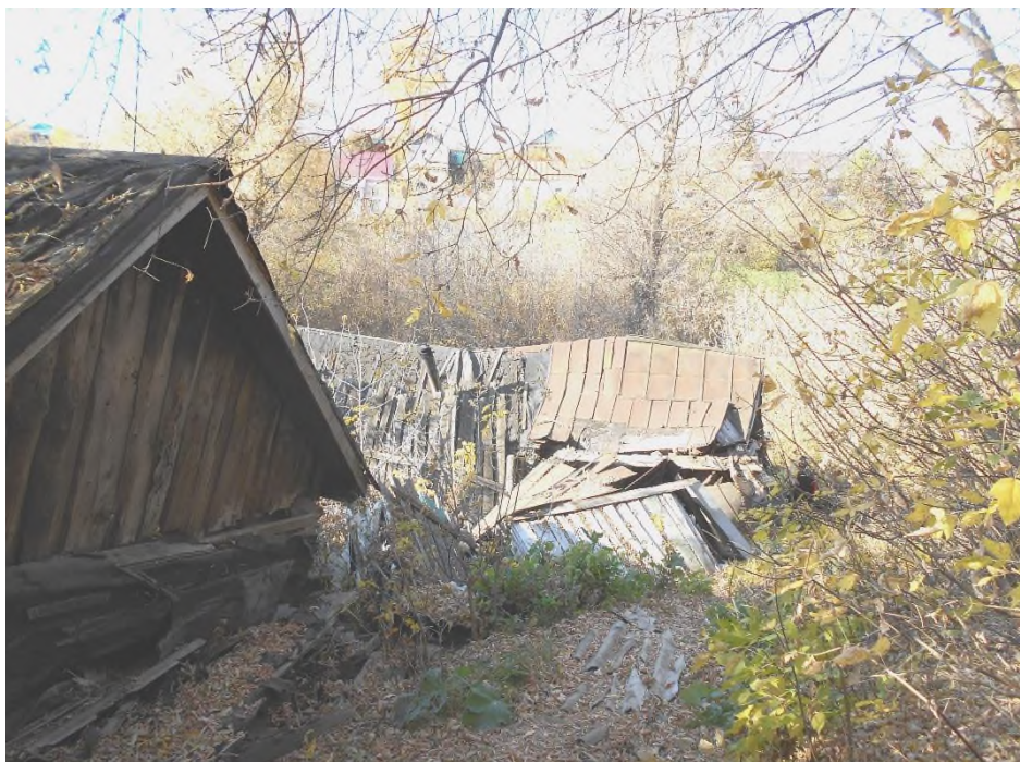
Фото 16.2020.0007. Развитие оползня скольжения по адресу ул. Маринина д.55, ниже дома 53, г. Чистополь, Республика Татарстан
