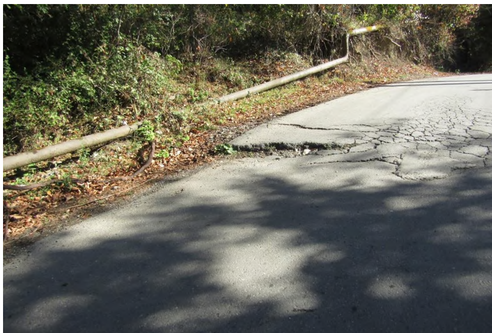
Фото 23.2020.0057 Оползневые деформации по ул. Владимирской в с. Черешня
