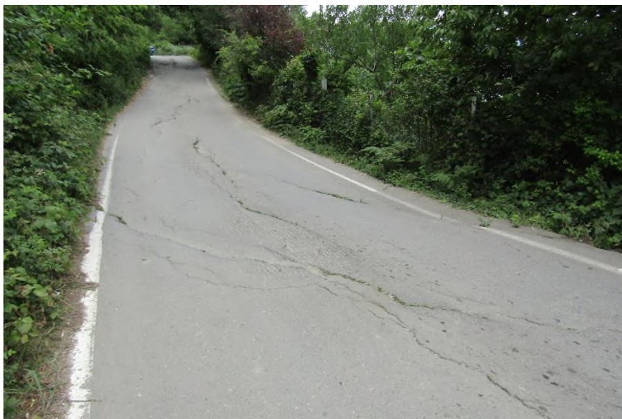
Фото 23.2020.0054. Оползневые деформации на автодороге с.Галицыно – с. Лесное
