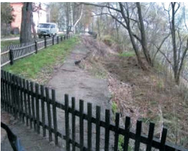
Рис. 2.7. Обрушение пешеходной дорожки на Кустодиевском бульваре в г.Тутаеве, Ярославская область (ТЦ ГМСН “Ярославпгеомониторинг”)
