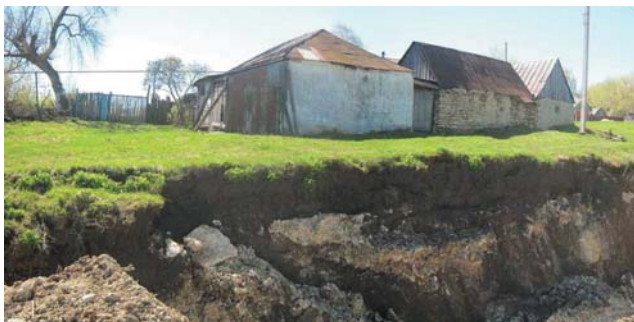
Рис. 2.4. Оползень-обвал грунтовой дороги в с.Злобино, Пинецкая область (ТЦ ГМСН “Пинецкгеомониторинг”)
