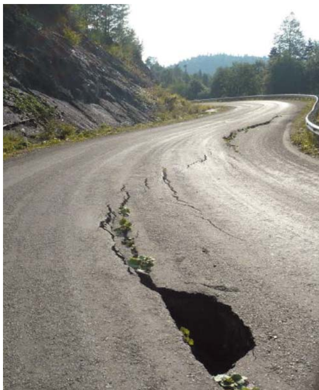
Рис. 2.9. Оползневые трещины в полотне автодороги п.Гузерибль—п.Партизанский (ГУП “Кубаньгеология”)
