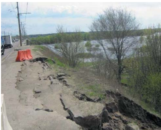
Рис. 2.5. Активизация оползневого процесса на Октябрьском мосту в с.Сырское, Пинецкая область (ТЦ ГМСН “Пинецкгеомониторинг”)
