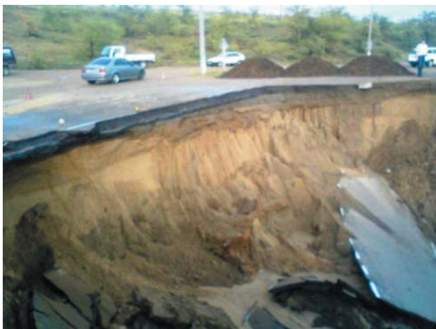
Рис. 2.35. Разрушение автомобильной дороги А-165 Улан-Удэ–Кяхта, Республика Бурятия (РЦ ГМСН по Сибирскому федеральному округу)
