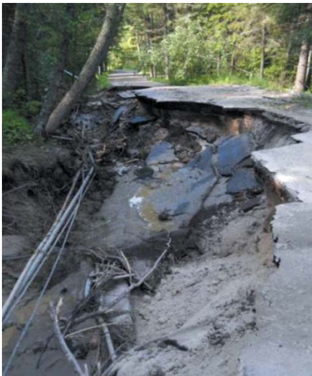
Рис. 2.28. Проявление суффозионных процессов в г. Ханты-Мансийск в районе биатлонной трассы (Ханты-Мансийский ТЦ ГМСН)
