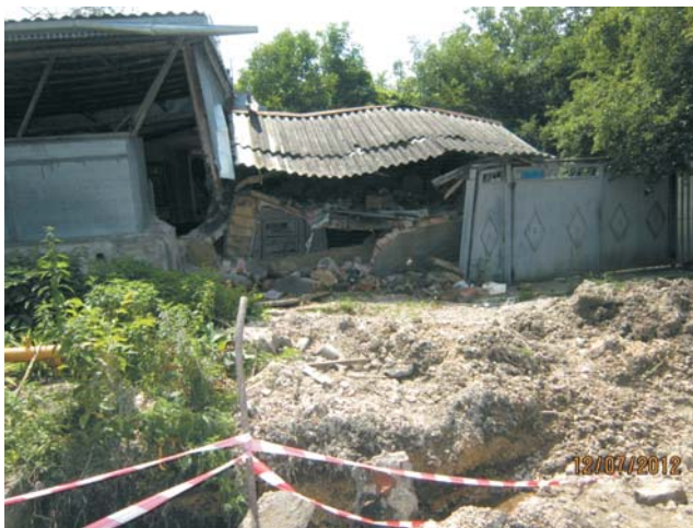
Рис. 2.15. Домостроения, разрушенные в результате активизации оползня в г.Пятигорске (п.Свобода) (Южный региональный центр ГМСН)
