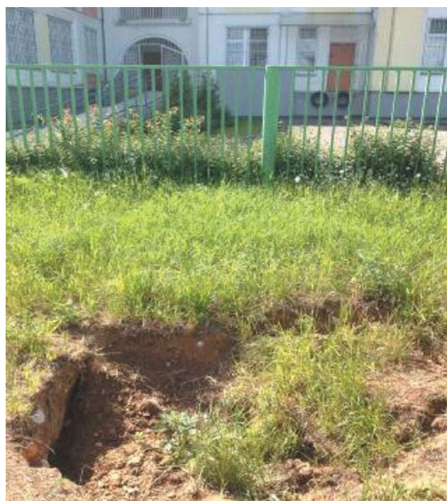
Рис. 2.47. Провал грунта у ограды детского сада на ул.Борисовские пруды, г.Москва (ОАО “Геоцентр-Москва”)
