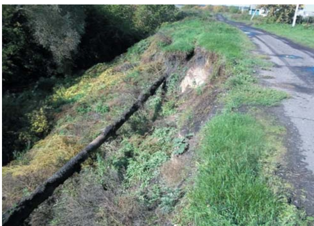
Рис. 2.16. Воздействие оползневой процесса на автодорогу и газопровод в с.Ст.Обуховка, Республика Мордовия (Мордовский ЦС ГМСН)
