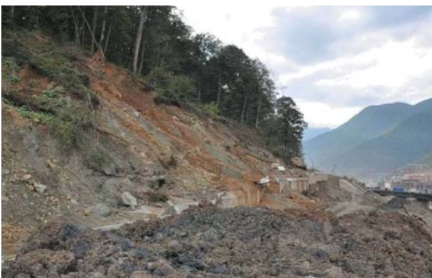
Рис. 2.11. Оползневые смещения в верховом откосе строящейся железной дороги Агпер–Красная Поляна (от ПК-450 до ПК-476) (Южный региональный центр ГМСН)
