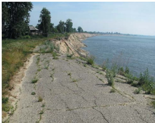
Рис. 2.43. Разрушение дороги в г.Колпашево, Томская область (РЦ ГМСН по Сибирскому федеральному округу)
