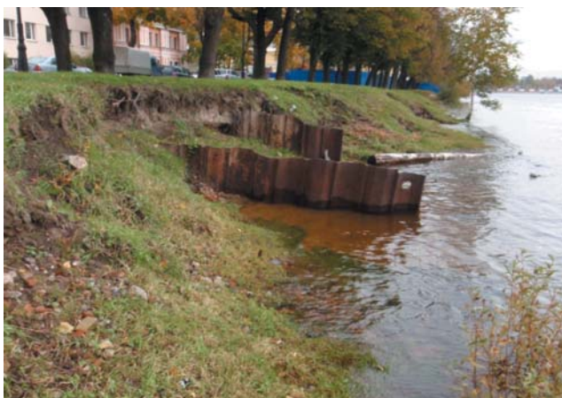
Рис. 2.37. Речная и склоновая эрозии набережной р.Малая Невка вблизи Каменноостровского моста в г.Санкт-Петербурге (ГГУП "СФ "Минерал")
