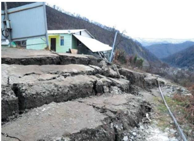
Рис. 2.10. Трещины на оползневом массиве в районе с.Барановка (ГУП “Кубаньгеология”)
