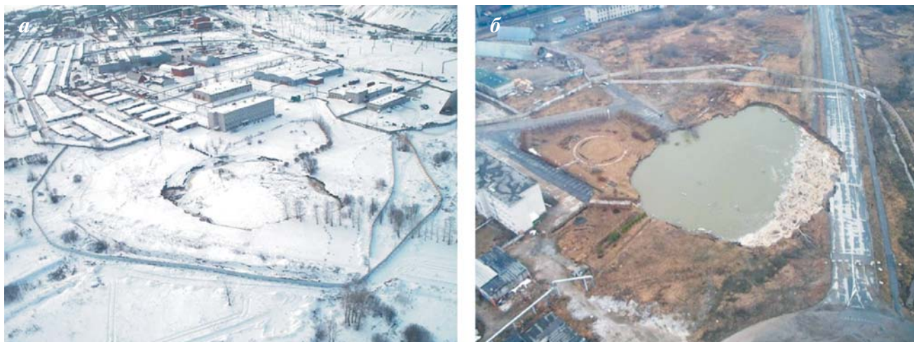
Рис. 2.51. Провал №3 севернее АБК БСШУ по состоянию на середину апреля (а) и июнь (б) 2012 г., Пермский край (Верхнекамский центр МГС ОАО “Уралкапий”)
