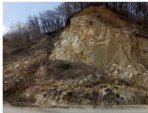
15-11-00085. Оползень Батакоюртский III
