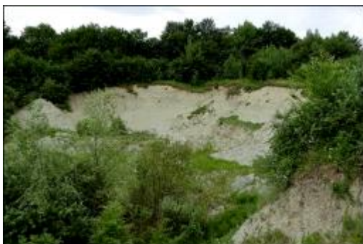
Фото 07-11-00004 – Оползень «Дорожный» (07-11-00004), в 2 км к западу от с. Герпегеж (Черекский муниципальный район). Стенка отрыва, активная часть. (10.06.2024 г., ООО «Каббалкгеомониторинг»)
