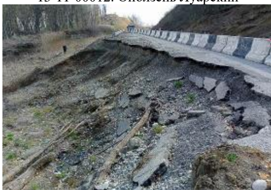
15-11-00086. Оползень Батакоюртский IV
