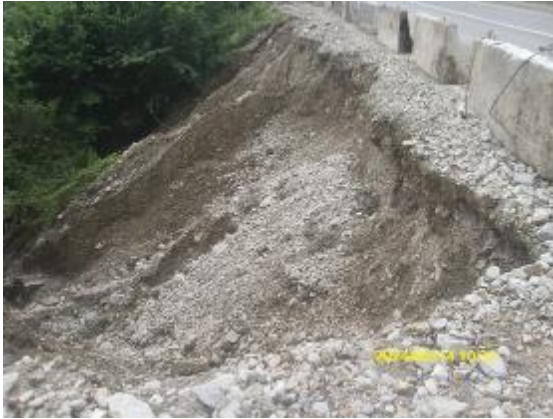
Фото 20-11-00586. Шатойский район. Автодорога с.Зоны – с.Шатой в 3,5км на юг от с.Зоны. 14.06.24.
