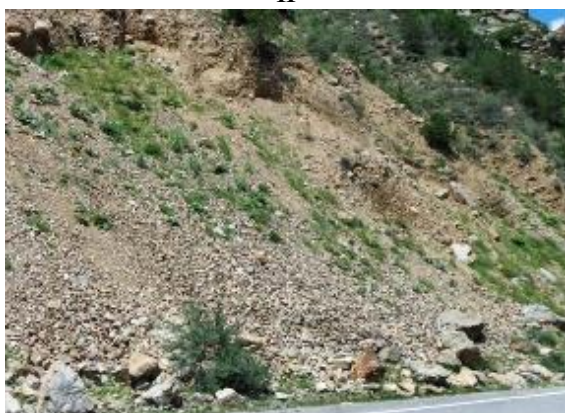
15-12-00080. Обвально-осыпной участок Усть-Садонский
