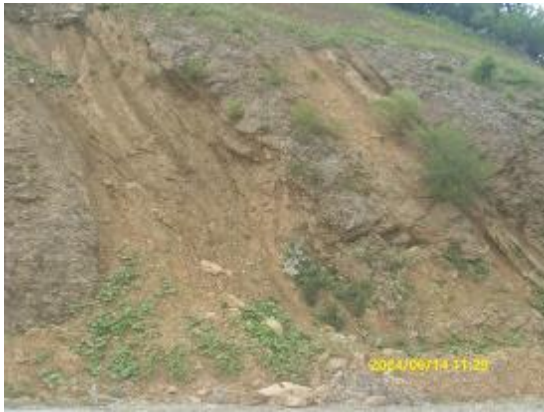
Фото 20-11-00462. Шатойский район. с.Пионерское в 0,56км южнее на автодороге с.Пионерское – с.Чишки. 14.06.24.
