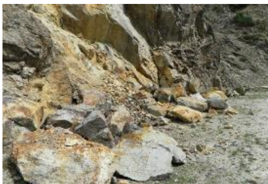
15-10-00127. Обвал на км 9,7 а/д Мацута-Дунта
