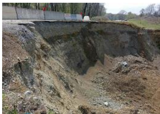
15-11-00104. Оползень Батакоюртский VIII
