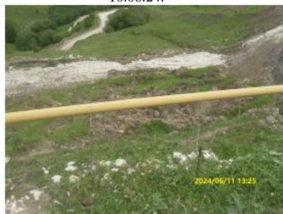
Фото 20-11-00299. Шатойский район. с.Верхний Дай. В головной части оползня разрушена а/д без покрытия на участке длиной 11м, 2 стойки газопровода разрушены. В средней части полностью разрушено полотно а/д без покрытия, на участке длиной 23м. 11.06.24.
