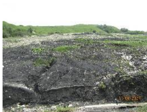
Фото 26-11-01051 Активизация оползневого процесса в нижней склоне дороги п. Белореченский – Верхняя база центр Спортивной Подготовки на 3,8 км (г. Кисловодск)
