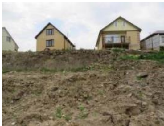
Фото. 26-11-00102. Смещения в головной части у левого и правого бортов оползня
