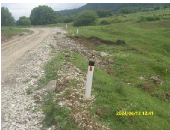
Фото 20-11-00585. Шатойский район. Проселочная дорога на юг от с.Грушкорт. Разрушена обочина дороги без покрытия на участке длиной 10м, шириной 1м. 12.06.24.
