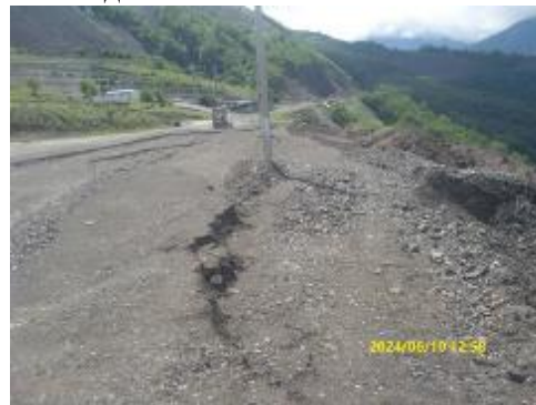
Фото 20-11-00584. Итум-Калинский район. Автодорога с. Итум-Кале – с.Ведучи в 3,9км на юго-восток от с.Итум-Кале Под угрозой разрушения 2 столба ЛЭП и линия ЛЭП длиной 75м. 10.06.24.
