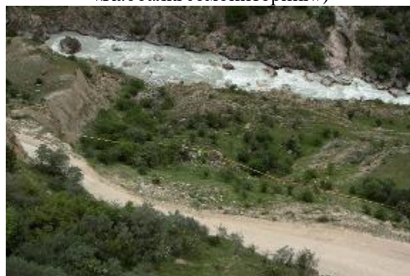
Фото 07-11-00022 – Активный участок оползня на нижнем откосе а/д Урвань-Уштулу в правом борту р. Черек Балкарский, в 1,5 км к СВ от с. Верхняя Балкария, Черекский муниципальный район. Деформация автодороги и газопровода среднего давления. (19.06.2024 г., ООО «Каббалкгеомониторинг»)
