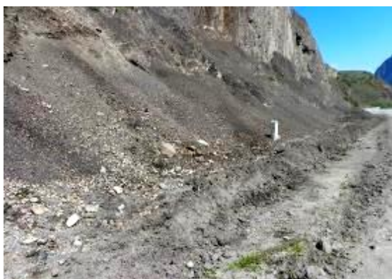
15-12-00107. Обвально-осыпной участок Суаргомский II
