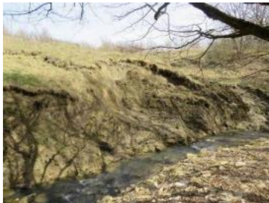
Фото. 26-11-00007. Участок активизации 2-го порядка в языке оползня.
