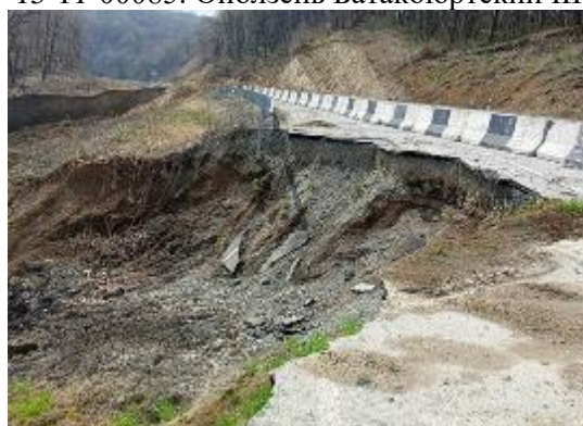
15-11-00087. Оползень Батакоюртский V
