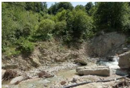
Фото 07-11-00002 – участок активизации в нижней части оползня 07-11-00002 в правом борту р. Белая, в 600 м к ЮЗ от устья р. Белая (г.о. Нальчик) (14.06.2024 г., ООО «Каббалкгеомониторинг»)
