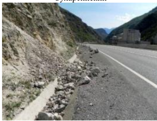
15-12-00130. Обвально-осыпной участок ТрансКАМ 397
