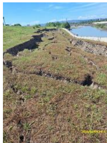
Фото 20-11-00583. Городской округ г.Аргун. На въезде в город смещение берегоукрепительного сооружения из железобетона на участке длиной 85м. 04.06.24.
