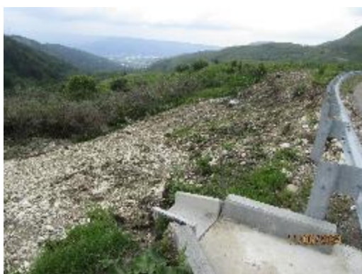
Фото 26-11-01003 Активизация оползневого процесса в верхнем борту дороги п. Белореченский – Верхняя база центр Спортивной Подготовки на 4,3 км (г. Кисловодск)
