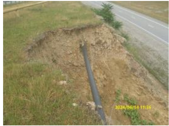
Фото 20-11-00521. Шатойский район. с.Пионерское в 0,54км южнее на автодороге с.Пионерское – с.Чишки. 14.06.24.
