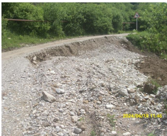
Фото 20-11-00524. Веденский район. Автодорога с. Агишбатой – с. Эрсеной 2,56 км. Разрушено полотно дороги без покрытия на участке длиной 25м, шириной 1,5м. 18.06.24.
