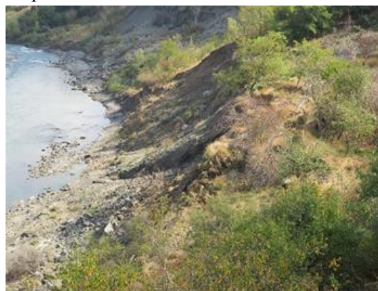
Фото. 26-11-00050. Оп. №350. Смещения в верхней части зоны транзита и у левого борта оползня, в весенне-летний период.
