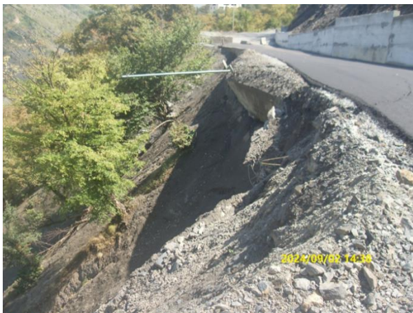
Фото 06-12-00088. Осыпной процесс в Джейрахском районе, с.Джейрах. Разрушена обочина дороги с покрытием длиной 15м, шириной 2м. Упал 1 столб ЛЭП и разрушена линия ЛЭП на участке длинно 100м.
