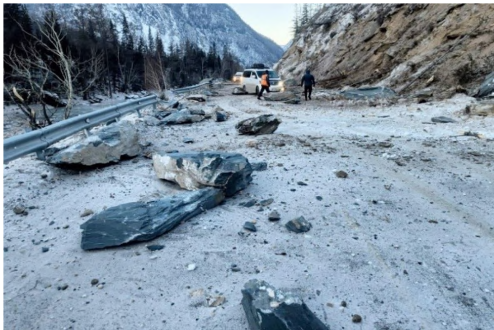
Фото 04-10-00005. Уч. а/дороги Р-256 Чуйский тракт, 764,525-764,86 км. Глыбы на дорожном полотни, Онгудайский район, Республика Алтай, 19.01.2024
