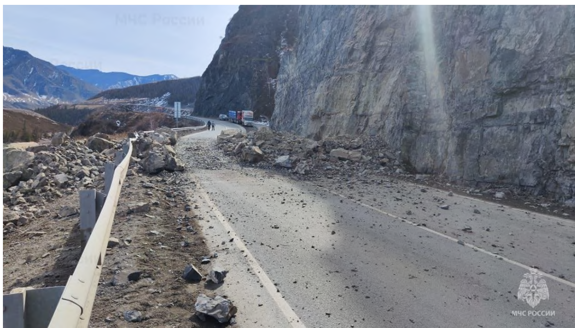
Фото 04-10-00004. Уч. а/дороги Р-256 Чуйский тракт, 686 км. Дорога на отрезке 10 м частично расчищена для пропуска транспорта, Онгудайский район, Республика Алтай, 27.03.2024
