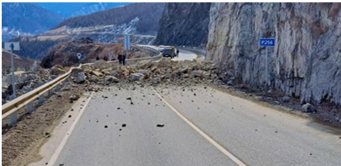
Фото 04-10-00004. Уч. а/дороги Р-256 Чуйский тракт, 686 км. Глыбы перекрыли автодорогу Р-256 на отрезке 10 м, Онгудайский район, Республика Алтай, 27.03.2024
