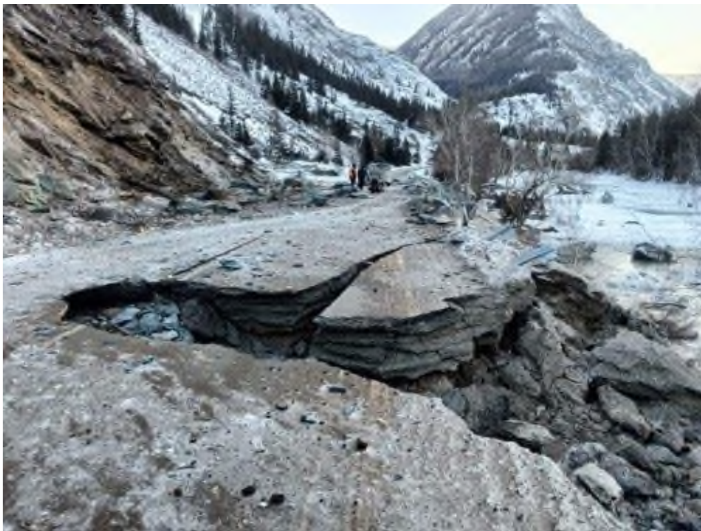
Фото 04-10-00005. Уч. а/дороги Р-256 Чуйский тракт, 764,525-764,86 км. Разрушение дороги, Онгудайский район, Республика Алтай, 19.01.2024
