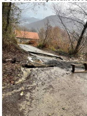
Фото 23-11-00567. Деформация дорожного покрытия по ул. Мичурина. МО город-курорт Сочи, Адлерский район, с. Каштаны. Фото из сторонних источников.
