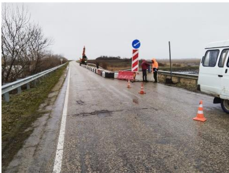
Фото 01-11-00117. Активизация оползневой процесса в откосе дороги. Тахтамукайский район, участок дамбы вдоль Октябрьского водохранилища (автодорога 79А-110 Энем-Адыгейск-Бжедугхабль). Фото из открытых источников СМИ.
