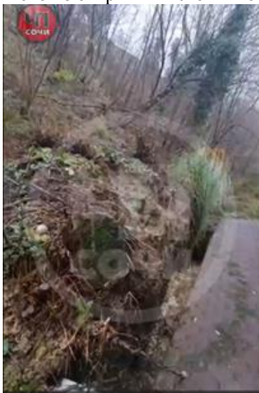
Фото 23-11-00577. Активизация оползня по ул. Клубничная МО город-курорт Сочи, Центральный район, мкр. Новый Сочи, Фото из открытых источников СМИ
