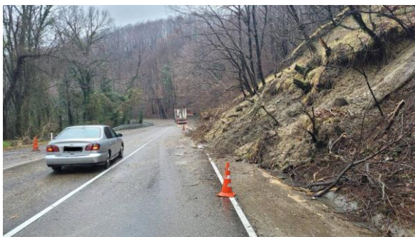
Фото (номер не присвоен). Активизация оползневой процесса в верхнем откосе автодороги А-147 «Джубга-Сочи» на 54 км. Фото из открытых источников СМИ
