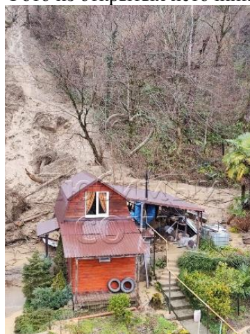
Фото 23-11-00582. Наполнение оползневых масс на жилой дом. МО город-курорт Сочи, Адлерский район, с. Казачий Брод, СТ Пекан.
