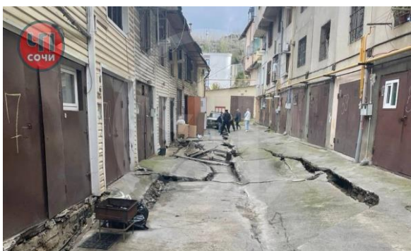
Фото 23-11-00585. Деформации дорожного полотна, жилых гаражей при активизации оползневого процесса. МО город-курорт Сочи, Центральный район, мкр. Больничный городок. Фото из открытых источников СМИ
