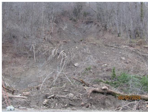
Фото 23.11.00274. Активизация оползневой процесса, на участке 1427 км автодороги М-4 «Дон» в 2,4 км к северу от с. Дефановка. Фото ЮРЦ ГМСН «Гидроспецгеология»
