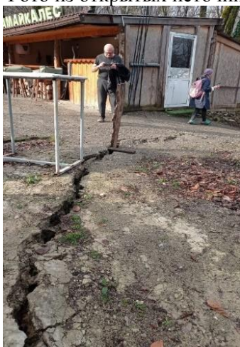
Фото 23-11-00584. Активизация оползня в районе базы отдыха «Мамайка Лес». МО город-курорт Сочи, Лазаревский район. Фото из открытых источников СМИ
