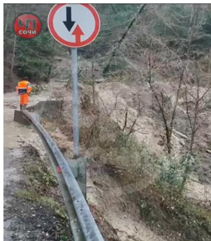
Фото 23-11-00579. Перекрытие оползнем движения участка дороги 03К-465 «Подъезд к с. Красная Воля» 4 км +200 МО город-курорт Сочи, Адлерский район.
