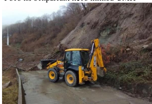
Фото 23-11-00538. Оползень в верховом откосе дороги. МО город-курорт Сочи, Адлерский район, с. Ахштырь, ул. Кропоткинская у Пункта пограничного контроля. Фото из открытых источников СМИ
