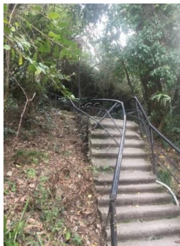
Фото 23-11-00583. В результате активизации оползневого процесса повреждена бетонная лестница. МО город-курорт Сочи, Центральный район, мкр. Завокзальный. Фото из открытых источников СМИ
