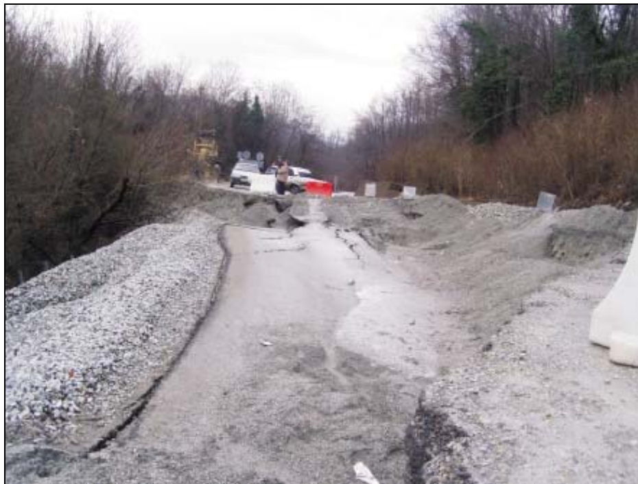
Рис. 3. Оползневые подвижки федеральной автодороги «Дон» М-4 на 1491 км в Краснодарском крае (фото ГУП «Кубаньгеология»).
