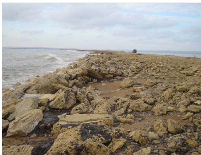
Рис.7. Активный размыв щебенисто-глинистого покровного слоя поверхности дамбы со стороны Таманского залива.
