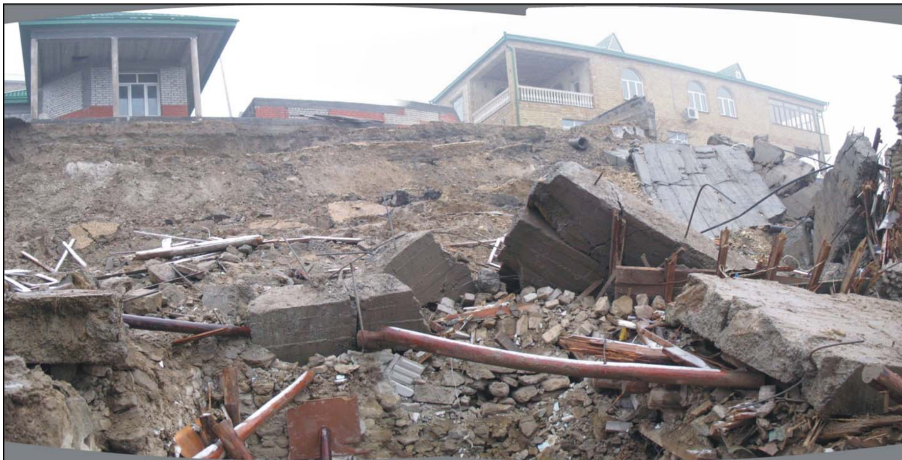
Рис.4. Разрушенные конструкции подпорной стенки и домостроения по ул. Средн. Таркинская, 202, г. Махачкала.
