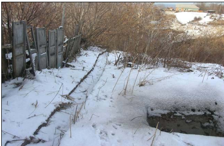
Рис.1. Самовольно сооруженный желоб для стока поверхностных вод через усадьбу на овражный склон в районе ул. Горская, 87. Алтайский край, г. Барнаул.
