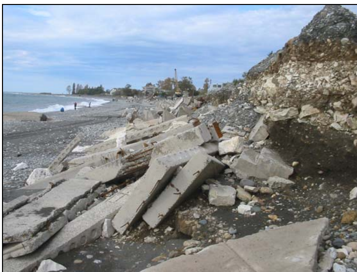
Рис.10. Размыв техногенной защитной наброски из обломков плит, бетонных кубов и пирамид на левобережье р. Мзымта.
