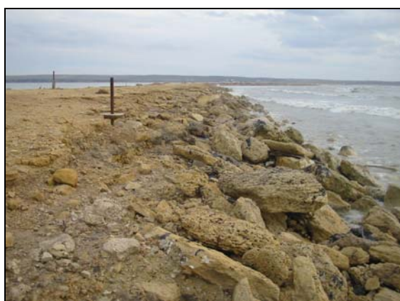
Рис.5. Интенсивный размыв каменно-глыбовой защитной наброски откоса дамбы с морской стороны.
