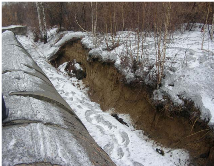
Рис.6. Оползень антропогенного типа на трассе действующего водовода БНС-2. Алтайский край, г. Барнаул, Октябрьский район.
