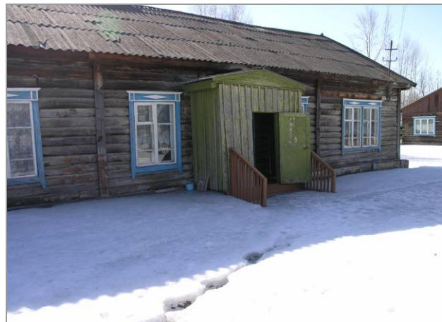
Рис.21. Село Чендек. Жилой корпус детского сада. По периметру здания наледь мощностью до 0,5 м. Республика Алтай, Усть-Коксинский район.
