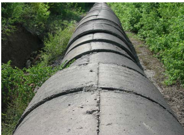
Рис.7. Участок БНС-2. Деформации бетонной «скорлупы» водовода на месте схода оползня, г. Барнаул, Октябрьский район.
