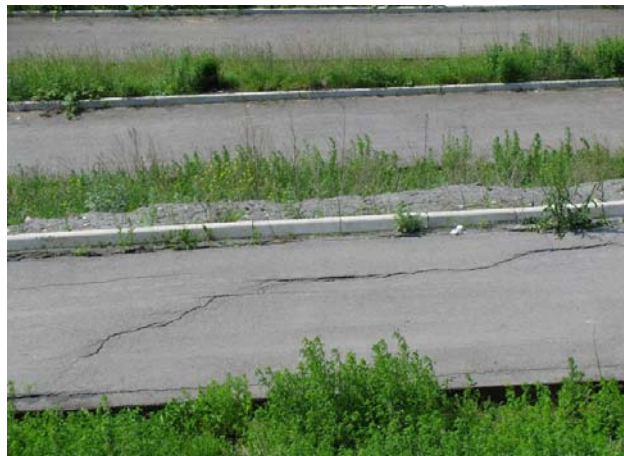
Рис.14. Просадочная трещина (оползневой цирк №11). Лагерный сад, г. Томск.
