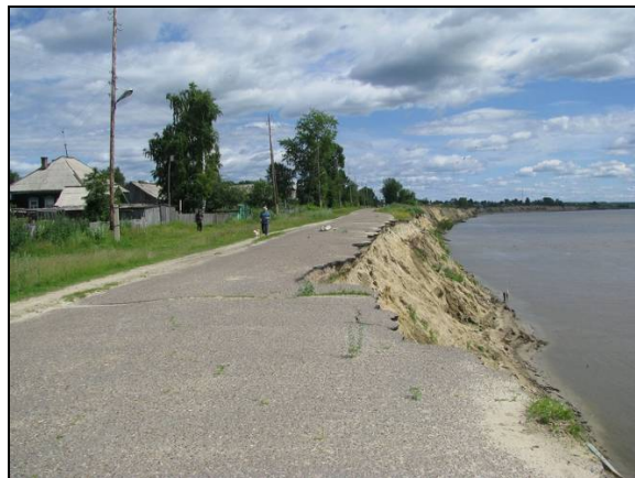
Рис.4. Разрушение дорожного полотна по ул. Дзержинского в г. Колпашево, Томская область.
