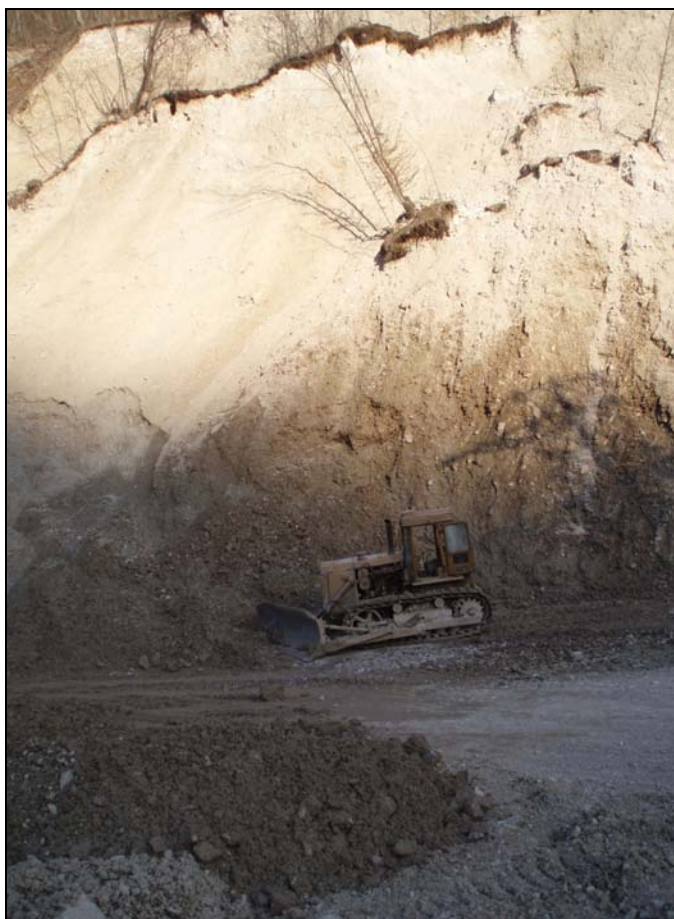
Рис.4. Обвал рыхлых пород в верховом откосе автодороги, идущей в с. Шатой (ООО «Стройсервис»).
