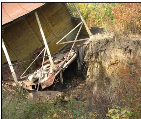
Рис.6. Разрушенное дачное строение на новой стенке срыва оползня Пчелка, 6 октября 2008 г. (Саратовская ГГЭ ФГУП "Волгагеология").
