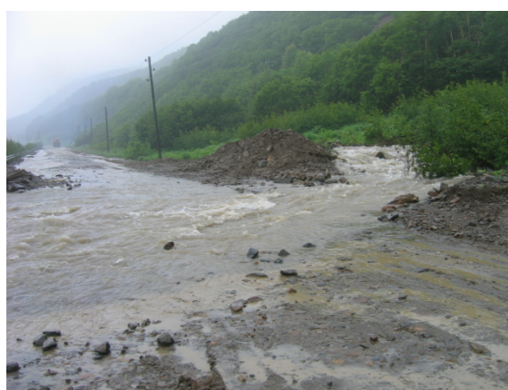
Рис.19. Размывание полотна автодороги грязеводными потоками, 241км (ФГУГП «СахГРЭ»).
