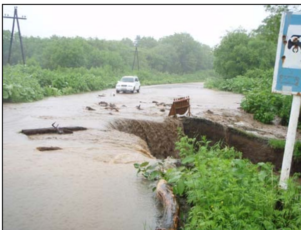
Рис.20. Промоина на 14 км автодороги Южно-Сахалинск – Холмск (23 июня 2009 г) (ФГУГП «СахГРЭ»).
