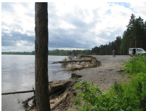
Рис.15. Разрушение дорожного полотна на участке «Мост Чулым» (ОАО «Томскгеомониторинг»).
