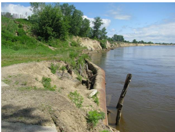
Рис.13. Размыв ливневого коллектора в районе пристани, г. Колпашево (ОАО «Томскгеомониторинг»).
