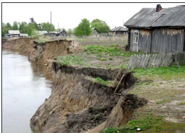
Рис.17. Разрушение берега р. Чулым вблизи от дома № 4 по ул. Коммунальной, с. Зырянское (ОАО «Томскгеомониторинг»).
