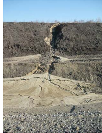
Рис.2. Трасса М-53. Эрозионный размыв придорожных склонов, Красноярский край (ФГУП «Красноярскгидрогеология»).
