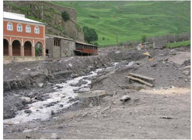
Рис.8. Фрагменты разрушенного водопровода и мостового перехода в результате активизации селевого процесса в с. Ириб (ГУП РЦ «Дагестангеомониторинг»).
