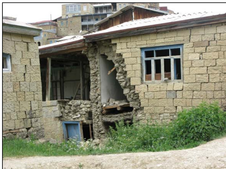
Рис.6. Деформации домостроений в результате активизации оползневого процесса в с. Чох (ГУП РЦ «Дагестангеомониторинг»).
