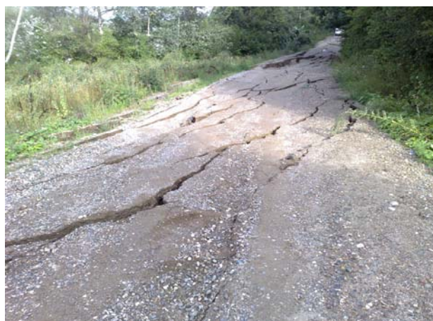
Рис. 13. Разрушено полотно объездной автодороги на правом берегу р. Пшехи; 06.08.2009 (ГУП «Кубаньгеология»).
