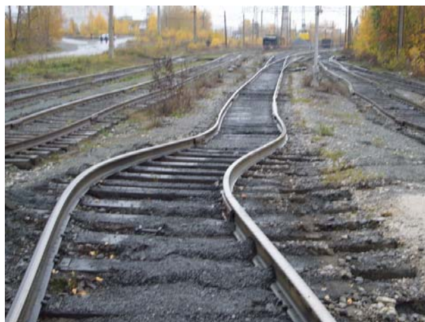
Рис. 16. Деформации полотна железной дороги (РЦ ГМСН по Уральскому федеральному округу)
