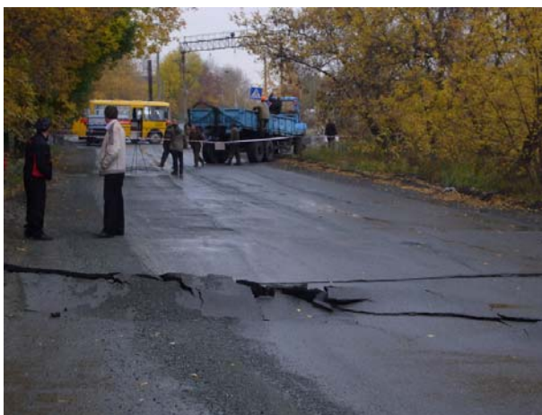
Рис. 15. Просадка поверхности автомобильной дороги (РЦ ГМСН по Уральскому федеральному округу)
