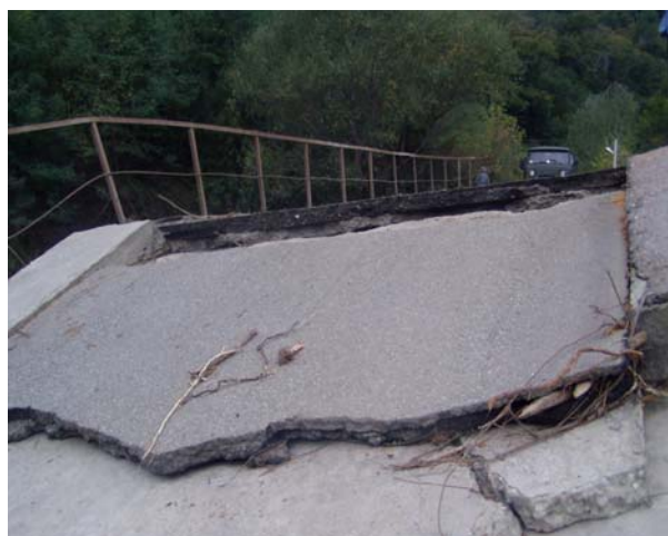
Рис.4. Разрушенный мост через р. Туапсе в районе п. Мессажай (ГУП «Кубаньгеология»)
