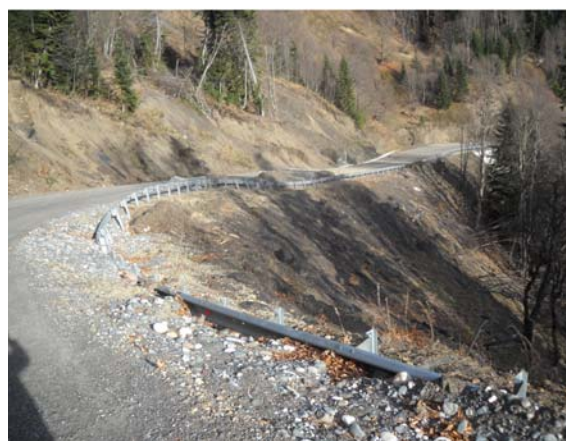
Рис.2. Деформация полотна дороги западнее п. Гузерипль (ГУП «Кубаньгеология»)
