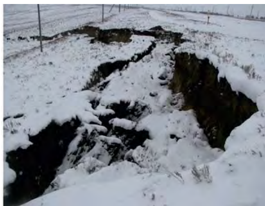
Рис.3. Фрагмент активного оползневого проявления на 176-м км магистрального нефтепровода «Грозный – Баку» (ГУП РЦ «Дагестангеомониторинг»)
