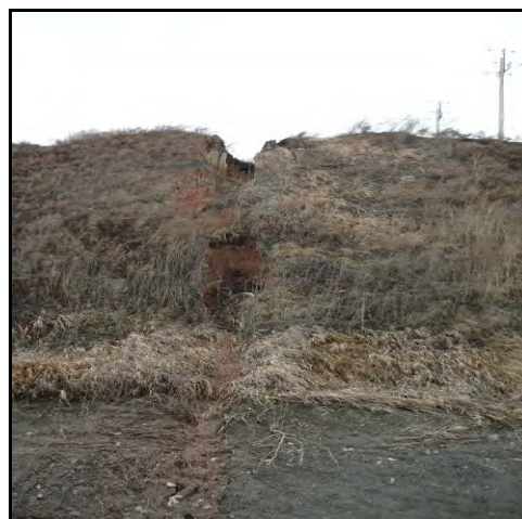
Рис.2. Эрозионные промоины на придорожном склоне Северного шоссе, г. Красноярск (ОАО «Красноярскгидрогеология»)
