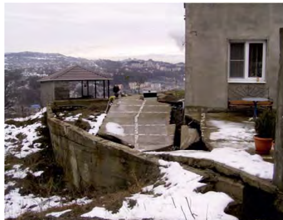
Рис.6. Формирование новых оползневых уступов в районе с. Барановка (ГУП «Кубаньгеология»)
