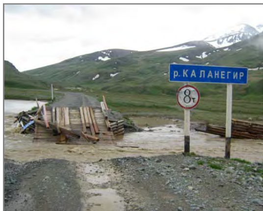
Рис.25. Разрушенный мост через р. Каланегир на автодороге Кош-Агач – Джазатор, Республика Алтай (ТЦ «Алтайгеомониторинг»)
