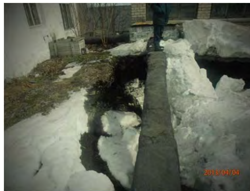
Рис.3. Провал на территории промпредприятия в г. Артемовский, Свердловская область (РЦ ГМСН по Уральскому федеральному округу)
