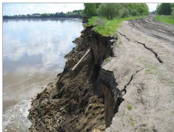
Рис.16. Разрушение автодороги Зырянское- Причулымск, Томская область (ОАО «Томскгеомониторинг»)
