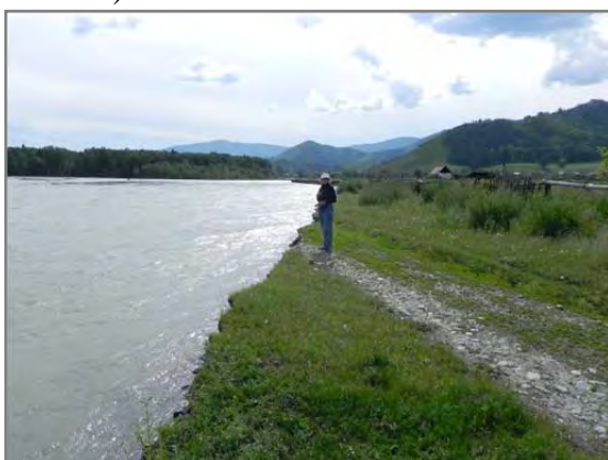
Рис.19. Разрушение берега и размыв дороги на уч. Березовка, Республика Алтай (ТЦ «Алтайгеомониторинг»)
