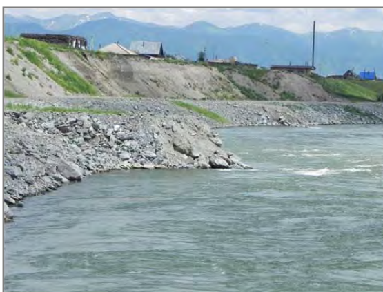
Рис.21. Размыв волноотбойника в центральной части дамбы, уч. Усть-Кокса, Республика Алтай (ТЦ «Алтайгеомониторинг»)
