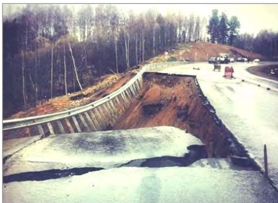
Рис.14. Разрушение дорожного полотна в результате активизации оползневого процесса на федеральной автодороге М-55 «Байкал», Республика Бурятия (интернет-источник)
