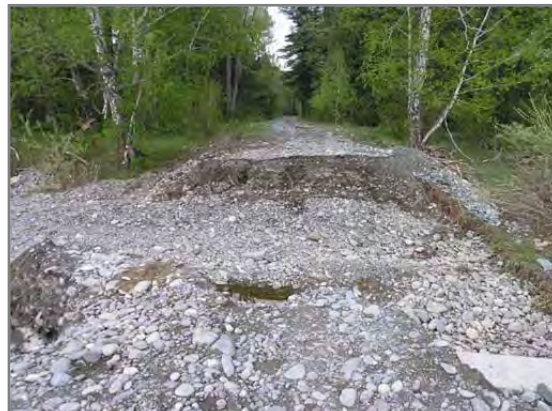
Рис.24. Проран на участке автодороги к Катанакскому мосту, Республика Алтай (ТЦ «Алтайгеомониторинг»)
