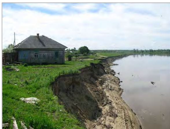
Рис.17. Разрушение берегового склона в с. Комсомольск, Томская область (ОАО «Томскгеомониторинг»)
