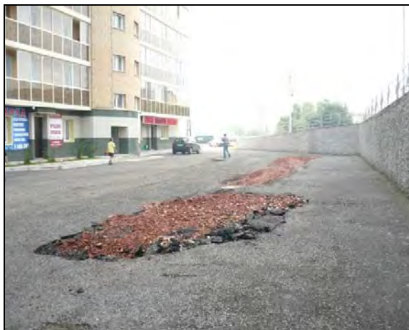
Рис.22. Ликвидированный провал по ул. Академика Киренского, г. Красноярск (ТЦ ГМСН по Красноярскому краю)
