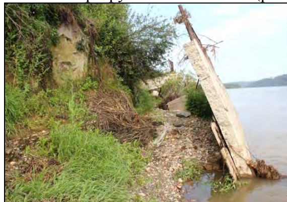
Рис.8. Разрушение подпорной стенки на берегу р. Томь в с. Боровково, Кемеровская область (ТЦ ГМСН по Кемеровской области)
