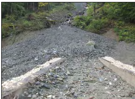
Рис.11. Селевые отложения, заполнившие селепропускные лотки над 2-й противоселелавиннозащитной галереей технологической автодороги ОАО «ФСК ЕЭС» к подстанции «Мзымта» (ЮРЦ ГМСН)
