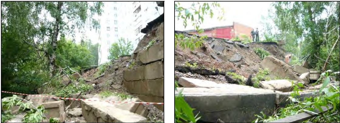
Рис.21. Обрушение подпорной стены автопарковки в г. Красноярск (ТЦ ГМСН по Красноярскому краю)
