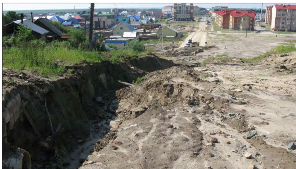
Рис.17. Овраг, образовавшийся по ул. Ледовая на территории горнолыжного курорта «Хвойный Урман» (ТЦ ГМСН по Ханты-Мансийскому автономному округу)
