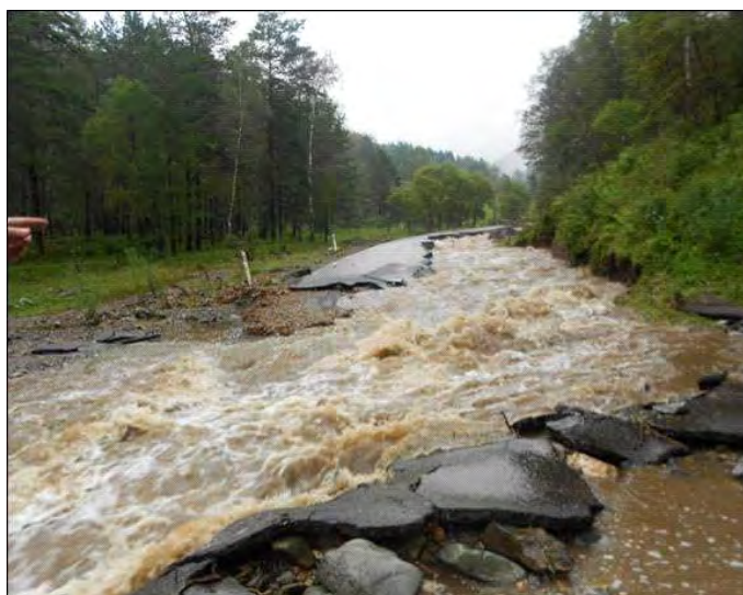
Рис.20. Размыв дорожного полотна на трассе Муны – Карым, Республика Алтай (МЧС по Республике Алтай)
