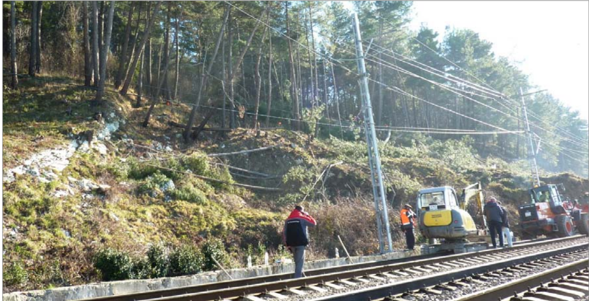
Рис.4. Оползень на участке железной дороги Туапсе – Сочи (ГУП «Кубаньгеология»)
