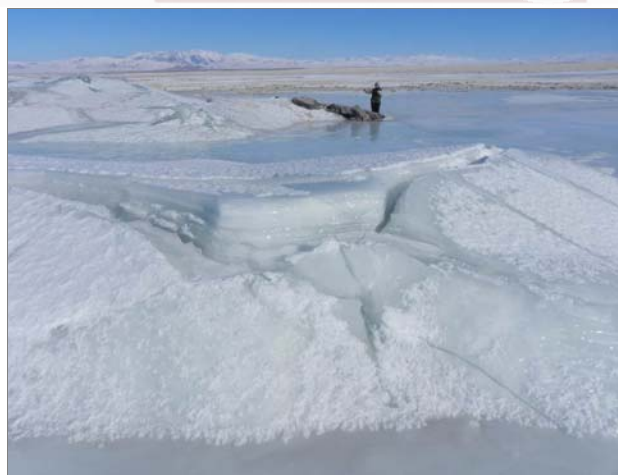
Рис.6. Наледный бугор, разбитый трещинами (на заднем плане – укрепления по бровке дороги, ведущей к свалке ТБО с. Тобелер), Республика Алтай (ТЦ «Алтайгеомониторинг»)
