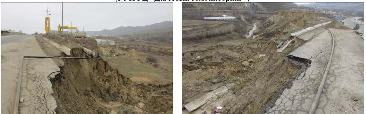
Рис.2. Фрагменты разрушенных линии водопровода и обочины автодороги (ГУП РЦ «Дагестангеомониторинг»)
