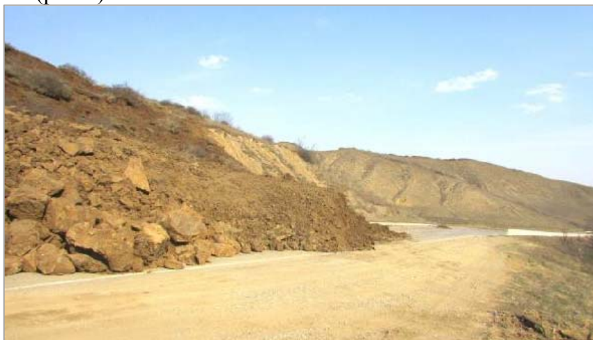
Рис.3. Перекрытие оползнем участка автодороги (ГУП РЦ «Дагестангеомониторинг»)
