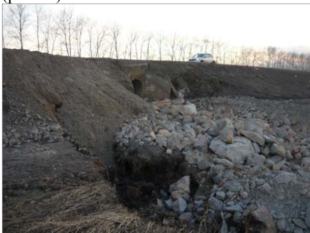
Рис.13. Разрушение основания полотна дороги Красноярск – Элита, Красноярский край (ТЦ ГМСН по Красноярскому краю)
