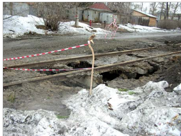
Рис.11. Промоина под железнодорожным полотном на участке схода антропогенного оползня, г. Барнаул (Алтайский ТЦ ГМСН)
