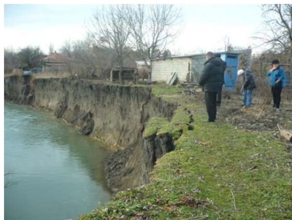
Рис.11. Разрушение приусадебного участка по ул. Трудовая, 14 (ГУП «Кубаньгеология»)
