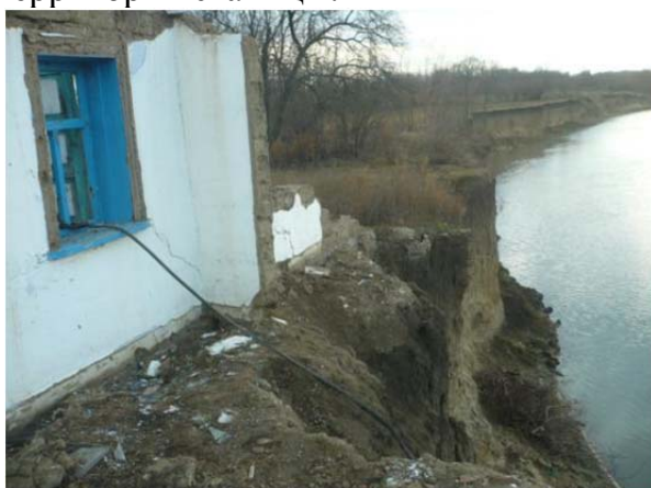
Рис.10. Жилой дом по ул. Луначарского, 1, разрушенный в 2014 г. (ГУП «Кубаньгеология»)
