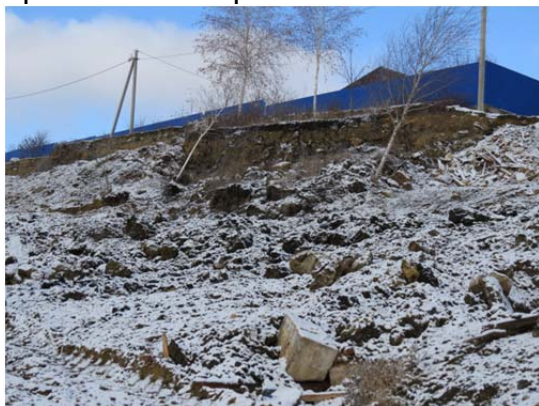
Рис.1. Стенка отрыва в головной части оползня № 175 (ТЦ ГМСН по Ставропольскому краю)
