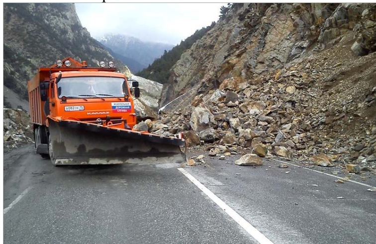
Рис.1. Участок Транскавказской автомагистрали, перекрытый обвальными массами (ГУ МЧС России по РСО–А).
