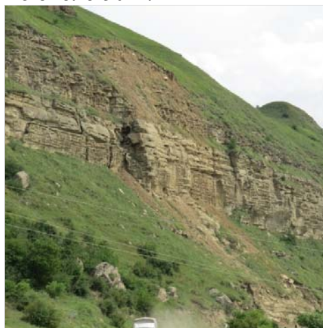
Рис.41. Активный оползневой массив в верховом откосе автодороги Сары-Тюз – Каменноостский (Южный РЦ ГМСН)
