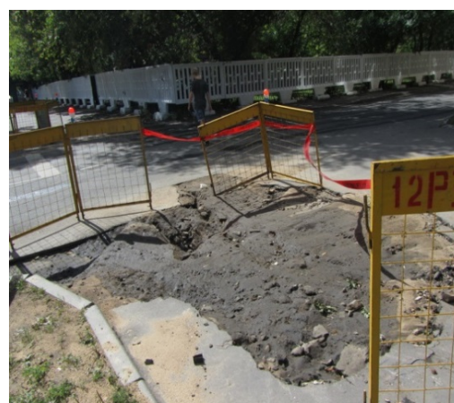
Рис.5. Провалы грунта около д. 7 по ул. Куусинена, г. Москва (ТЦ ГМСН по г. Москве)
