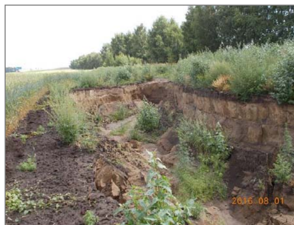
Рис.25. Вершина отвершка «левого» оврага на участке автодороги М-54, 242 км, Красноярский край (ТЦ ГМСН по Красноярскому краю)
