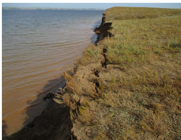
Рис.9. Разрушение берега на участке Быковский (Южный РЦ ГМСН)
