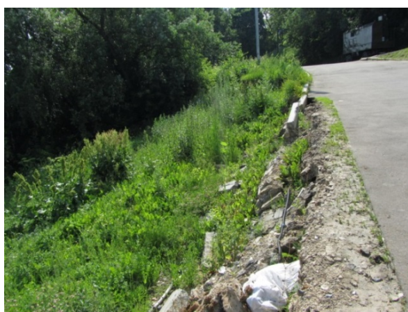
Рис.4. Участок разрушения полотна автодороги на склоне Воробьевых гор вблизи смотровой площадки, г. Москва (ТЦ ГМСН по г. Москве)
