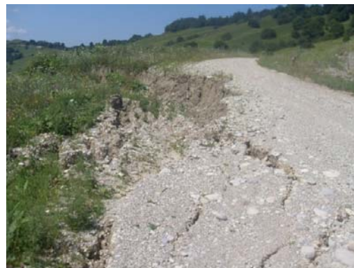
Рис.37. Деформированный в результате активизации оползневого процесса участок автодороги с. Даттых – с. Галашки (ТЦ ГМСН по Республике Ингушетия)
