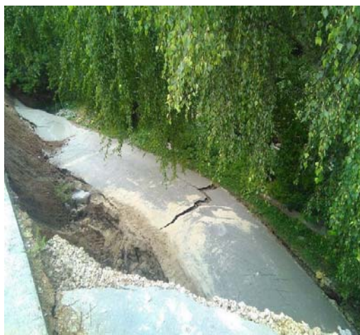
Рис.45. Разрушенный участок автодороги, пролегающей по бровке склона оврага, г. Н. Новгород (ТЦ ГМСН по Нижегородской области)
