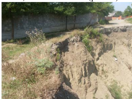
Рис.36. Деформированный в результате активизации оползневого процесса участок дороги в с. Галашки (ТЦ ГМСН по Республике Ингушетия)
