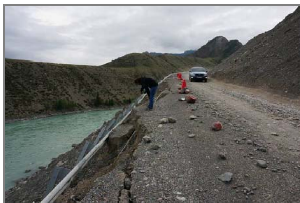
Рис.20. Разрушенный участок автодороги в Инегень в результате активизации оползневой эрозии, Республика Алтай (ТЦ ГМСН по Республике Алтай)
