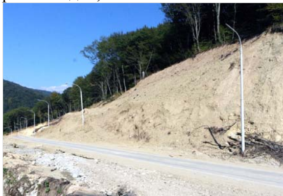
Рис.38. Оползень на откосе автодороги Голубые Озера – Верхние Голубые Озера (ТЦ ГМСН по Кабардино-Балкарской Республике)
