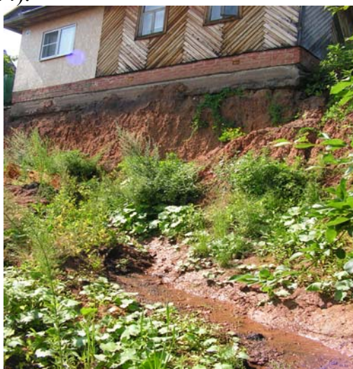
Рис.44. Разгрузка грунтовых вод в стенке отрыва оползня под домом № 47 по ул. Набережной, д. Докша, Завьяловский район, Удмуртская Республика (ТЦ ГМСН по Удмуртской Республике)
