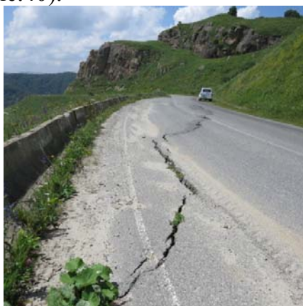
Рис.39. Участок автодороги Кисловодск – Карачаевск, деформированный оползнем (Южный РЦ ГМСН)
