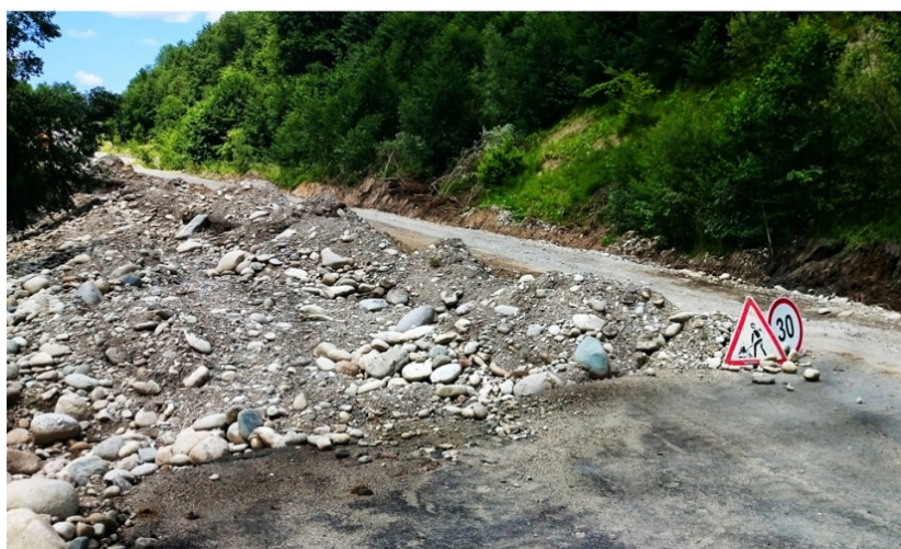
Рис.42. Участок активизации оползневого процесса на автодороге Чикола – Мацута, 14 км (правый борт р. Арсаки-Дон) (ТЦ ГМСН по Республике Северная Осетия – Алания)
