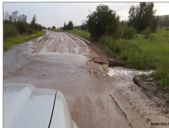
Рис.22. Разрушенный участок дорожного полотна автодороги Хандагайты – Мугур-Аксы, Республика Тыва (ТЦ ГМСН по Республике Тыва)
