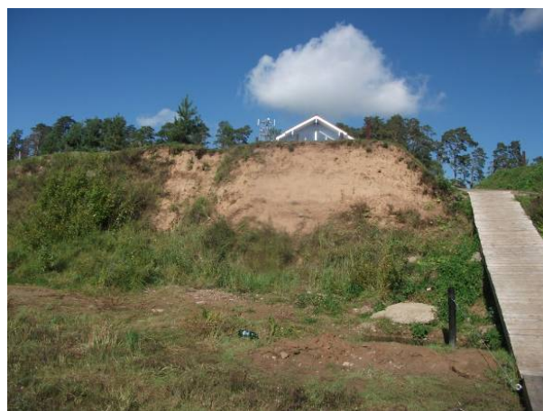
Рис.8. Участок активизации оползневого процесса на спуске к р. Волге в районе ресторана «Пристань», д. Демино, Ярославская область (ТЦ ГМСН по Ярославской области)
