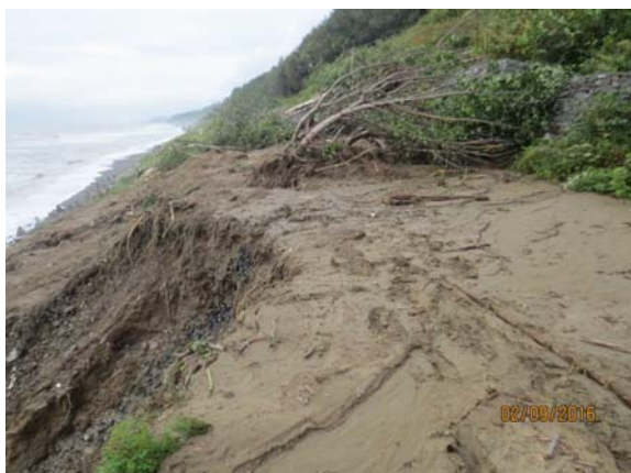
Рис.50. Оползневые массы, перекрывшие участок железной дороги Южно-Сахалинск – Ноглики, 262-265 км (ТЦ ГМСН по Сахалинской области)
