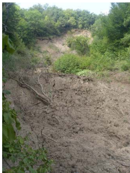
Рис.43. Участок автодороги с. Шена – с. Саясан (50 м), деформированный оползнем (ТЦ ГМСН по Чеченской Республике)
