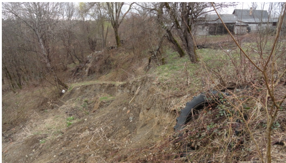
Рис. 3 Активизация оползневого процесса на участке древне-оползневого склона вдоль ул. Комсомольской (ООО «НИЦ Кубаньгеология»)
