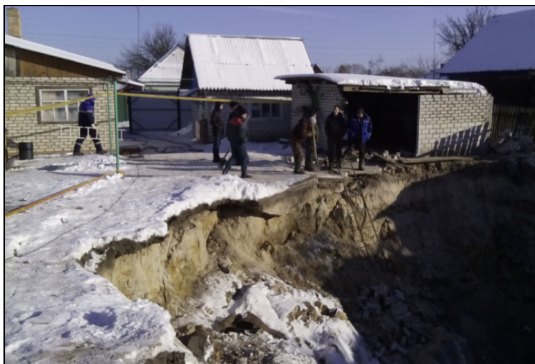
Рис. 1 Карстово-суффозионный провал на территории частного домовладения по ул. Щерса 24, в п. Вышкове Злынковского района Брянской области (ТЦ ГМСН по Брянской области).
