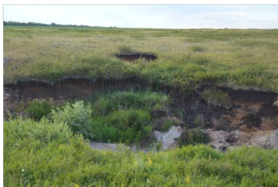
Рис. 64. Основная воронка и новый провал (на заднем плане) в тальвеге оврага Большой Лог на Янгельском участке, г. Магнитогорск, Челябинская область
