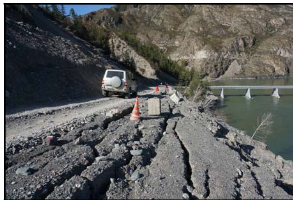
Рис.81. Участок дороги в с. Инегень. Левый фланг фронтального оползня (сентябрь 2017 г.), Республика Алтай
