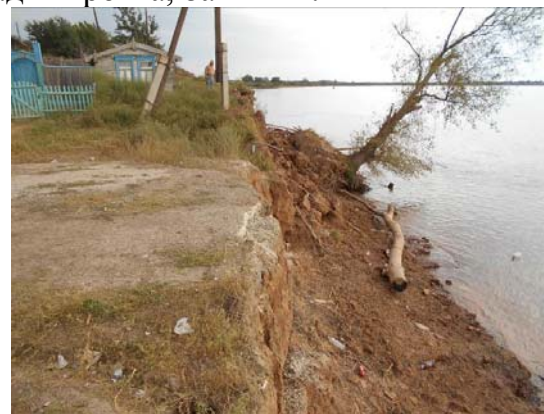
Рис. 32. Участок активизации оползневого процесса в с. Сергиевка
