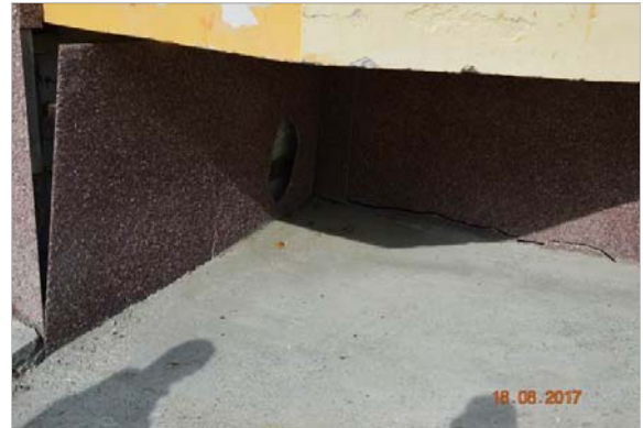
Рис. 72. Разрушение декоративных панелей дома на бульваре Стрижова, 1, г. Надым
