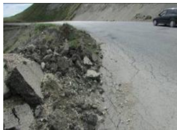
Рис. 101. Деформированный участок автодороги Леваша – Хаджалмахи, в 5,050 км западнее с. Леваша
