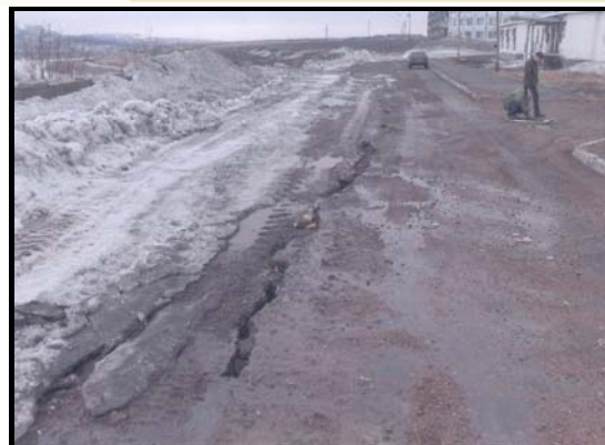
Рис.12. Трещины в асфальтовом покрытии Шахтерской набережной (24.04.2007 г.)
