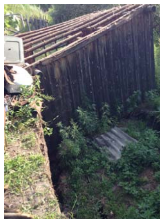
Рис. 61. Хозяйственная постройка, которая обрушилась в результате деформации участка дороги
