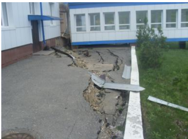
Рис. 107. Разрушенный в результате активизации оползневого процесса переход между корпусами детского реабилитационного центра с. Ножай-Юрт
