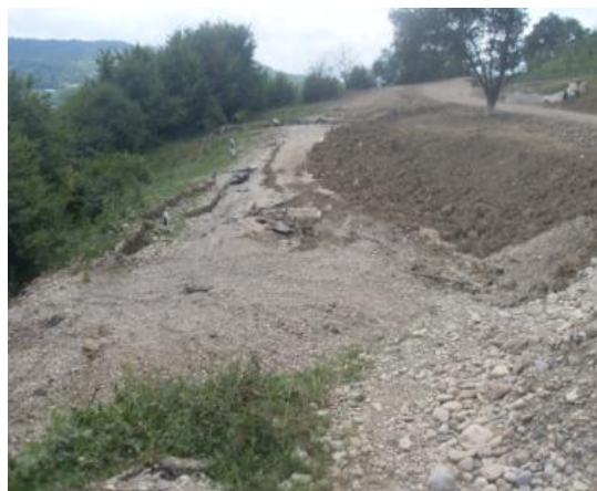
Рис.108. Разрушенная оползнем дорога перед Реабилитационным центром (120 м) с. Ножай-Юрт
