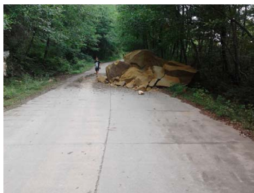
Рис. 28. Обвал на участке автодороги Нижняя Шиловка – Ахштырь
