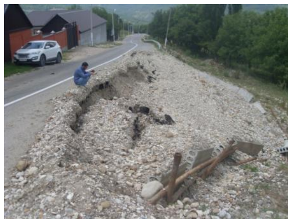
Рис.112. Деформированный оползнем участок дороги (35 м), с .Саясан
