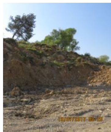
Рис. 43. Активный оползневой массив в верховом откосе автодороги Черкесск – Домбай (Красногорский участок)
