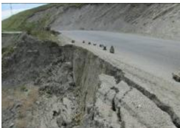
Рис. 100. Деформированный участок автодороги Леваша – Хаджалмахи, в 5 км западнее с. Леваша
