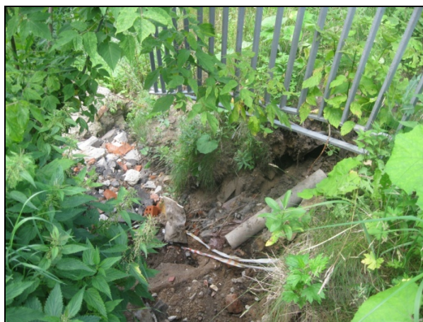
Рис. 1. Промоина на оползневом блоке вдоль деформированного забора, ул. Винницкая, д. 27А, г. Москва
