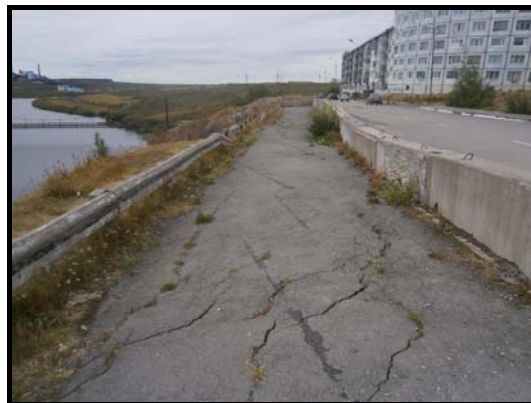
Рис.17. Трещины на автодороге и пешеходной дорожке на ул. Шахтерская набережная
