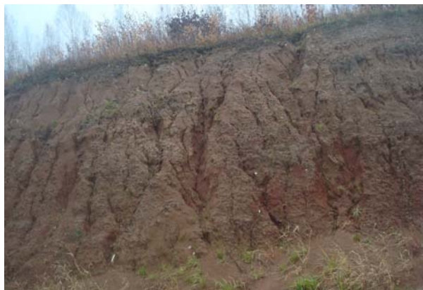
Рис.95. Участок развития плоскостной эрозии на придорожном склоне автодороги "Уссури", 116 км, Хабаровский край
