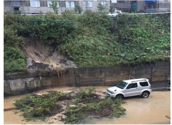
Рис.98. Отложения приповерхностного оползня-сплыва во дворе многоквартирного жилого дома по ул. Первомайской в г. Холмске
