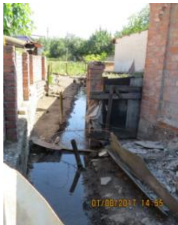
Рис. 48. Высачивание грунтовых вод в районе домовладений по ул. Пионерская в п. Эркин-Шахар
