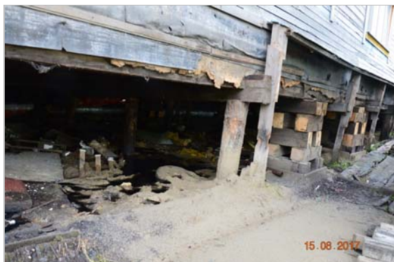
Рис. 67. Образование техногенного водоема на участке старой застройки по ул. Чапаева ба, г. Салехард
