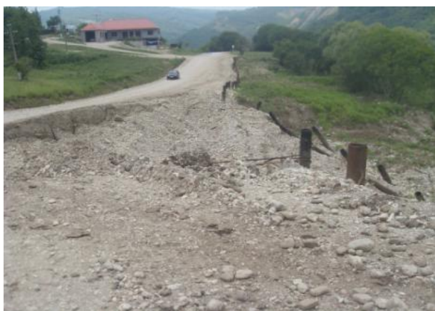
Рис. 109. Деформированный оползнем участок дороги (30 м), с. Саясан
