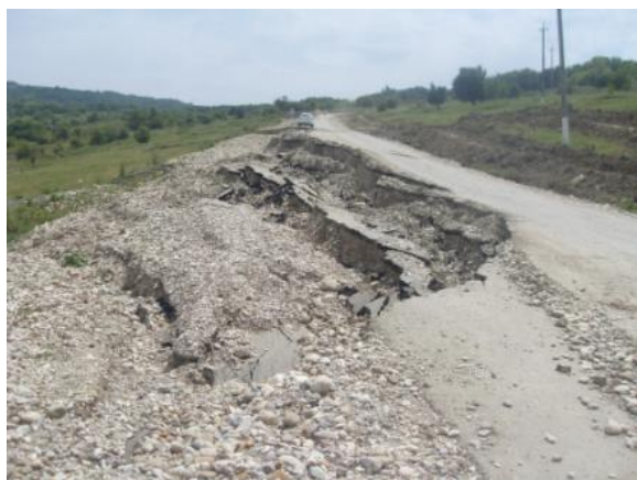
Рис. 111. Деформированный оползнем участок дороги (80 м), с .Саясан
