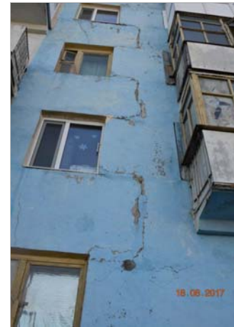
Рис. 70. Смещение блоков дома по ул. Полярная, 19, г. Надым
