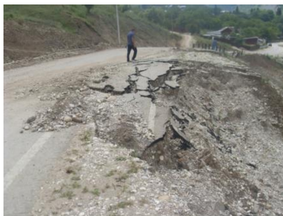
Рис. 110. Деформированный оползнем участок дороги (70 м), с. Саясан
