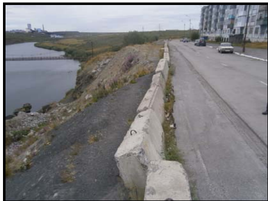
Рис.16. Смещенные железобетонные блоки в центральной части оползня
