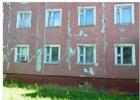
Рис. 74. Разрушение панелей первого этажа административного здания, г. Надым
