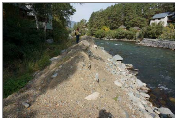
Рис. 80. Участок разрушения дамб обвалования по левому берегу на уч. Чемал (на противоположном берегу – габионы т/б «Марьин остров»), Республика Алтай
