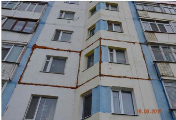
Рис. 71. Запеченные стыки панелей дома № 34 по ул. наб. Оруджева, г. Надым
