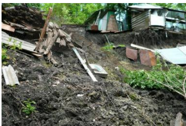
Рис. 49. Деформация оползнем хозяйственных построек, Ташлянский участок, г. Ставрополь
