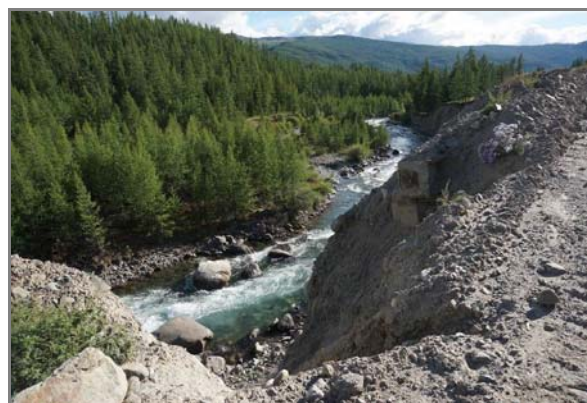
Рис. 79. Размытый участок полотна с разрушением креплений на 101,1-101,4 км автодороги Кош-Агач – Джазатор, Республика Алтай
