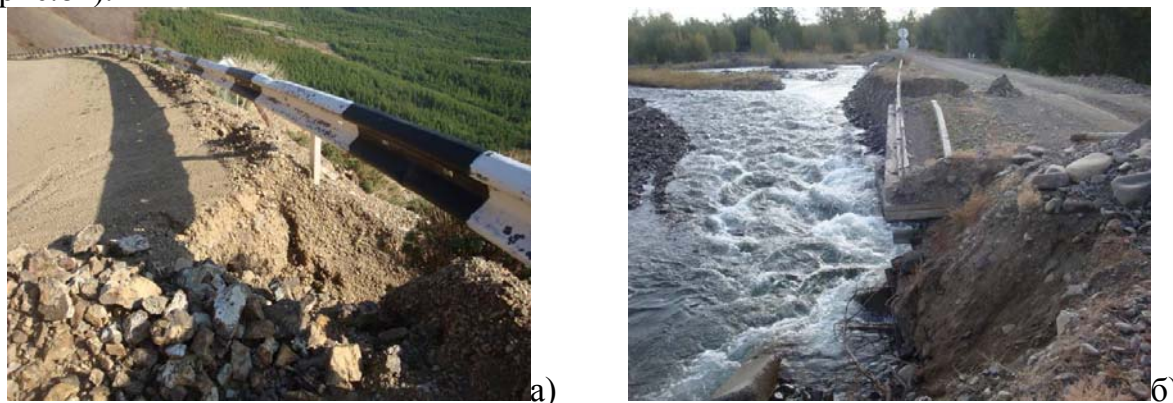
Рис.82. Участки активизации гравитационно-эрозионных процессов на автодороге Хандагайты – Чыраа-Бажы: а) промоина на участке дороги через перевал, б) подмытый мост через р. Торгалык у с. Дус-Даг, Республика Тыва
