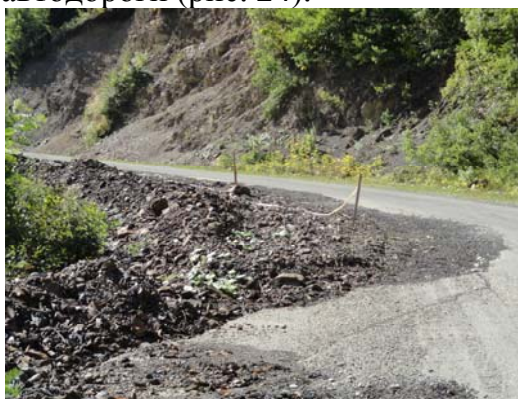
Рис. 24. Участок деформации дорожного полотна автодороги п. Гузерипль – ур. Лаго-Наки в результате активизации оползневого процесса
