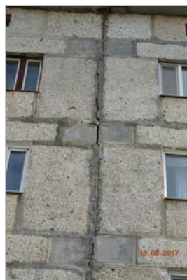
Рис. 73. Деформации дома № 10 по ул. Рыжкова (раскрытие температурно-деформационного шва здания), г. Надым
