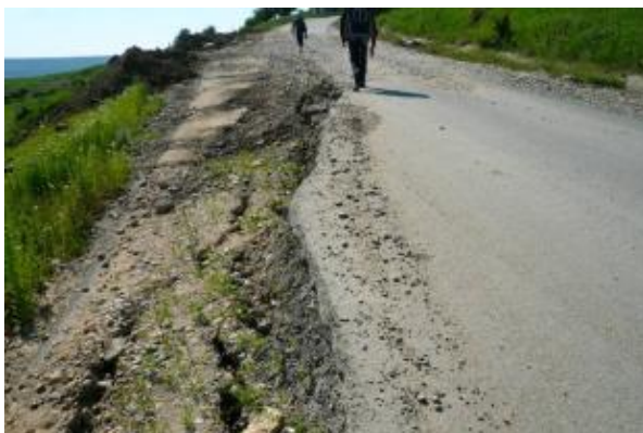
Рис.51. Деформированные оползнем участок автодороги (70 м), Татарский участок
