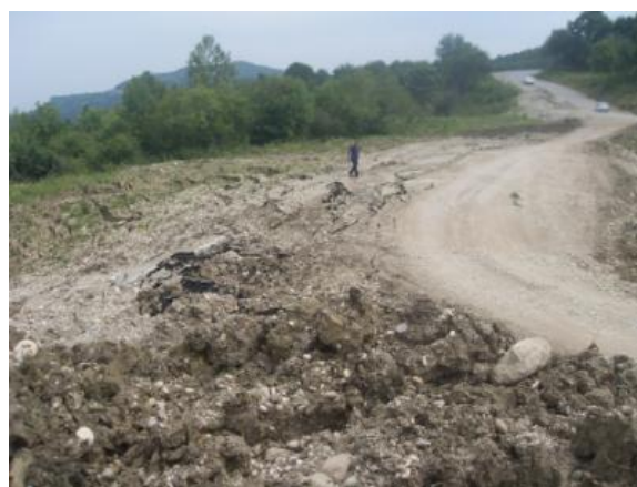
Рис.114. Деформированный оползнем участок дороги (175 м), с. Айти-Мокх – с.Саясан, 2,02 км
