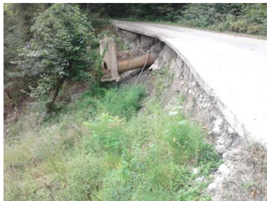
Рис.26. Участок активизации оползневой процесса на автодороге Нижняя Шиловка – Ахштырь, Адлерский район г. Сочи
