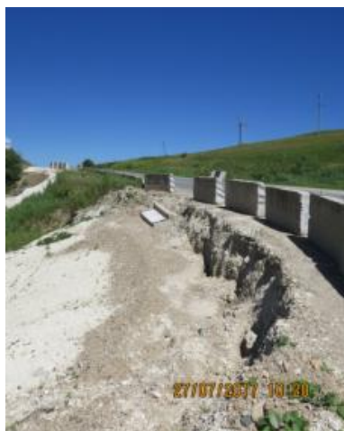
Рис. 44. Участок активизации оползневой процесса в низовом откосе автодороги Кисловодск – Усть-Джегута
