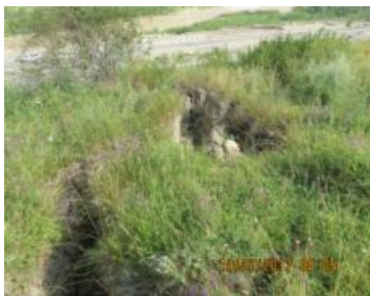
Рис. 42. Трещины отрыва в верховом откосе автодороги Черкесск – Домбай (Красногорский участок)
