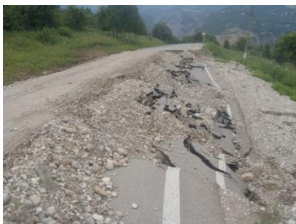
Рис.113. Деформированный оползнем участок дороги (140 м), с. Айти-Мокх – с.Саясан, 1,87 км
