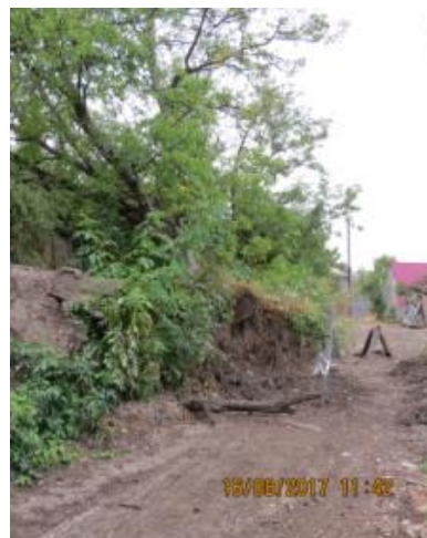
Рис.52. Языковая часть оползня, перекрывшая участок автодороги (50 м), г. Пятигорск
