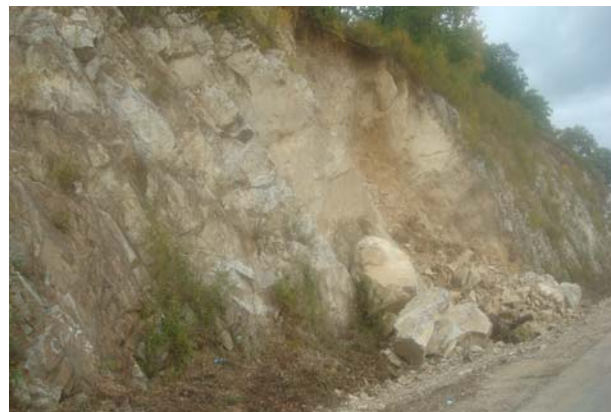
Рис.96. Осыпные проявления на придорожном склоне автодороги Лидога – Ванино, 128 км, Хабаровский край
