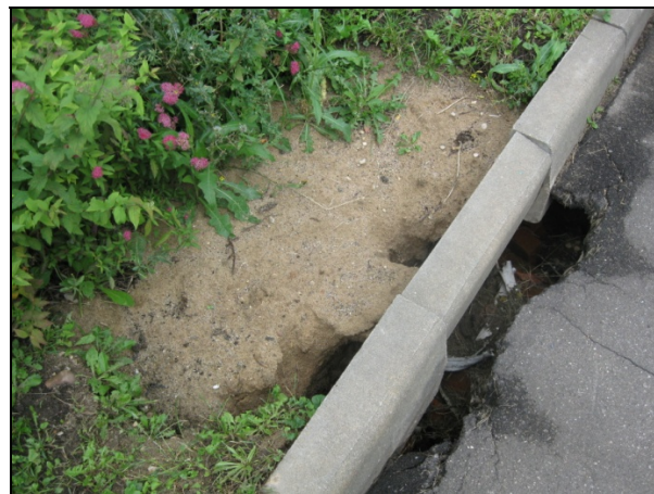
Рис. 2. Суффозионный провал на территории дошкольного отделения школы № 2017, г. Москва
