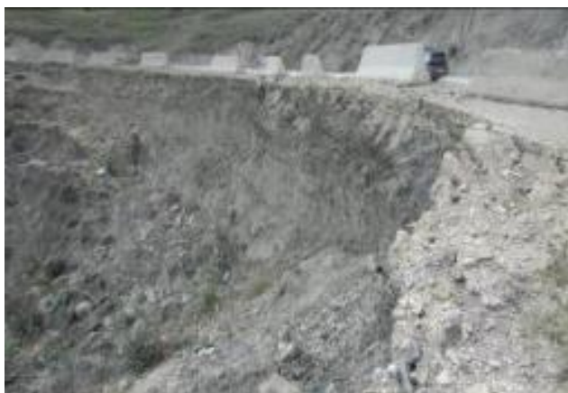
Рис. 102. Деформированный участок автодороги Леваша – Хаджалмахи, в 5,650 км западнее с. Леваша
