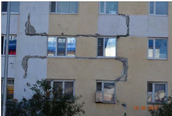
Рис. 69. Трещины между блоками здания по ул. Полярная, 9, г. Надым
