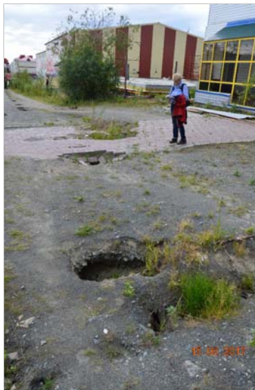
Рис. 66. Суффозионные провалы на перекрестке ул. Чупрова – ул. Маяковского, г. Салехард
