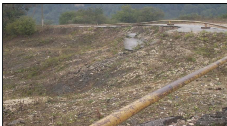
Рис. 27 Деформированный оползнем газопровод на интервале 40 м. с. Беной.
