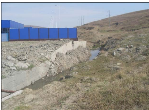
Рис. 22 Деформированная оползнем бетонная берегозащитная стенка за заводом Минеральных вод. Сунженский участок. Республика Ингушетия
