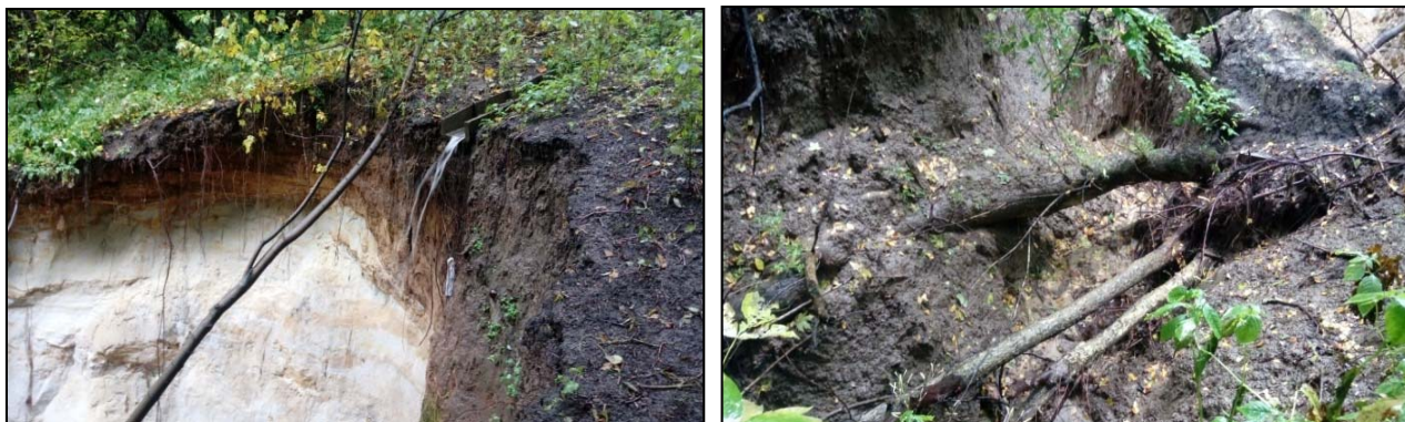
Рис. 8 Оползень на склоне вдоль 1-ой улицы Дьякова Городища, г. Москва
