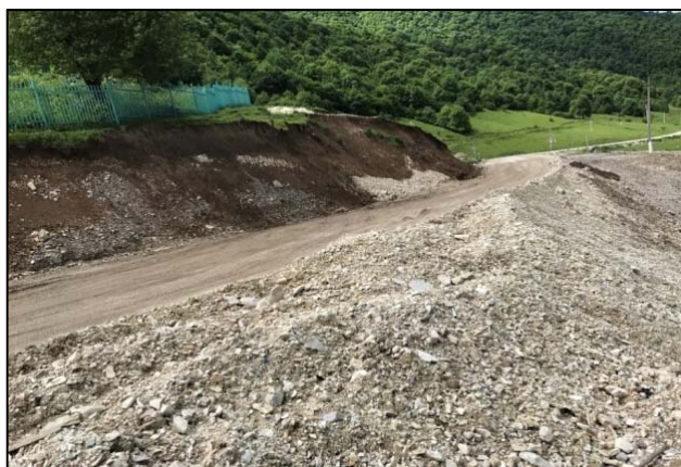
Рис. 29 Деформированное оползнем полотно автодороги с. Харачой – с. Ведено на интервале 100м.
