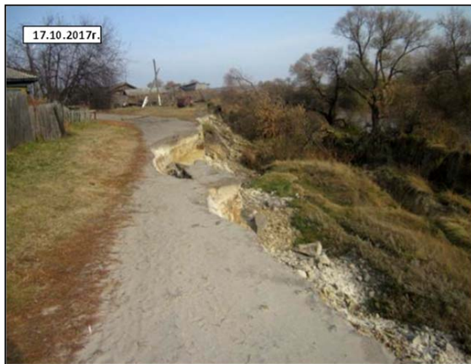
Рис. 36 Деформированный участок дороги (д. Старая Шадрина, ул. Береговая). Тюменская область
