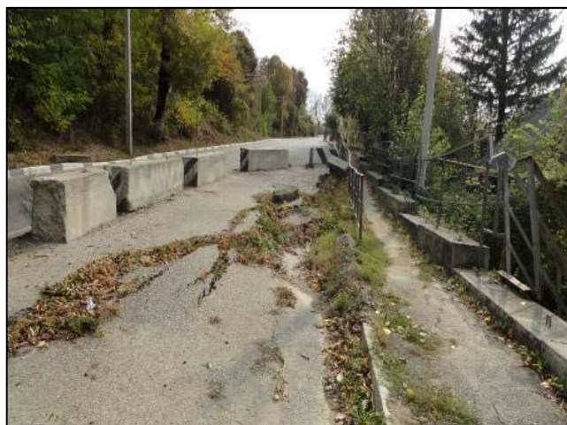
Рис. 15 Деформированная автодорога на восточной окраине г. Хадыженск. Краснодарский край
