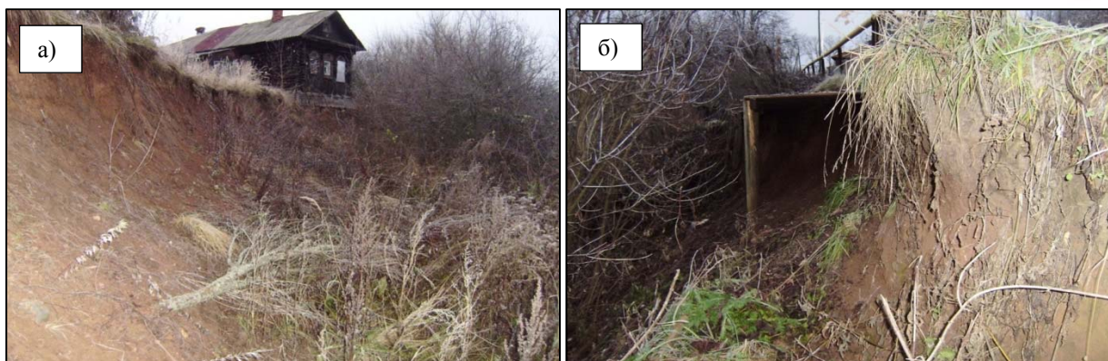
Рис. 7 Стенка срыва оползня: а) Углубление стенки срыва оползня под заброшенное строение; б) Углубление стенки срыва оползня под газопровод, – ул. Подгорная в п. Новописцово Вичугского района Ивановской области
