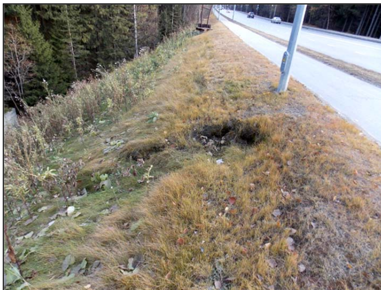
Рис. 38 Размытый дорожный откос по ул. Мира (вид слева, если ехать в Аэропорт)
