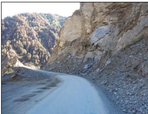
Рис. 19 Опасный обвально-осыпной склон в верховом откосе автодороги «Буйнакс-Гимры-Чирката» Унцукульский район. Республика Дагестан
