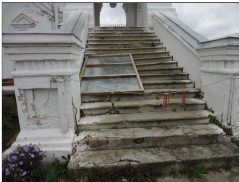
Рис. 9 Трещины в ступенях церкви «Воскресенье Славущего» в с. Исады Спасского района Рязанской области
