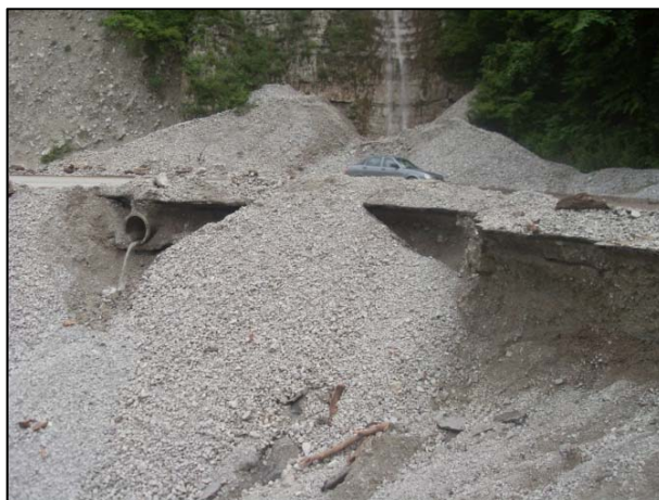
Рис. 30 Обвально-осыпные массы, перекрывшие полотно автодороги с. Зоны – с. Шатой (4,35 км) на интервале 40 м.
