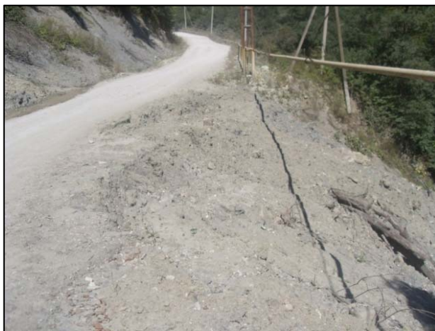
Рис. 25 Деформированное оползнем полотно автодороги с. Нижний Дай – с. Нохчи-Келой (1,47км).
