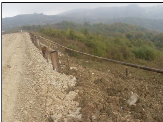
Рис. 28 Деформированный оползнем газопровод на интервале 50 м, низовой откос автодороги с. Зандак-Ара – с. Даттах.
