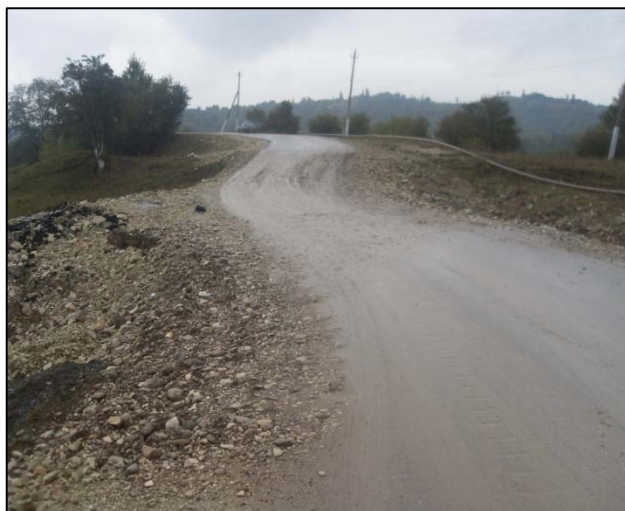
Рис. 26 Деформированное оползнем полотно автодороги на интервале 40 м. с. Беной.
