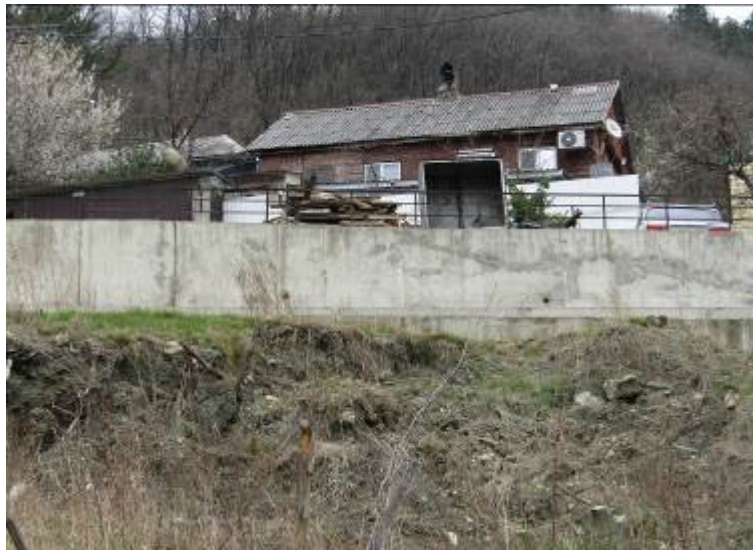
Рис.7 Головная часть оползневого очага. Выше расположена подпорная стенка. Краснодарский край.
