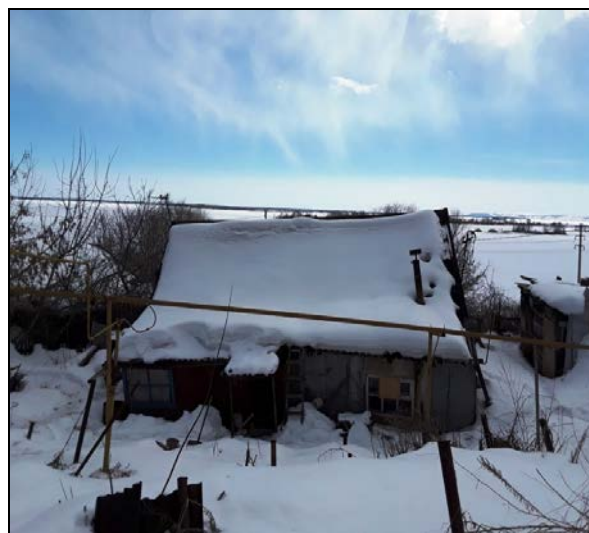
Рис. 18 Оползневой участок «г. Сызрань». Оседание восточной части дома №150. Самарская область.
