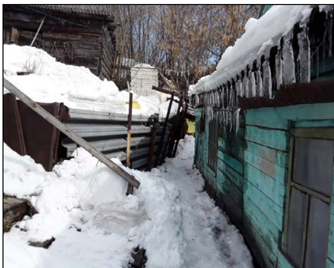
Рис. 17 Оползневой участок «г. Сызрань». Деформация подпорной стенки, расположенной выше дома №144. Самарская область.
