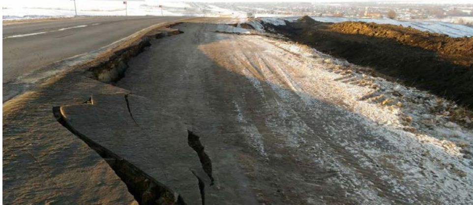
Рис. 16 Деформированный участок автодороги Нижний Новгород – Саратов (218 км), вследствие развития оползневой процесса. Починковский район Нижегородской области.
