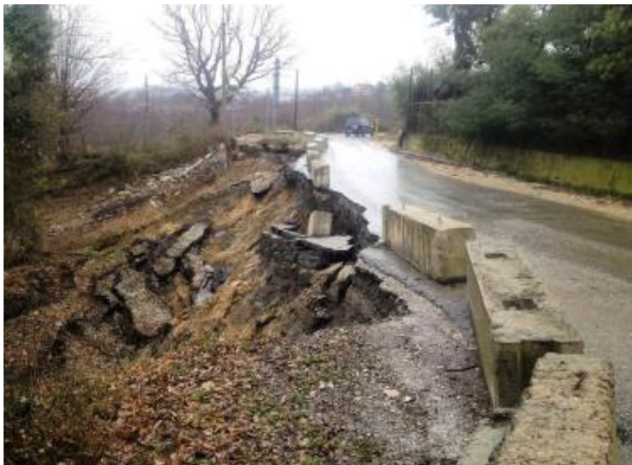
Рис. 4 Разрушенный оползнем участок автодороги. Краснодарский край.
