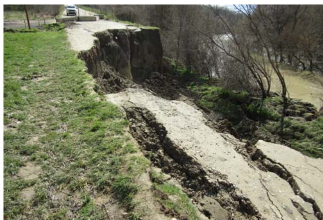
Рис. 2.5 Разрушенная оползнем автодорога в ст. Бакинская
