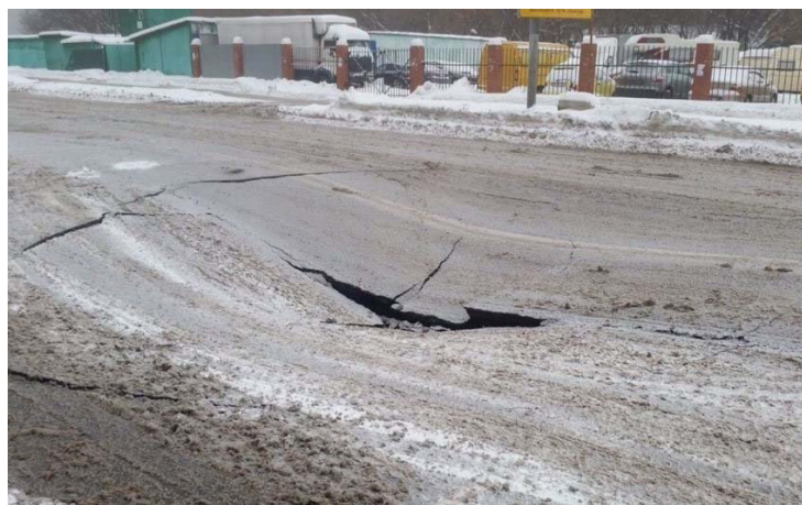
Рис. 2.2 Провал полотна автодороги на ул. Ферганская, стр. 2, в следствие суффозионного выноса мелких частиц грунта
