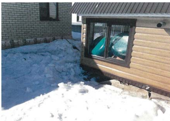
Рис. 2.9 Местоположение провала во дворе дома № 20 по ул. Бульвара Героев Труда, г. Уфа, Республика Башкортостан.
