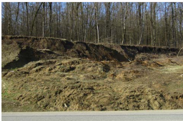
Рис. 2.3 Оползневой очаг в верховом откосе автодороги Краснооктябрьский – Гавердовский
