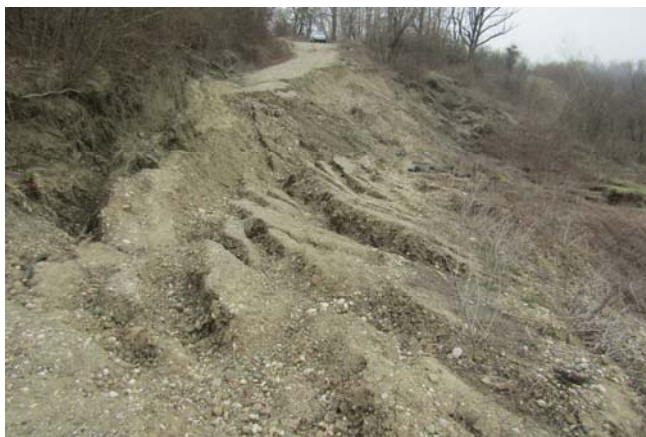
Рис. 2.7 Участок разрушенной оползнем автодороги в г. Апшеронск.
