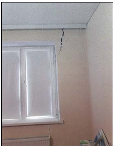
Рис. 2.10 Трещина внутри дома на западной стене. г. Уфа, Республика Башкортостан.
