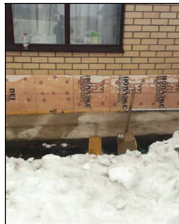
Рис. 2.11 Северная стена дома, под отмостками пустота 30-40 см. г. Уфа, Республика Башкортостан.
