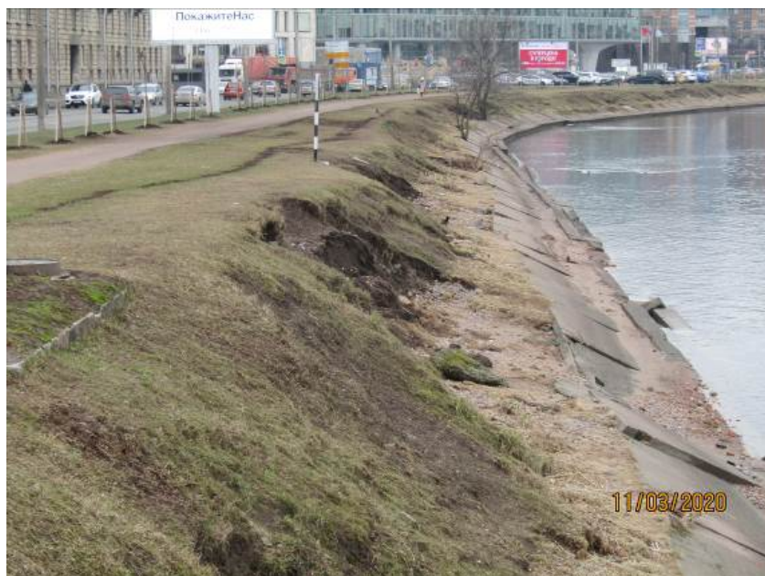
Фото 2. Проявление суффозионного процесса вблизи Большого Крестовского моста, г. Санкт-Петербург
