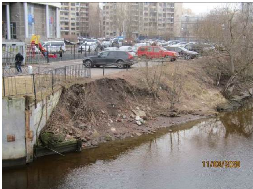
Фото 1. Проявление оползневой процесса вблизи ул. Беринга д. 27, г. Санкт-Петербург
