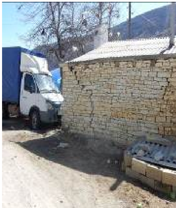
Фото 7. Деформированный оползнем дом, расположенный в западной части с. Бурца Хунзахского района Республики Дагестан
