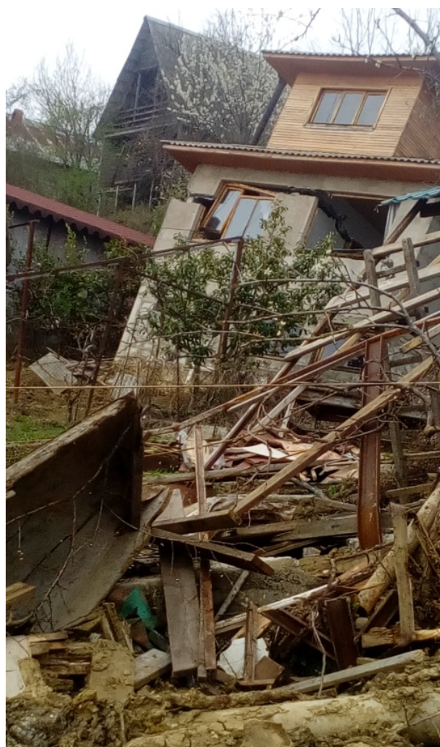
Фото 6. Разрушенное здание на теле оползня, образовавшегося в с. Галицыно Краснодарского края
