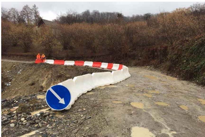
Фото 5. Разрушенный оползнем участок полотна автодороги на северной окраине с. Пластунка Краснодарского края
