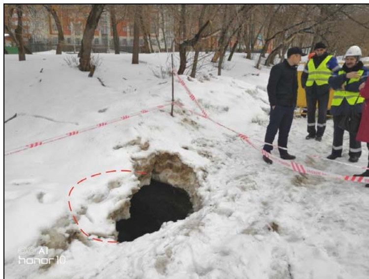
Фото 9. Карстовый провал у дома № 14 по ул. С.Перовской, г. Уфа, Республика Башкортостан
