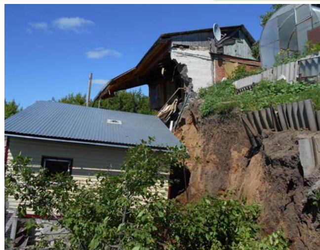
Фото 16.2020.0001. Разрушение домовладения в результате схода оползня по ул. Маринина, 53 в г. Чистополь, Республика Татарстан
