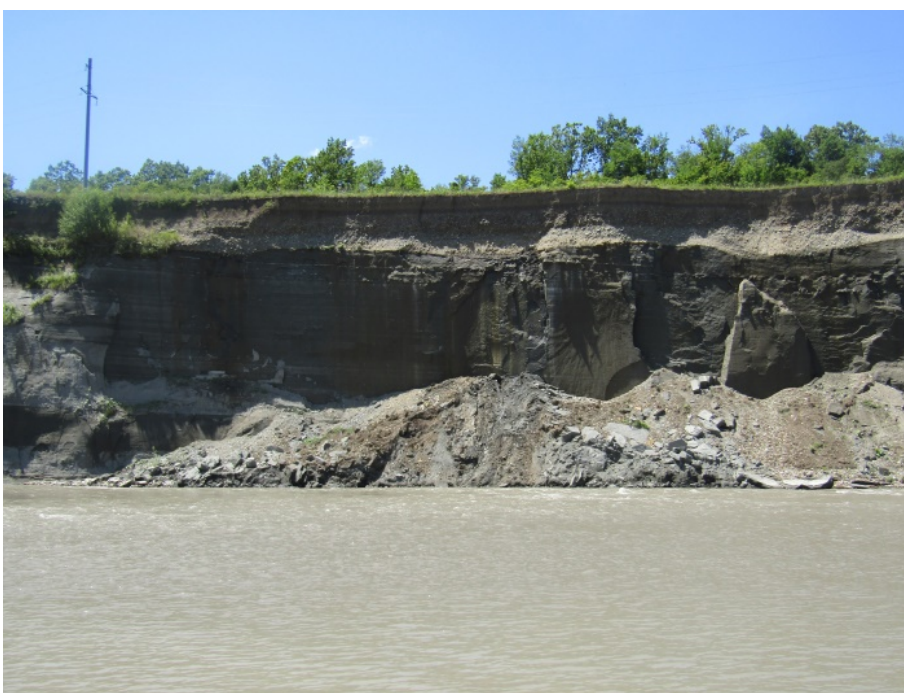
Фото 01.2020.0005. Эрозионно-обвальный отрезок уступа в пос. Совхозный, в 600 м к югу от автомобильного моста через р. Белую. В текущем квартале произошло обрушение одного из столбов ЛЭП. Майкопский район, Республика Адыгея.
