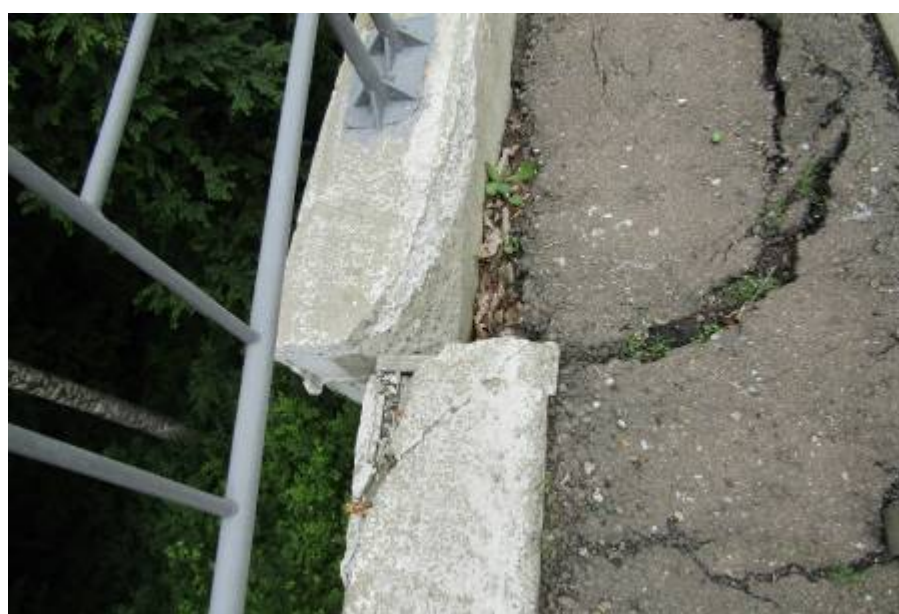
Фото 23.2020.0005. Деформация и частичное разрушение участка пешеходной дорожки вдоль автодороги Альпийское шоссе. г.Сочи, Адлерский район, Горная олимпийская деревня
