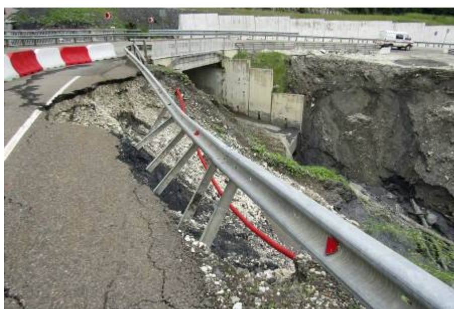
Фото 23.2020.0007. Разрушение участка автодороги Альпийское шоссе на правом берегу р.Черного. г.Сочи, Адлерский район, Горная олимпийская деревня
