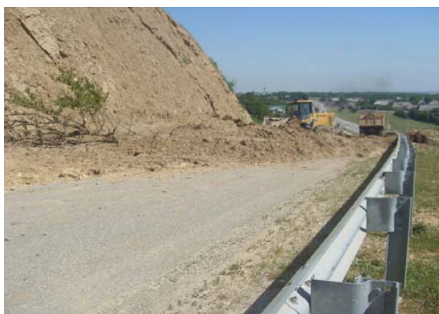
Фото 20.2020.0012. Оползневыми массами перекрыто полотно дороги с покрытием с.Пионерское-с.Чишки. Шатойский район, Чеченская Республика. (Фото ООО «Центр ГИДИС»).
