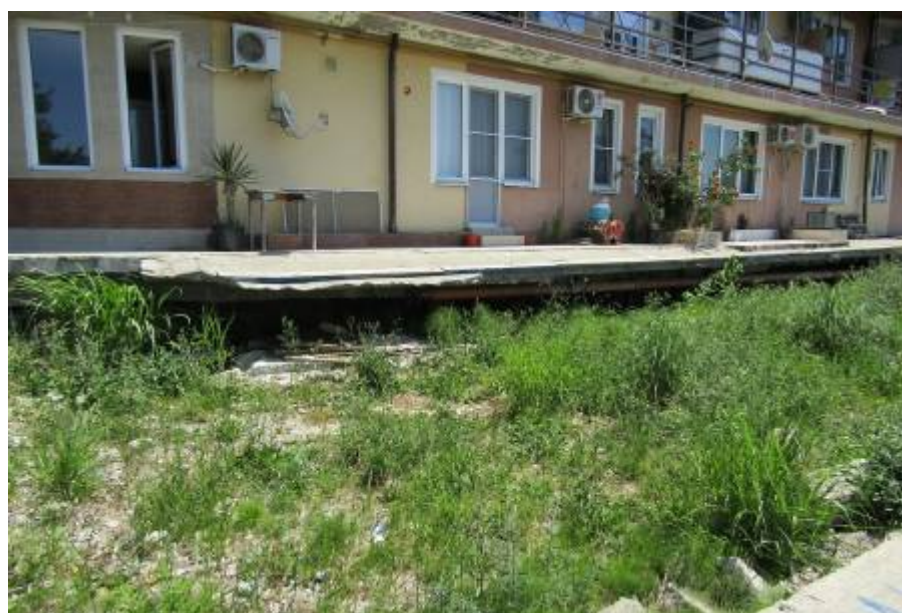
Фото 23.2020.0015 Активизировались оползневые процессы по ул. Шаумяна 18. Разрушение отмосток и парковочной зоны на территории многоэтажного дома г.Сочи, Хостинский район
