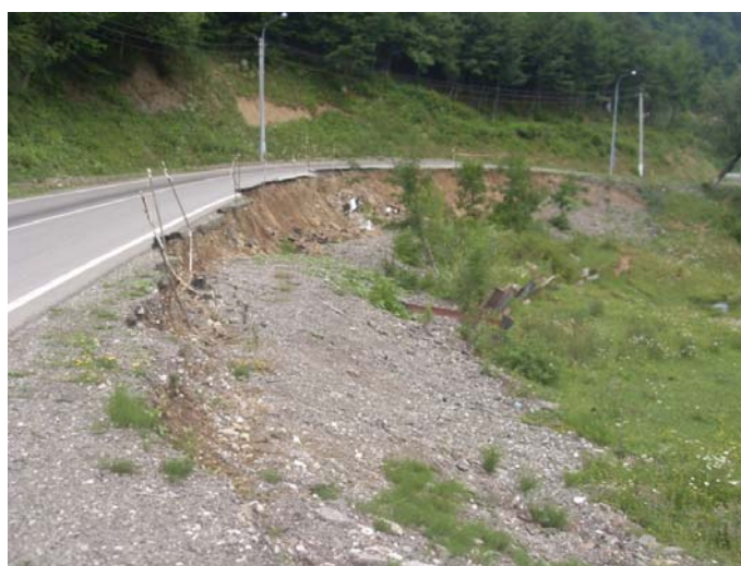
Фото 20.2020.0028. Деформация полотна автодороги с.Хаджи-Юрт-с. Марзой-Мохк вследствие активизации оползневого процесса в Веденском районе. Чеченская Республика. (Фото ООО «Центр ГИДИС»).
