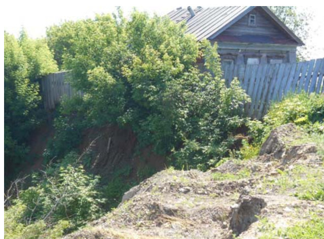
Фото 16.2020.0006. Деформации в результате схода оползня проседания по ул. Приволжская, 4. г. Тетюши, Республика Татарстан
