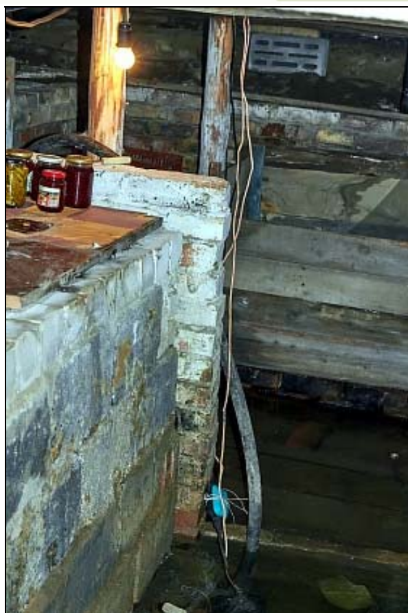
Фото 66.2020.0002. Подтопление в доме садового товарищества «Горняк» п. Медная Шахта, ГО Краснотурьинск, июнь 2020 г.
