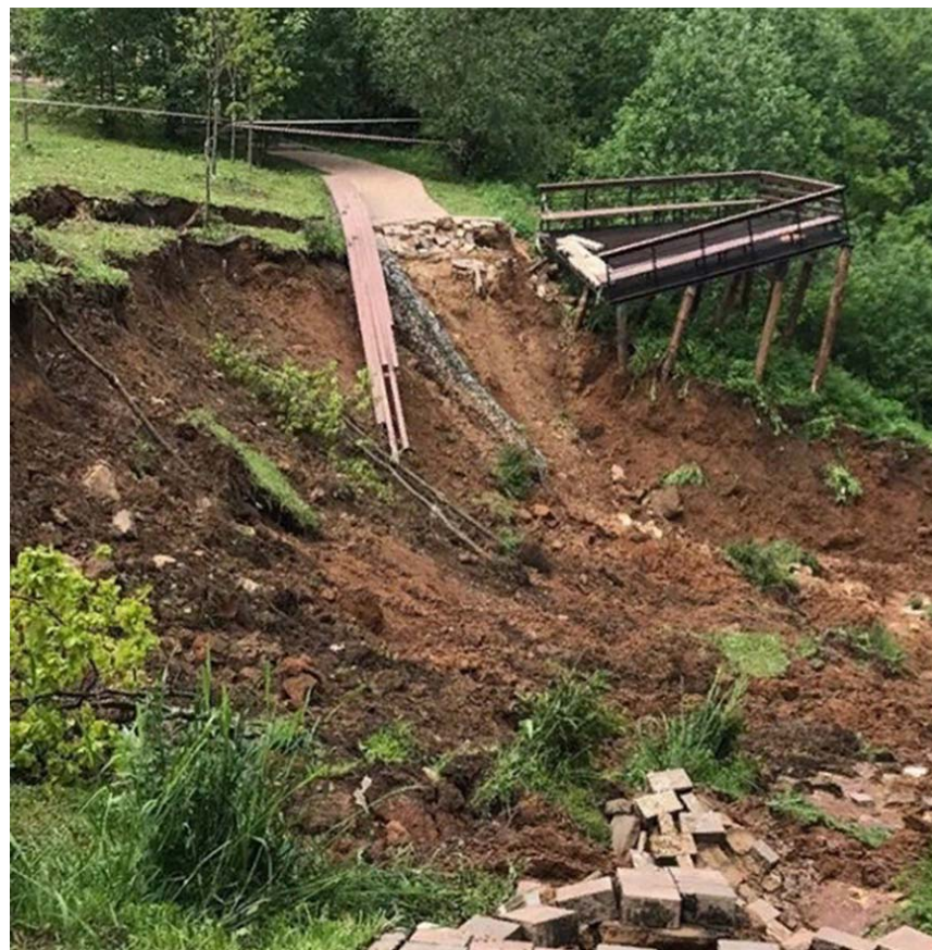
Фото 77.2020.0003 Оползень на территории природно-исторического парка «Тушинский», Пятницкое ш., д. 10-12, г. Москва
