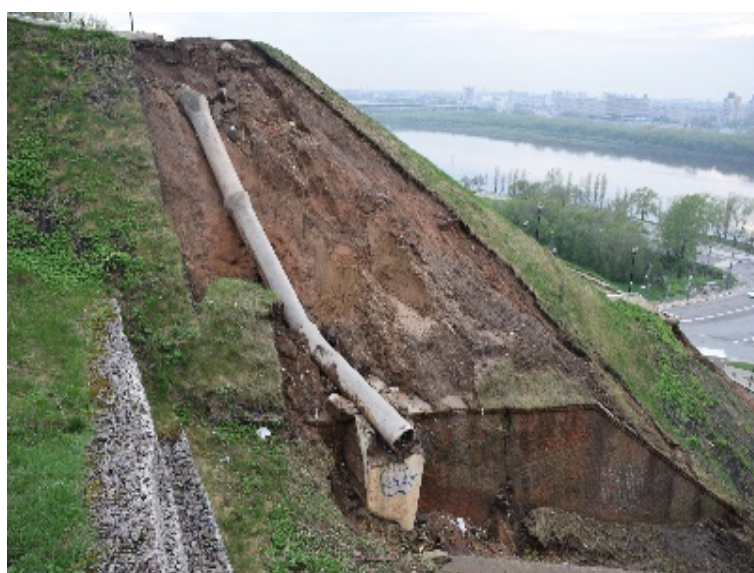
Фото 52.2020.0004. Оползневой процесс на набережной Федоровского, г. Нижний Новгород, Нижегородская область
