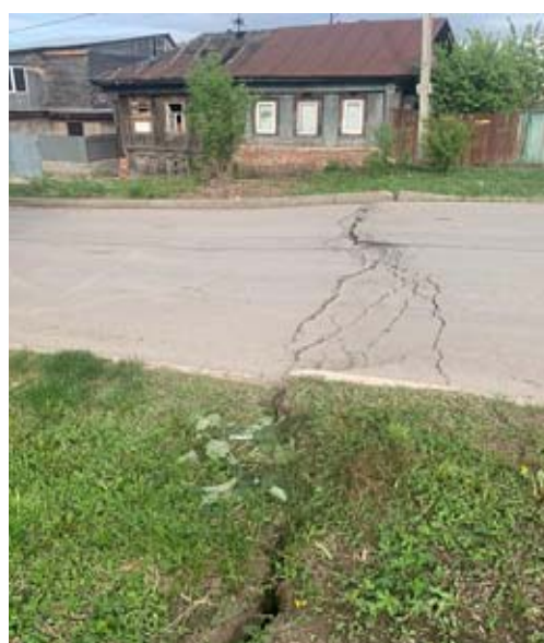
Фото 02.2020.0002. Трещины по границе просадки грунта по ул. Запотоцкого, г.Уфа, Республика Башкортостан
