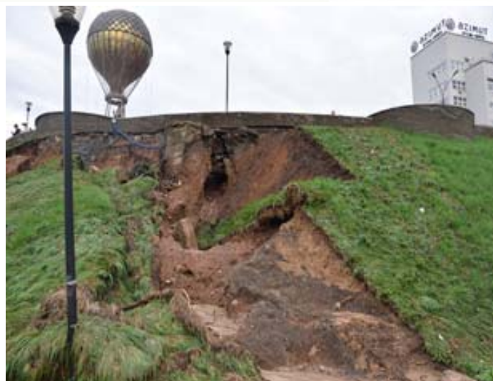
Фото 52.2020.0003. Оползневой процесс на набережной Федоровского, г. Нижний Новгород, Нижегородская область
