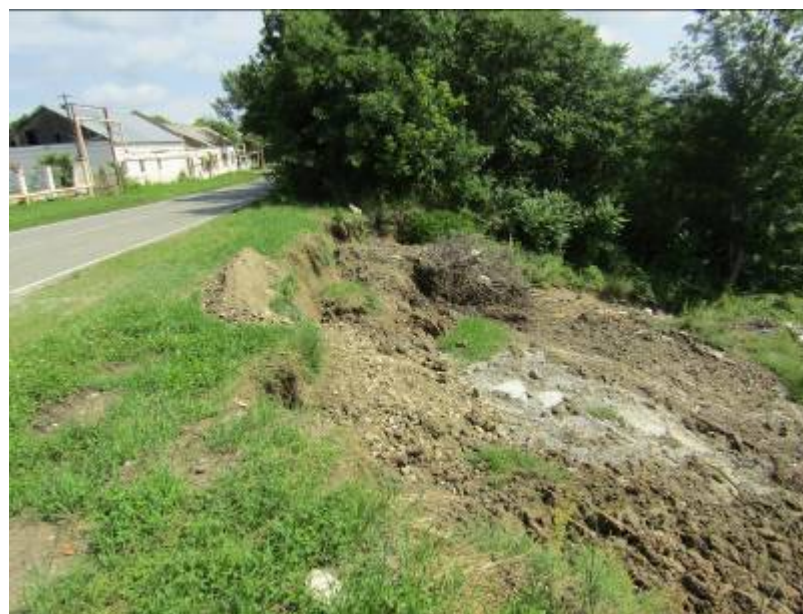
Фото 23.2020.0017 Оползневая активизация в низовом откосе автодороги по ул.Советской. Высота стенки срыва 1-2 м. Деляпсий увлажнен. Бровка стенки срыва оползня находится в 3 м от полотна автодороги. Апшеронский район, пгт.Нефтегорск
