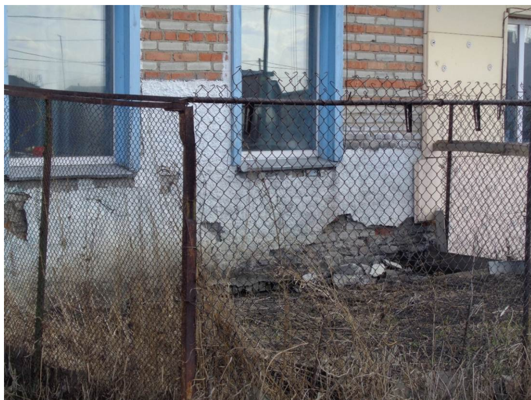
Фото 54.2020.0008. В результате подтопления разрушается дом по ул. Фабричная, 5. Пгт. Коченёво, Коченёвский район, Новосибирская область
