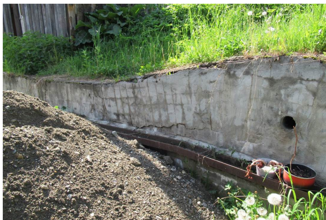
Фото 04.2020.0005. Подпорная стенка в подошве оползня № 28 перед усадьбой по ул. Черноплодная, 10. Г. Горно-Алтайск, Республика Алтай
