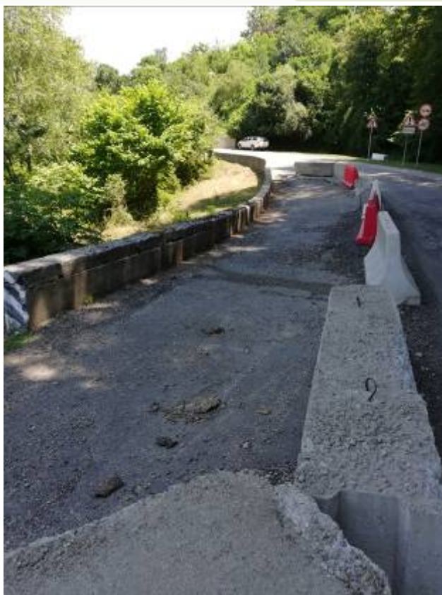
Фото 23.2020.0009. Оползневая активизация в низовом откосе автодороги. Деформировано полотно автодороги на протяжении 15м. г. Сочи, Адлерский район, южная окраина с.Илларионовка
