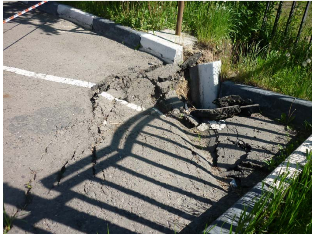
Фото 77.2020.0002 Разрушенное асфальтированное дорожное покрытие, в результате сместившегося оползневого блока пород на левом берегу р. Очаковка, в пределах Большого Очаковского пруда, Мичуринский проспект д. 80, г. Москва
