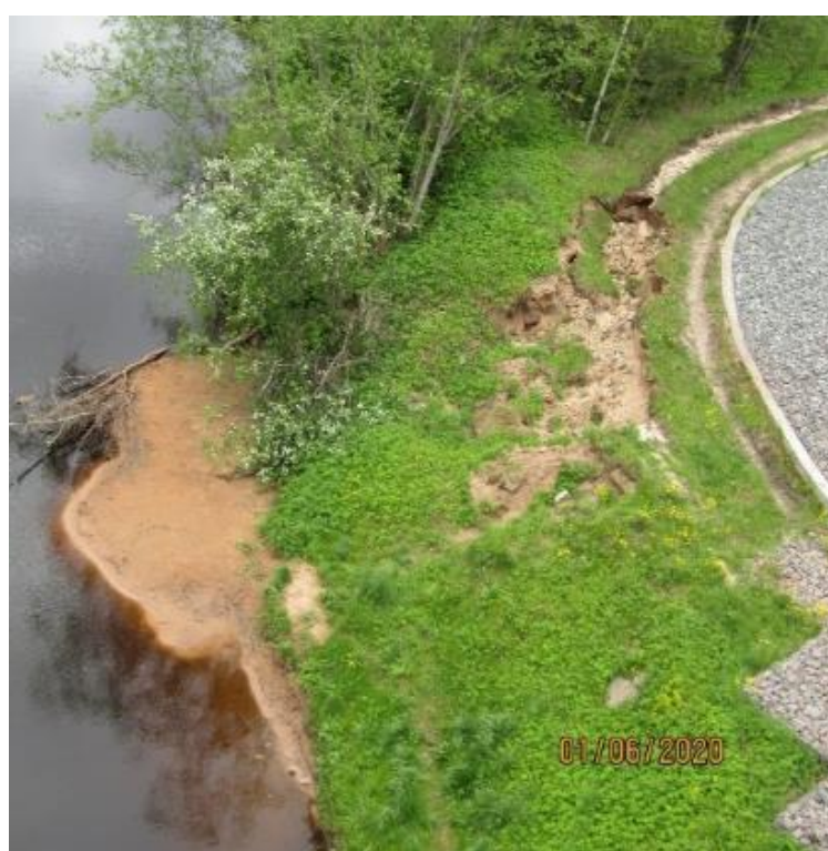
Фото 47.2020.0005 Развивающийся оползневой процесс под мостом через реку Яцера на левом берегу, вблизи деревни Долговка Лужского района. Ленинградская область
