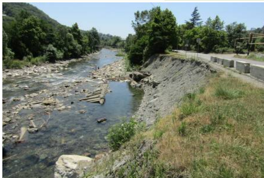
Фото 23.2020.0016 Правый берег р.Сочи. Активные оползневые процессы в низовом откосе автодороги г.Сочи - с.Пластунка. Фактор активизации - боковая эрозия реки. Протяженность участка 40 м г.Сочи, Хостинский район
