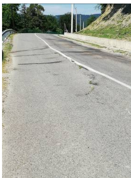
Фото 23.2020.0010 Оползневая активизация в низовом откосе автодороги. Деформация дорожного полотна на протяжении 30 м. Высота оползневой ступени 15 см. г.Сочи, Адлерский район, северная окраина с.Илларионовка
