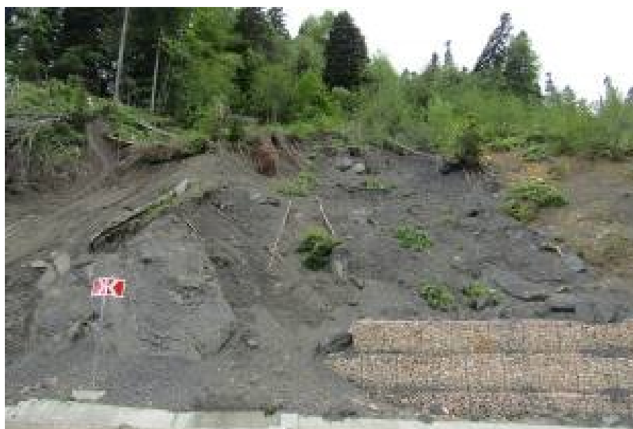
Фото 01.2020.0001. Консистентный оползень в верховом откосе строящейся автомобильной дороги Гузерипль – плато Лаго-Наки в 14 км к северо-западу от п. Гузерипль. Майкопский район, Республика Адыгея.
