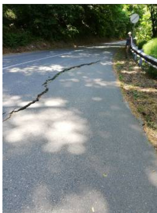
Фото 23.2020.0011 Оползневой очаг в низовом откосе автодороги шириной 30м. Деформации полотна автодороги, высота оползневой ступени около 10см, ширина раскрытия трещин 5 см. г. Сочи, Хостинский район северо-западная окраина п.Хоста
