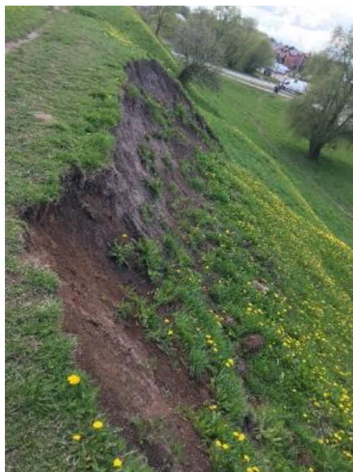
Фото 53.2020.0007 Стенка отрыва оползня, развивающегося вблизи д. 38 по ул. Черняховского. Новгородская область
