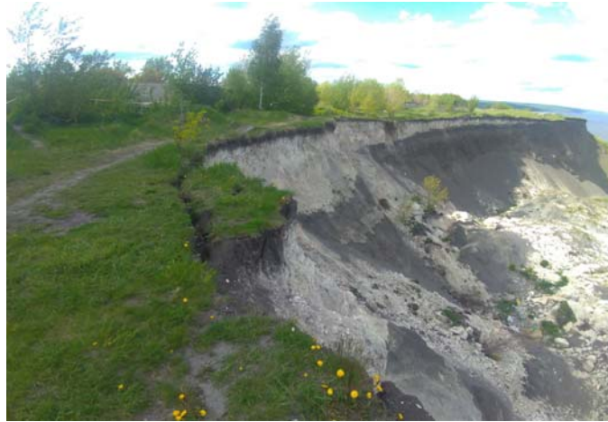
Фото 73.2020.0001. Бровка срыва оползня на участке «Разрез Милановского», Ленинский р-н, г. Ульяновск, Ульяновская область
