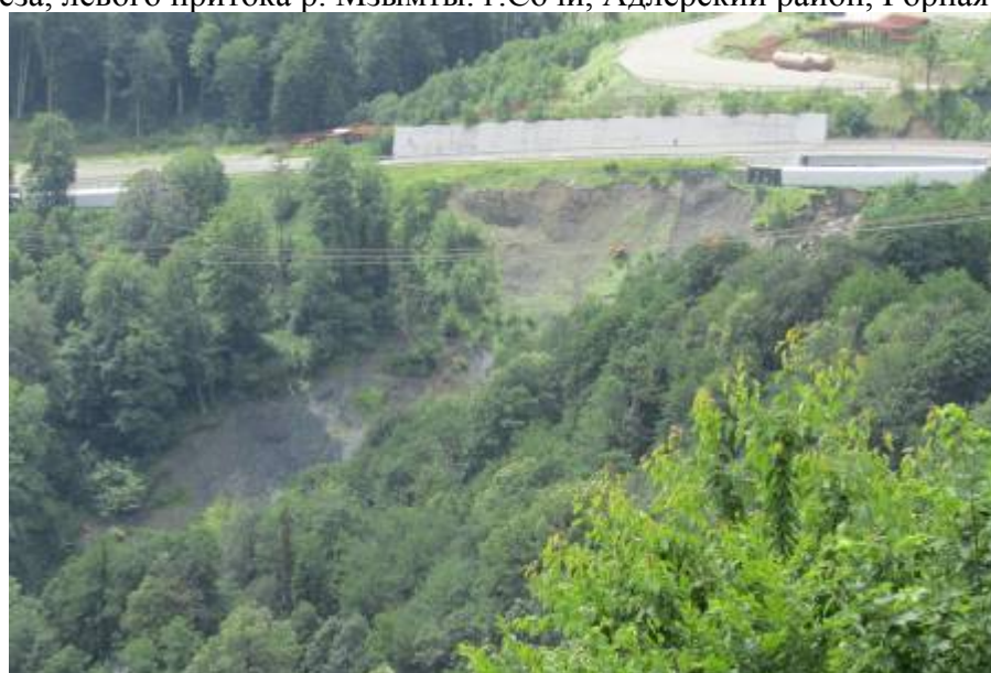
Фото 23.2020.0004. На правом берег балочного вреза, в низовом откосе автодороги Альпийское шоссе активизировались оползневые процессы на площади около 3,2 тыс. м 2 . г.Сочи, Адлерский район, Горная олимпийская деревня
