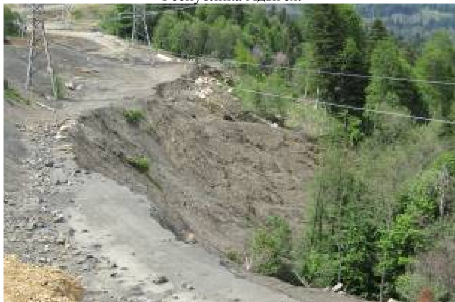
Фото 01.2020.0003. Блоково-консистентный оползень в верховом откосе строящейся автомобильной дороги Гузерипль – плато Лаго-Наки в 12,7 км к северо-западу от п. Гузерипль. Разрушение низового откоса старой лесовозной дороги. Под угрозой разрушения опоры ЛЭП. Майкопский район, Республика Адыгея.
