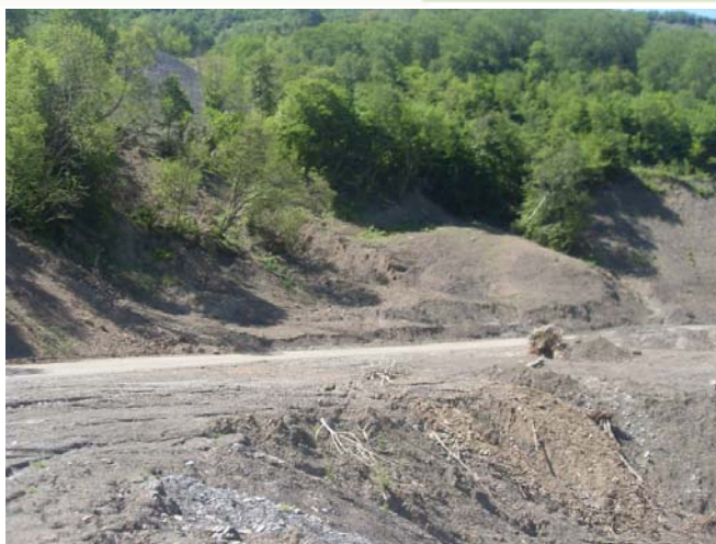
Фото 20.2020.0002. Перекрытие оползневыми массами полотна автодороги без покрытия с.Итум-Кале-с.Ведучи в 1,75км на юг от с.Итум-Кале. Итум-Калинский район, Чеченская республика. (Фото ООО «Центр ГИДИС»).
