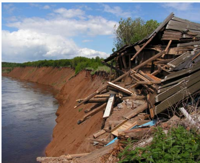
Фото 18.2020.0001. Разрушение дома №3 по ул. Набережной в с. Крымская Слудка Кизнерского района, Республика Удмуртия
