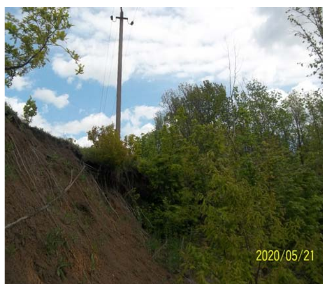
Фото 13.2020.0003. Опора ЛЭП в 6,0 м от бровки оползневого уступа, 720 м севернее с. Надеждинка, Республика Мордовия
