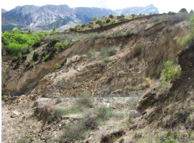
Фото 15.2020.0013. В результате активизации Низового оползня деформируется полотно дороги на интервале 150 м. Республика Северная Осетия -Алания. (Фото АО «Севосетинэкогеомониторинг»)
