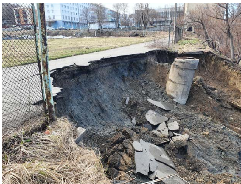
Фото 65.2020.0017. Оползень в г. Холмске Сахалинской области
