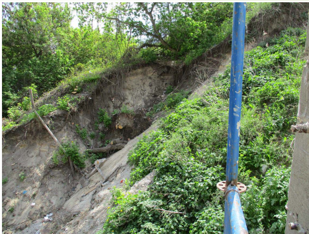
Фото 36.2020.0001 Сместившийся оползневой блок пород на территории набережной Софьи Перовской пер. Детский, г. Воронеж, Воронежская область
