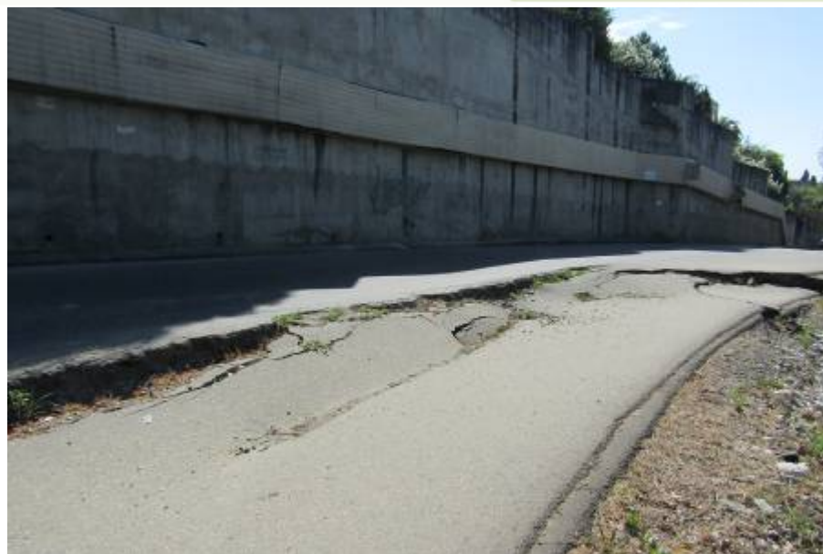
Фото 23.2020.0012 Оползневой очаг в низовом откосе автодороги протяженностью 30м. Разрушено 1/2 ширины полотна автодороги на протяжении 15м. Высота оползневой ступени 30см. г. Сочи, Хостинский район, юго-восточная окраина п.Хоста
