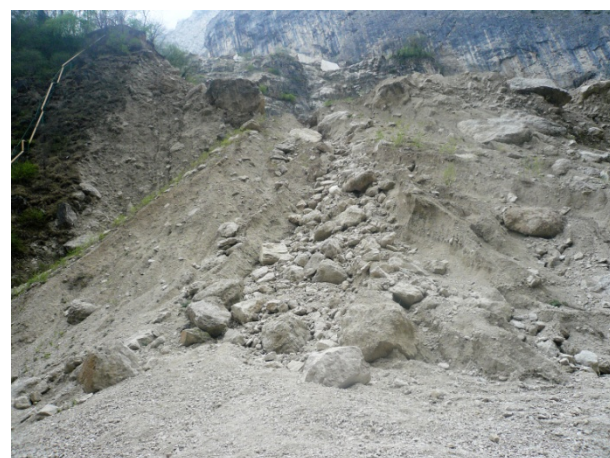
Фото 15.2020.0010. Обвальнo-осыпной участок на нижних серпантинах автодороги Гизель-Даргавс. Обвальнo-осыпными массами периодически перекрывается до 150м полотна автодороги без покрытия. Республика Северная Осетия -Алания. (Фото АО «Севосетинэкогеомониторинг»)
