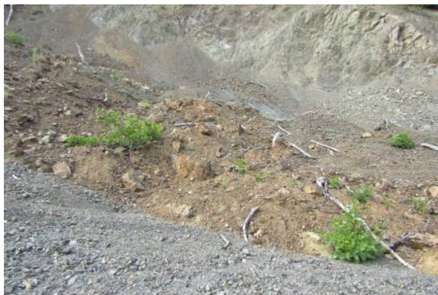
Фото 23.2020.0008. Кепшинский оползневой массив. Вдоль левого борта оползня на протяжении 500 м развиты активные обвально-осыпные процессы. Г.Сочи, Адлерский район
