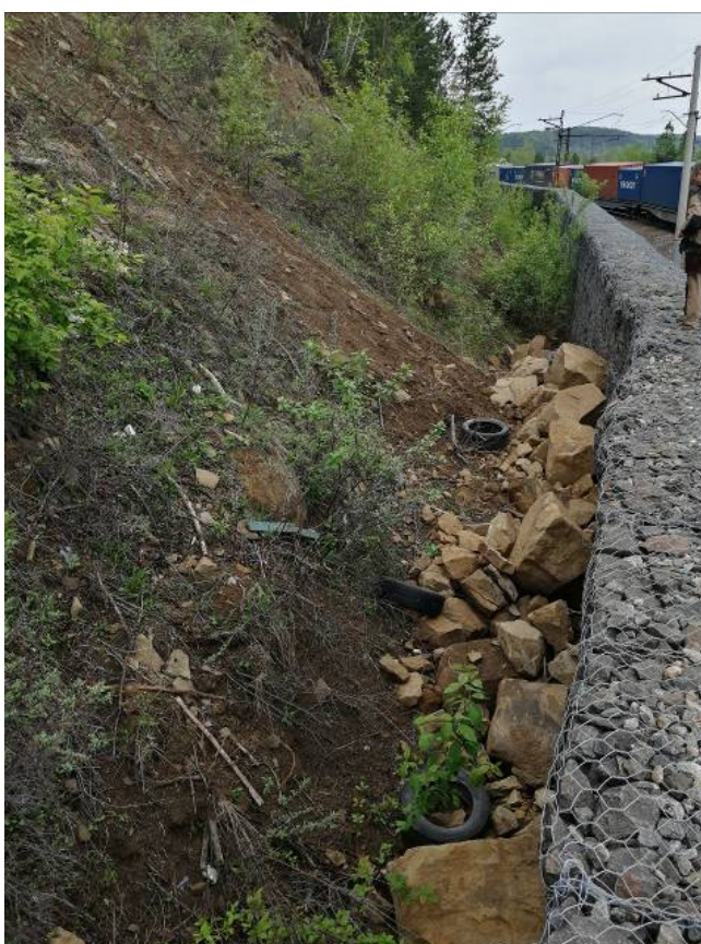
Фото 38.2020.0001. Скопление осыпного материала за подпорной стенкой на участке ВСЖД Кая-Черемушки в г. Иркутске, Иркутская область
