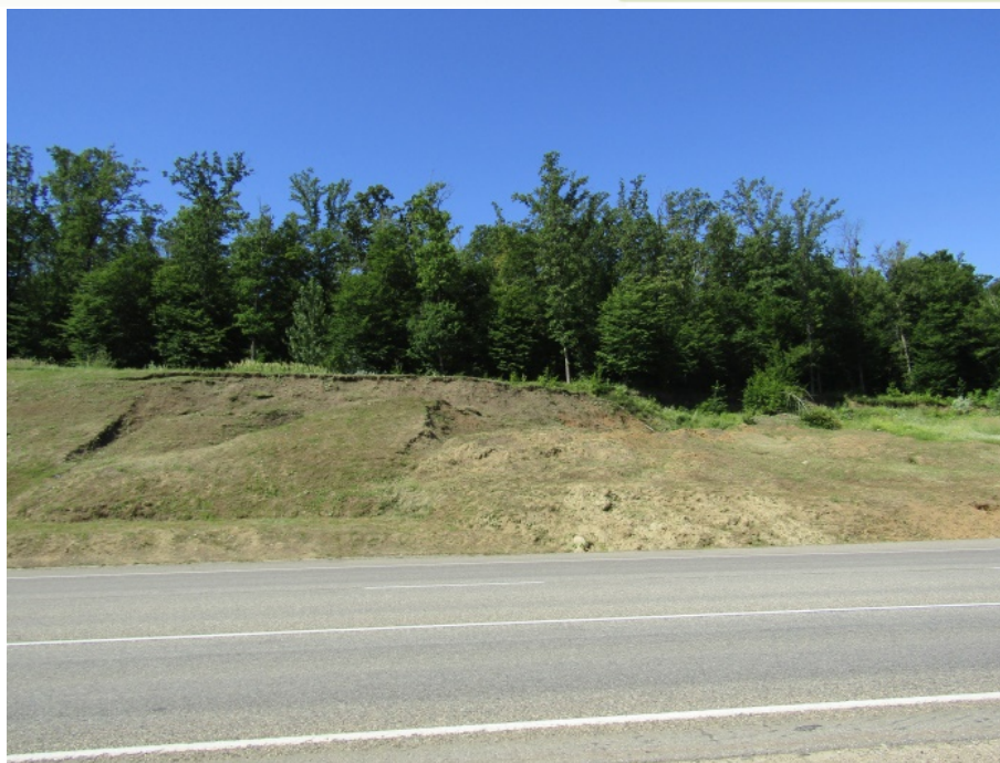
Фото 01.2020.0004. Оползневой участок в верховом откосе автодороги 79К-186 в 2,5 км к северо-западу от пос. Краснооктябрьский. Оползень блоковый, в языковой части пластичный, приобретает форму течения. Майкопский район, Республика Адыгея.
