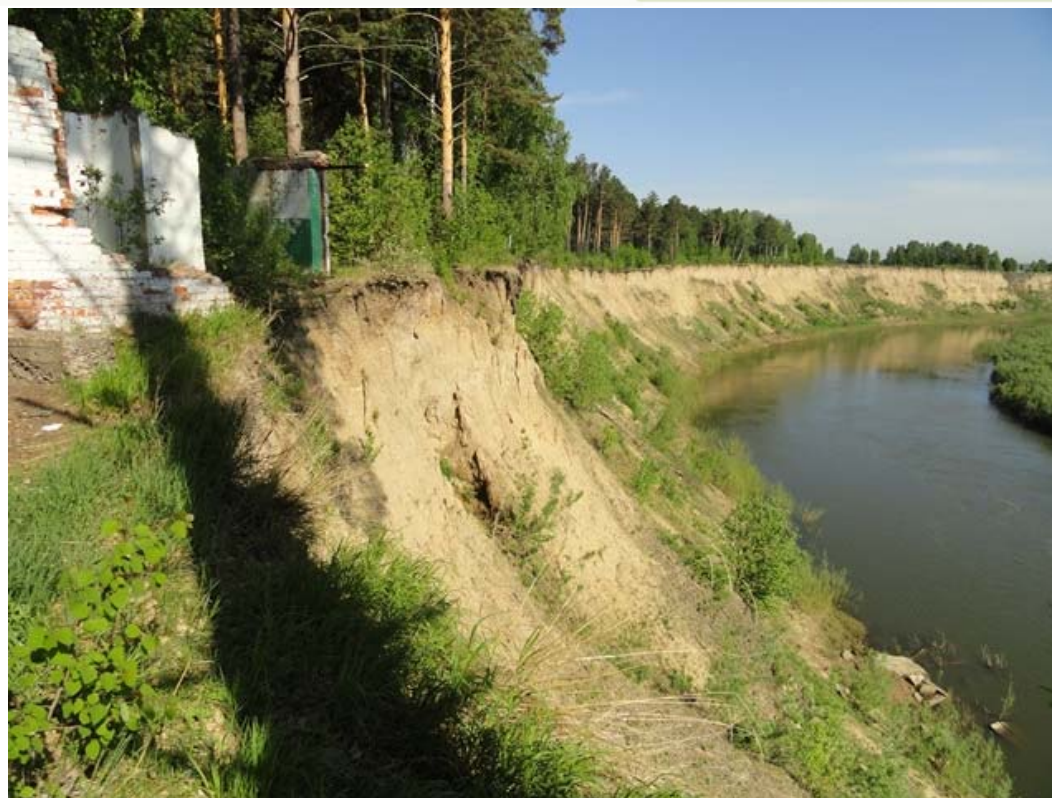
Фото 70.2020.0013. Разрушение хозяйственных построек под воздействием гравитационно-эрозионных процессов, с. Калтай, район ДООЦ «Энергия», Томская область
