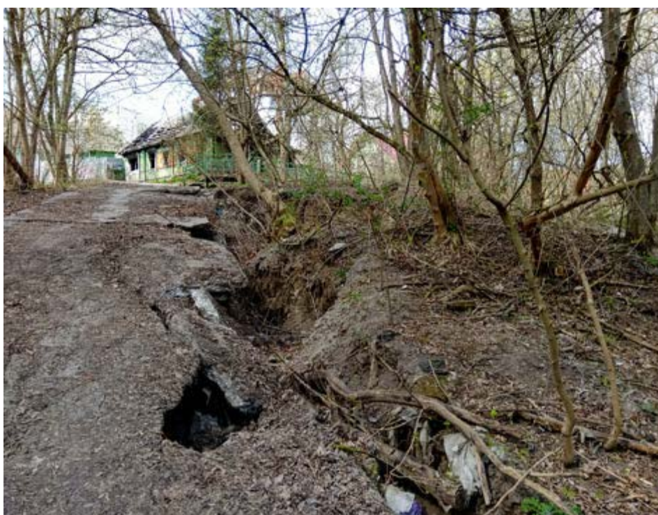
Фото 32.2020.0001 Разрушенное асфальтированное дорожное покрытие, в результате активизации процесса овражной эрозии на территории памятника природы овраг «Нижний Судок», Советский район, г. Брянск, Брянская область
