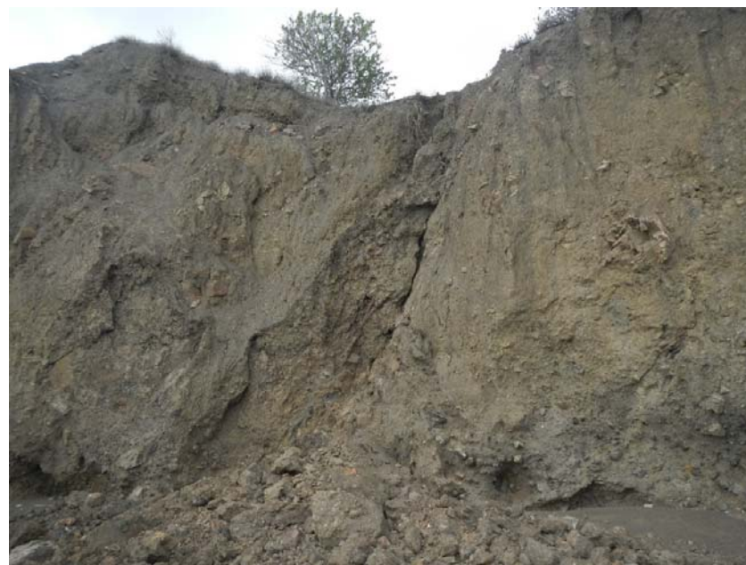
Фото 91.2020.51. Образование трещин закола в языковой части оползня и свежие вывалы грунта на пляж. Республика Крым. (Фото ГАУ РК «ЦЛАТИ»)
