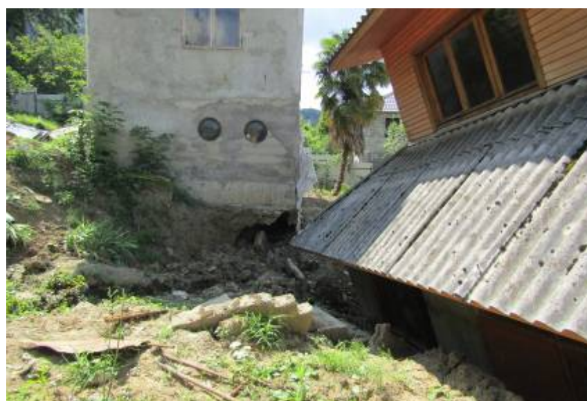
Фото 23.2020.0002. Разрушение дачных построек вследствие активизации оползневых процессов СТ «Мир1», Адлерском районе г.Сочи
