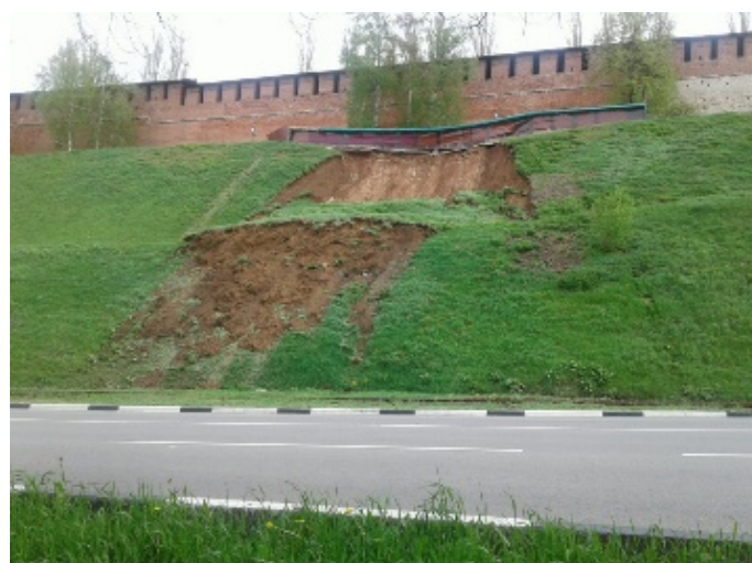
Фото 52.2020.0005. Оползень на Зеленском съезде г.Нижний Новгород, Нижегородская область
