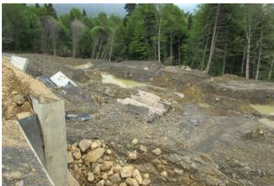
Фото 01.2020.0002. Блоково-консистентный оползень в верховом откосе строящейся автомобильной дороги Гузерипль – плато Лаго-Наки в 13 км к северо-западу от п. Гузерипль. В теле оползня фрагменты разрушенных бетонных подпорных стенок. Майкопский район, Республика Адыгея.
