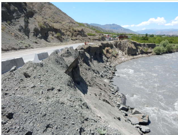
Фото 05.2020.16. Активный оползень в низовом откосе автодороги на восточной окраине с. Голотль. Республика Дагестан. (Фото ООО «Даггеомониторинг»).
