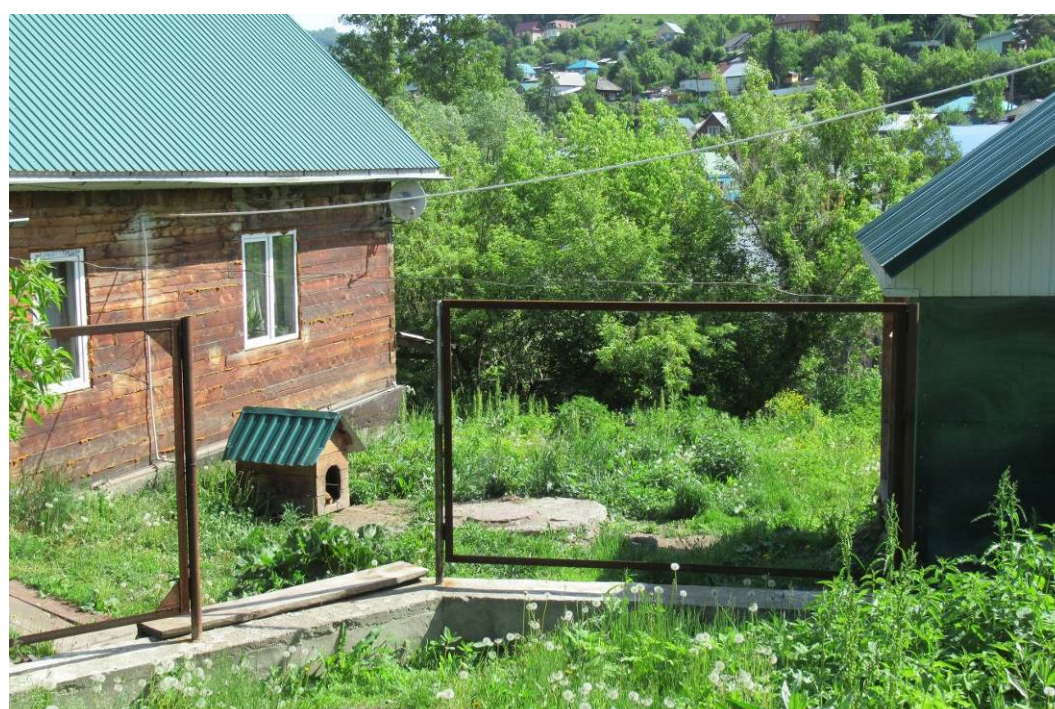
Фото 04.2020.0006. Оползень № 30 в левом борту р. Каяс. Жилой дом по ул. Айская, 2 в опасной близости от бровки уступа. Г. Горно-Алтайск, Республика Алтай
