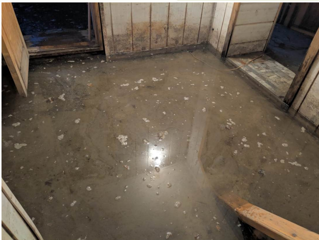
Фото 54.2020.0003. Затопленный нижний этаж коттеджа по ул. Искитимская, 18 вследствие подтопления грунтовыми водами. Г. Бердск, Новосибирская область
