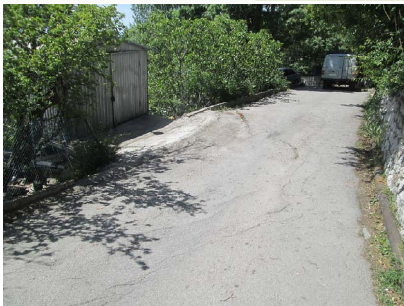
Фото 91.2020.0015. Активный очаг, разрушающий асфальтовый проезд в с. Оползневое, городской округ Ялта. Республика Крым. (Фото ГАУ РК «ЦЛАТИ»)
