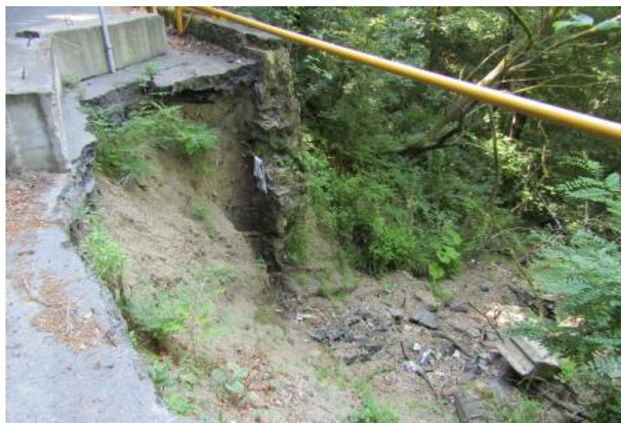
Фото 23.2020.0013 Оползневой очаг в низовом откосе автодороги протяженностью 15м. Разрушение полотна автодороги на протяжении 15 м. г.Сочи, Хостинский район, п.Хоста
