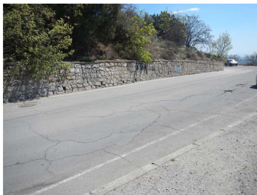
Фото 91.2020.0025. Наблюдается деформации на асфальтовом покрытии в районе пгт. Отрадное, городской округ Ялта. Республика Крым. (Фото ГАУ РК «ЦЛАТИ»)
