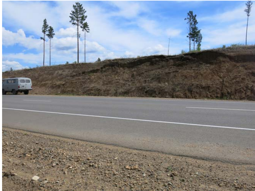
Фото. 75.2020.0011 Смещение оползня на обочину дороги (70-ый км автодороги Чита-Хабаровск) в Карымском районе Забайкальского края.
