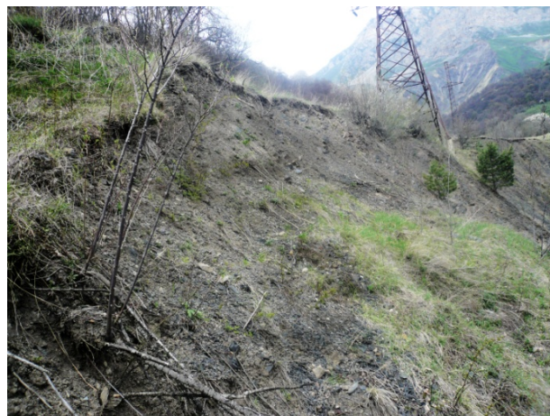
Фото 15.2020.0001. Активный Суаргомский оползень. Головная часть оползня захватывает внешний край дорожной полки (20м) автодороги Чми - Гор.Саниба. Создаётся угроза деформации газопровода, пересекающего оползень и опоры ЛЭП. Республика Северная Осетия -Алания. (Фото АО «Севосетинэкогеомониторинг»)
