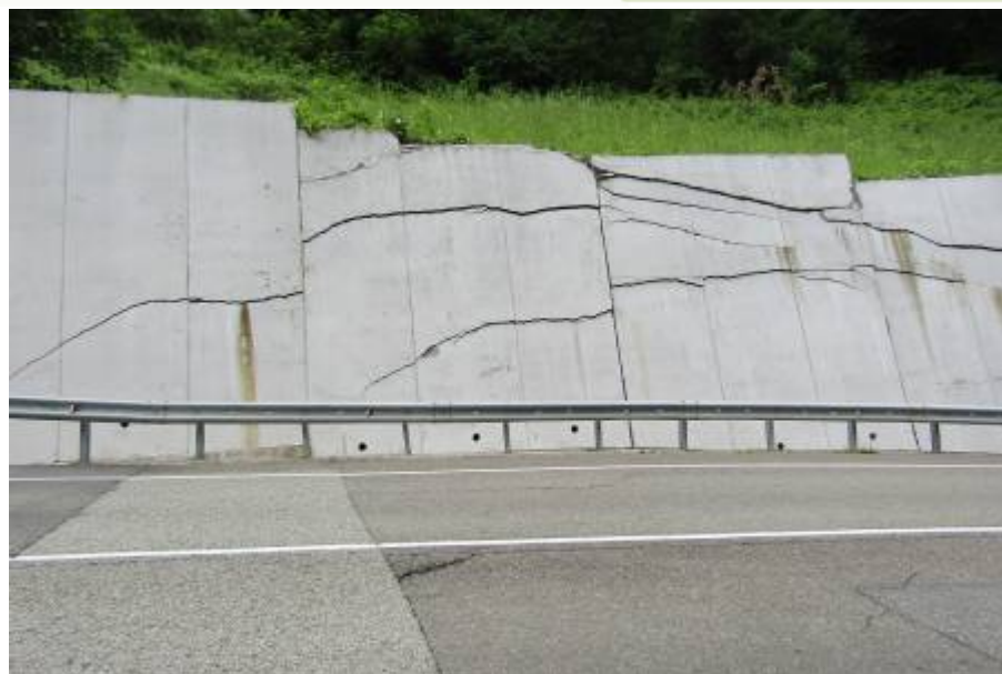
Фото 23.2020.0006 Разрушение подпорной стенки на правом берегу р. Черного в районе Горной олимпийской деревни. г.Сочи, Адлерский район, Горная олимпийская деревня
