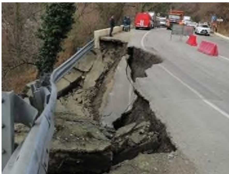
Фото 23.2021.0009 Подвергнувшийся воздействию оползневому процессу участок обочины и полотна автодороги А-147, Джубга – Сочи (158 км).
