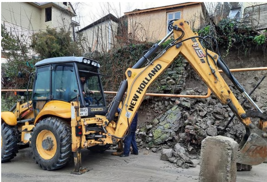
Фото 23.2021.0003 Перекрытое оползневыми массами полотно автодороги по ул. Либкнехта. Туапсинский район. г. Туапсе,
