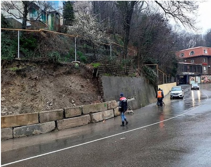
Фото 23.2021.0002 Разрушенная оползнем подпорная стенка откоса автодороги по ул. Кирова, 64. Туапсинский район. г. Туапсе.
