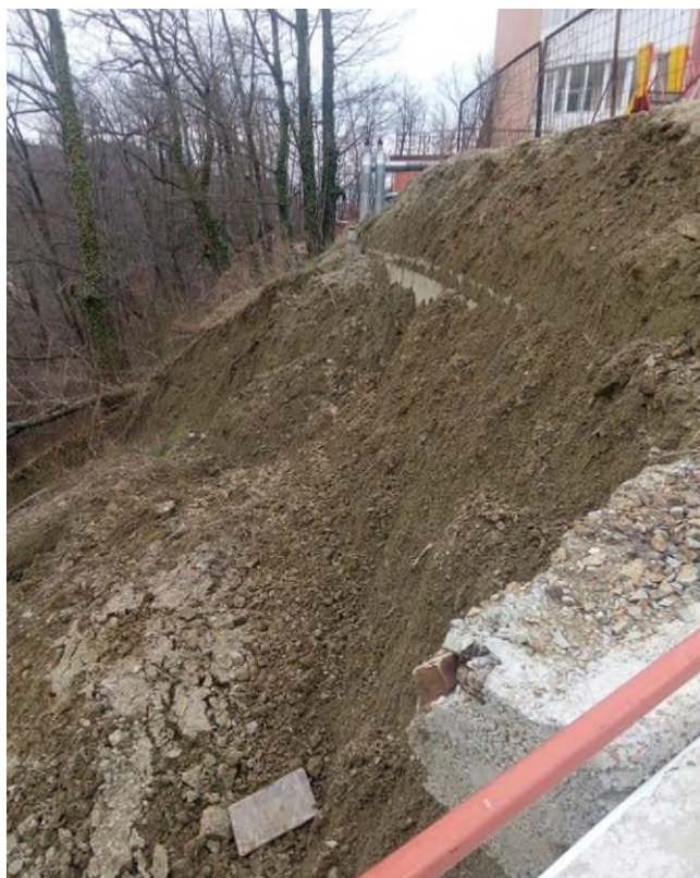
Фото 23.2021.0004 Активизировавшийся оползень у здания по ул. Кириченко, 90. Туапсинский район. г. Туапсе.
