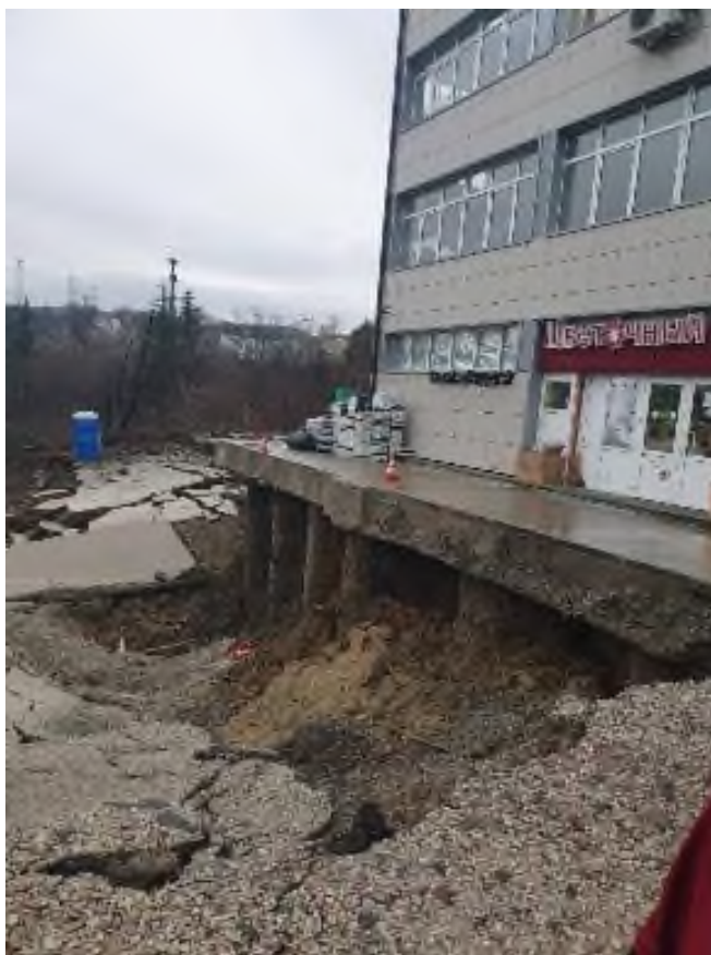
Фото 23.2021.0005 Активизировавшийся оползень у здания по ул. Транспортная № 74/5, Центрального района г. Сочи. Краснодарский край
