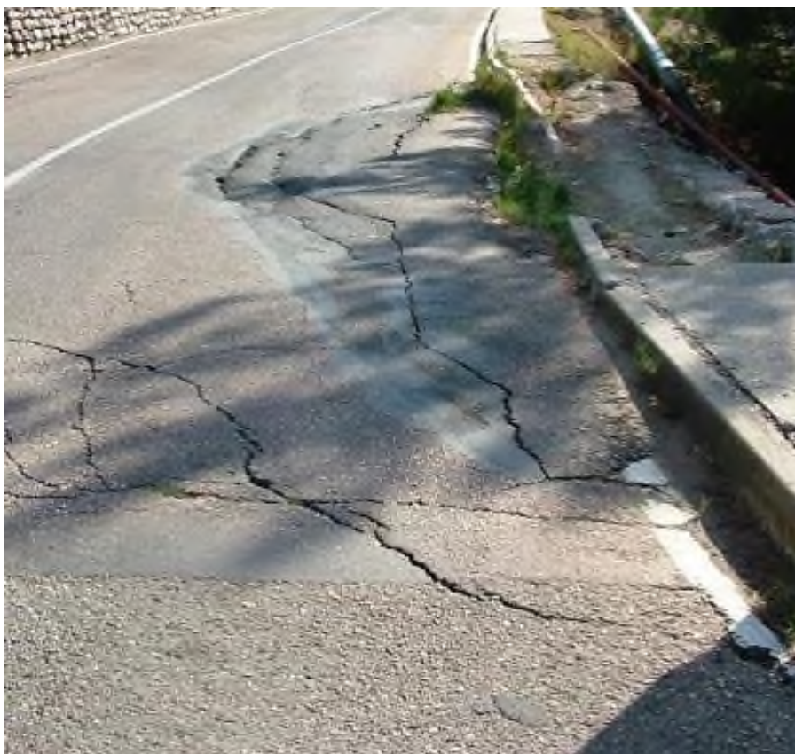
Фото 67.2021.0001 Участок полотна автодороги на Батилиман, деформированный в следствие активизации оползневого процесса. Балаклавский район, г. Севастополь.
