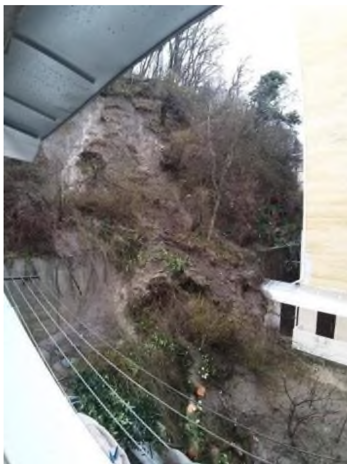
Фото 23.2021.0010 Активный оползень вблизи жилого дома по ул. Пластунская 194/14. МО г. Сочи, Центральный район.
