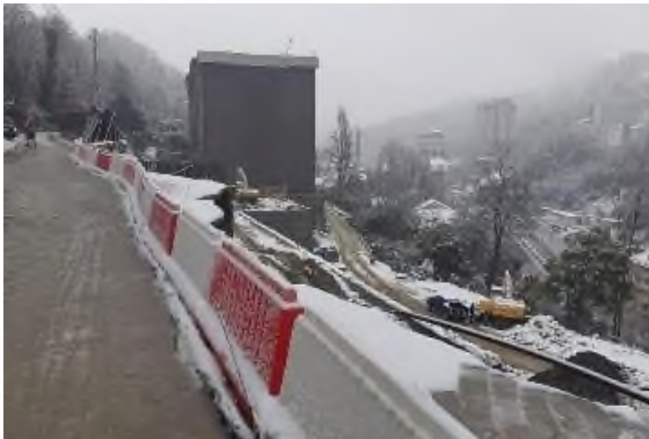
Фото 23.2021.0007 Разрушенный участок автомобильной дороги в следствие активизации оползневого процесса. МО г. Сочи, Хостинский район, ул. Ломоносовская.
