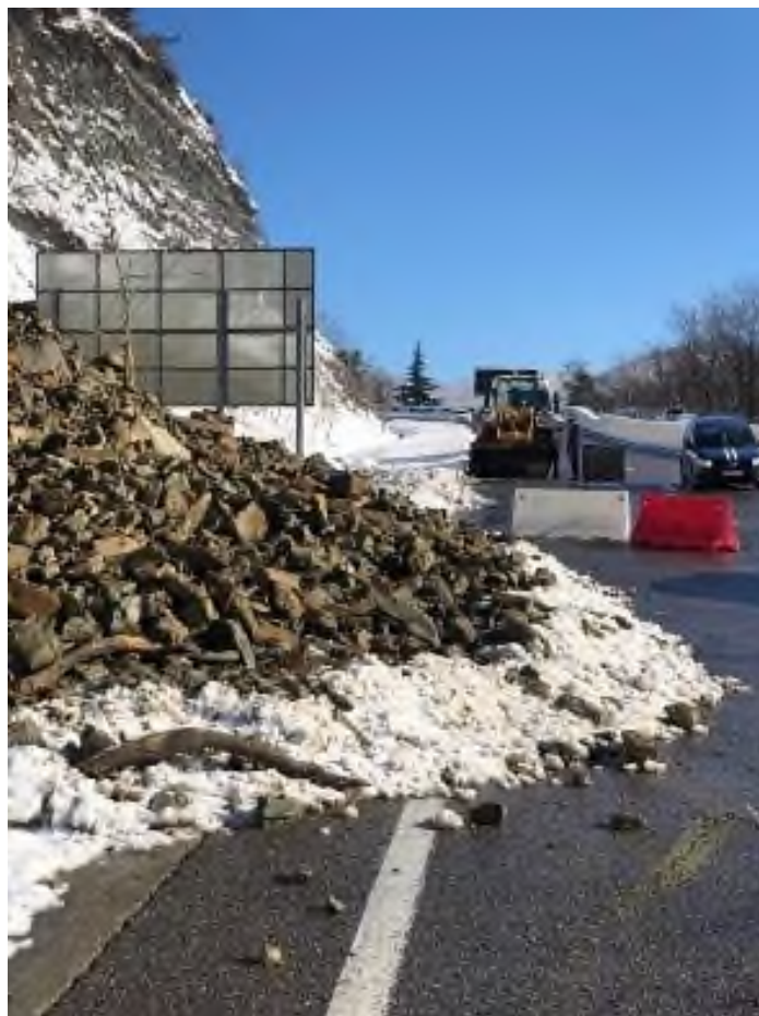
Фото 23.2021.0008 Перекрытый оползневymi массами участок полотна автодороги. МО г. Сочи, Лазаревский район, перевал Мамайский
