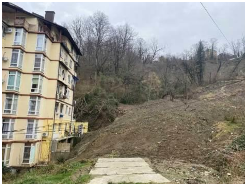
Фото 23.2022.0031. Языковой части оползня, воздействующая на 1-й этаж дома по ул. Макаренко 8Б/8. Центральный район, МО г. Сочи
