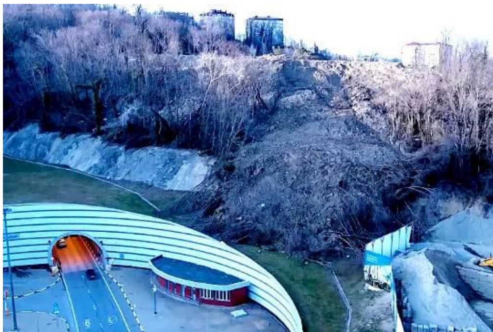
Фото 23.2022.0040. Проявление оползневого процесса у туннеля на «Дублере Курортного проспекта» в районе с. Раздольное. Хостинский район, МО г. Сочи
