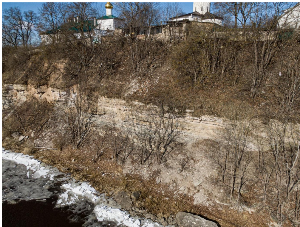
Фото 60.2022.0001. Проявление обвально-осыпных процессов на склоне Снеготорского монастыря в г. Псков
