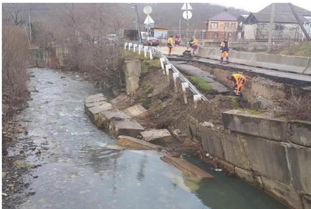
Фото 23.2022.0006. Участок автодороги вдоль береговой линии р. Бол. Псеушко, подвергшийся воздействию оползневой процесс. Туапсинский район, с. Бол. Псеушко
