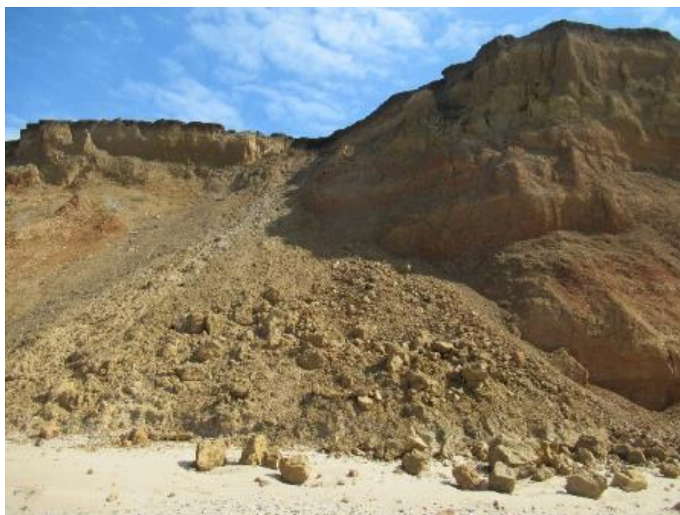
Фото 91.2022.0002. Горные породы, сместившиеся в результате активизации оползневого процесса. Бахчисарайский район, с. Береговое
