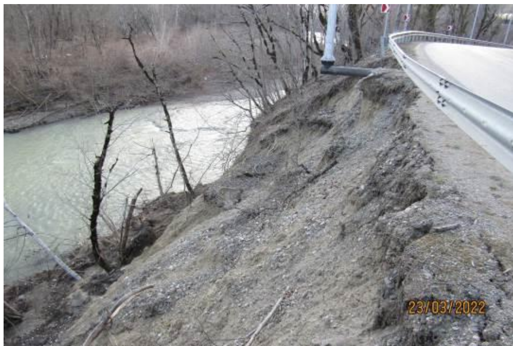
Фото 23.2022.0025. Активный оползень в низовом откосе автодороги 03К-003. Туапсинский район, юго-западная окраина с. Навагинское
