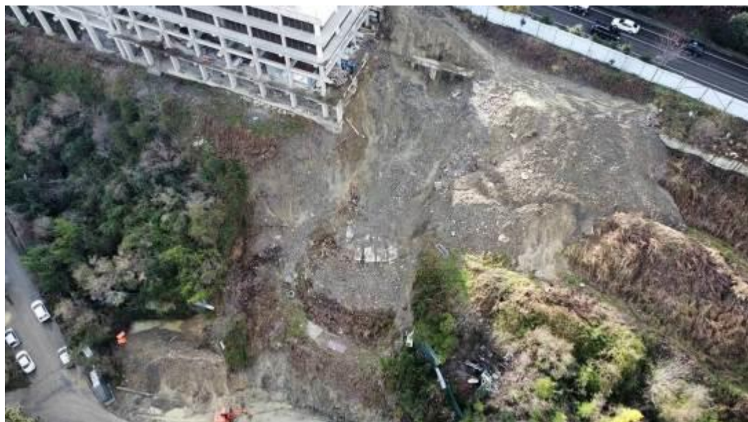
Фото 23.2022.0018. Активный оползень в районе строящегося здания по ул. Виноградная, 190. Центральный район, МО г. Сочи.
