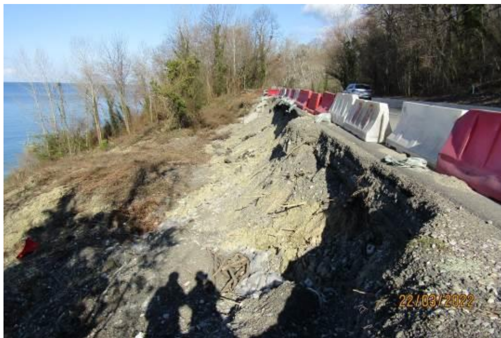
Фото 23.2022.0012. Оползень в низовом откосе автодороги А-147 (в районе 138 км). Лазаревский район, МО г. Сочи.
