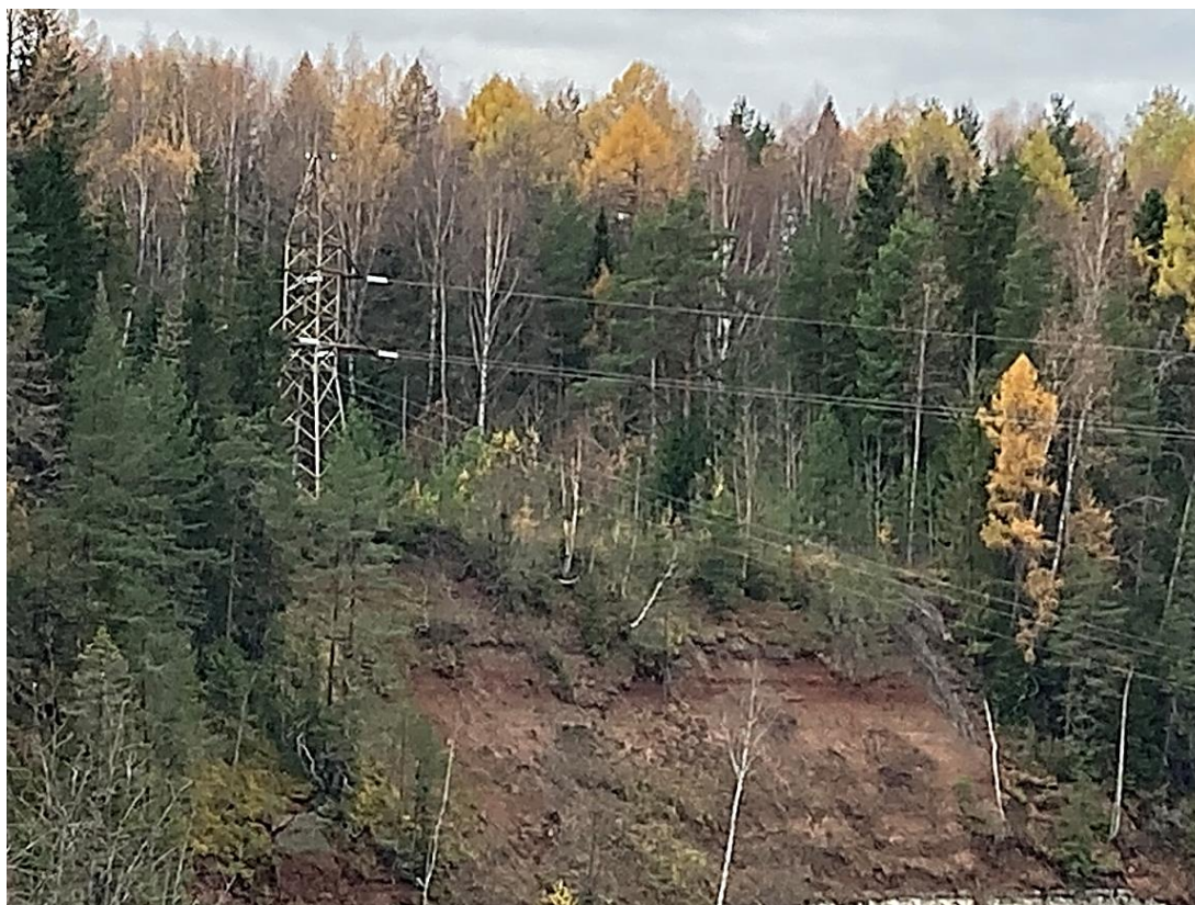
Фото 35.2022.0003. Общий вид оползневого склона, д. Студеное, Великоустюгский район, Вологодская область
