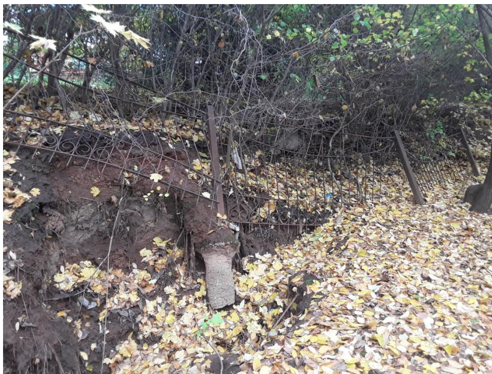
Фото 21.2022.0003. Деформация забора в г. Чебоксары ул. Семена Ислюкова. Чувашская Республика
