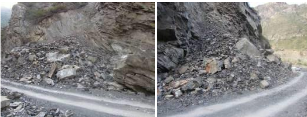
Фото 95.2022.0054. Активизация обвального процесса на участке а/д “ Ахты – Фий” 1км, 7,6км ЮЗ с.Смугул, Ахтынский район, Республика Дагестан
