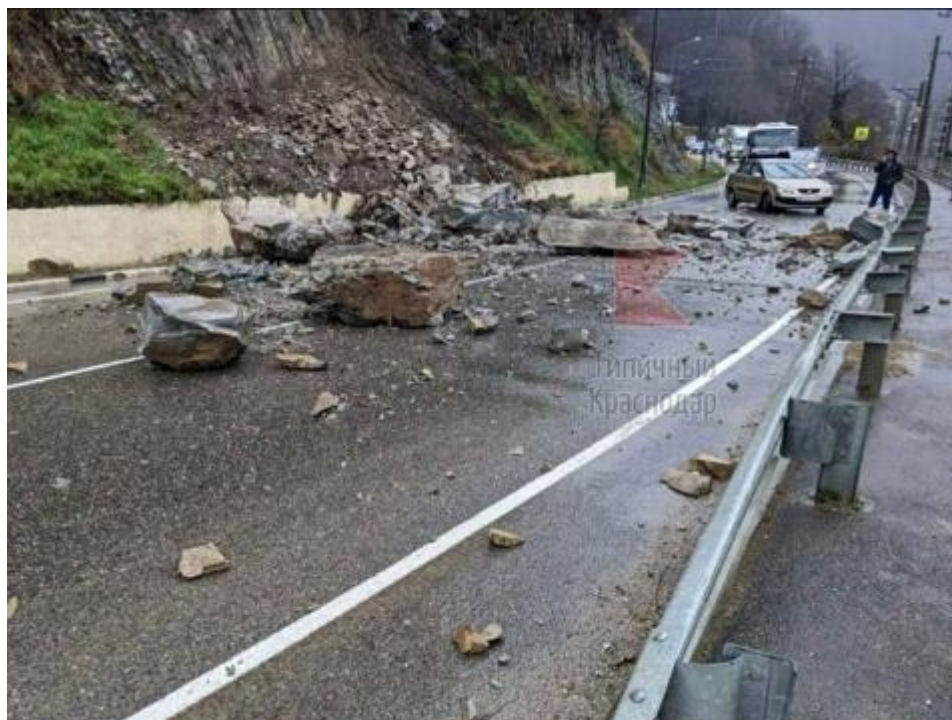
Фото 23.2022.0285. Обвал в верховом откосе автодороги 03К-003 (г. Майкоп - г. Туапсе) в районе п. Пригородный Туапсинского района, Краснодарский край
