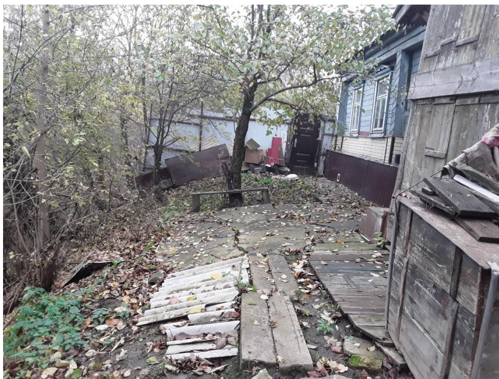
Фото 21.2022.0006. Оползневой процесс деформирует дом по ул. Подгорная, д. 37, г. Алатырь. Чувашская Республика
