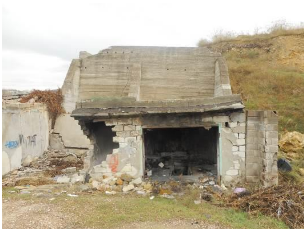
Фото 67.2022.0002-1. Правый борт оползня. Полуразрушенные и разрушенные гаражные боксы. Деформация подпорной стенки, осыпавшийся грунт из-за подпорной стены. Трещины в подпорной стене, стена потеряла свои конструктивные свойства. Смещения фундамента гаража. Разрушение гаражных боксов продолжается. г. Севастополь, Нахимовский район (23.11.2022)
