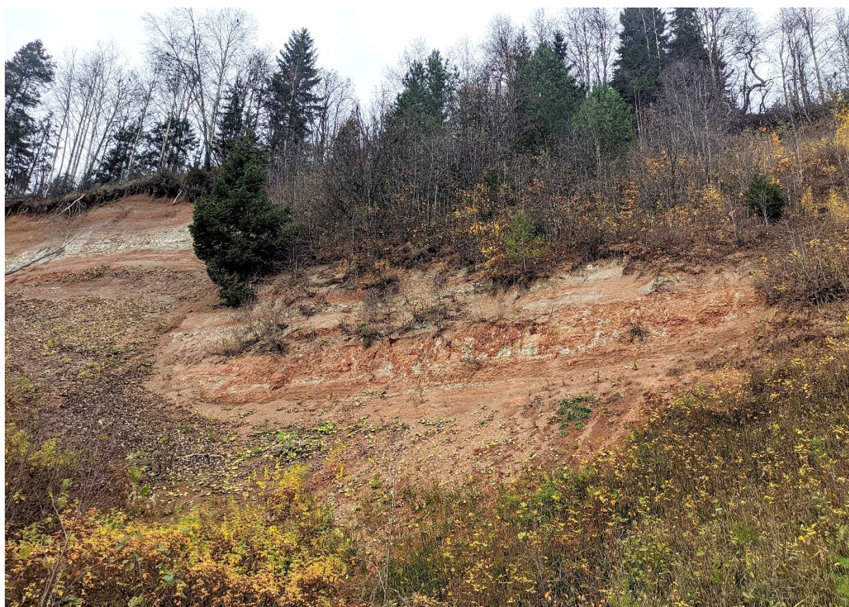
Фото 35.2022.0002. Общий вид оползневого склона, д. Красное Поле, Великоустюгский район, Вологодская область
