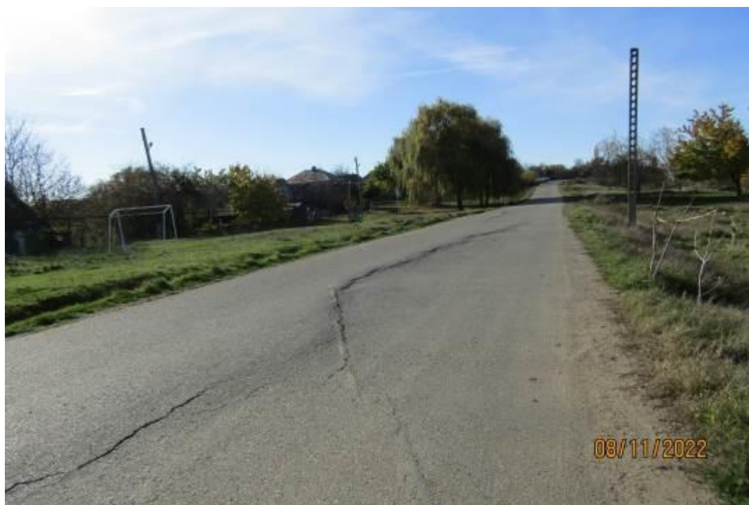
Фото 23.2022.0283. Оползневые деформации дорожного полотна по ул. Красной в пгт. Нефтегорске, Краснодарский край
