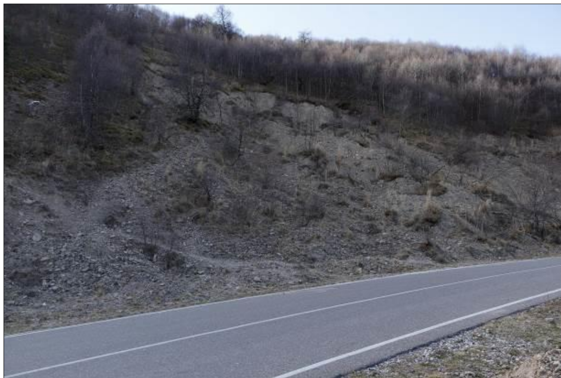
Фото 07.2022.0017. Правый борт оползня на верхнем откосе дороги, правый борт левого притока р.Харбас, Зольский район, Кабардино-Балкарская Республика, 21.10.2022г.
