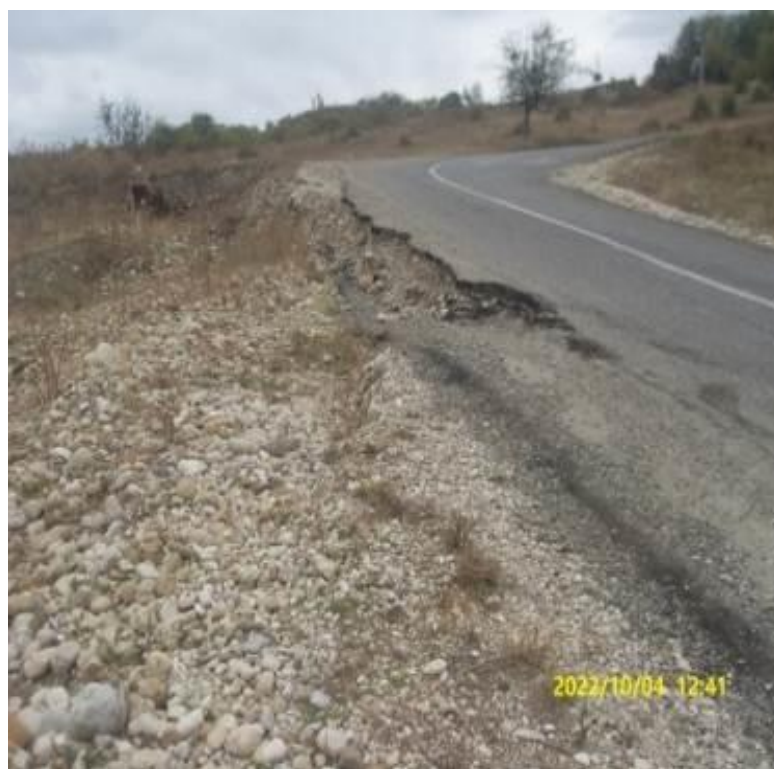
Фото 20.2022.0082. Чеченская Республика. Ножай-Юртовский район. С. Саясан 0,42км. Активизация оползня привела к разрушению и частичному деформированию полотна дороги с покрытием на участке длиной 40м.
