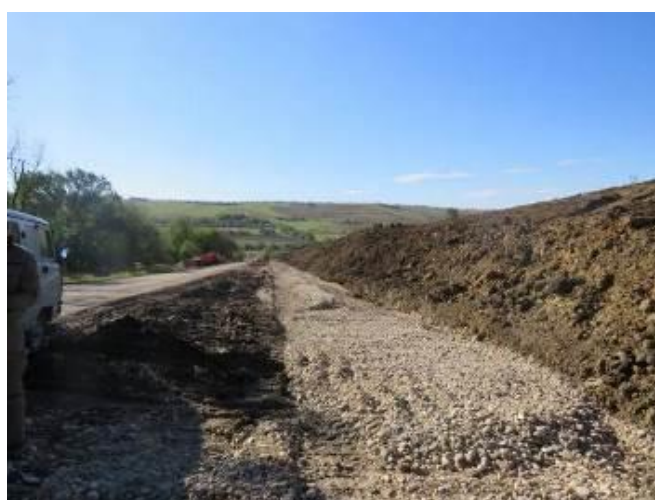
Фото 26.2022.0059. Оп. №2312. Весной 2022г происходили смещения высокой интенсивности в откосе вдоль левого борта, Северо-восточная окраина х. Васильевского Кочубеевского МО, Ставропольский край
