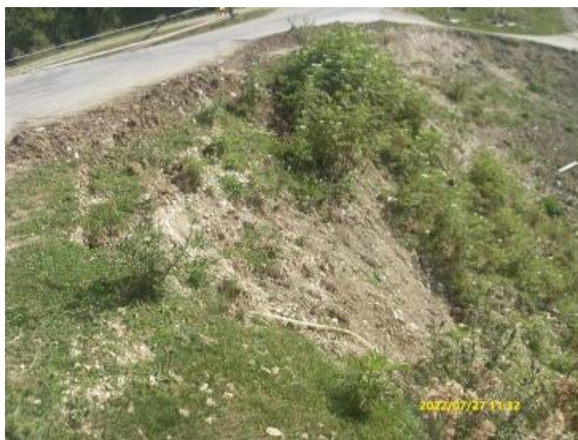
Фото 20.2022.0076. Чеченская Республика. Ножай-Юртовский район. С.Датгах, центральная часть, развилка дорог на с.Зандак и с.Булгат-Ирзу. Активизация оползня привела к разрушению участка дороги без покрытия длиной 20м и участка дороги с покрытием длиной 6м шириной 1м.
