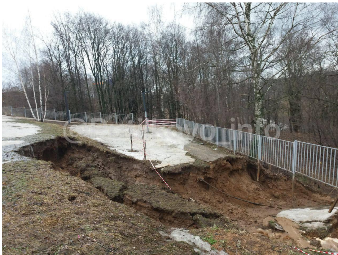
Фото. 50-2023-00001. Активное проявление оползневого процесса на территории Православного Храма Архангела Михаила. д. Путилково, Красногорский городской округ, Московская область.
