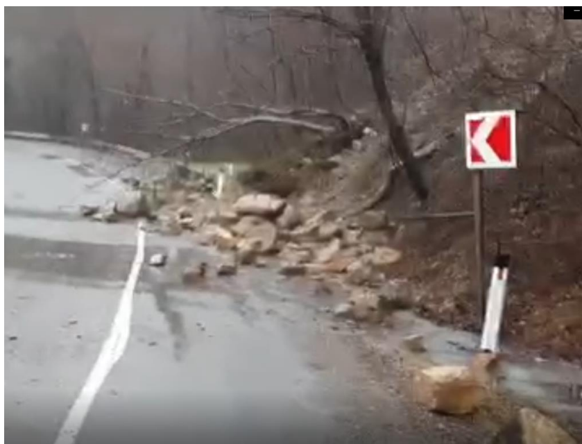
Фото 23-11-00212. Сместившиеся на полотно автодороги горные породы, в результате активизации оползневого процесса на 41-м км трассы А-147 в Туапсинском районе, Краснодарский край. Фото из открытых источников СМИ
