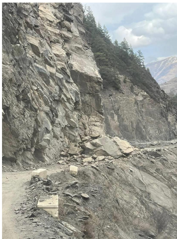
Фото 05-10-00002. Активизировавшийся обвальный процесс на 100 км автодороги “Тунибское шоссе – Вантляшевский перевал”, 8,8 км восточнее от с. Карадах, Республика Дагестан.
