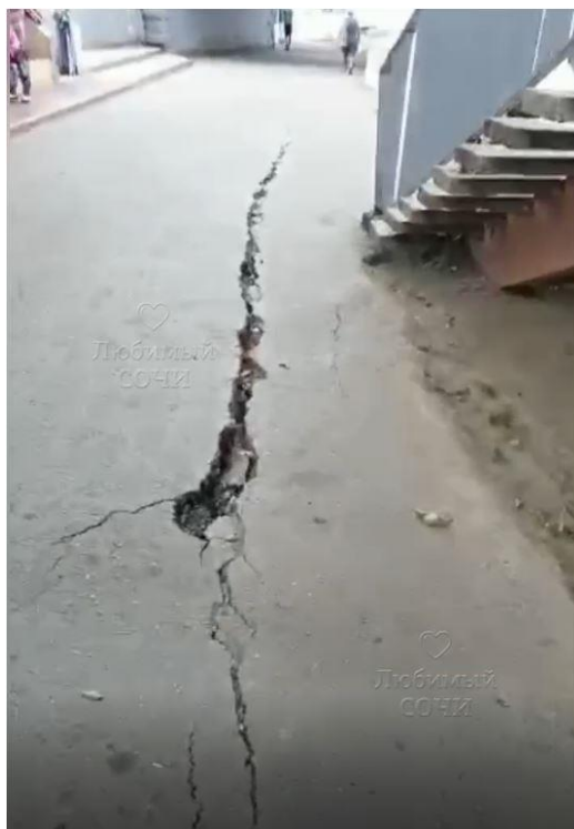
Фото 23-11-00358. Увеличившиеся трещины в асфальтовом покрытии, в результате активизации оползневого процесса под эстакадой железной дороги на территории МО г. Сочи, Хостинский район, жилой район Хоста, набережная р. Хоста. Фото из открытых источников СМИ
