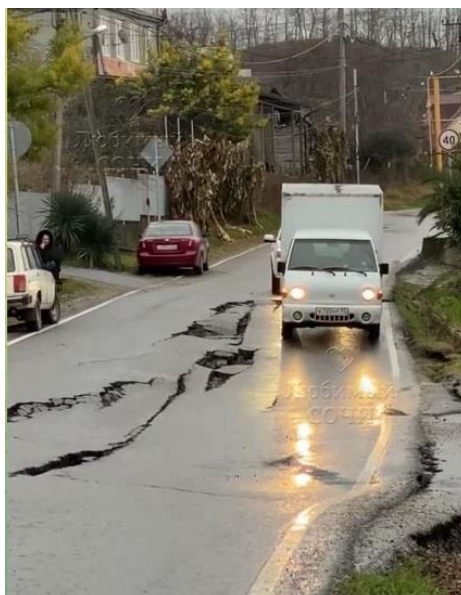
Фото 23-11-00352. Отрезок автодороги, деформированной в результате активизации оползневого процесса на территории МО г. Сочи, Адлерский район, с. Верхневеселое, ул. Блинова 33. Фото из открытых источников СМИ
