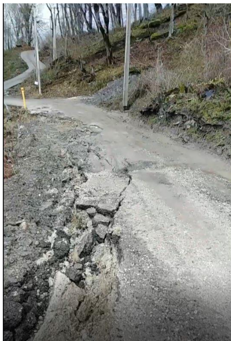
Фото 23-11-00354. Деформированная в результате активизации оползневого процесса часть автодороги на территории МО г. Сочи, Хостинский район, северная окраина с. Верхнениколаевское, ул. Псебайская. Фото из открытых источников СМИ
