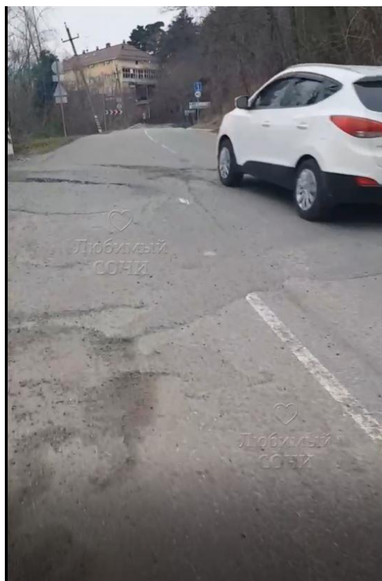
Фото 23-11-00357. Деформированный в результате активизации оползневого процесса участок автодороги, на территории МО г. Сочи, Лазаревский район, южная окраина с. Сергей-Поле (участок дороги 03К-466 между селами Васильевка и Сергей-Поле). Фото из открытых источников СМИ
