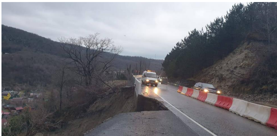
Фото 23-11-00210. Разрушенная в результате активизации оползневого процесса часть автодороги в с. Дедеркой Туапсинского района (70-й км трассы А-147), Краснодарский край. Фото из открытых источников СМИ
