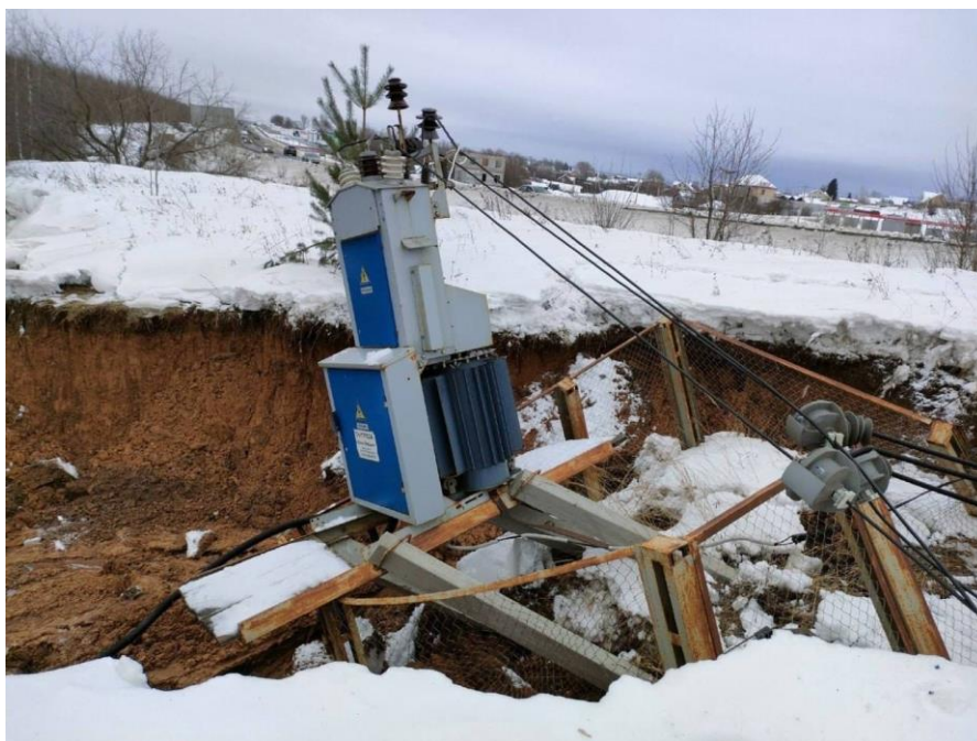
Фото 52-11-00001. Объект энергетической инфраструктуры, вовлеченный в оползневой процесс на территории п. Новинки, г.о. Нижний Новгород, Нижегородская область. 13 января 2023г.
