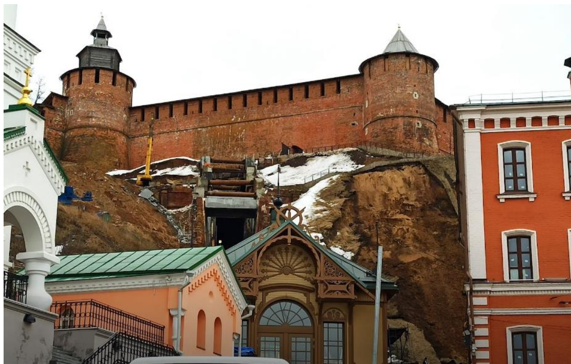
Фото 52-11-00002. Активное проявление оползневой процесса у Северной башни Нижегородского кремля, ул. Рождественская, г. Нижний Новгород, Нижегородская область, 25 марта 2023 г.
