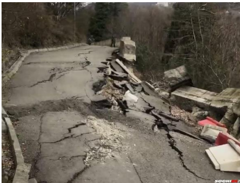
Фото 23-11-00356. Разрушенная в результате активизации оползневого процесса часть автодороги на территории МО г. Сочи, Хостинский район, жилой район Хоста, ул. Самшитовая (дорога к Национальному парку Тисо-самшитовая роща). Фото из открытых источников СМИ
