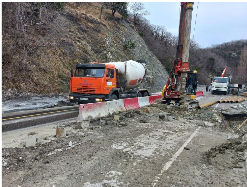
Фото 23-11-00215. Разрушенная в результате активизации оползневого процесса часть автодороги на 115 км федеральной трассы А147 в с. Волконка. Фото из открытых источников СМИ
