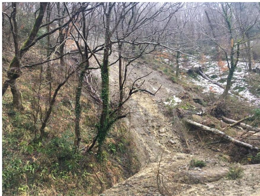
Фото 23-11-00213. Активное проявление оползневой процесс на 126 км автодороги А147 в с. Зубова Щель. МО Сочи, Лазаревский район, Краснодарский край. Фото из открытых источников СМИ
