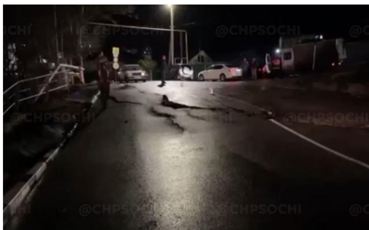
Фото 23-11-00353. Отрезок автодороги, деформированной в результате активизации оползневого процесса на территории МО г. Сочи, Хостинский район, с. Прогресс, ул. Юбилейная (на пересечении с пер. Ахунским). Фото из открытых источников СМИ
