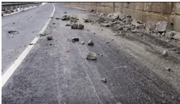
Фото 23-10-00101. Смещенный на полотно автодороги обломочный материал, в результате активизации обвального процесса на территории МО г. Сочи, Хостинский район, с. Измайловка, ул. Измайловская (в районе поворота на Змейковские водопады). Фото из открытых источников СМИ
