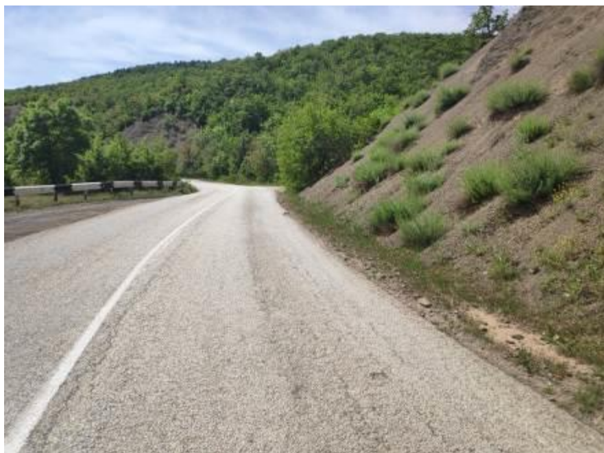
Фото 91-10-05301 Осыпи и отдельные камнепады со склона водораздела, южная часть
