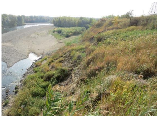
Фото 26-11-00148. Оп. №2994. Смещения не высокой интенсивности на локальном участке левой части оползня в зоне транзита и языке
