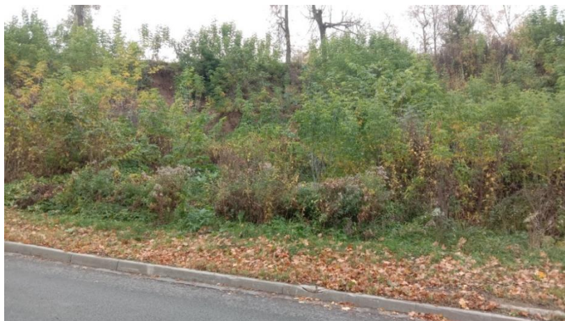
Фото 43-22-00003. Промоины в левом борту Раздерихинского оврага г. Кирова Кировской области
