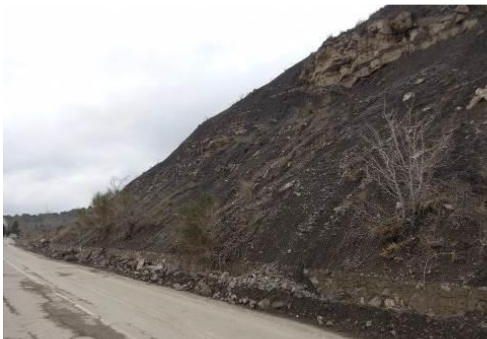
Фото 91-12-06001 Осыпь дресвяно-щебнисто-глинистой фракции в верховой обочине автодороги. Камнепады на дорогу
