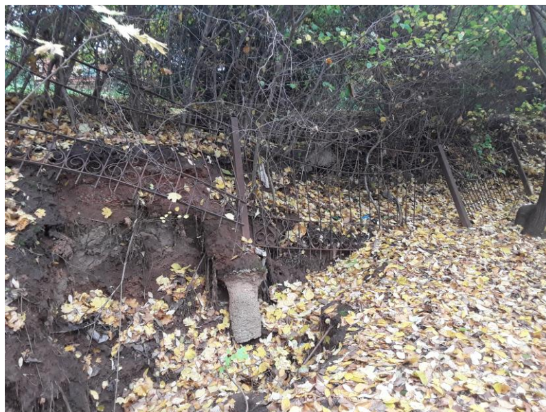
Фото 21.11.00001. Развитие оползневого процесса в северо-западной части, ул. Семена Ислюкова г. Чебоксары, Чувашская Республика
