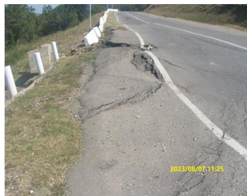
Фото 20-11-00427. Автодорога с. Бетти – Мохк - с. Совраги, 4,58 км Активизация оползня
