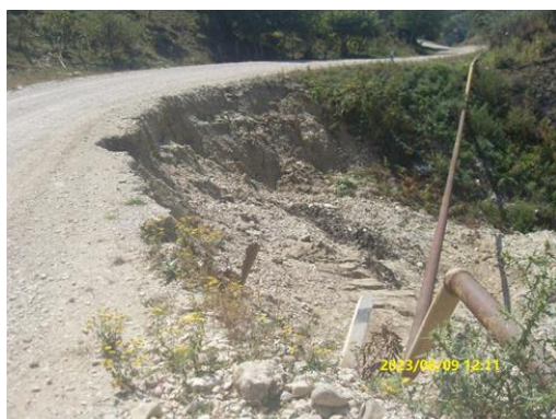
Фото 20-11-00555. Автодорога с. Мехкешты - с. Зандак – 4,7 км. Активизация оползня
