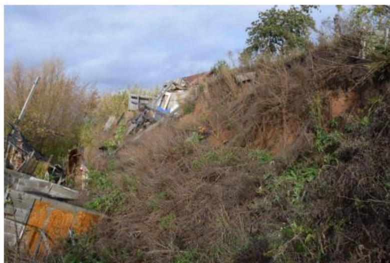
Фото 16-11-000017 Продолжается смещение грунта по ул. Маринина, октябрь 2023 г., Чистополь, Чистопольский муниципальный район, Республика Татарстан
