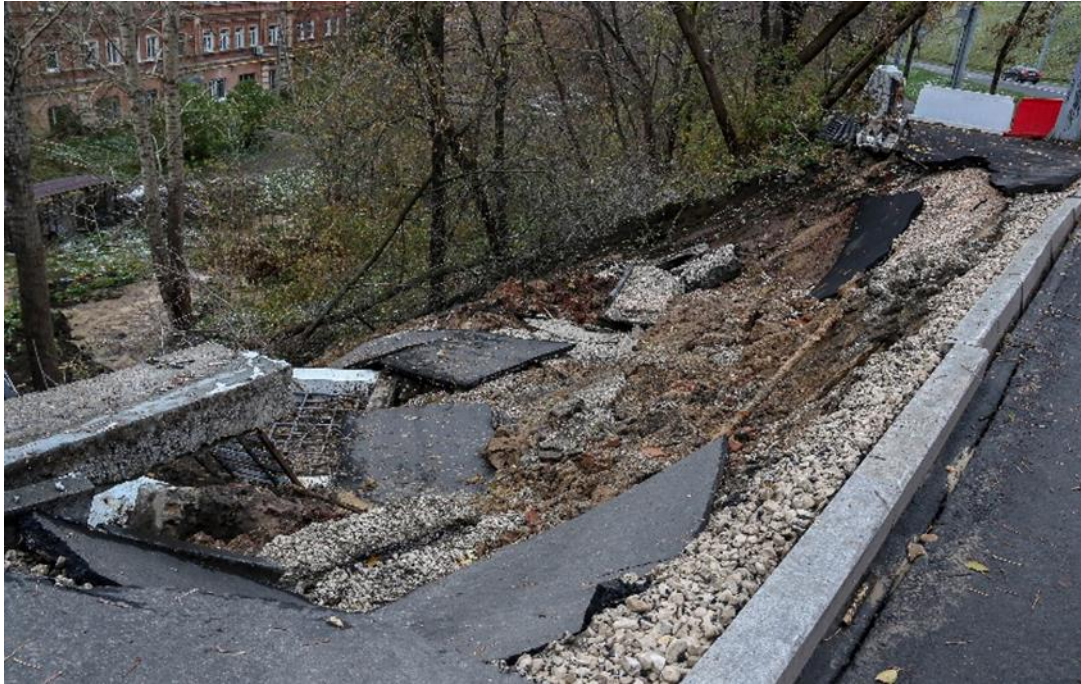
Фото 52.11.00348 (549). Активизации оползневого процесса в черте г. Нижнего Новгорода, на правом борту Почаинского оврага. Нижегородский район, октябрь 2023 г.
