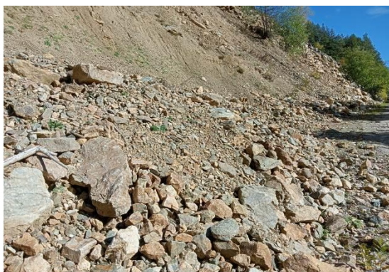
15-12-00051. Среднеобломочная осыпь на км 8,6 автодороги Бурон – Цей
