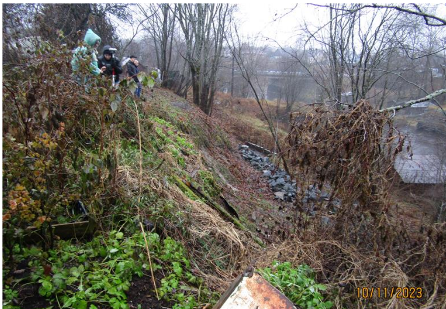
Фото 10.11.0006. Оползень в пгт. Хелюля (Сортавальское шоссе, д. 26) Республики Карелия. 11.10.2023 г.
