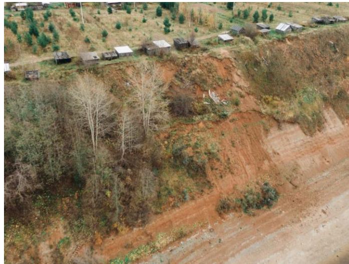
Фото 29.11.0017. Вид на оползневой склон южнее ДОКа, д/ж ст. Заовражье, Архангельская область. 14.10.2023 г.
