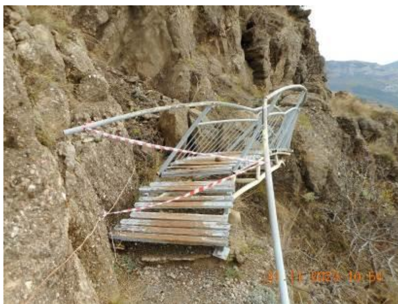
Фото № 92.11.0003. Повреждение пешеходного мостика. Объем обвала около 1,5 м 3 . (дата съемки 21.11.2023 г.)
