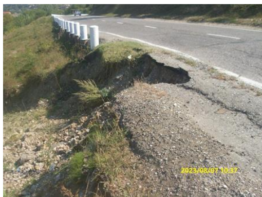
Фото 20-11-00054. Автодорога с. Бетти – Мохк - с. Совраги, 2,14 км Активизация оползня
