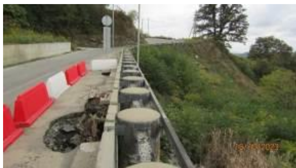
Фото 23.11.00525. Активизация оползневой процесса в низовом откосе автодороги по ул. Липецкая в с. Липники в городе-курорте Сочи
