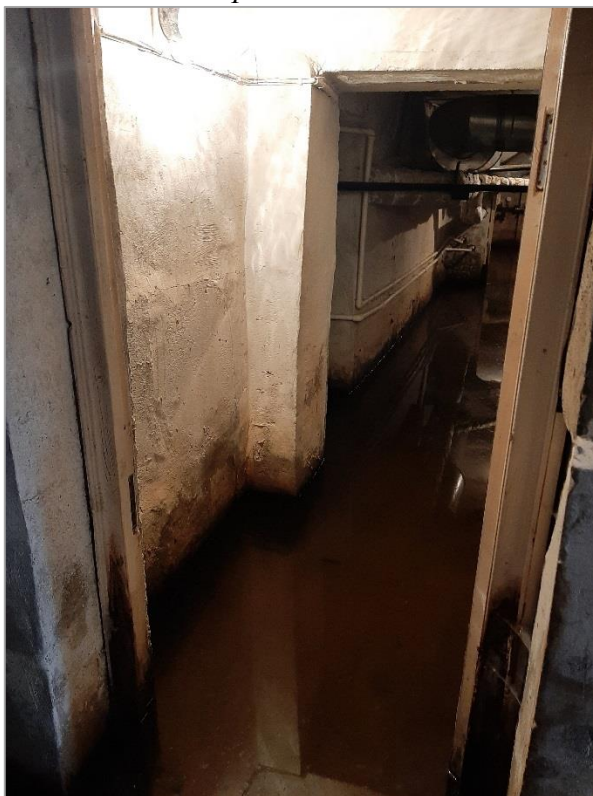
Фото 47.13.0024. Подтопление подвального помещения д. 25/6 по ул. Ленина на
