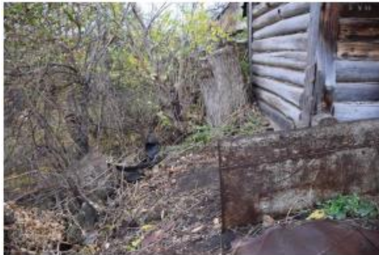
Фото 16-11-00001 Воздействие оползня на жилой дом по ул. Чапаева, 14, октябрь 2023, г. Чистополь, Чистопольский муниципальный район, Республика Татарстан
