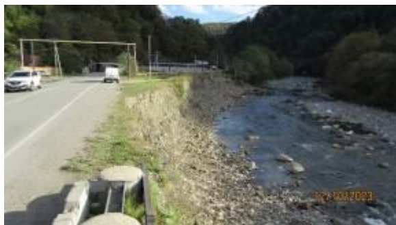
Фото 23.11.00430. Активизация оползневой процесса в низовом откосе автодороги по ул. Краснодарская, на правом берегу р. Сочи в городе-курорте Сочи
