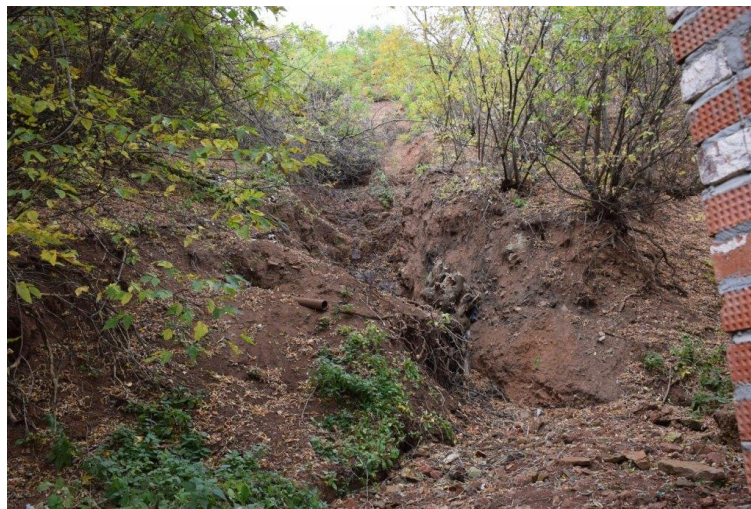
Фото 43-10-00002. Промоина за зданием ул. Пристанская, д. 5 г. Кирова Кировской области
