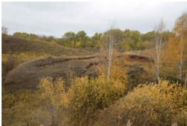
Фото 16-11-00153 Оползень скользя в конце 4 репера створа 2 на левом борту оврага Восточный, октябрь 2023 г., пгт. Рыбная Слобода, Рыбно – Слободский район, Республика Татарстан
