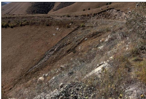
Фото 07-11-00102. Оползень на нижнем отк автодороги Кисловодск - Долина нарзанов Джилысу на правом борту долины левого притока р. Харбас
