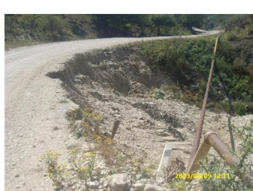
Фото 20-11-00089. С. Байтарки, западная окраина. Активизация оползня
