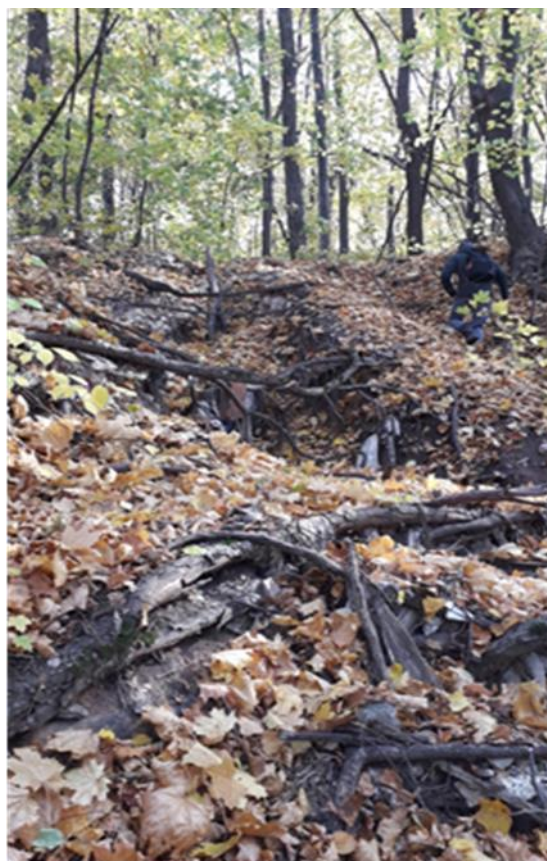
Фото 02-22-00007. Активный овраг в междурьях 7 и 8 оврагов, Южный участок Уфимского косогора, г. Уфа Республика Башкортостан
