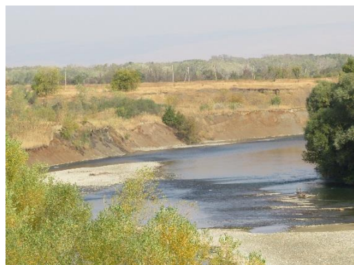
Фото 26-11-00064. Оп. №1209. Смещения на локальных участках левой и правой частях оползня в откосах и у их основания
