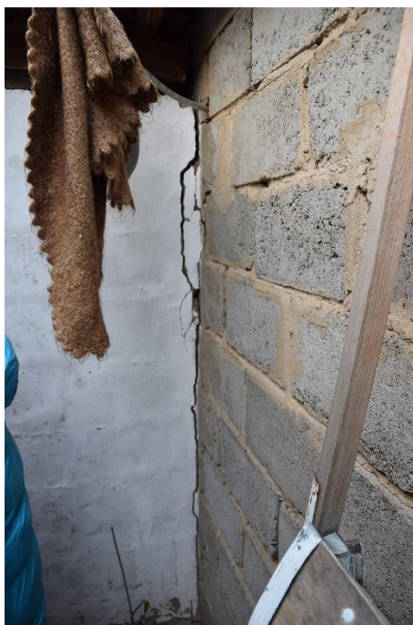
Фото 16-11.00003 Трещина стены дома 210 по ул. Бебеля, октябрь 2023 г., Чистополь, Чистопольский муниципальный район, Республика Татарстан
