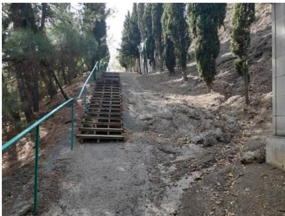
Фото 91-11-00732 Оползень № 732, верхняя часть, правый борт. Трещины и деформации на пешеходной дорожке
