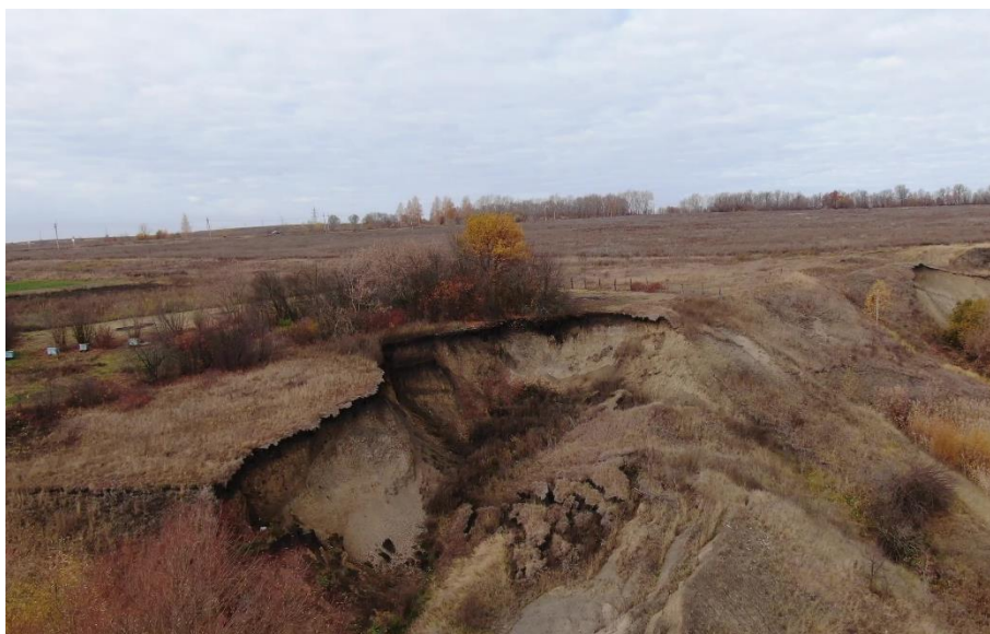
Фото. 21.11.00031. Развитие оползневого процесса на северной окраине д. Стемасы Алатырский мун. округ, Чувашская Республика
