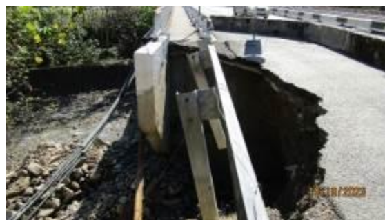
Фото 23.11.00544. Разрушение автодороги в результате активизации оползневой процесса на правом берегу р. Мацеста в с. Краевско-Армянское города – курорта Сочи.
