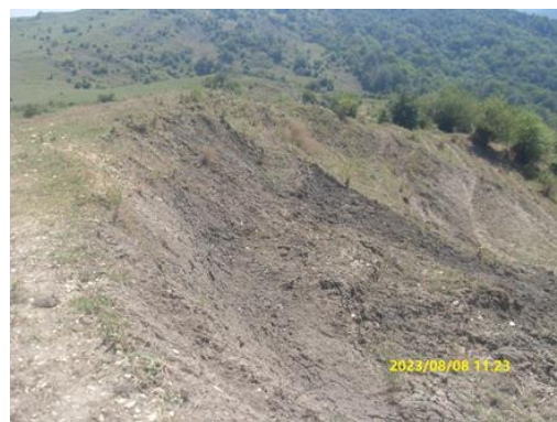
Фото 20-11-00077. Автодорога с. Мехкешты - с. Зандак – 4,3 км. Активизация оползня
