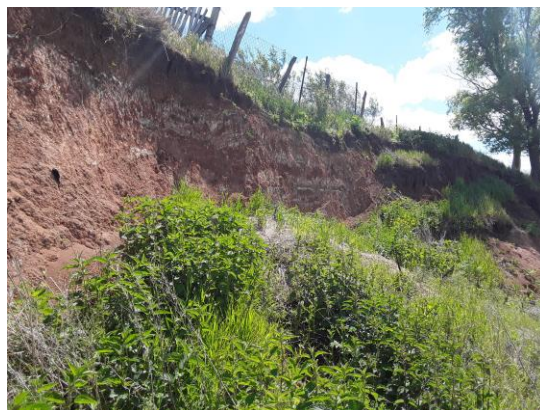
Фото 21.11.00039. Развитие оползневого процесса на южной окраине д. Пиндиково Козловского мун. округа, Чувашская Республика
