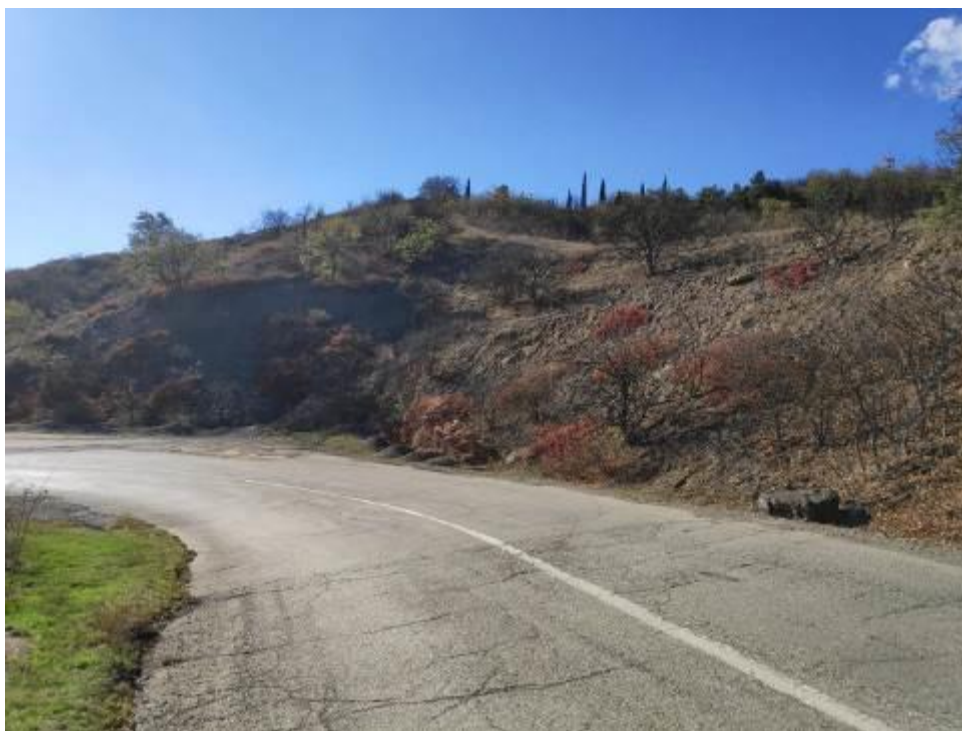
Фото 91-11-00736 Оползень № 736, средняя часть, правый борт. Мелкие трещины 3-5 мм на асфальте
