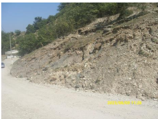
Фото 20-11-00575. С. Байтарки. Активизация оползня
