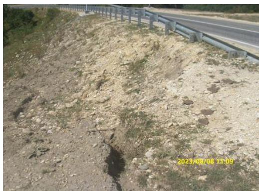
Фото 20-11-00574. Автодорога с. Мехкешты - с. Зандак – 4,3 км. Активизация оползня
