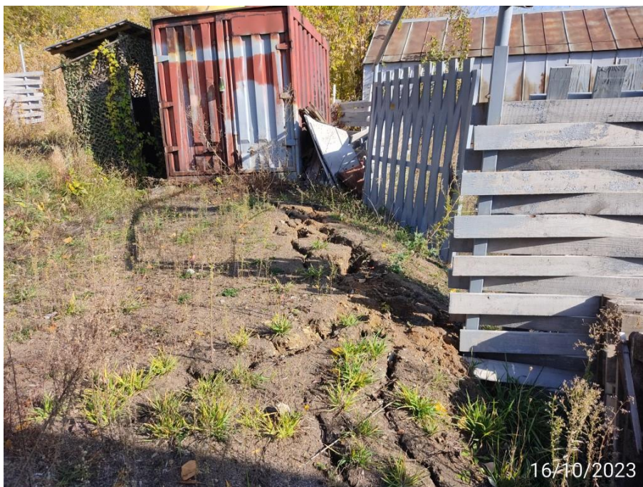
Фото 63.11.00004. Бугры вспучивания на территории дачи, расположенной в нижней части оползня, г.Сызрань, 16.10.2023г. Самарская область
