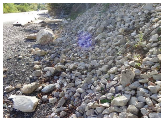
15-12-00116. Среднеобломочная осыпь на км 6 автодороги Бурон - Цей
