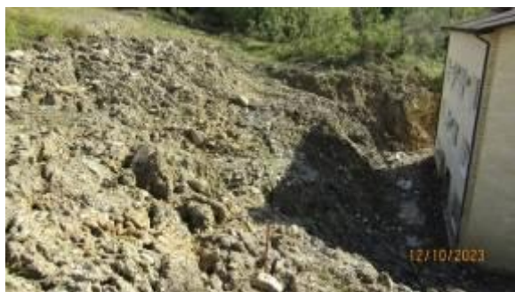
Фото 23.11.00355. Активизация оползневой процесса в районе ул. Яна Фабрициуса 66/6 города курорта Сочи. Наползание деляцсия на жилой многоквартирный дом.
