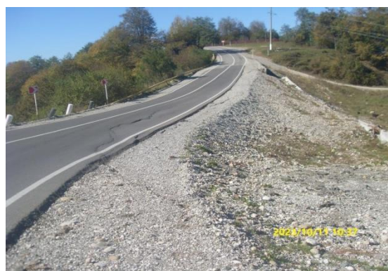
Фото 20-11-00515. С. Беной Активизация оползня
