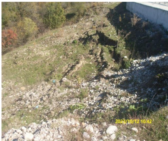
Фото 20-11-00457. С. Беной. Активизация оползня
