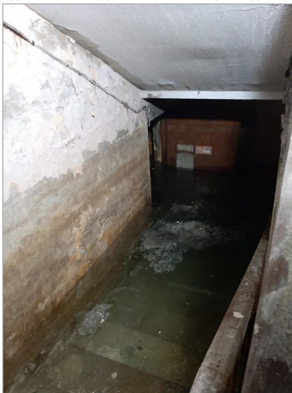
Фото 47.13.0025. Затопленные технологические ворота и подвал Сланцевской швейной фабрики, г. Сланцы, ул. Баранова, д. 20.
