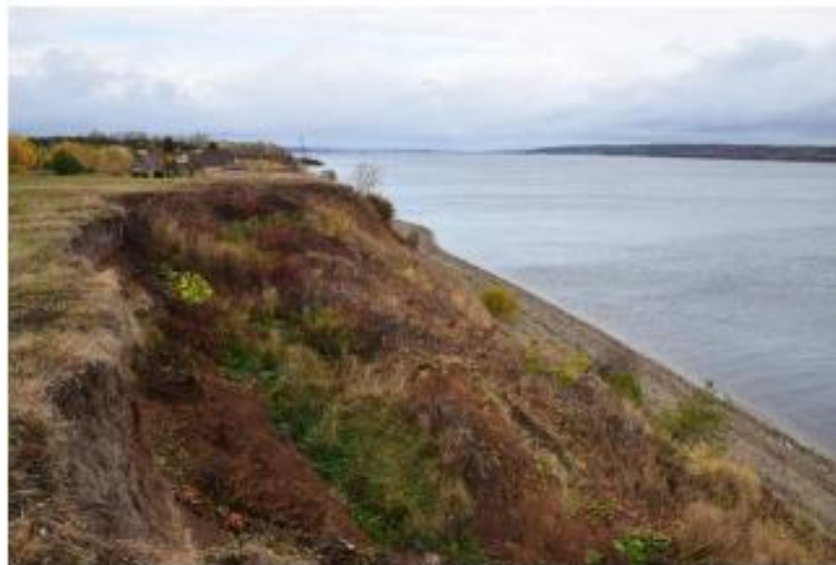
Фото 16-11-00274 Оползень скольжения на правом коренном берегу р. Волга у мечети, октябрь 2023 г., с. Кызыл – Байрак, Верхнеуслонский муниципальный район, Республика Татарстан
