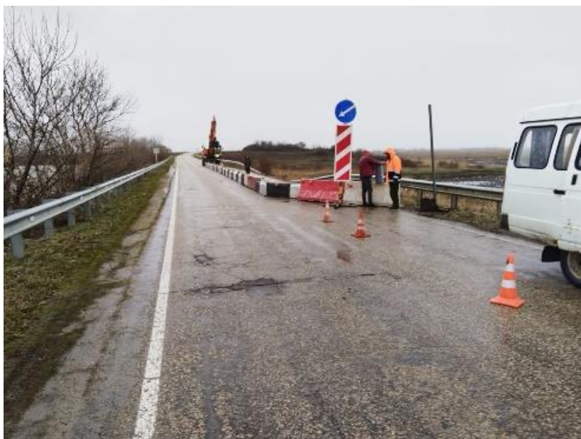
Фото 01-11-00117. Оползень в откосе дороги на участке дамбы вдоль Октябрьского водохранилища. Тахтамукайский район (автодорога 79А-110 Энем-Адыгейск-Бжедугхабль).
