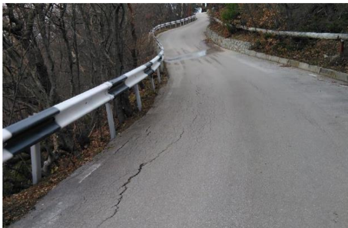
Фото 91-11-01205 Деформация покрытия автодороги на пгт. Санаторное, приуроченное к правому борту оползня.
