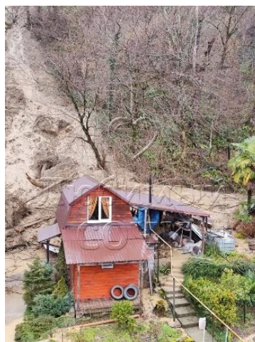
Фото 23-11-00582. Наползание оползневых масс на жилой дом. МО город-курорт Сочи, Адлерский район, с. Казачий Брод, СТ Пекан. Фото из открытых источников СМИ
