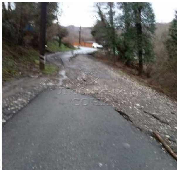
Фото 23-11-00578. Повреждение дорожного полотна в результате оползня по ул. Шолоховская. МО город-курорт Сочи, Адлерский район, с. Воронцовка. Фото из открытых источников СМИ
