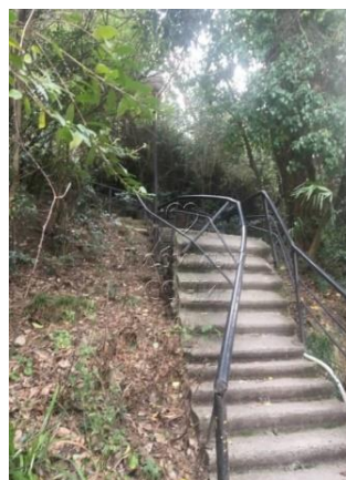
Фото 23-11-00583. Деформация бетонной лестницы в результате активизации оползня. МО город-курорт Сочи, Центральный район, мкр. Завокзальный. Фото из открытых источников СМИ
