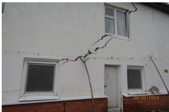
Фото 23-11-00509. Диагональные трещины растяжения на жилом доме. МО город-курорт Сочи, Лазаревский район, с. Волковка. Фото ЮРЦ ГМСН «Гидроспецгеология»
