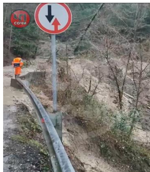
Фото 23-11-00579. Перекрытие участка дороги оползнем. 03К-465 «Подъезд к с. Красная Воля» 4 км +200 МО город-курорт Сочи, Адлерский район. Фото из открытых источников СМИ
