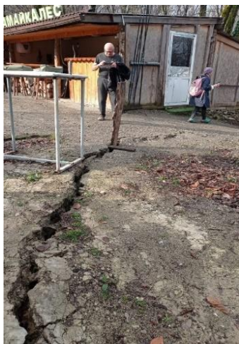
Фото 23-11-00584. Трещина бокового отпора оползня в районе базы отдыха «Мамайка Лес». МО город-курорт Сочи, Лазаревский район. Фото из открытых источников СМИ
