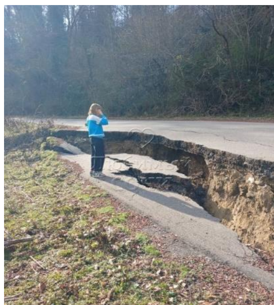
Фото 23-11-00576. Разрушенное дорожное полотно в результате активизации оползня. МО город-курорт Сочи, Адлерский район, с. Галицыно. Фото из открытых источников СМИ
