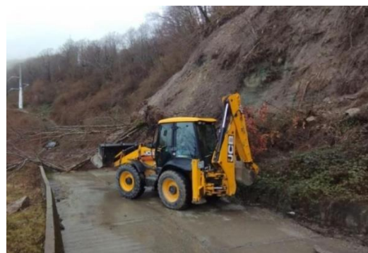
Фото 23-11-00538. Оползень в верховом откосе дороги. МО город-курорт Сочи, Адлерский район, с. Ахштырь, ул. Кропоткинская у Пункта пограничного контроля. Фото из открытых источников СМИ
