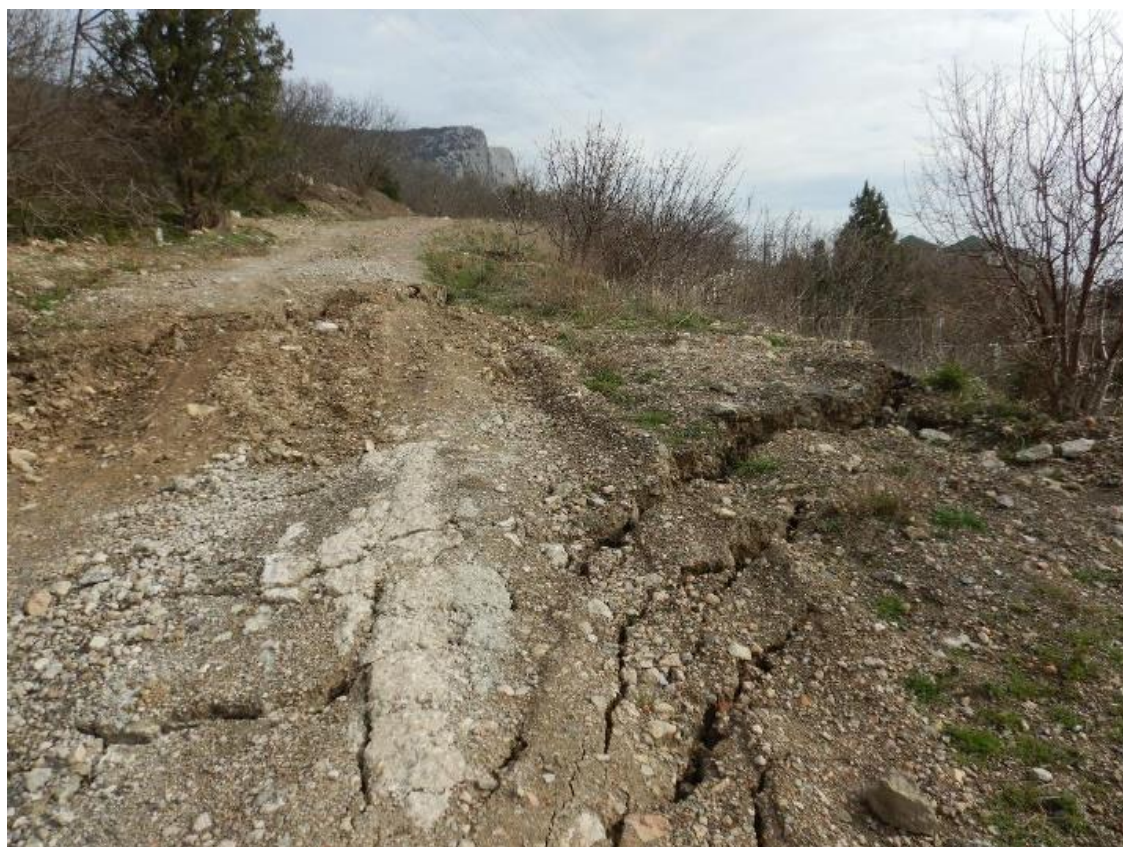
Фото 91-11-01102 Свежие деформации на грунтовой автодороге, приуроченные к левому борту оползневого очага, г.о. Ялта, пгт. Форос
