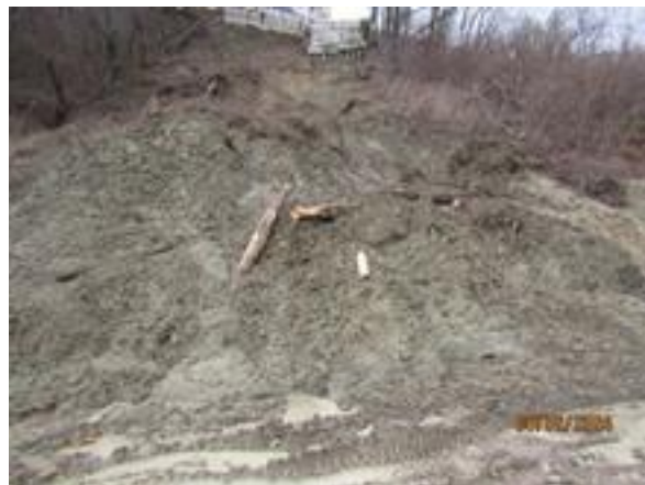
Фото 23-11-00189. Оползень в г.Туапсе в районе улиц Кириченко и Калараша. Фото ЮРЦ ГМСН «Гидроспецгеология»
