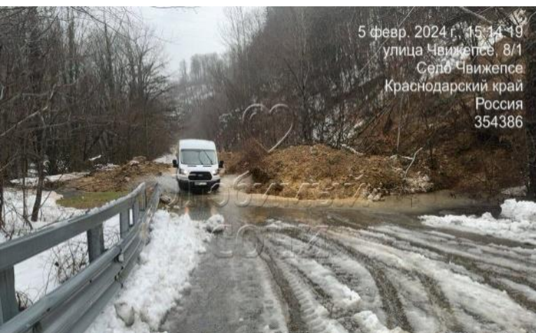
Фото 23-11-00312. Перекрытие оползневыми массами проезжей части автодороги. МО город-курорт Сочи, Адлерский район, с. Чвижепсе. Фото из открытых источников СМИ
