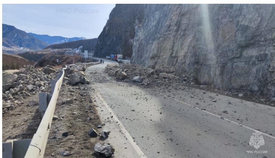
Фото 04-10-00004. Обвал на отрезке автодороги (Р-256 «Чуйский тракт», 686 км). Онгудайский район, Республика Алтай, 27.03.2024 г.
