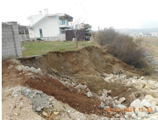
Фото 92-11-0004. Головной срыв оползня в районе придомовой территории по ул. Мускатная д. 37, 39, Балаклавский район (05.03.2024 г.)
