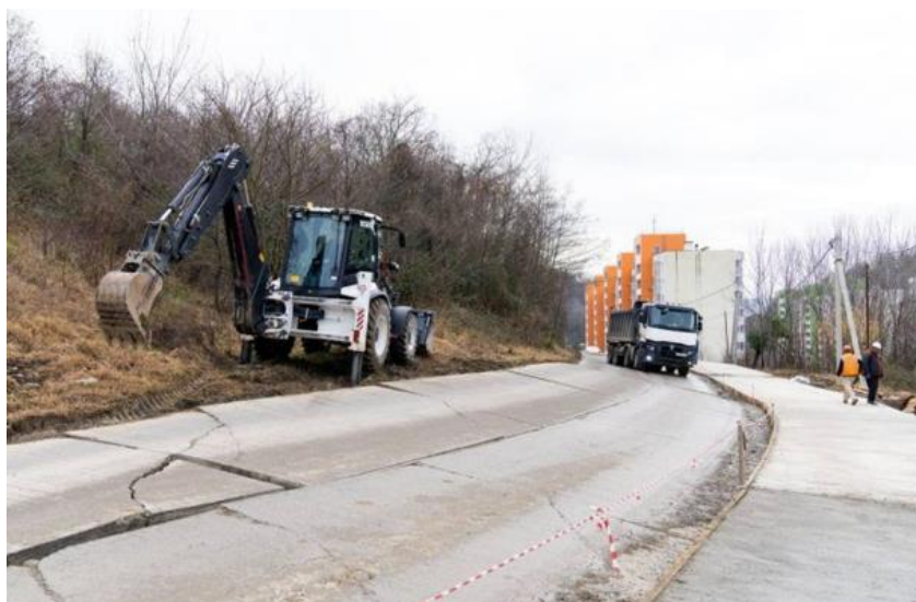
Фото 23-11-00574. Деформация бетонной дороги вследствие оползневого процесса. МО город-курорт Сочи, Хостинский район, с. Раздольное. Фото из открытых источников СМИ
