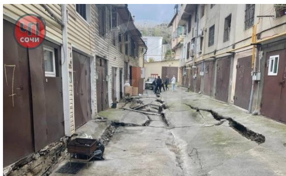
Фото 23-11-00585. Деформации дорожного полотна, жилых гаражей при активизации оползневого процесса. МО город-курорт Сочи, Центральный район, мкр. Больничный городок. Фото из открытых источников СМИ
