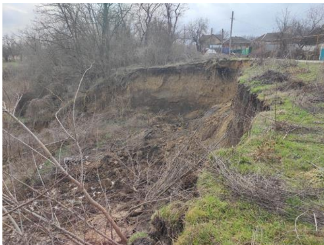
Фото 26-11-00116. Стенка срыва оползня с захватом обочины проезжей части по ул. Егорлыкской в ст. Новотроицкой Изобильненского МО
