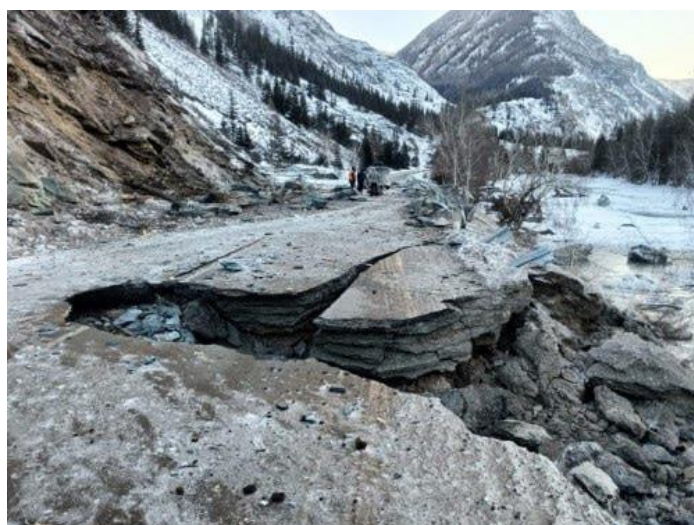
Фото 04-10-00005. Разрушенный участок автодороги Р-256 764,525-764,86 км «Чуйский тракт» в результате обвала. Онгудайский район, 19.01.2024 г.
