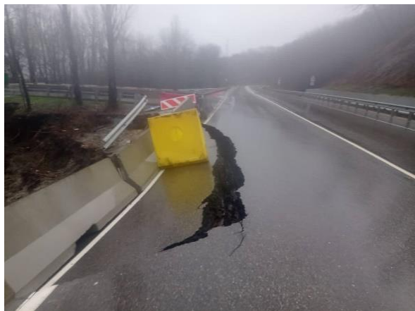
Фото 23-11-00262. Оползень на участке автодороги М4 «Дон» (1492-й км). Муниципальное образование г. Геленджик. Фото из открытых источников СМИ
