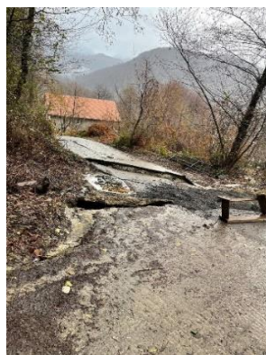
Фото 23-11-00567. Деформация дорожного покрытия в результате активизации оползня по ул. Мичурина. МО город-курорт Сочи, Адлерский район, с. Каштаны. Фото из сторонних источников.
