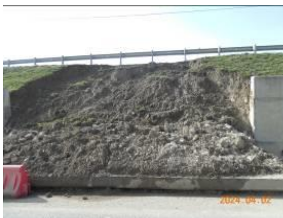
Фото 05-11-00027. Оползень в откосе дороги. Южный пост, ФАД Р-217 выезд из г. Махачкала в пос. Агачаул, Карабудахкентский район.
