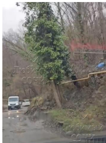
Фото 23-11-00490. Оползень в верховом откосе дороги. МО город-курорт Сочи, Хостинский район, мкр. Малый Ахун. Фото из открытых источников СМИ
