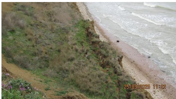
Фото 23-11-00023. Оползень в нижней части уступа, в 1,6 км от м. Панагия, Темрюкский район.
