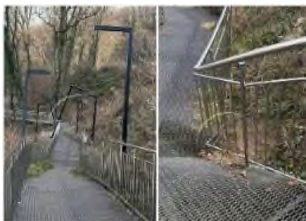
Фото 23-11-00648. Деформированная оползнем пешеходная дорожка в мкр.Бытха(город-курорт Сочи).
