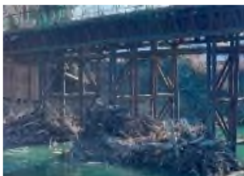
Фото 23-11-00291. Воздействие оползневой процесса на мост через р. Шапсуцхо в с.Лермонтово Туапсинского района.
