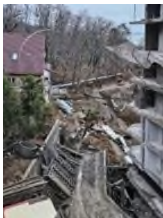
Фото 23-11-00647. Активизация оползневой процесса по ул.Есауленко 6А (город-курорт Сочи).
