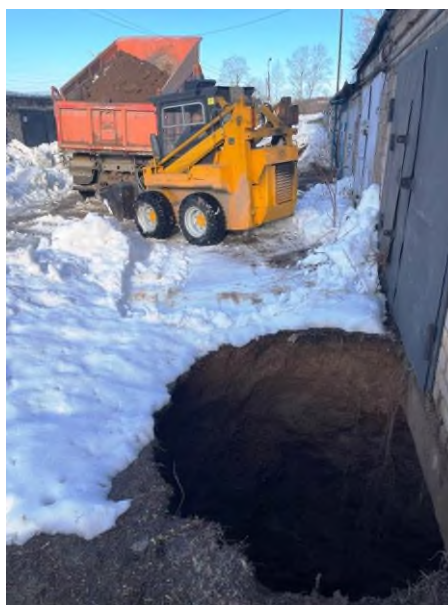
Фото 02-05-00259 Карстовый провал в г. Благовещенске на территории Гаражно- строительного кооператива № 1
