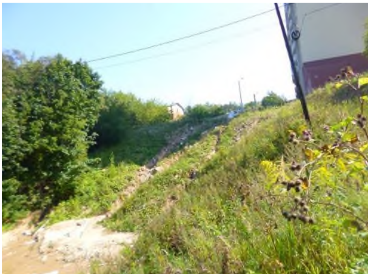
Фото 67-22-00002. Активный процесс овражной эрозии по ул. Шевченко, г. Смоленск, Смоленская область
