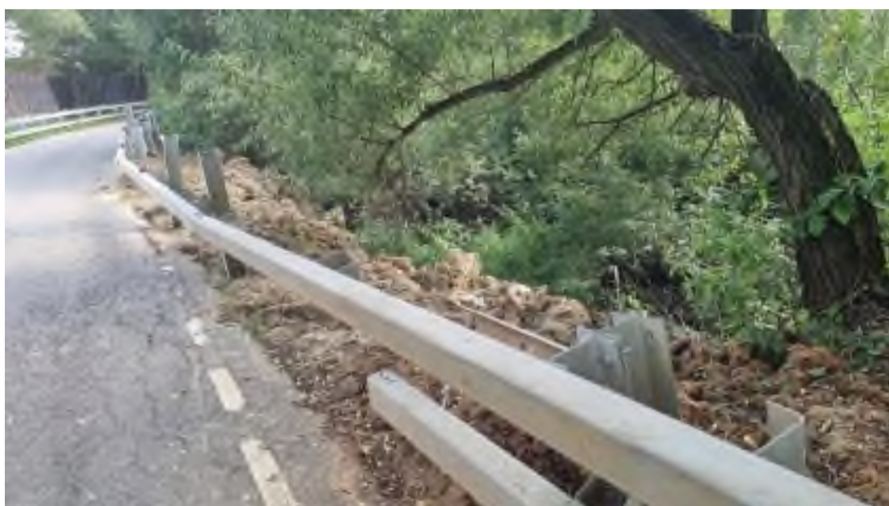
Фото 77-11-00070. Активный оползень по ул. Зимёнковская, д. Ларёво, г. Москва
