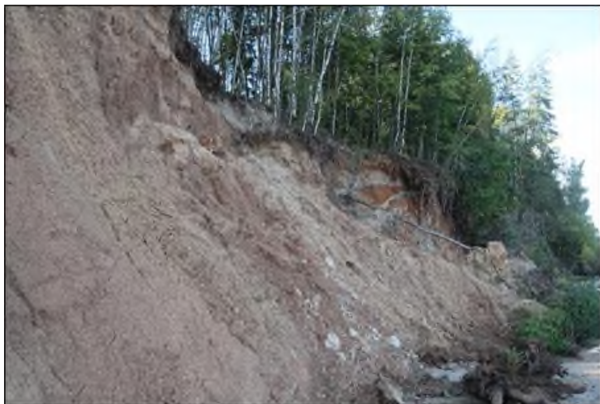
Фото 37-11-00110. Оползень в Пучежском районе, северо-восточнее д. Юшково, вдоль правобережного склона р. Волга (Горьковское вдхр.), Ивановская область
