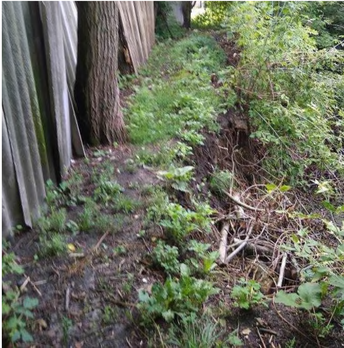
Фото 48-11-00112. Оползень в Чаплыгинском районе, г. Чаплыгин, ул. Подгорная, Липецкая область
