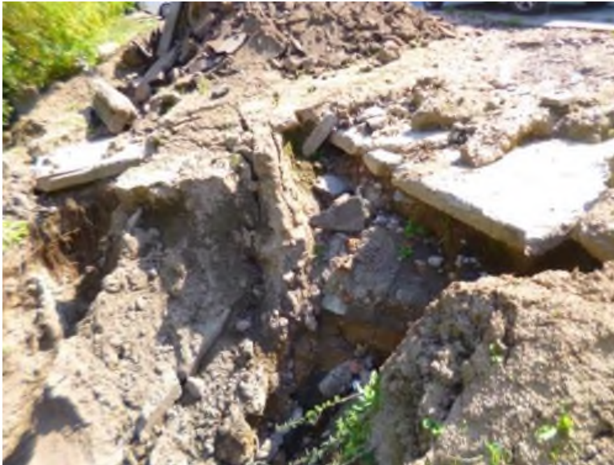
Фото 67-11-00144. Оползень по ул. Шевченко, г. Смоленск, Смоленская область
