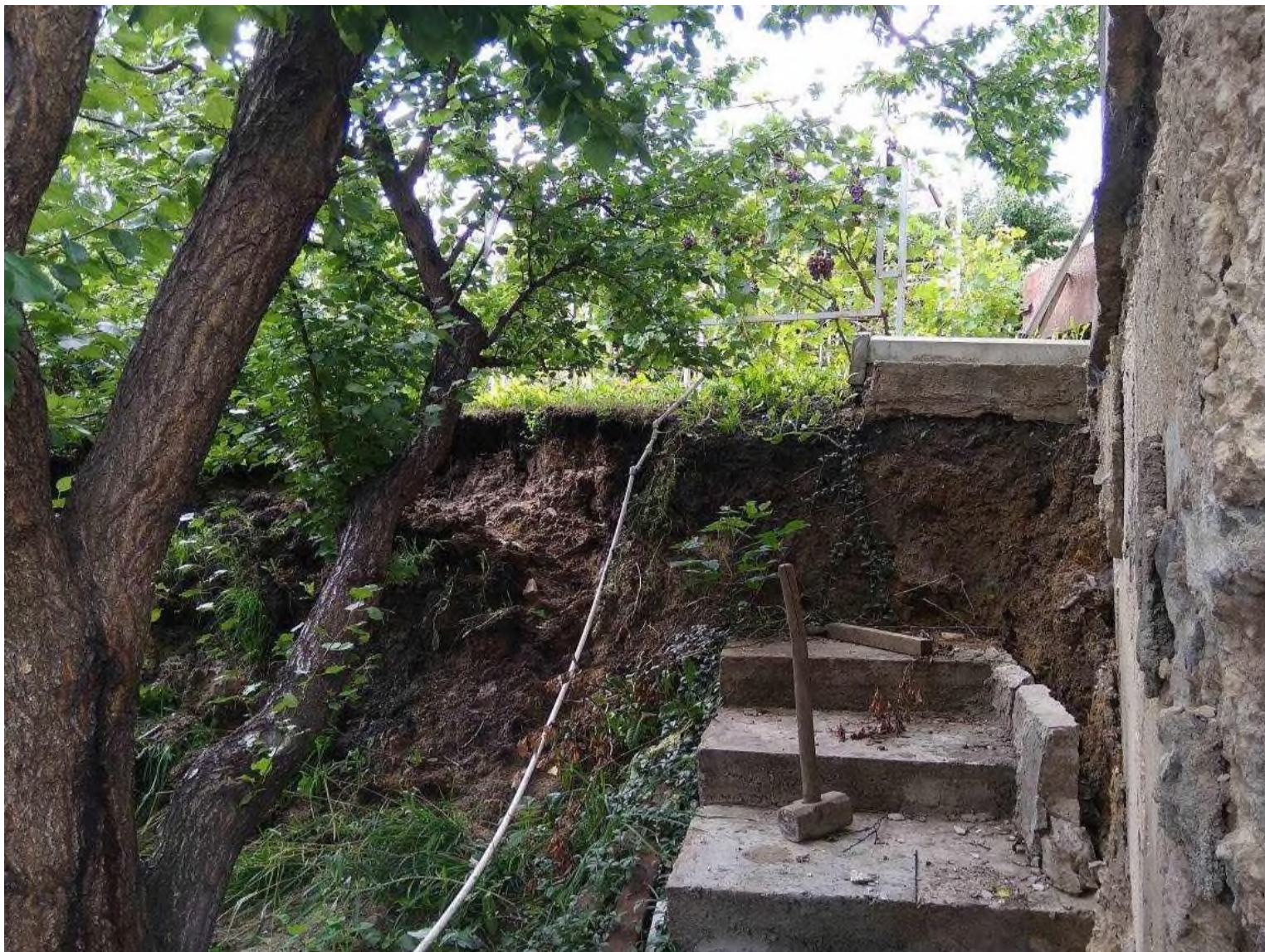
Фото 48-11-00117. Оползень в Липецком районе, с. Сырское, ул. Речная, д. 24, 25, 26, 27, 28, Липецкая область
