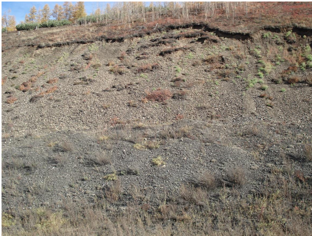
Фото 49.12.0003. Сусуманский муниципальный округ, г. Сусуман. Активизация осыпного процесса на участке 1405,5 км автодороги Р504 «Колыма» по состоянию на 05.09.2024 г. (фото Приморского отделения филиала «Дальневосточный региональный центр ГМСН»)
