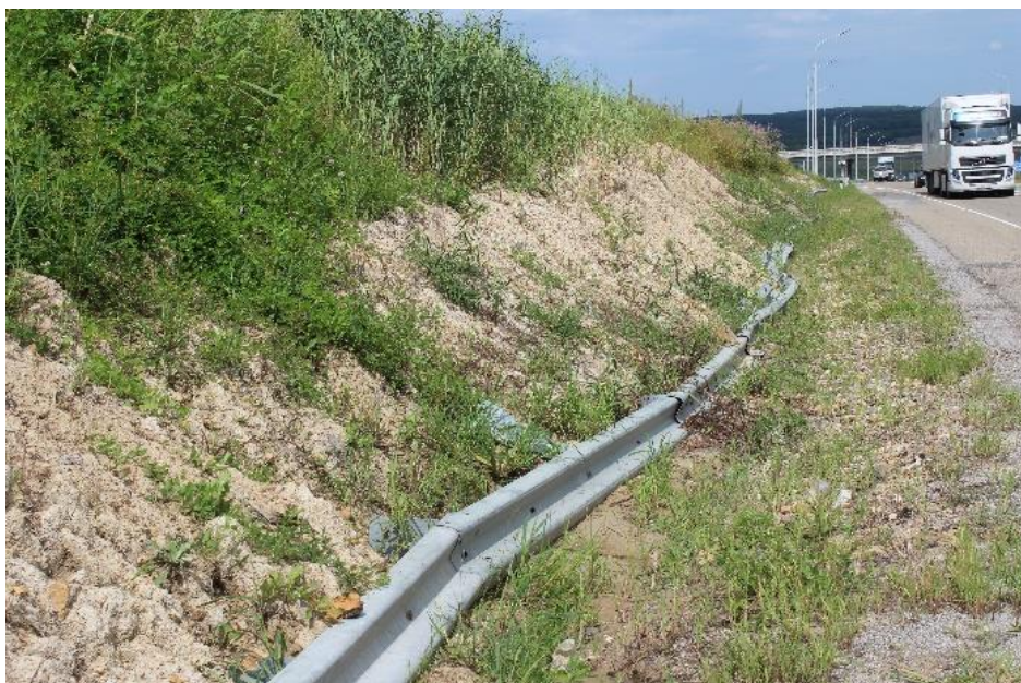
Фото 25.11.0005. Продолжение активизации оползневой процесса на участке 665, 03 км автодороги А-370 "Уссури" Хабаровск-Владивосток по состоянию на 26.08.2024 г
