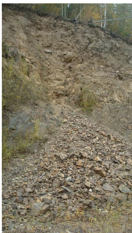
Фото 27-23-0016 Проявления осыпного процесса на 173 км А 376 в Нанайском районе 16.09.2024г.
