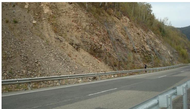
Фото 27-27-0012, Обвально-осыпной шлейф на участке 85 км А 376, Нанайский район Хабаровский край, 16.09.2024г.
