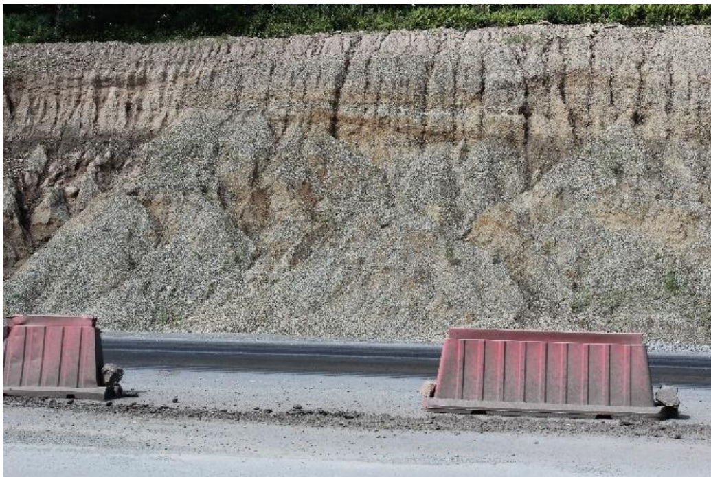
Фото 25.11.0001. Активизация оползневого в парагенезе с эрозийным процессом на участке 717,35 км автодороги А-370 «Уссури» по состоянию на 26.08.2024 г
