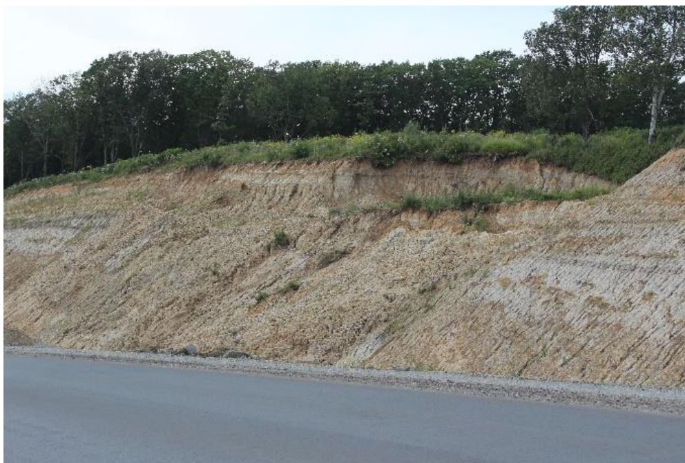
Фото 25.11.0002. Продолжение активизации оползневого процесса на участке 0,375 км от начала объездной дороги от 689,75 км автодороги А-370 «Уссури» по состоянию на 26.08.2024г
