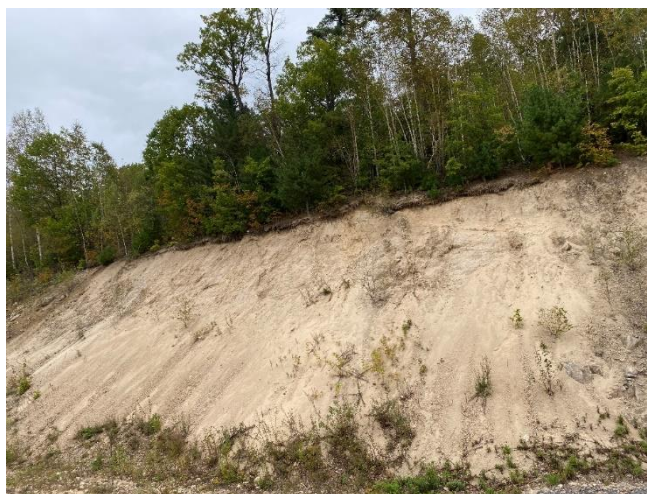
Фото 27-27-007, Обвальное-осыпное проявление выноса, на участке 68 км А 376, Нанайский район Хабаровский край, 16.09.2024г.
