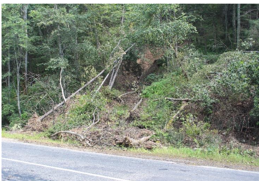
Фото 25.11.0007. Активизация оползневой процесса на участке 314,5 км автодороги Осиновка-Р. Пристань по состоянию на 28.08.2024 г
