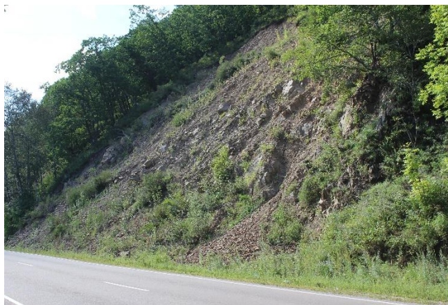
Фото 25.12.0009. Активизация оползневого процесса на участке 404,1 км автодороги Находка-Ольга-Кавалерово по состоянию на 28.08.2024 г
