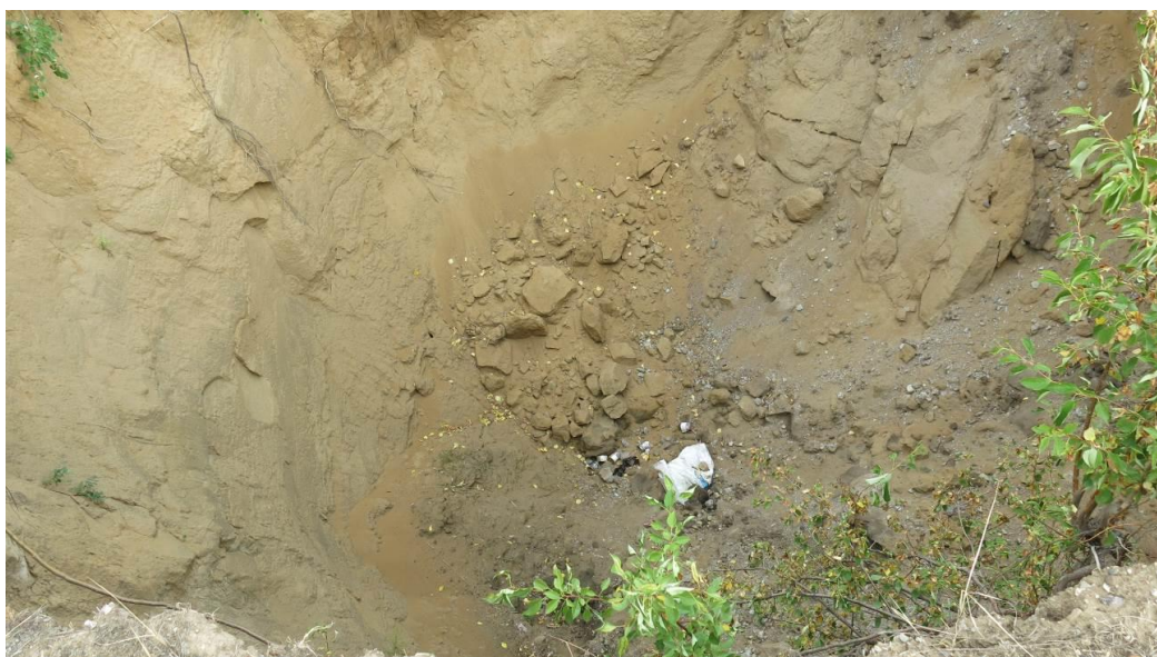
Фото 75-26-00001. Провал на Тасеевском шахтном поле, Балеийский район, Забайкальский край, 31.07.2024
