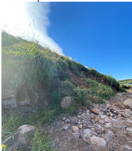
Фото 27-11-001 Проявления оползневого процесса на Побережье, Советско-Гаванский 17.09.2024г.
