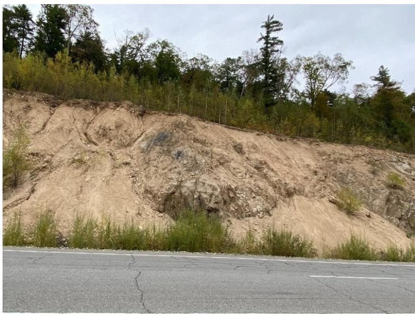
Фото 27-27-008, Обвальнo-осыпной конус на участке 69 км А 376, Нанайский район Хабаровский край, 16.09.2024г.
