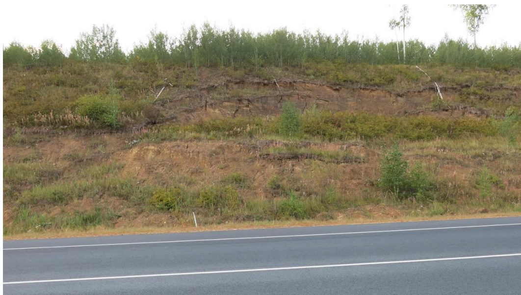
Фото 75-11-00003. Южная часть оползня у 70-го км на правом откосе а/дороги Чита-Хабаровск перед закрепленным участком склона, Карымский район, Забайкальский край, 31.07.2024
