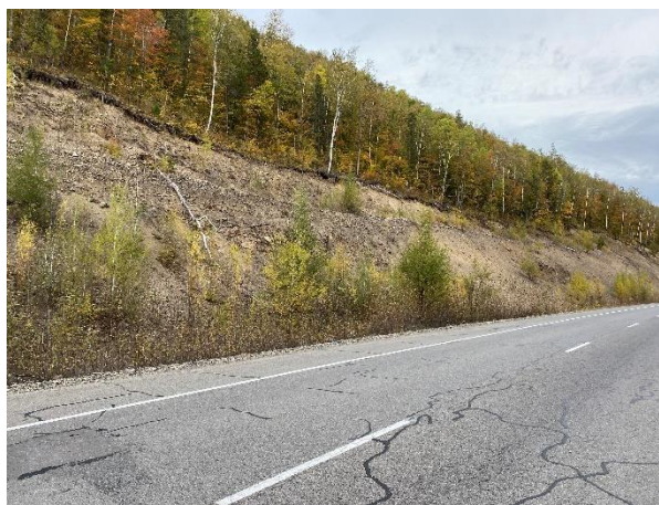
Фото 27-23-0015 Обвальнo-осыпной шлейф, на участке 136км А 376, Нанайский район Хабаровский край, 16.09.2024г.
