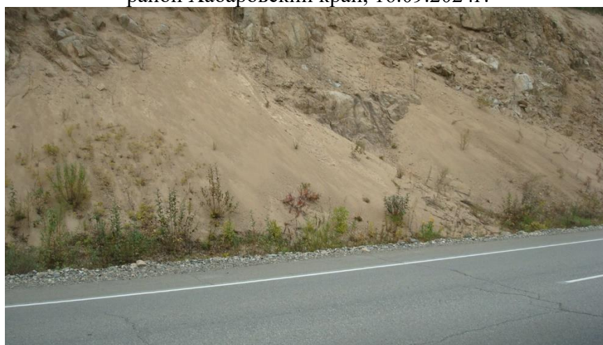
Фото 27-27-009, Обвальнo-осыпной конус на участке 76 км А 376, Нанайский район Хабаровский край, 16.09.2024г.
