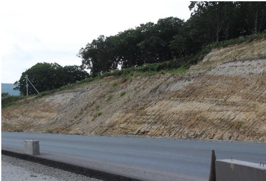
Фото 25.11.0003. Продолжение активизации оползневой процесса на участке 0,498 км от начала объездной дороги от 689,75 км автодороги А-370 «Уссури» по состоянию на 26.08.2024г Б.
