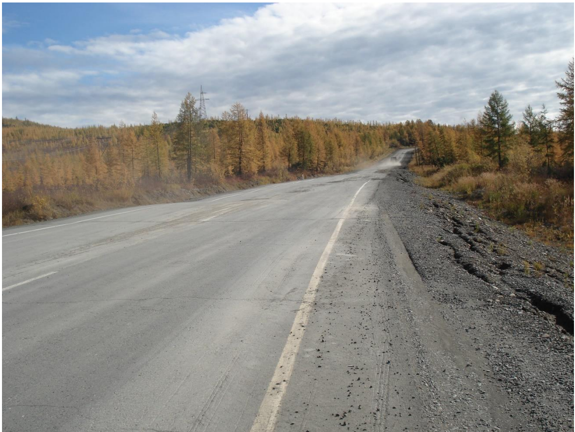
Фото 49.6.0005. Сусуманский муниципальный округ, г. Сусуман. Активизация криогенеза (пучение) на участке 1495,25, 3 км автодороги Р-504 «Колыма» по состоянию на 05.09.2024 г. (фото Приморского отделения филиала «Дальневосточный региональный центр ГМСН»)
