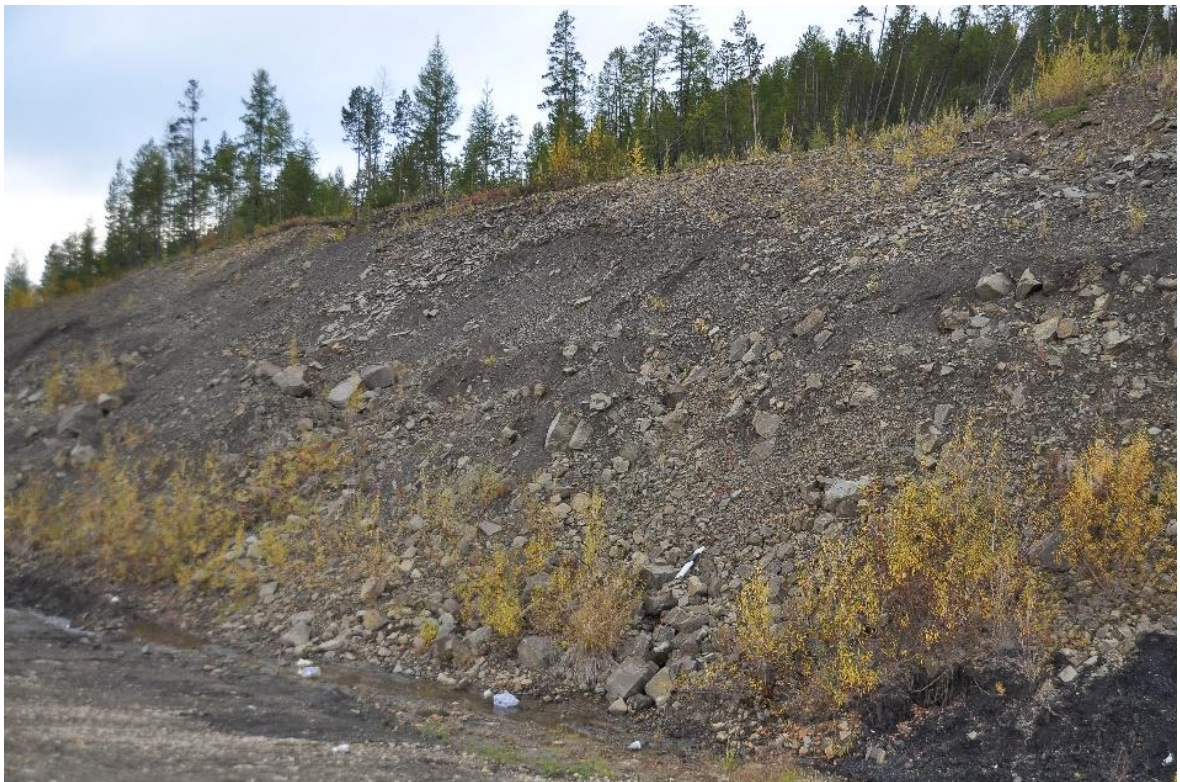
Фото 14-27-002 Активизация осыпного процесса на ТН-2 по состоянию на 07.09.2024 г. Нерюнгринский район республика Саха (Якутия)
