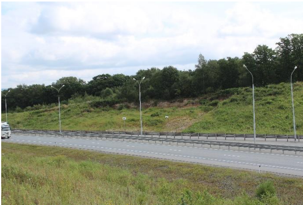
Фото 25.11.0004. Продолжение активизации оползневой процесса на участке 686, 8 км автодороги А-370 "Уссури" Хабаровск-Владивосток по состоянию на 26.08.2024 г
