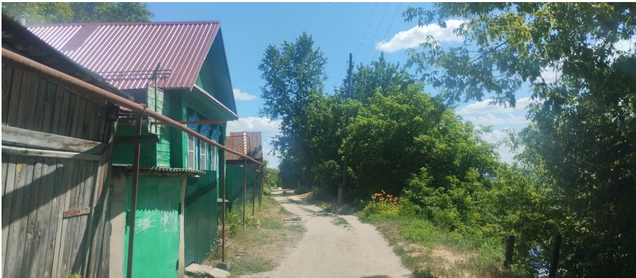
Фото 58-11-00056. Деформация газопровода и столба линий электропередач, ул. 5-я Линия, д. 9, г. Кузнецк, Пензенская область
