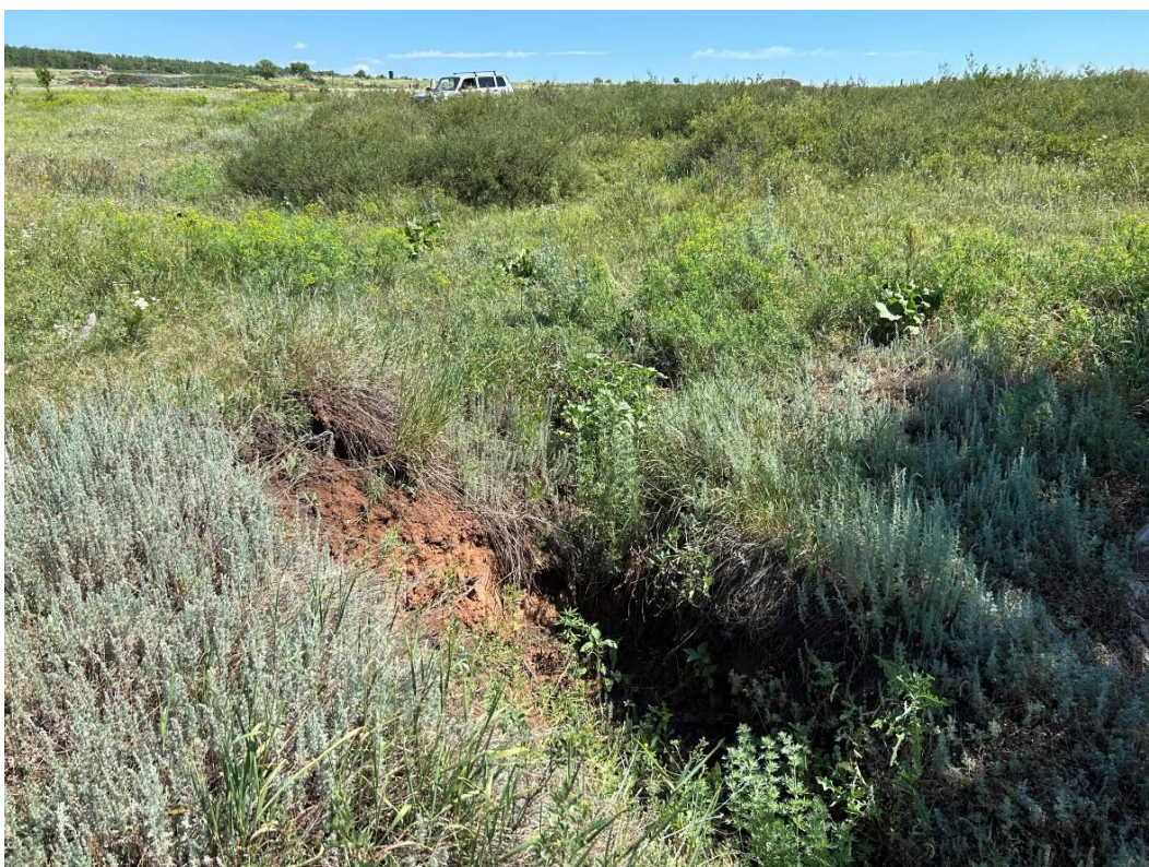
Фото 56-22-00004. Верховье наблюдаемого оврага. Вид в западном направлении. 0,5 км севернее с. Нижнеозерное, Илекский район. Оренбургская область
