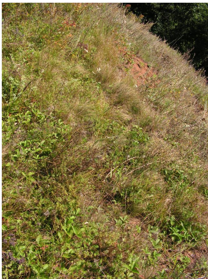
Фото 18-11-00033. Участок дежурных инженерно-геологических обследований «Чеганда», Каракулинский район, Удмуртская Республика. Август 2024 г. Оползневая трещина закола
