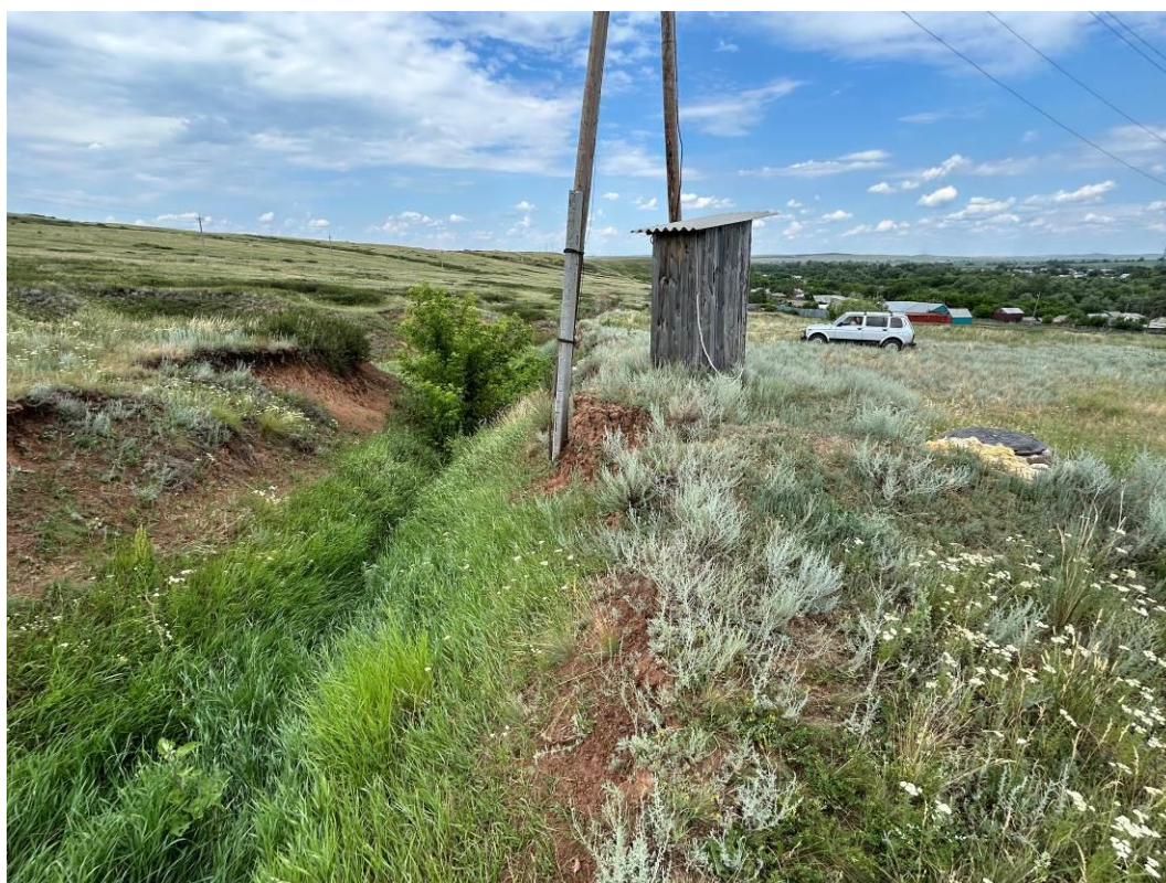
Фото 56-22-00005. Скважина и будка управления насосом. Вид в северном направлении. западная окраина с. Кулагино, Новосергиевский район, Оренбургская область
