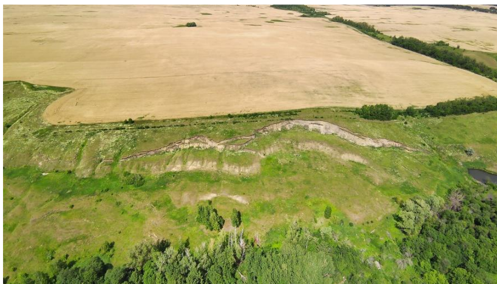
Фото 73-11-00139. Срывы грунта по бровке и застои грунтовых вод Ульяновская обл. Ульяновский р-н. с. Максимовка, ул. Солнечная
