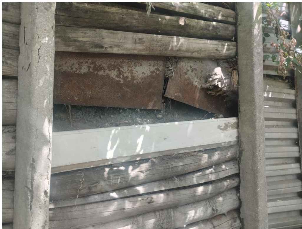
Фото 58-22-00059. Осыпание стенки оползня, ул. 3-я Линия, д.16, г. Кузнецк, Пензенская область
