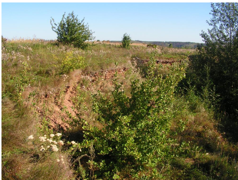
Фото 18-11-00036. Участок дежурных инженерно-геологических обследований «Колесниково», Каракулинский район, Удмуртская Республика. Август 2024 г. Стенка отрыва оползня вязкопластического течения
