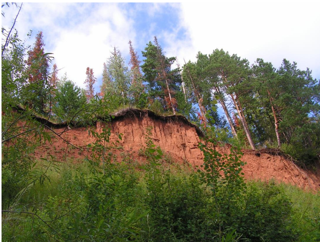
Фото 18-11-00028. Оползневой процесс. Участок дежурных инженерно-геологических обследований «Гольяны», Завьяловский район, Удмуртская Республика. Август 2024 г. Стенка отрыва и вершинная часть оползня вязкопластического течения
