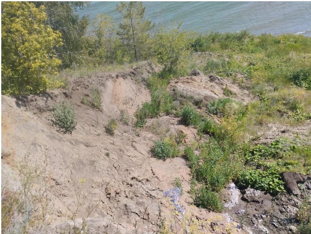
Фото 73-11-00051. Срывы, смещения грунта в районе левого борта оползня Ульяновская обл. Ульяновский р-н, снт. Родничок
