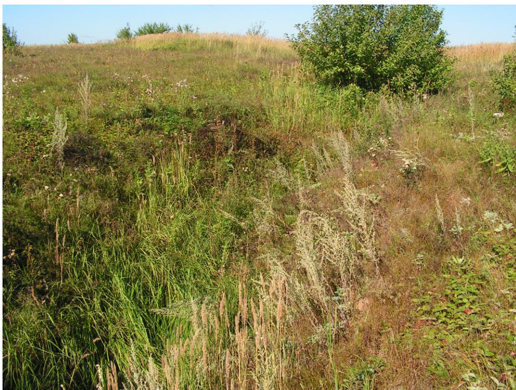
Фото 18-11-00034. Участок дежурных инженерно-геологических обследований «Чеганда», Каракулинский район, Удмуртская Республика. Август 2024 г. Оползневая трещина закола.
