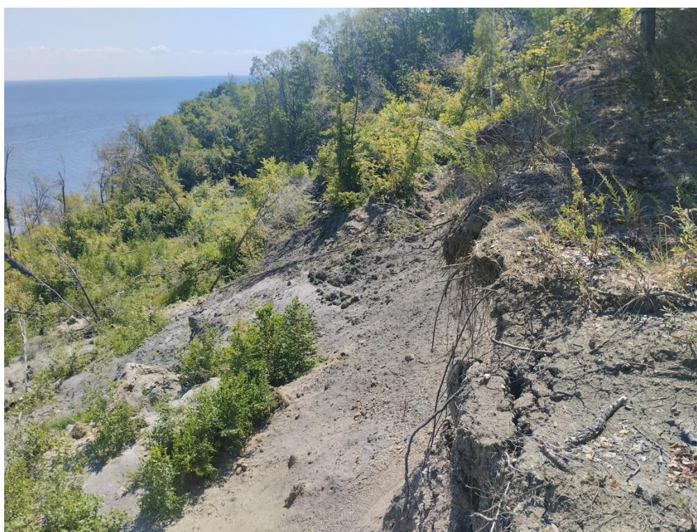
Фото 73-11-00062. Сплывы и осыпи грунта в районе правого борта оползня. Ульяновская обл. Сенгилеевский р-н, с. Буераки
