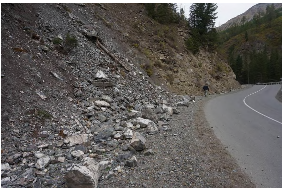
Фото 04-12-00011. Кюветы и обочина автодороги частично перекрыты глыбово-щебнистым материалом осыпных шлейфов, уч. а/дороги Акташ – Улаган, 5,85-6,03 км, Улаганский район, Республика Алтай, 03.09.2024
