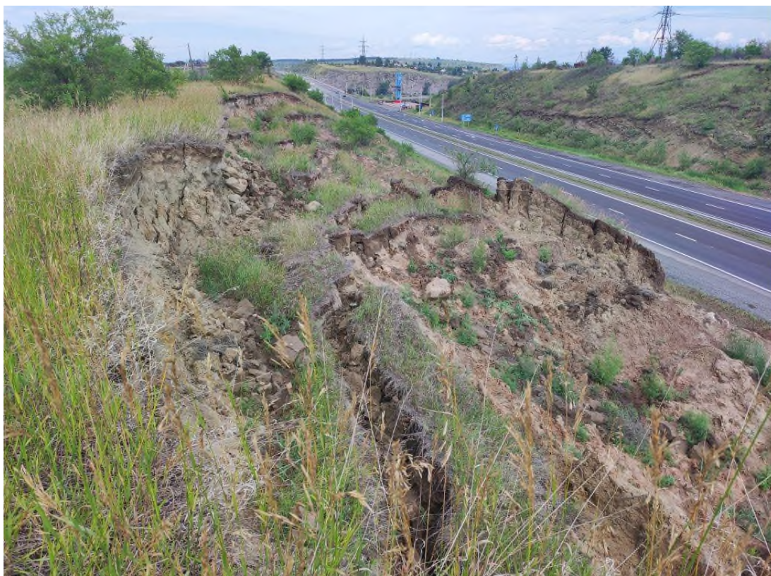
Фото 19-11-00002. Верхняя стенка отрыва оползня на левой стороне дороги на участке а/дороги Р-257, Братский мост, Алтайский район, Республика Хакасия, 19.07.2024
