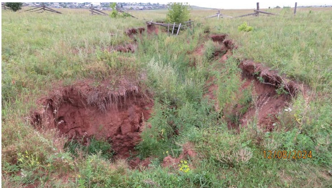
Фото 38-22-00009. Овраг №5, ПН Бильчир-2, п. Бильчир, Осинский район, Иркутская область, 12.08.2024
