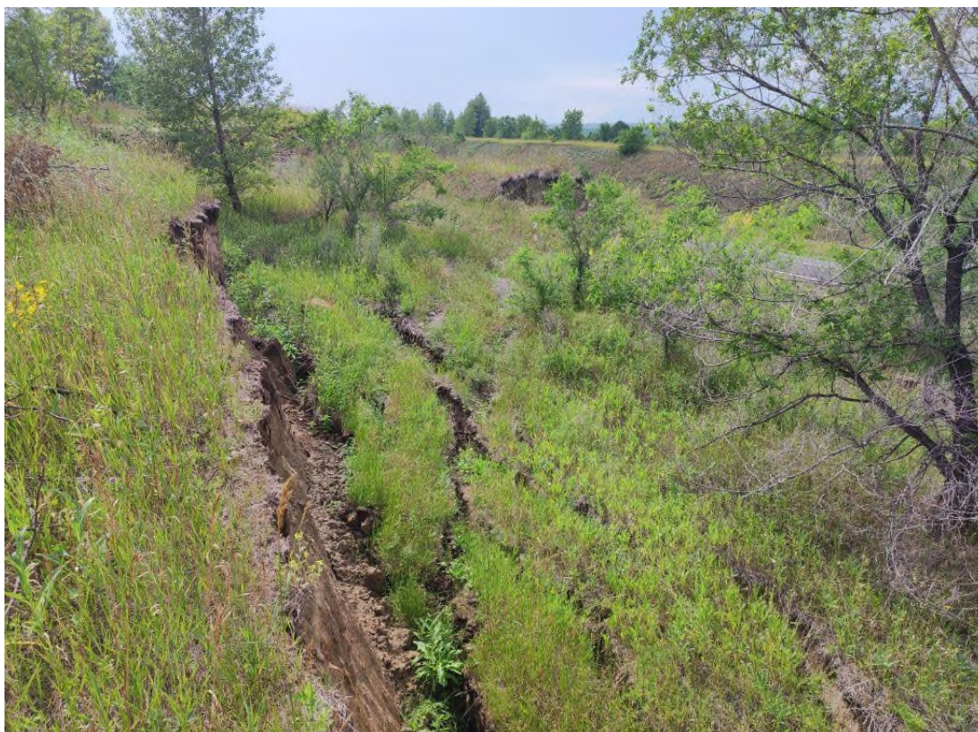
Фото 19-11-00004. Центральная часть стенки отрыва оползня 2 на участке а/дороги Р-257, Братский мост, Алтайский район, Республика Хакасия, 19.07.2024
