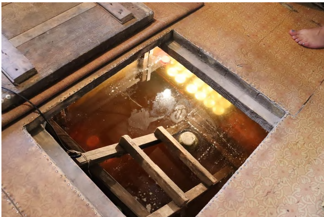
Фото 38-13-00004. Подтопленное подполье по ул. Ульяны Громовой, 17. УГВ находится на 0,77 м от поверхности, г. Зима, Иркутская область, 28.07.2024
