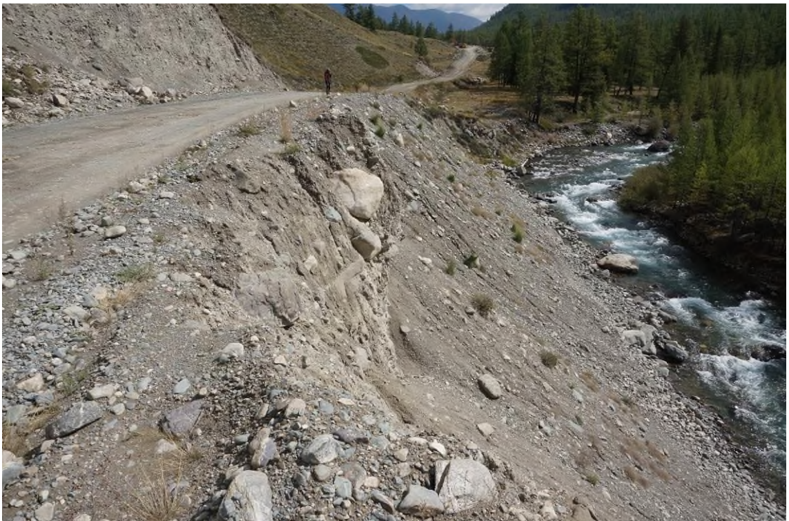
Фото 04-12-00017. Осыпание рыхлого материала и развитие рытвин метеогенного стока в уступе склона, уч. а/дороги Кош-Агач – Джазатор, 101,2 км, Республика Алтай, 30.08.2024
