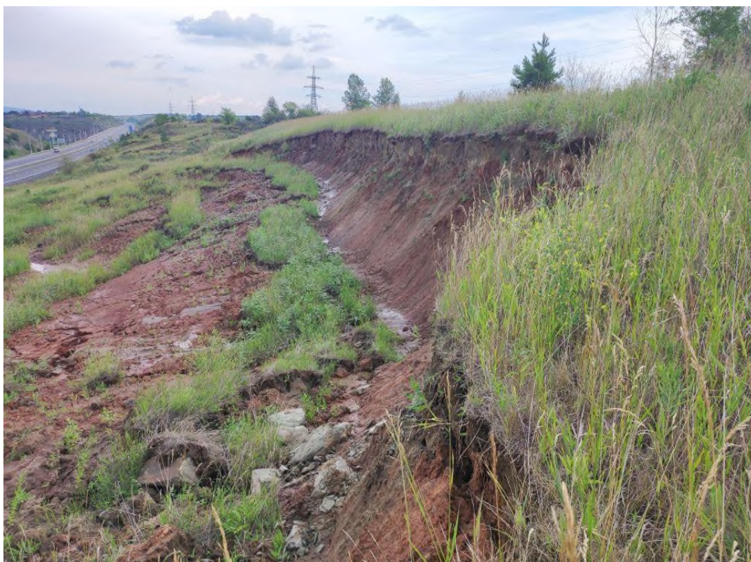
Фото 19-11-00003. Юго-западная окраина оползня 1 на участке а/дороги Р-257, Братский мост, Алтайский район, Республика Хакасия, 19.07.2024
