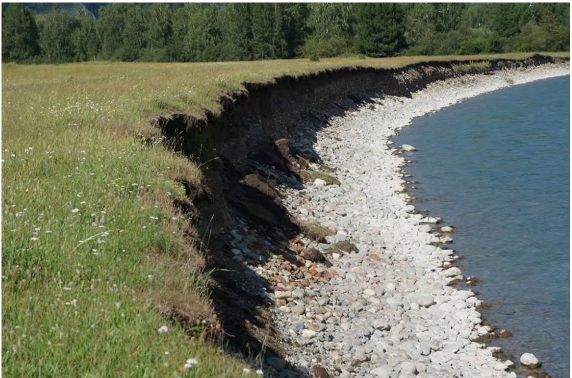
Фото 04-10-00007. Блоки обрушения в подошве вертикального уступа террасы, уч. а/дороги Усть-Кокса – Мараловодка, 21-22 км, Усть-Коксинский район, Республика Алтай, 23.07.2024
