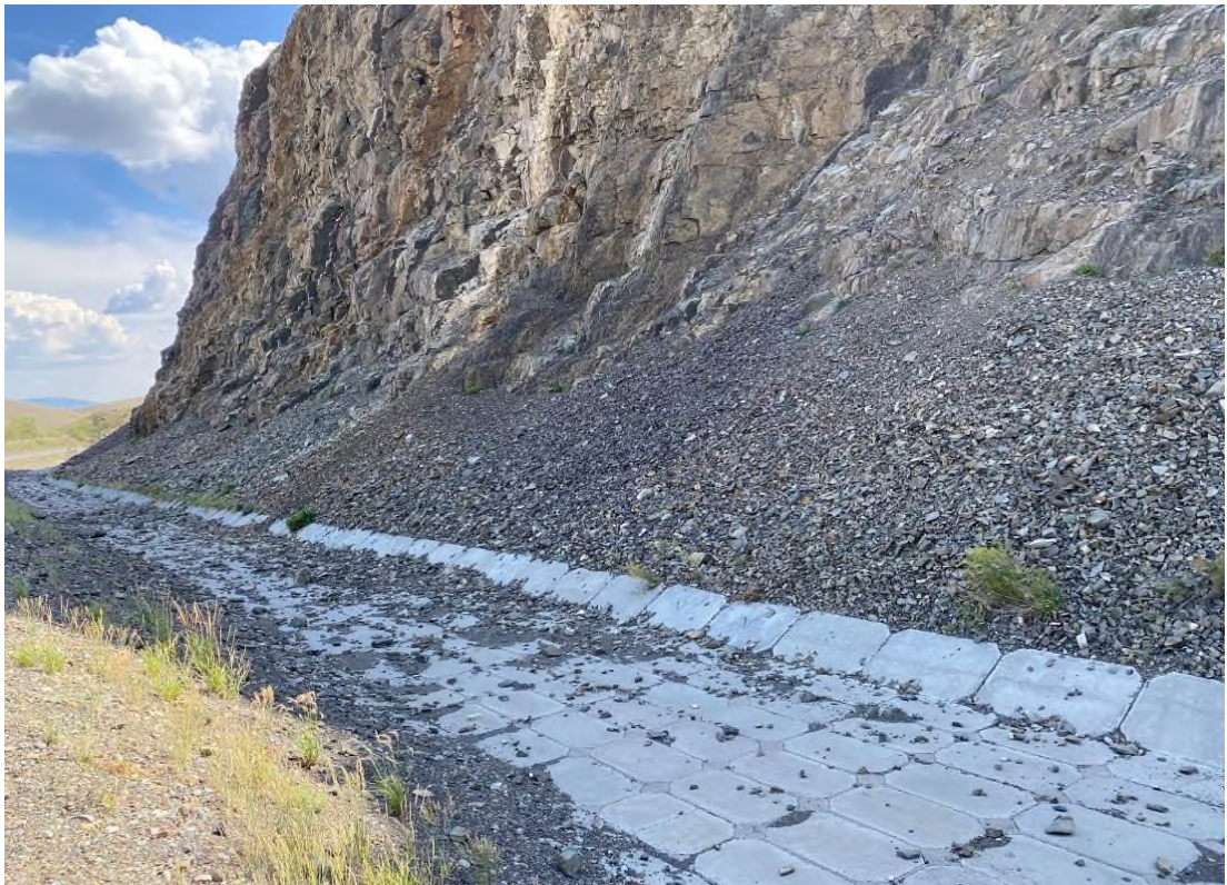
Фото 17-12-00010. Осыпной склон, уч. а/дороги Р-257 Енисей, 770-771 км, Пий-Хемский район, Республика Тыва, 31.07.2024
