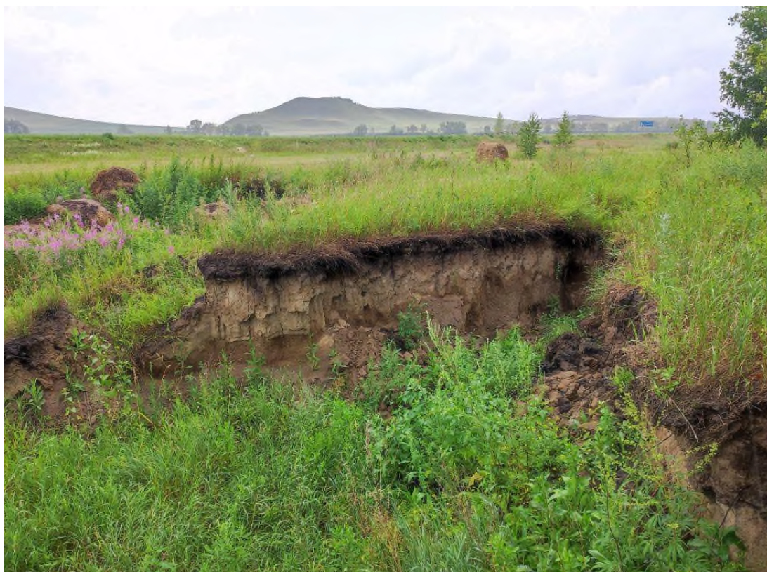
Фото 24-22-00029. Вершина (левая) оврага «Левый», ПН уч. а/дороги Р-257, 242 км, в 3,5 км западнее с. Новоселово, Новоселовский район, Красноярский край, 22.07.2024
