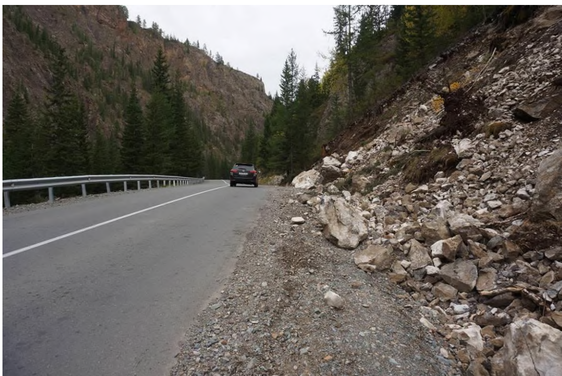
Фото 04-12-00012. Кюветы и обочина автодороги перекрыты щебнисто-глыбовым материалом осыпного конуса, уч. а/дороги Акташ – Улаган, 4,68-4,8 км, Улаганский район, Республика Алтай, 03.09.2024
