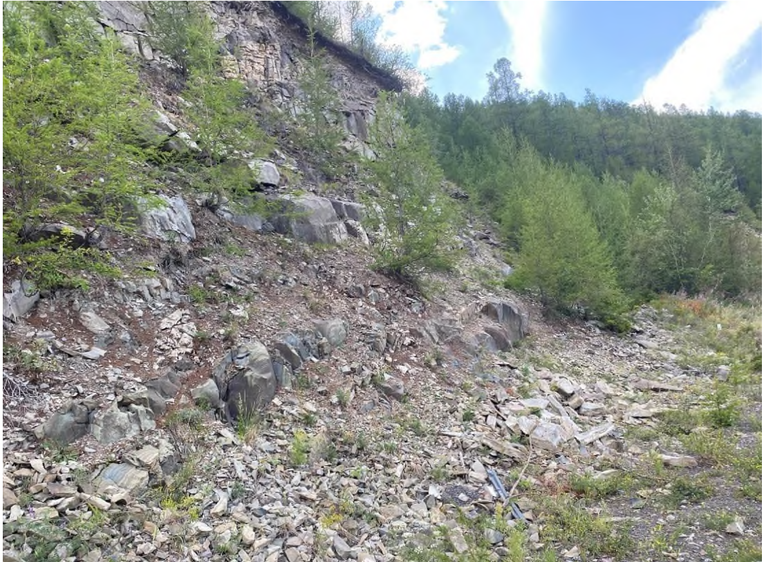
Фото 17-12-00009. Осыпной склон, уч. а/дороги Р-257 Енисей, 770 км, Пий-Хемский район, Республика Тыва, 31.07.2024
