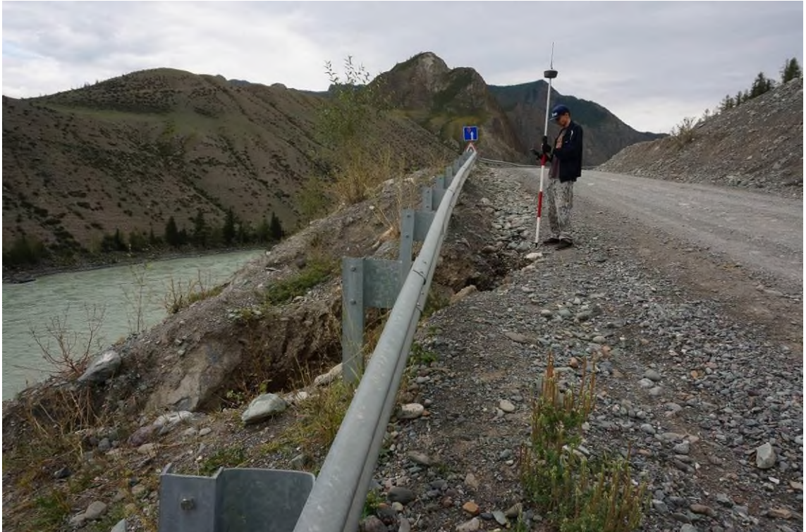
Фото 04-22-00011. Разрушение дорожного полотна и откосов дороги в вершине оврага, а/дорога в с. Инегень, Онгудайский район, Республика Алтай, 27.08.2024
