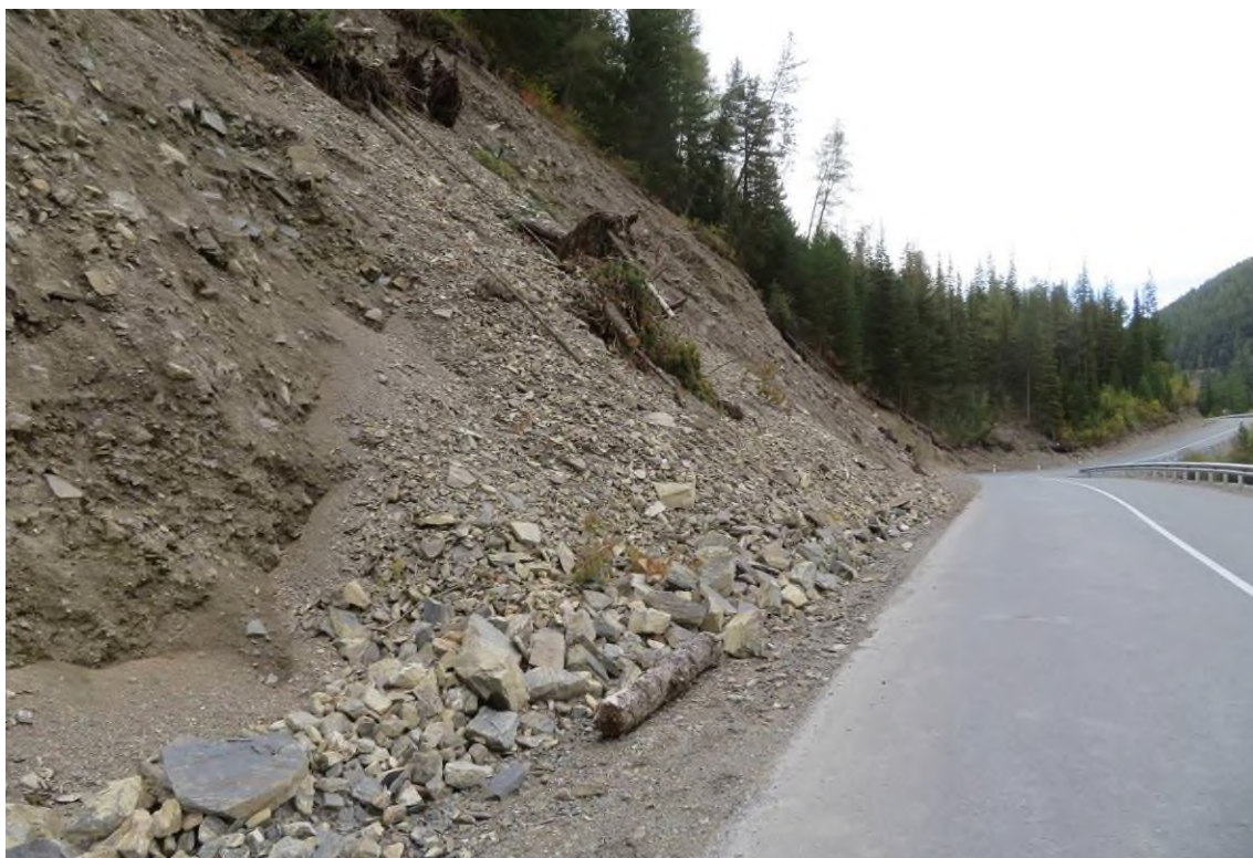
Фото 04-12-00006. Осыпной шлейф на обочине а/дороги, уч. а/дороги Акташ – Улаган, 11,15-11,6 км, Улаганский район, Республика Алтай, 03.09.2024
