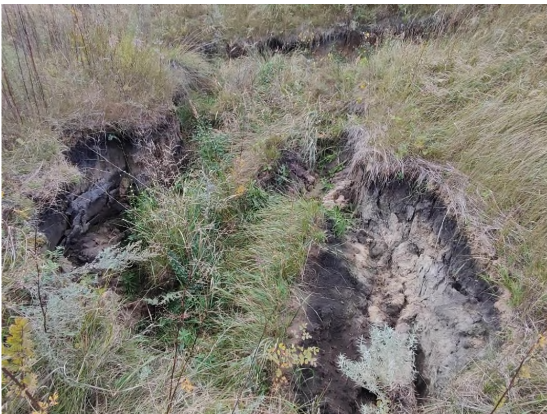
Фото 24-17-00004. Суффозионный провал №1, направленный к вершине отвершка, ПН уч. а/дороги Анцирь-Хаерино, в 0,5 км З с. Анцирь, Канский район, Красноярский край, 10.09.2024
