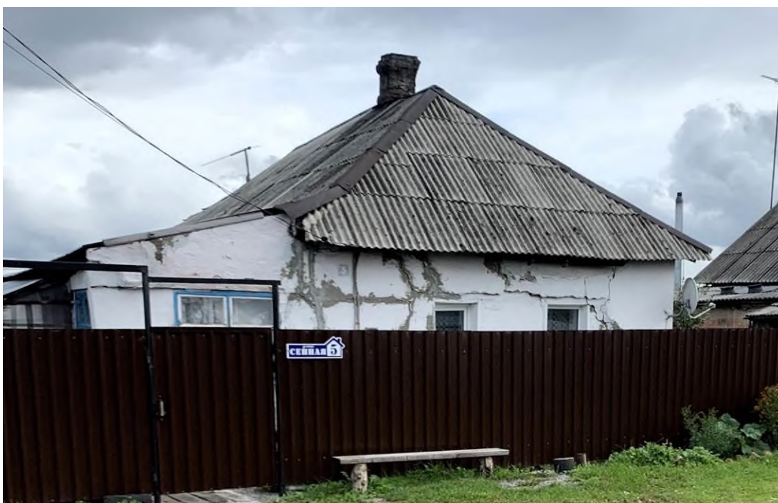
Фото 42-13-00008. Деформация дома по ул. Сенная, 5, г. Белово, Кемеровская область-Кузбасс, 06.09.2024
