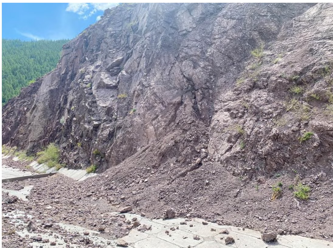
Фото 17-12-00008. Осыпь у подножия западного склона, скопление осыпного материала на водоотводном лотке, уч. а/дороги Р-257 Енисей, 770 км, Пий-Хемский район, Республика Тыва, 31.07.2024
