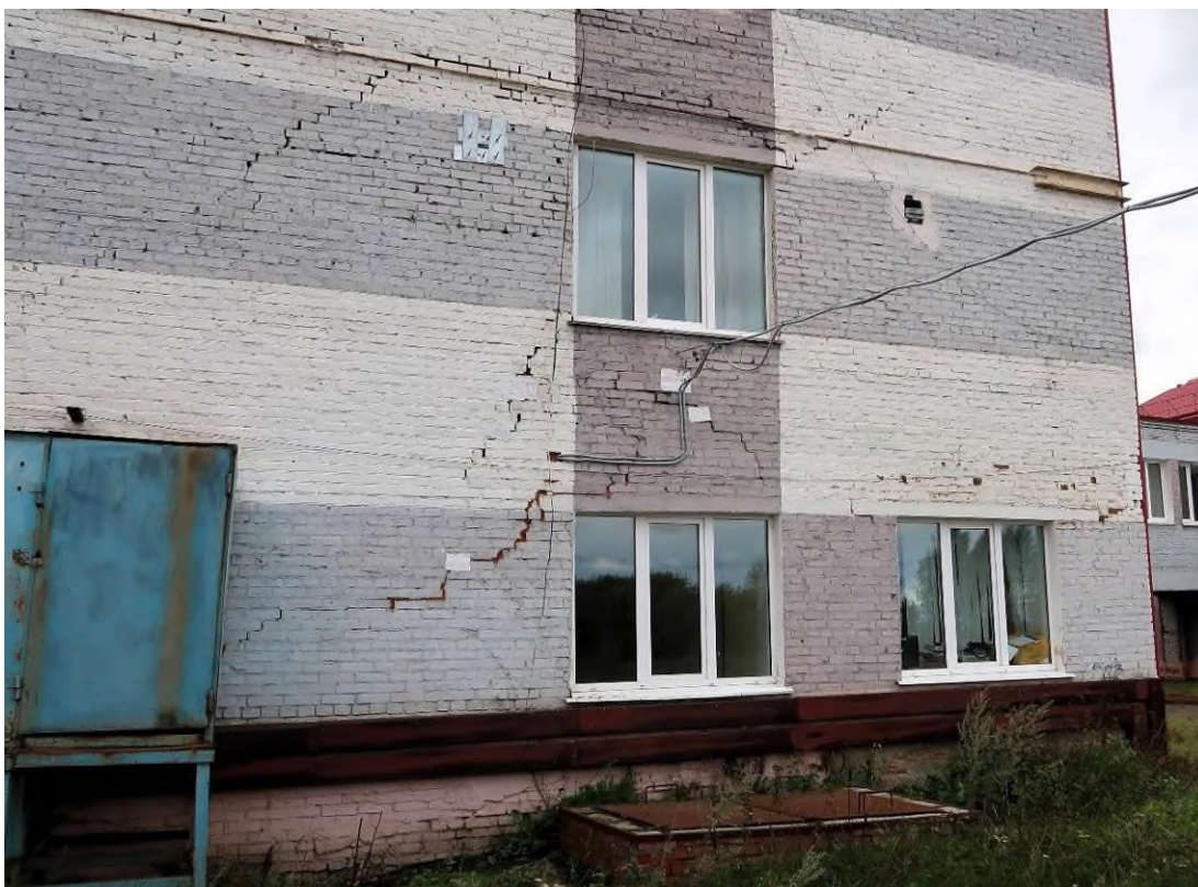
Фото 42-13-00007. Деформация центрального здания больницы, на трещины установлены маячки, пгт. Яя, Яйский район, Кемеровская область-Кузбасс, 08.09.2024
