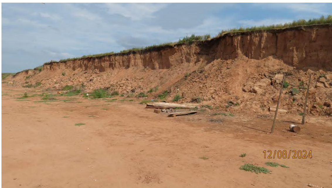
Фото 38-27-00001. Обвальный склон вблизи п. Жданово, ПН Жданово, Осинский район, Иркутская область, 12.08.2024
