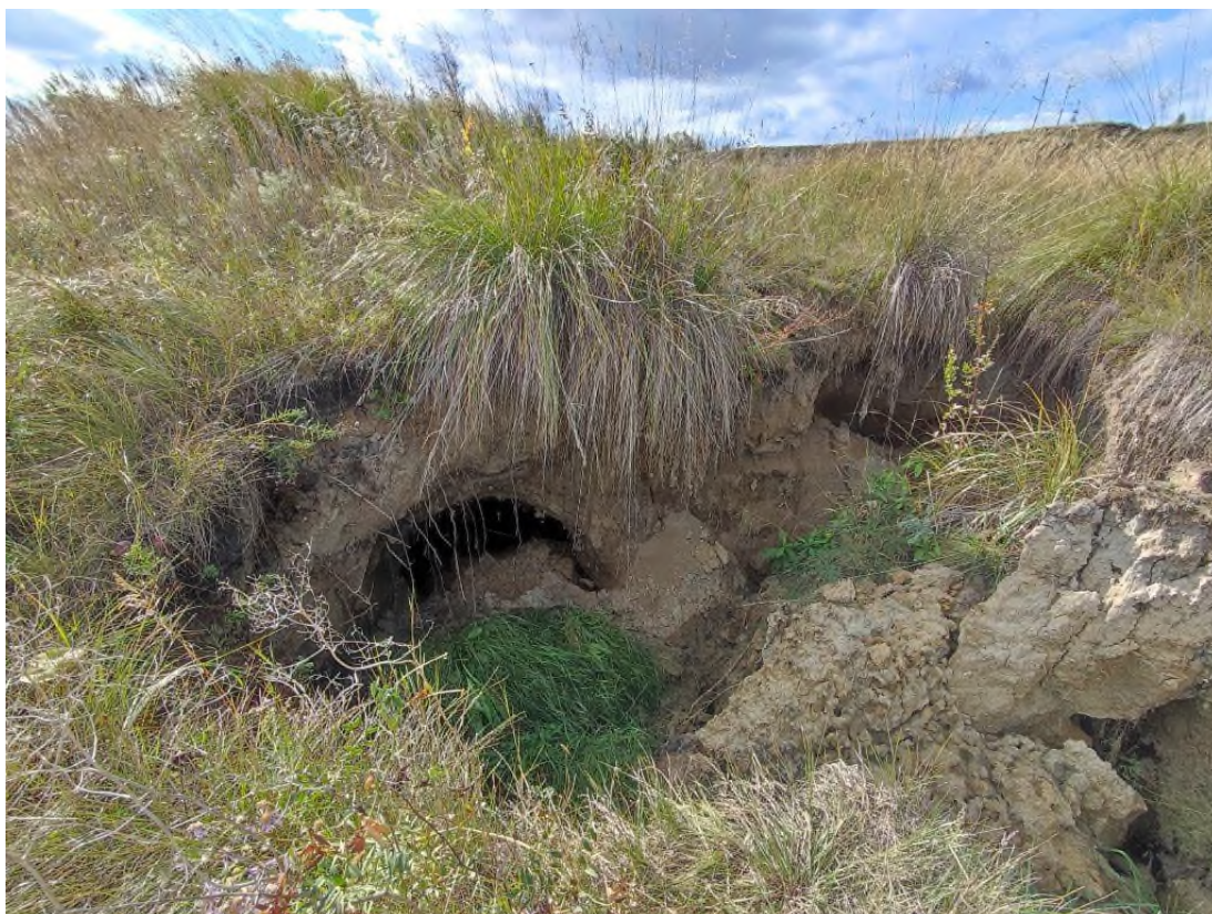
Фото 24-17-00005. Суффозионный провал №2 с суффозионными каналами в борту, ПН уч. а/дороги Анцирь-Хаерино, в 0,5 км З с. Анцирь, Канский район, Красноярский край, 10.09.2024
