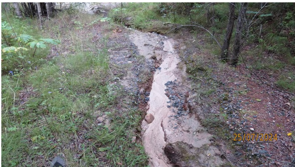
Фото 38-22-00004. Промоина в нижней части оврага №4, ПН Быстринский, уч. а/дороги А-146 Иркутск – Монды, Слюдянский район, Иркутская область, 25.07.2024
