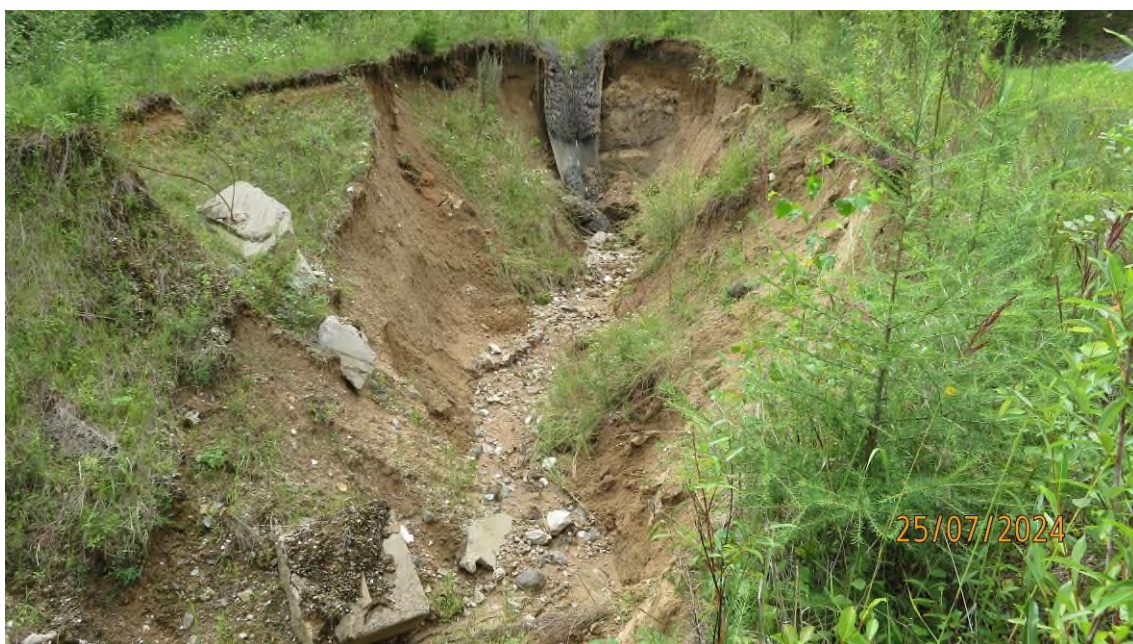
Фото 38-22-00001. Основной овраг №1, ПН Быстринский, уч. а/дороги А-146 Иркутск – Монды, Слюдянский район, Иркутская область, 25.07.2024
