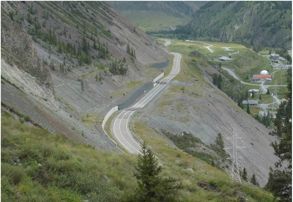
Фото 04-11-00057. Границы оползня с наиболее активными участками движения по флангам выделяются на дороге плавными уступами и свежими темными пятнами асфальта, уч. а/дороги в Алтайское подворье, 20,05 км, Онгудайский район, Республика Алтай, 19.07.2024
