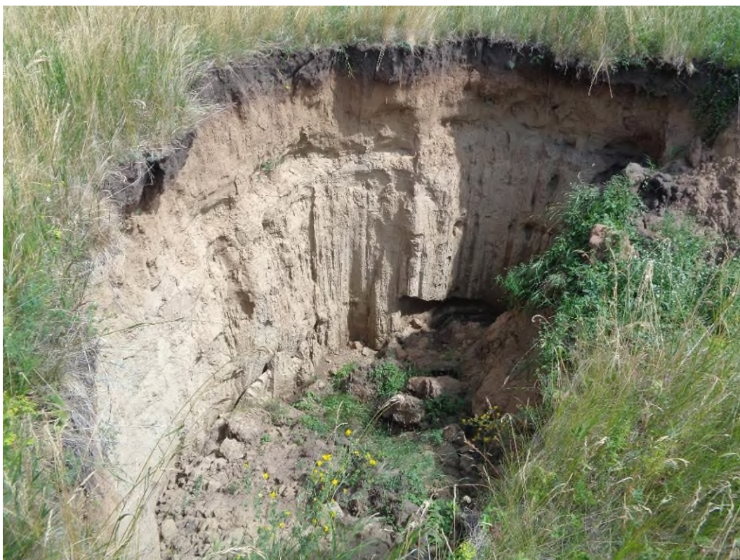
Фото 54-22-00047. Овраг № 29 вершина представляет собой водобойный колодец глубиной 6,5 м. Борта отвесные, обнаженные. с. Ленинское, Новосибирский район, Новосибирская область, 18.07.2024
