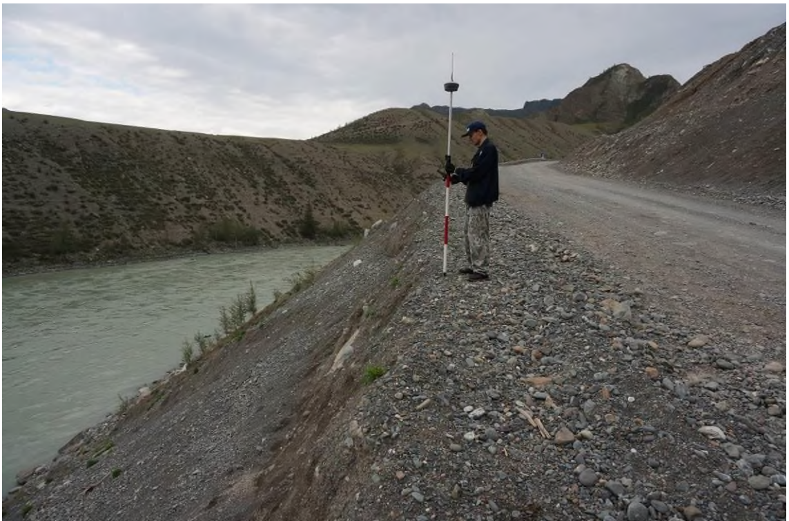
Фото 04-12-00020. Разрушение откосов автодороги осыпным процессом на автодороге в с. Инегень, Онгудайский район, Республика Алтай, 27.08.2024
