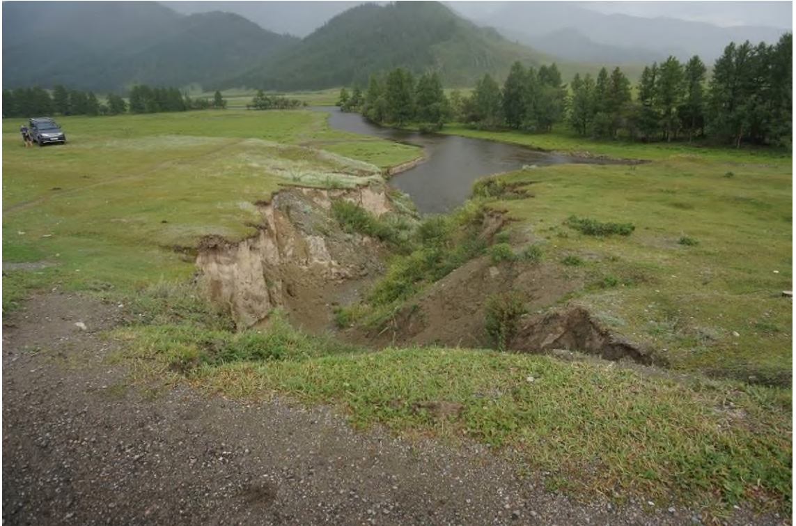
Фото 04-22-00009. Вершина оврага № 4 достигает откосов дороги, уч. а/дороги Туекта – Усть-Кан, 19,96 км, с. Кара-Кобы, Онгудайский район, Республика Алтай, 20.07.2024
