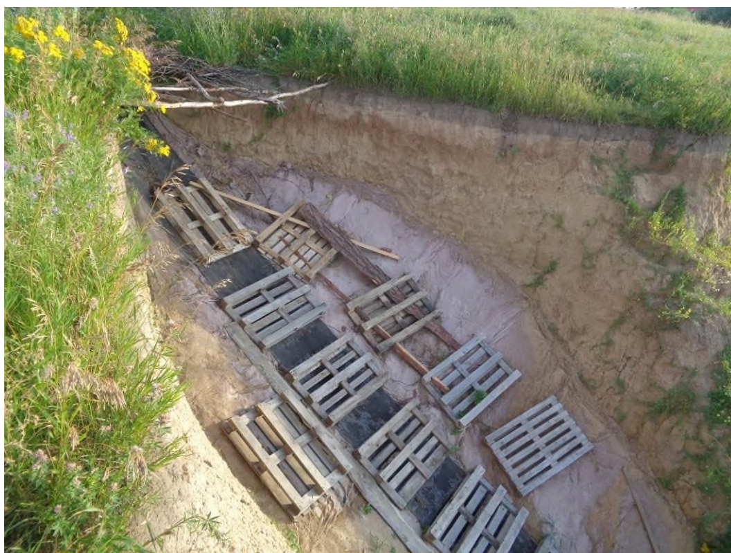
Фото 54-22-00045. Овраг № 27 устье-правый борт. Склоны правого борта выположены. Левый борт отвесный, с отслоением грунта в виде глыб столбчатой структуры. Днище выположено и выстелено резиновой тканью. с. Ленинское, Новосибирский район, Новосибирская область, 18.07.2024
