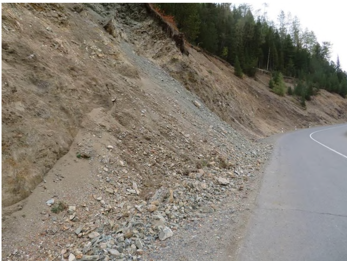
Фото 04-12-00005. Осыпной шлейф перекрывает обочины и кюветы на уч. а/дороги Акташ – Улаган, 11,83-12,27 км, Улаганский район, Республика Алтай, 03.09.2024
