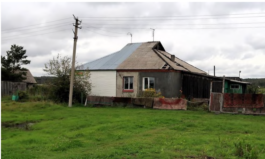
Фото 42-13-00006. Деформация здания по ул. Перспективная, 24, с. Борисово, Крапивинский район, Кемеровская область-Кузбасс, 06.09.2024
