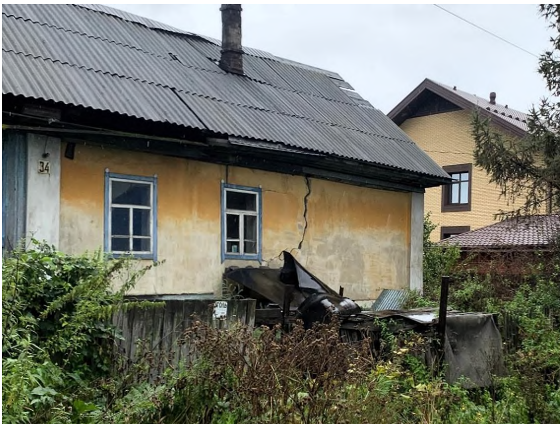
Фото 42-13-00009. Деформация дома по ул. Анадырская, 34, г. Новокузнецк, Кемеровская область-Кузбасс, 05.09.2024
