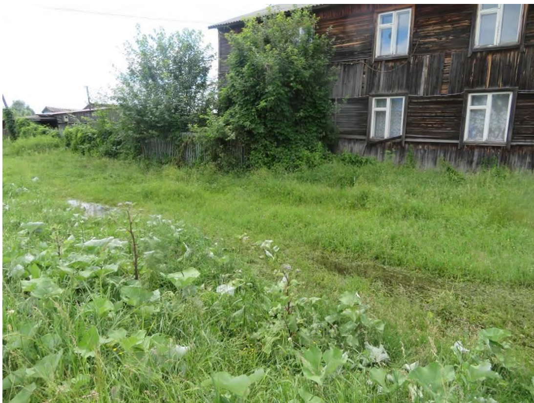
Фото 70-13-00001. Процесс подтопления в с. Озёрное (дренажная канава по ул. Совхозная), Колпашевский район, Томская область, 09.07.2024
