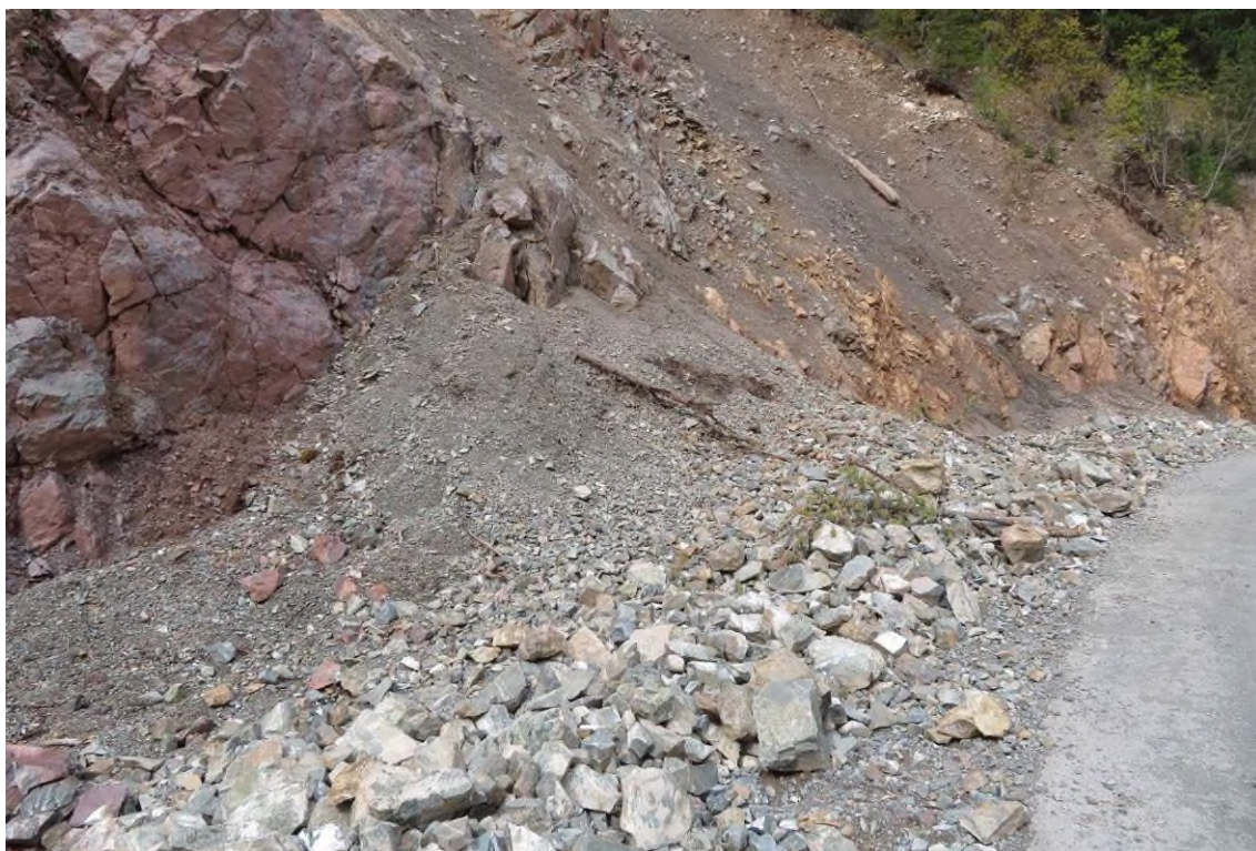
Фото 04-12-00008. Пересыпание кювет автодороги осыпными шлейфами, автодорога Акташ – Улаган, 7,72-7,92 км, Улаганский район, Республика Алтай, 03.09.2024
