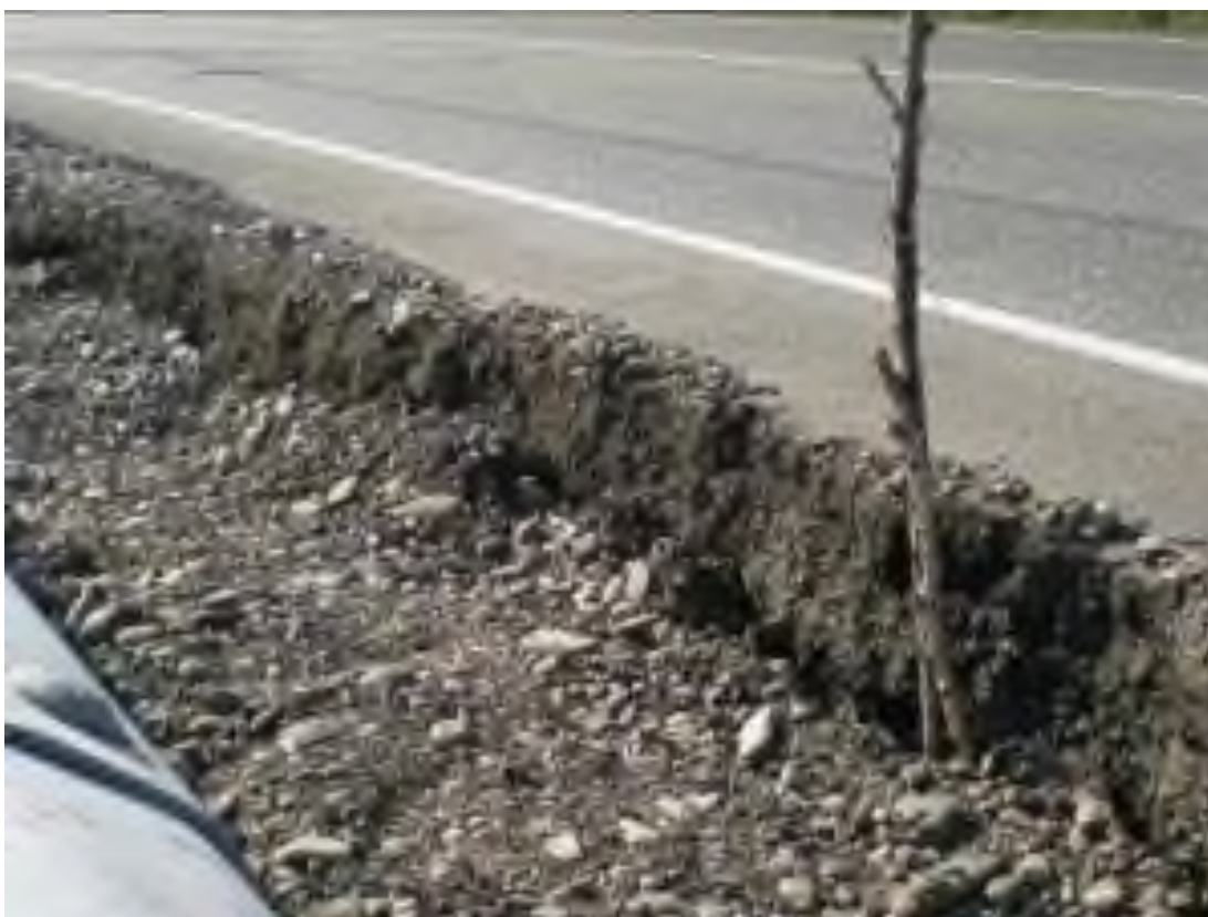
Фото 19-11-00008. Оползание обочины на участке а/дороги Абакан-Подсине, 7,15-7,25 км, Алтайский район, Республика Хакасия ( https://19rusinfo.ru/obshchestvo/74438-podryadchik-pristupil-k-remontu-trassy-prosevshej-vozle-mosta-cherez-reku-enisej )
