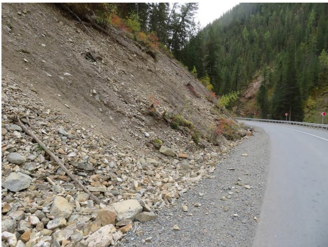
Фото 04-12-00007. Пересыпание мелкими глыбами кювет а/дороги, уч. а/дороги Акташ – Улаган, 8,72-9,235 км, Улаганский район, Республика Алтай, 03.09.2024
