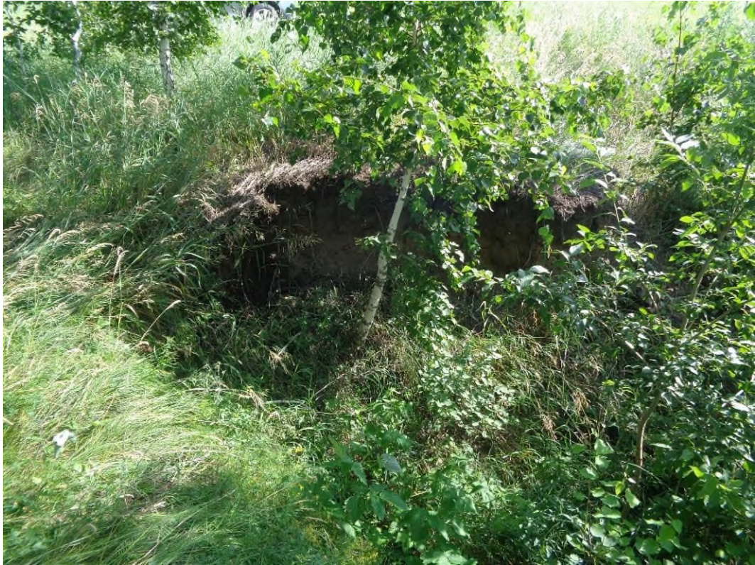
Фото 54-22-00018. Овраг № 9 вершин представляет собой водобойный колодец шириной 7 м глубиной 1,5-2 м. Видны свежие обвалившиеся куски почвенного покрова, козырьки ПРС. с. Ленинское, Новосибирский район, Новосибирская область, 18.07.2024
