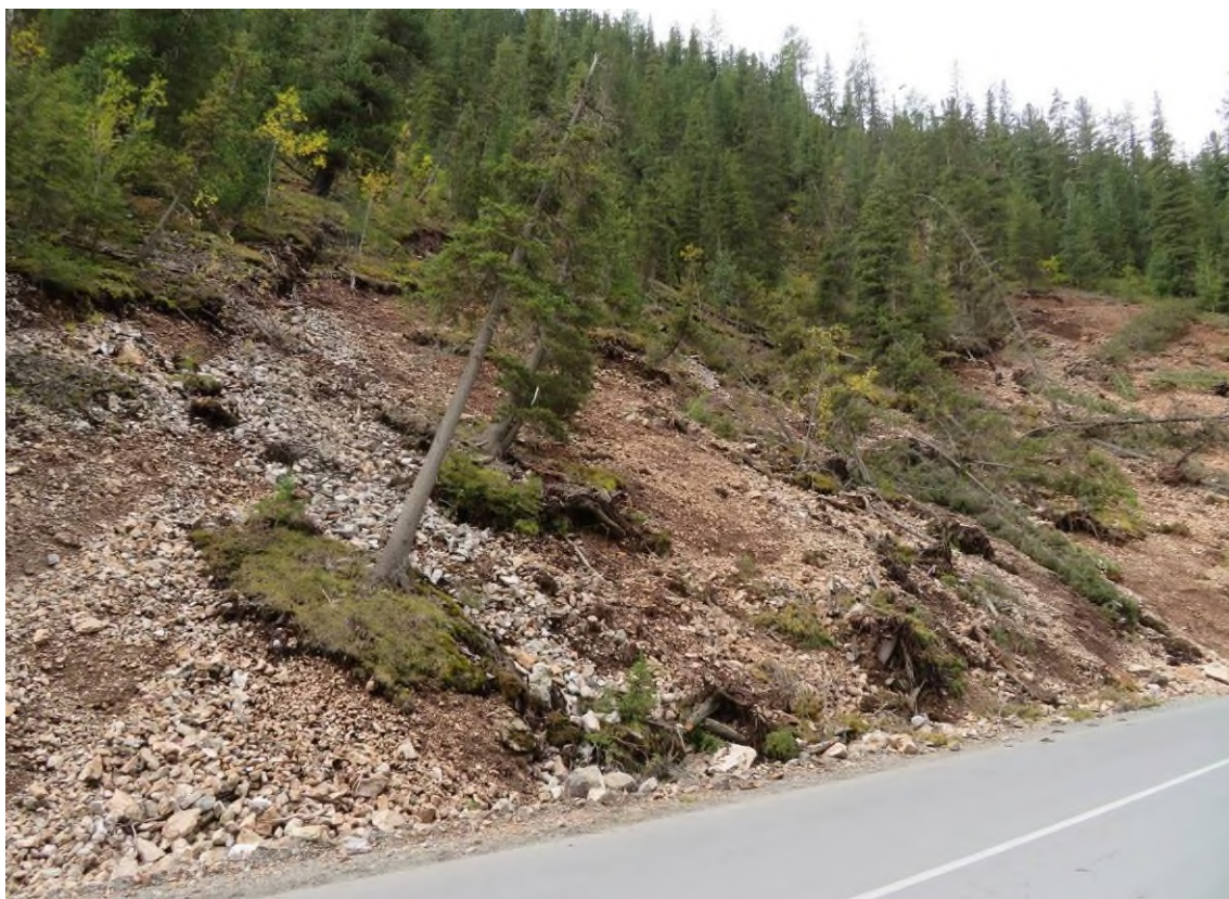
Фото 04-11-00065. Фронтальное смещение глыбово-щебнистого материала, блоков ПРС с деревьями и кустарниками, уч. а/дороги Акташ - Улаган, 8,49-8,575 км, Улаганский район, Республика Алтай, Республика Алтай, 03.09.2024
