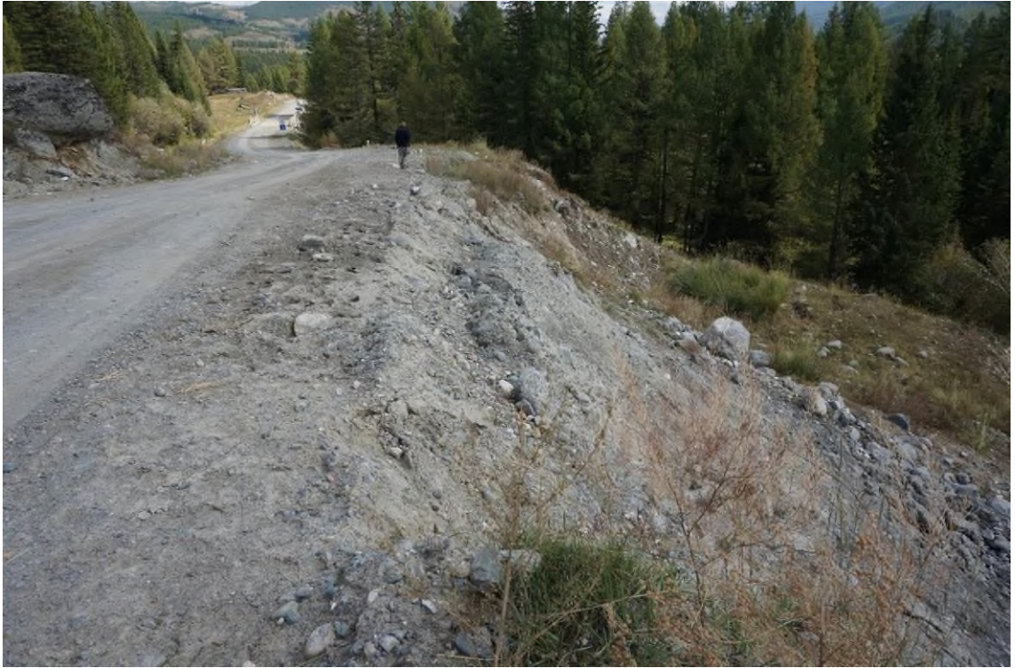
Фото 04-11-00064. Разрушение откосов автодороги на отрезке 6 м, уч. а/дороги Кош-Агач - Джазатор, 135,41 км, Кош-Агачский район, Республика Алтай, 30.08.2024
