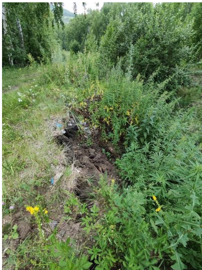
Фото 24-22-00024. Участок свежих обрушений по левому борту оврага «Новый», ПН Пригородный. п. Пригородный, Минусинский район, Красноярский край, 17.07.2024
