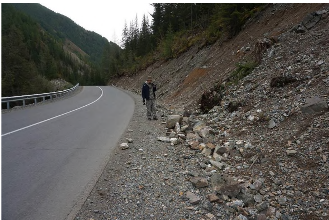
Фото 04-12-00009. Мелкое пересыпание кювет и обочины а/дороги глыбово-щебнистым материалом, уч. а/дороги Акташ – Улаган, 6,95-7,3 км, Улаганский район, Республика Алтай, 03.09.2024
