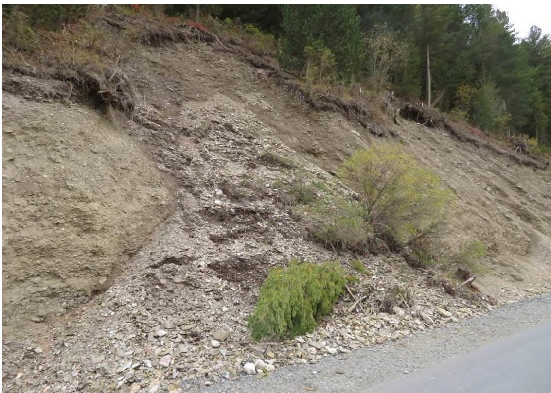
Фото 04-12-00004. Осыпной конус перекрывает кюветы и обочину на уч. а/дороги Акташ – Улаган, 12,75-13,21 км, Улаганский район, Республика Алтай, 03.09.2024
