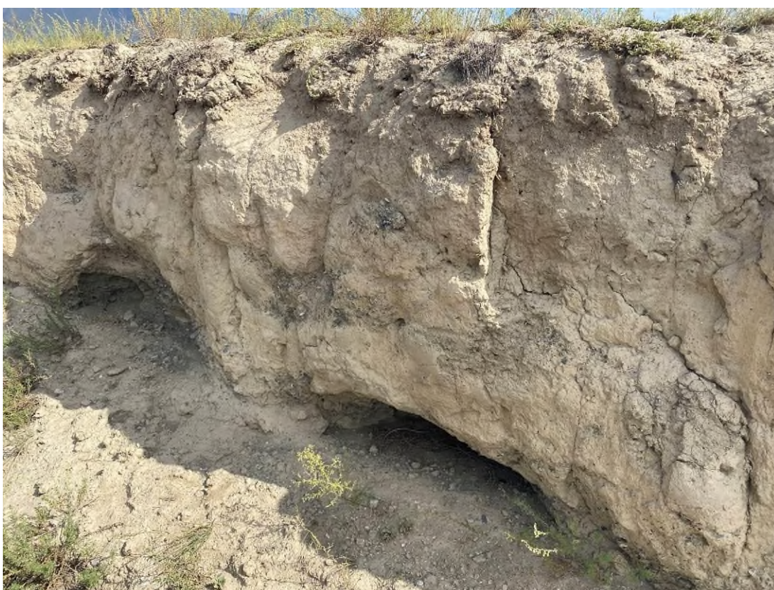
Фото 17-22-00012. Трещина отседания и ниша по левому борту оврага №1, уч. а/дороги Шагонар–Эйлиг-Хем, 10 км, Улуг-Хемский район, Республика Тыва, 21.08.2024
