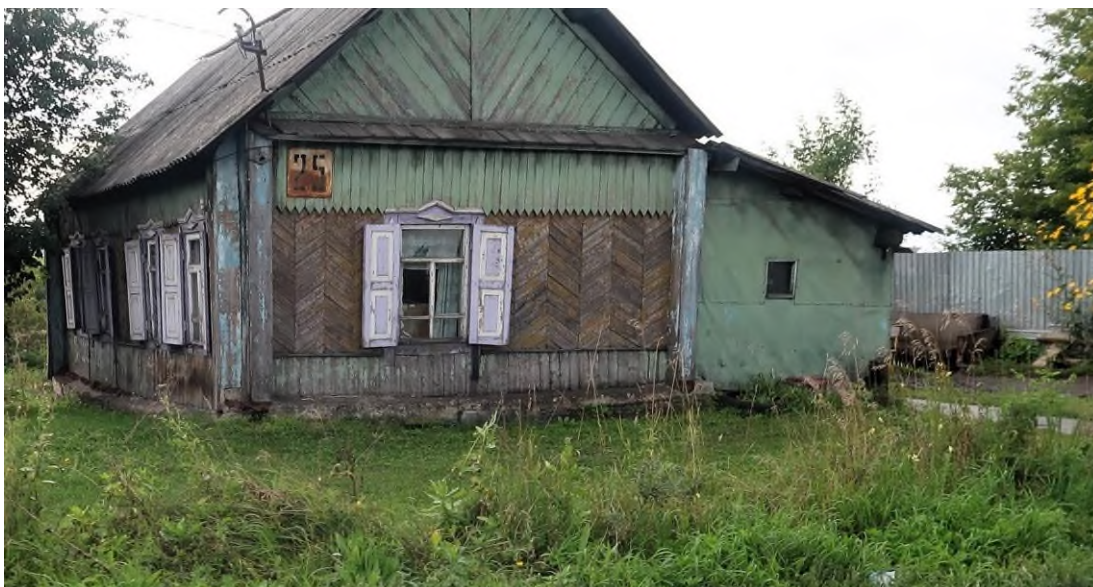
Фото 42-26-00001. Деформация дома по ул. Есенина, 25, г. Ленинск-Кузнецкий, Кемеровская область-Кузбасс, 02.09.2024
