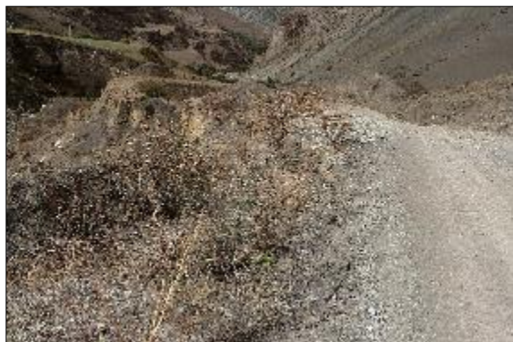
Фото 07-11-00029 – Оползень в правом борту долины р. Кардан (Чегемский район), пересекающий грунтовую автодорогу Эльтюбю – Безенги. В центре и слева - трещины на нижнем откосе дороге. (07.09.2024 г., ООО «Каббалкгеомониторинг»)
