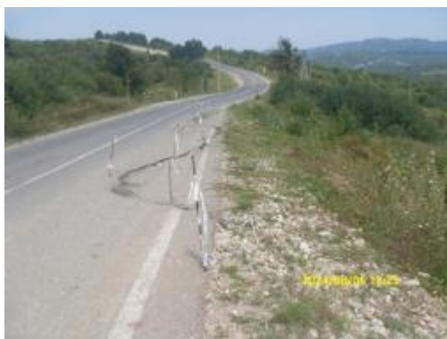
Фото 20-11-00597. 06.08.24. Чеченская Республика. Веденский район, автодорога с. Бас-Гордали - с. Белгатой, в 4,3км к западу от с.Бас-Гордали. Разрушено полотно дороги с покрытием на участке длиной 45м, шириной 1,5м.
