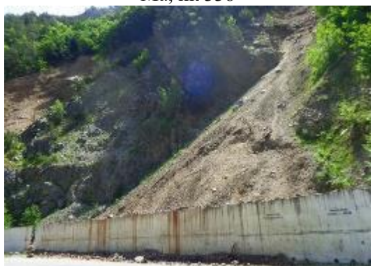
15-12-00031. Осыпь в верховом откосе ТрансКА-Ма, пк 347,5
