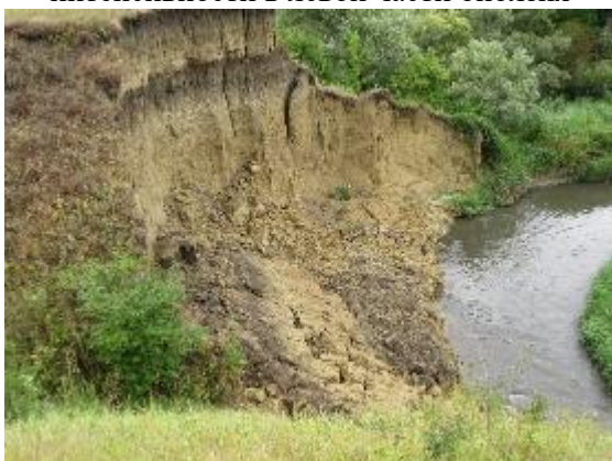
Фото. 26-11-00499. Смещения в правом береговом откосе на участке 10x20 м, в следствии береговой эрозии р.Мутнянка.
