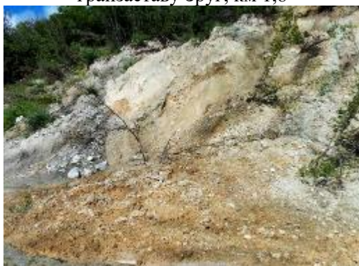
15-11-00122. Оползень в верховом откосе автодороги Мацута-Куссу, км 11,3
