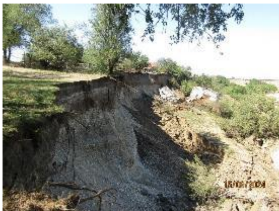
Фото 09-11-00146. Оползневое проявление на северо-восточной окраине а. Псыж
