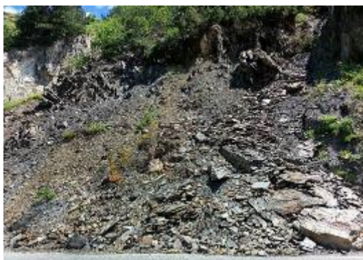
15-12-00094. Осыпь в верховом откосе ТрансКАМа, пк 108,5
