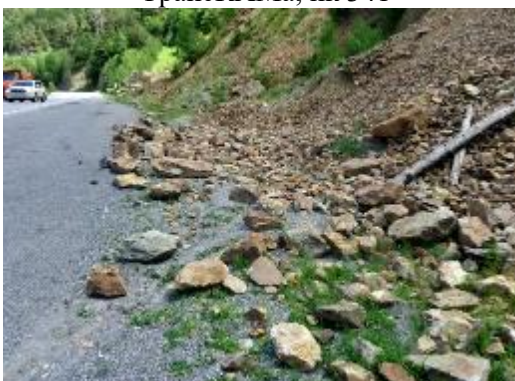
15-12-00088. Осыпь в верховом откосе ТрансКАМа, пк 351
