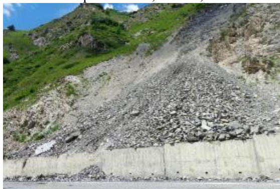
15-12-00111. Осыпь в верховом откосе ТрансКАМа, пк 235,5
