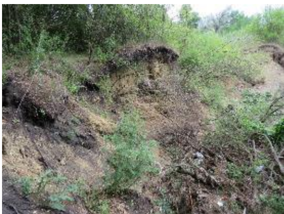
Фото. 26-11-00030. Смещения средней интенсивности на локальном участке, в правой части оползня.
