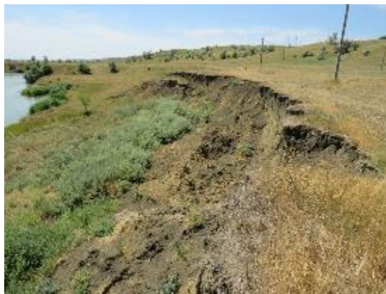
Фото. 26-11-00039. Смещения на локальном участке в правой части оползня
