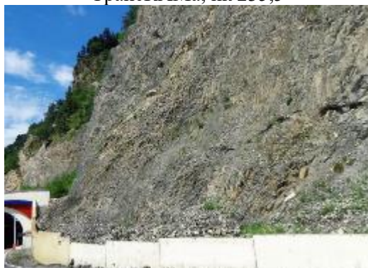
15-12-00098. Осыпь в верховом откосе ТрансКАМа, пк 212
