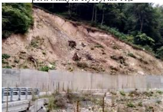
15-11-00114. Оползень в верховом откосе автодороги Гизель-Даргавс, км 19
