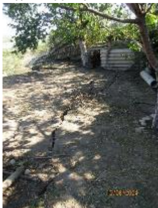
Фото 09-11-00146. Трещины закола вдоль бровки стенки срыва
