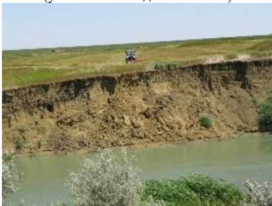
Фото. 26-11-00041. Смещения на локальном участке в правой части оползня
