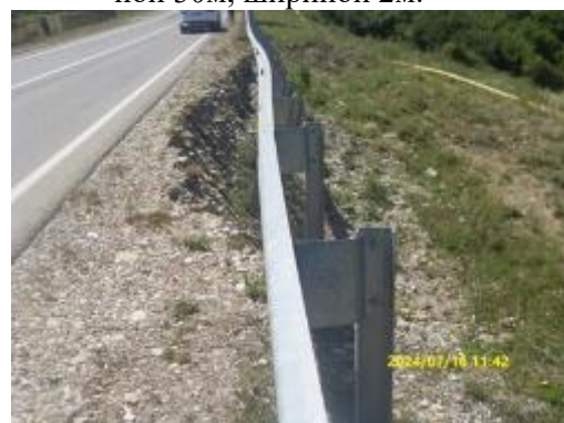
Фото 20-11-00158. 16.07.24. Чеченская Республика. Ножай-Юртовский район, автодорога с. Беной – с. Айти-Мохк 6,59км. Разрушена обочина дороги с покрытием длиной 30м, шириной 1м.
