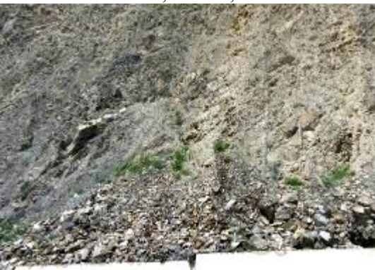
15-12-00134. Осыпь в верховом откосе ТрансКА-Ма, пк 57,5
