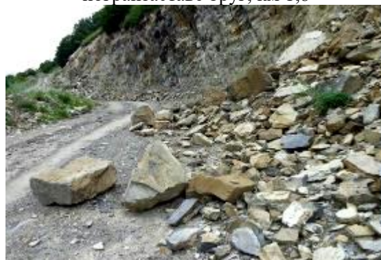
15-12-00072. Осыпь в верховом откосе авто-дороги на погранзаставу «Зруг», км 4,3
