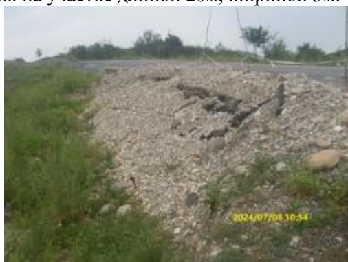
Фото 20-11-00594. 13.07.23. Чеченская Республика. Ножай-Юртовский район, автодорога с. Ялхой-Мохк – с. Малые Шуани – 4,61км. Разрушен участок дороги с покрытием на участке длиной 20м, шириной 1м. Разрушено ограждение длиной 30м.
