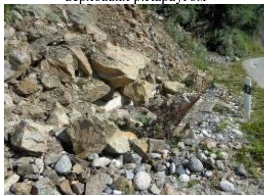
15-12-00123. Осыпь в верховом откосе автодороги Мацута-Куссу, км 11,5
