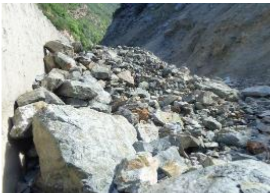
15-12-00030. Осыпь в верховом откосе ТрансКА-Ма, пк 338
