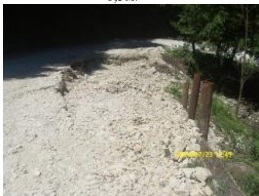
Фото 20-11-00591. 23.07.24. Чеченская Республика. Ножай-Юртовский район, автодорога с. Булгат-Ирзу - с. Алхан-Хутор, 0,8км. Разрушено полотно дороги без покрытия на участке длиной 20м, шириной 3м.
