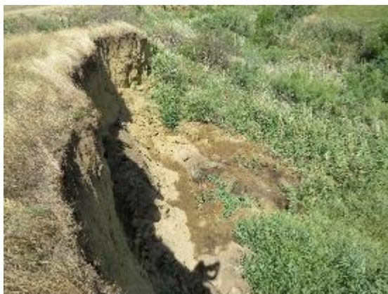
Фото. 26-11-00467. Смещения средней интенсивности у основания откоса на локальных участках в центральной и левой частях оползня
