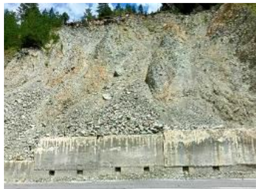
15-12-00061. Осыпь в верховом откосе ТрансКАМа, пк 341
