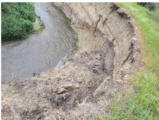
Фото. 26-11-000498. Новые смещения в правом береговом откосе р. Мутнянка на участке 10x20м.
