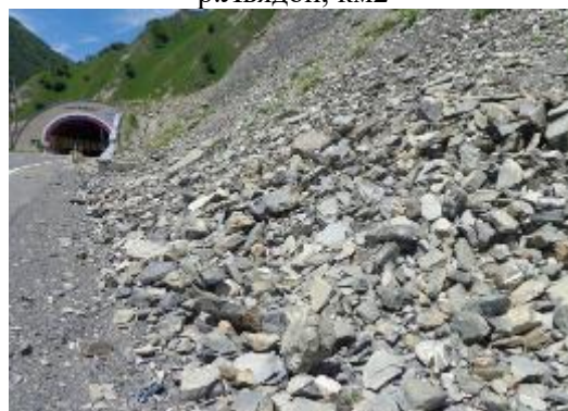
15-12-00124. Осыпь в верховом откосе ТрансКАМа, пк 262
