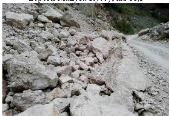
15-12-00059. Осыпь в верховом откосе автодороги Гизель-Даргавс, км 21,5
