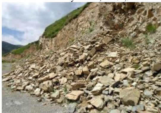
15-12-00074. Осыпь в верховом откосе технологической дороги ЛЭП, км 0,8
