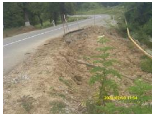
Фото 20-11-00547. 03.07.24. Чеченская Республика. Курчалоевский район, автодорога с. Джагларги - с. Регита, 3,5км. Разрушена дорога с покрытием длиной 7м, шириной 1м
