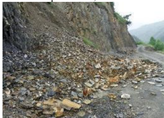
15-12-00136. Осыпь в верховом откосе а/д к погранзаставе Зруг, км 1,8
