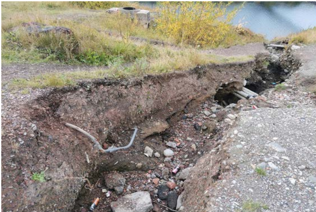
Фото 104. Проявление овражной эрозии (эрозионный врез), МО ГО "Воркута", Участок Шахтёрская набережная
