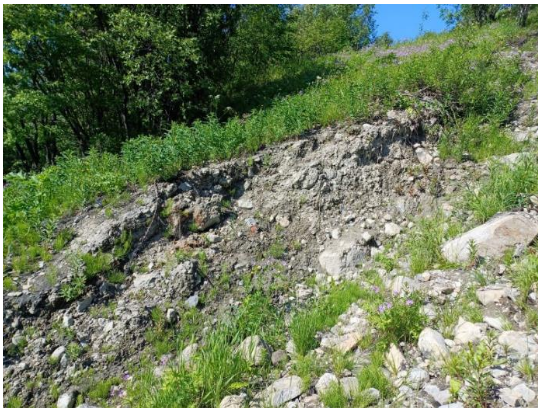
Фото 74. Свежие оползания грунта на боковой стенке. Нижне-Ростинское шоссе, 200 м от автобусной остановки «Контейнерная»
