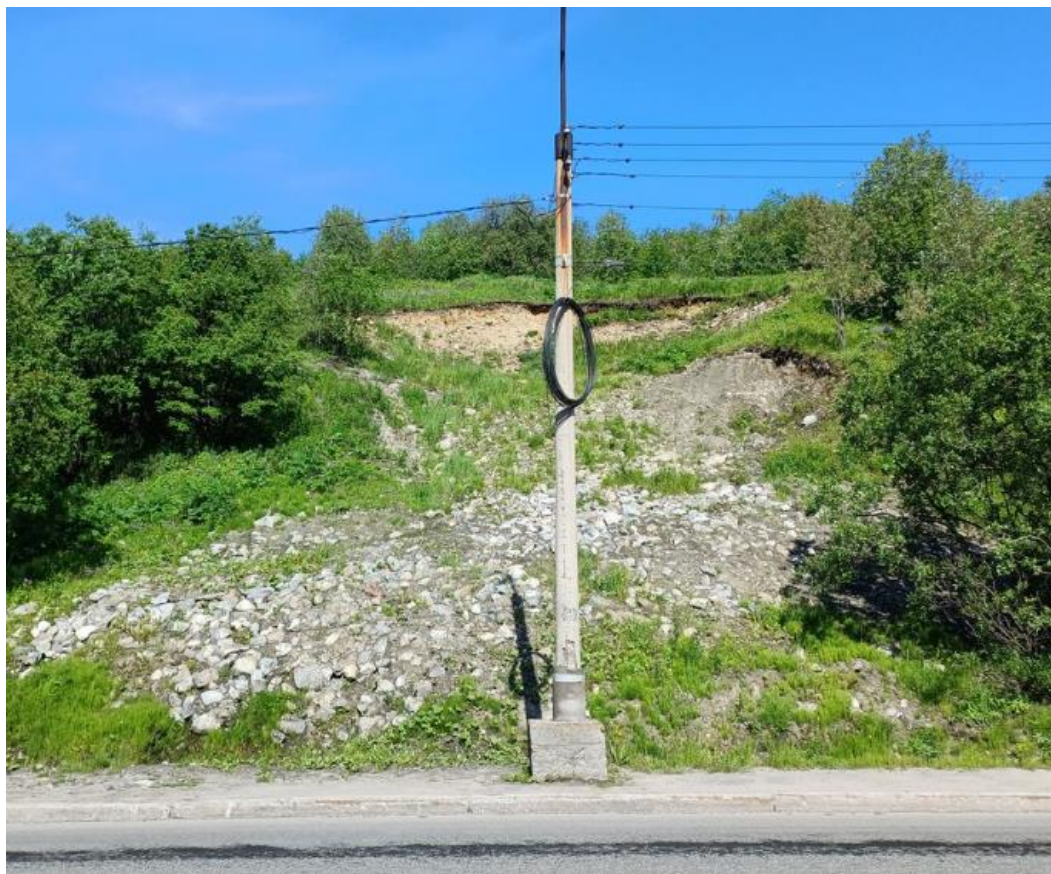
Фото 73. Оползневой склон. Нижне-Ростинское шоссе, 200 м от автобусной остановки «Контейнерная»
