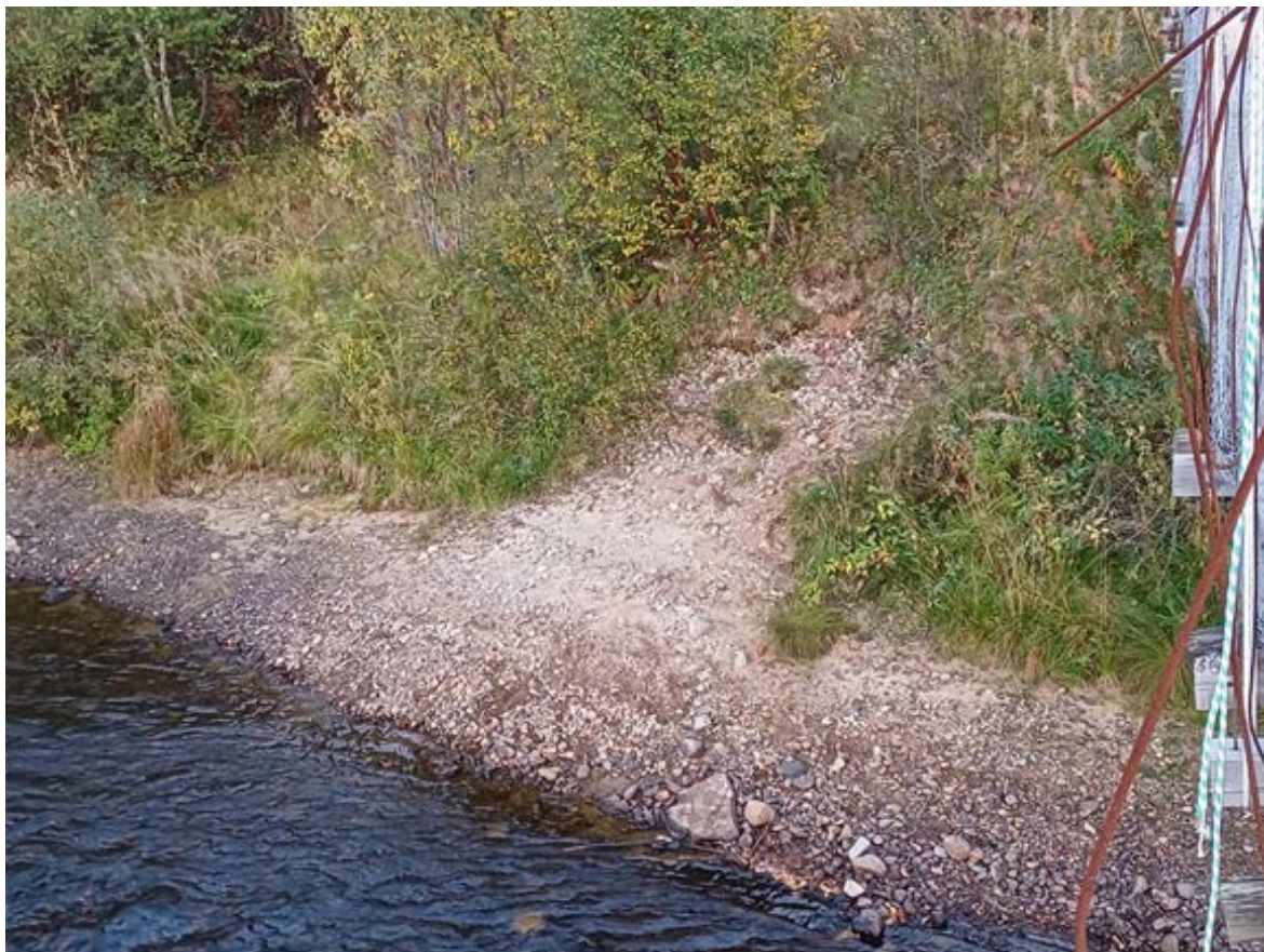
Фото 66. Нарушение дернового слоя и осыпание гравийно-песчаного грунта возле опоры моста. Кольский р-он, пос. Лопарская, правый берег р. Кола у моста.
