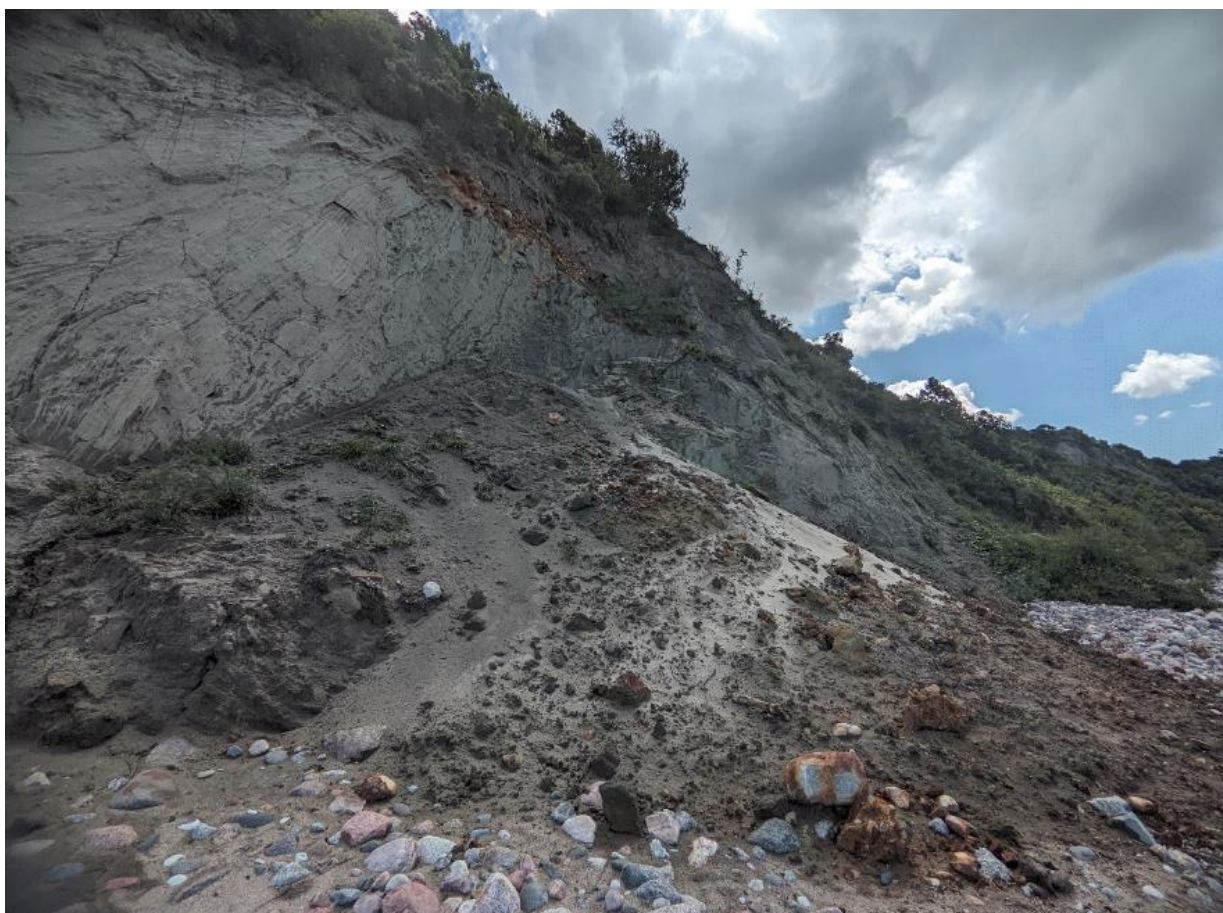
Фото 5. Обнажённый песчаный склон и оползневые массы у подножья в пгт. Донское,
