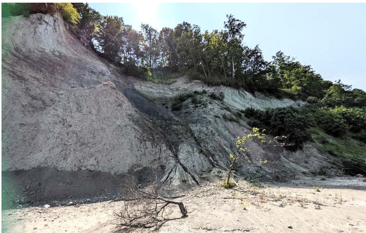
Фото 36. Оползневой цирк, сползшие деревья у подножья склона в п. Лесное
