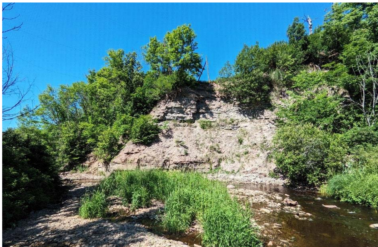
Фото 54, 55. Общий вид на проявление обвального процесса на береговом слоне р. Лава.
