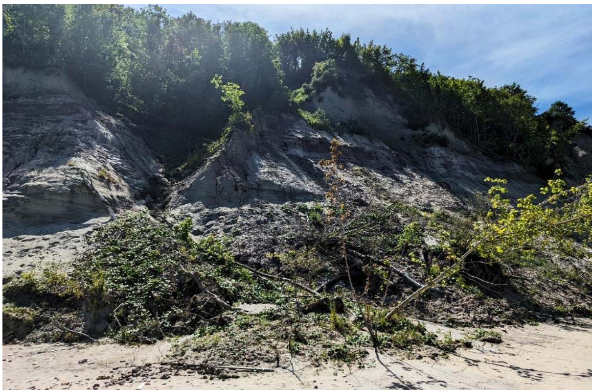
Фото 32. Свежие оползневые массы и поваленные деревья у подножья берегового склона
