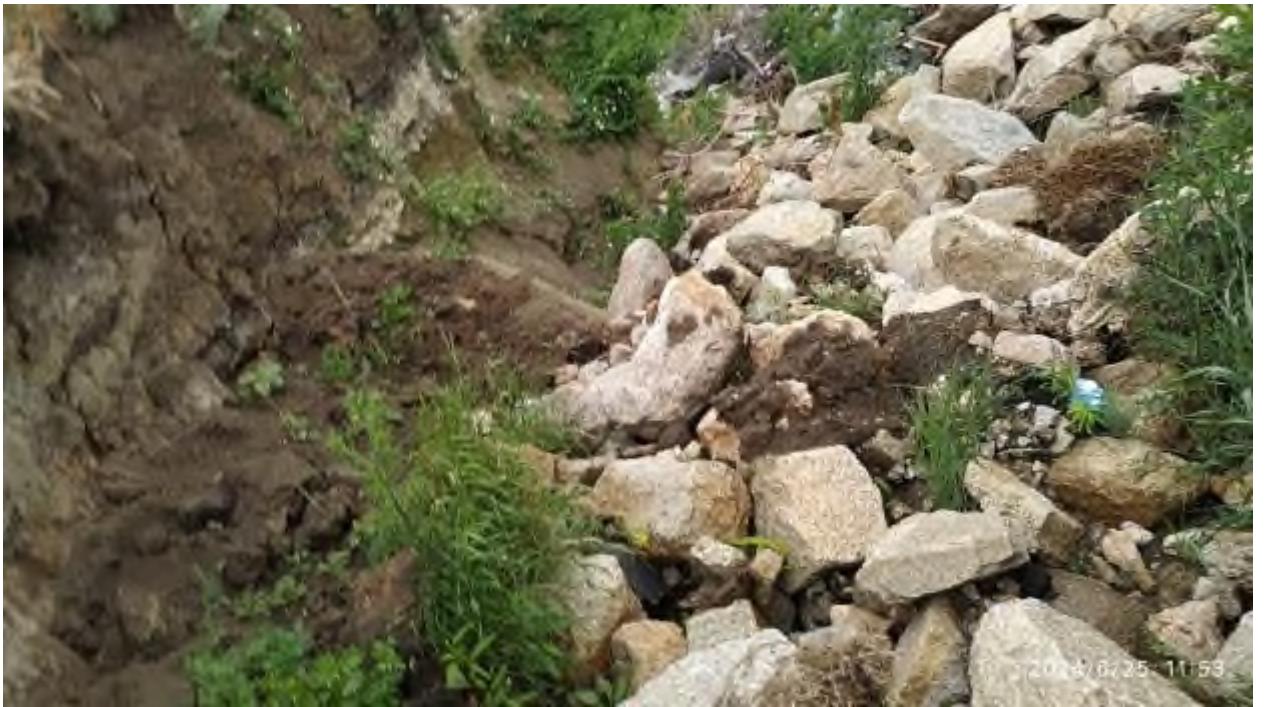
Фото 74-22-00260. Участок сброса воды с дамбы в вершине оврага в ТН 23. Участок Троицкий Челябинской области
