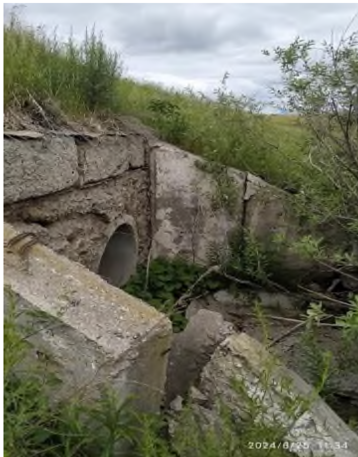
Фото 74-22-00259. Разрушение водопропуска под автодорогой в ТН 22. Участок Троицкий Челябинской области
