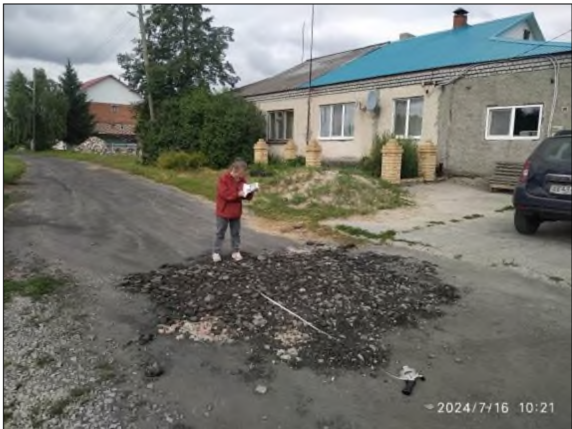
Фото 66-11-00310. Суффозионная просадка у дома по адресу пер. Южный, д. 10 в с. Усть-Ницинское. Усть-Ницинский участок Свердловская область
