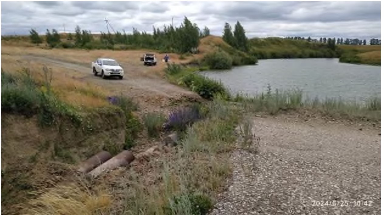
Фото 74-22-00254. Разрушенная паводковым стоком дамба и участок автодороги в ТН 17. Участок Троицкий Челябинской области
