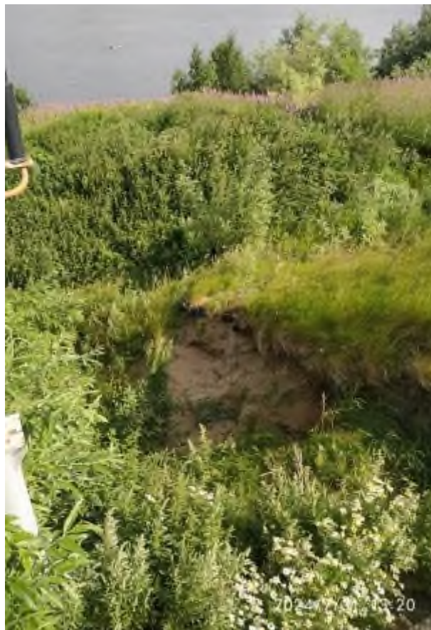
Фото 89-2024-01-001-0003. Участок термоэрозии со стороны мемориала в с. Аксарка в ТН 8. Участок Аксарский, ЯНАО
