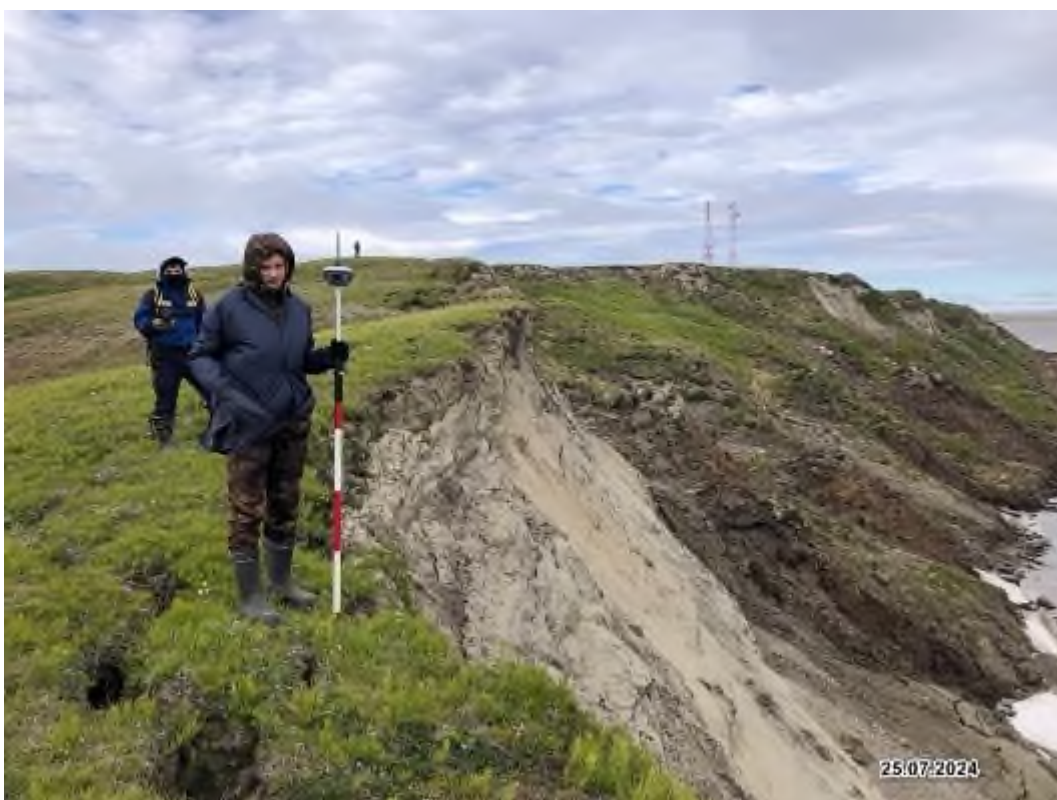
Фото 89-27-00230. Гравитационные процессы на высоком берегу Обской губы в ТН 7. Участок Сеяхинский, ЯНАО
