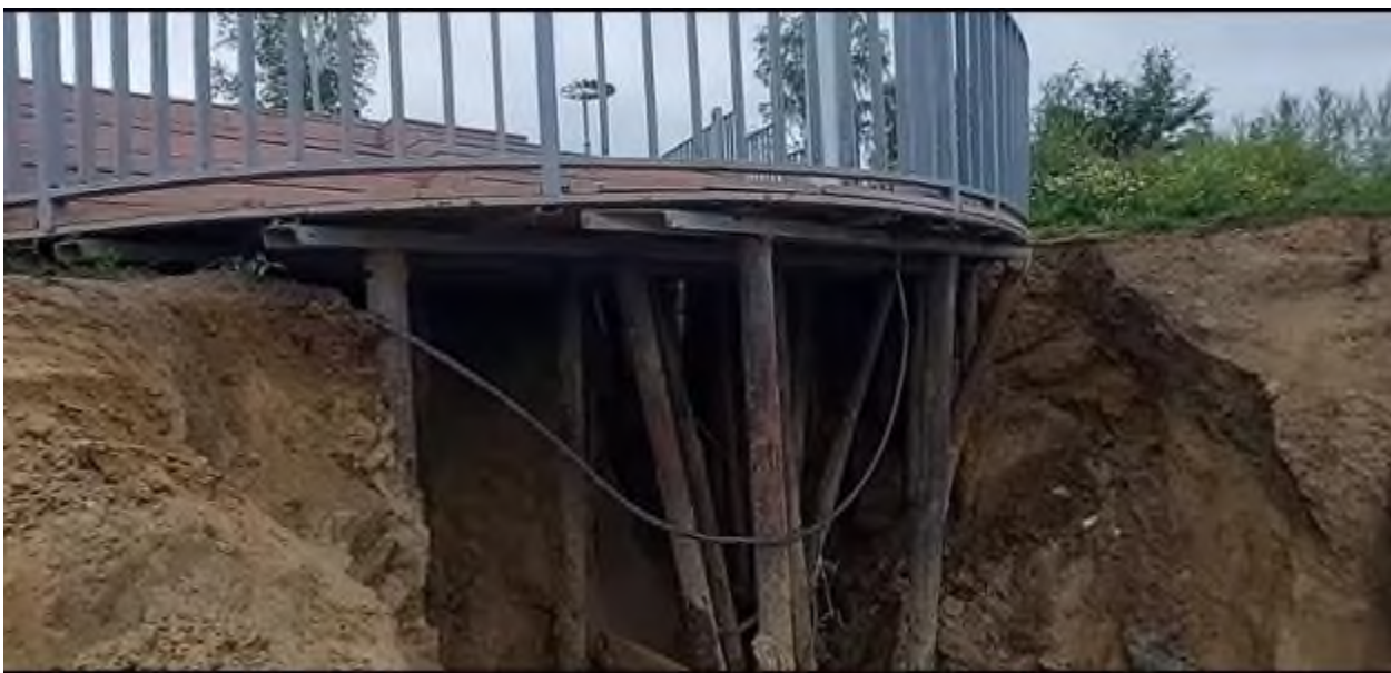
Фото 4. Обрушение грунта под смотровой площадкой на территории парка отдыха «Мега-парк», берег реки Мега. Источник: www.muksun.fm от 07.08.2024
