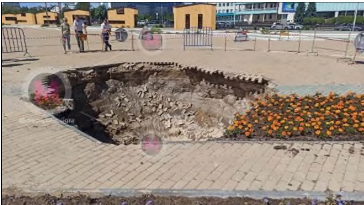
Фото 1. Суффозионный провал в г. Сургут, на площади Советов 10.07.2024 г. Фото с сайта СМИ «Сургутская трибуна» и «Мегаполис Югра»
