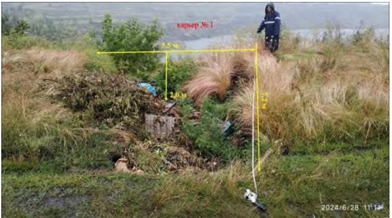
Фото 74-22-00203. Овраг на борту карьера в п. Проходная в ТН 13а. Еманжелинский участок Челябинская область
