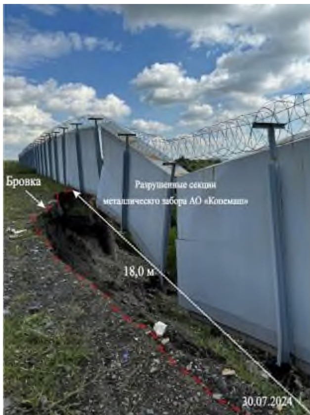
Фото 74-11-237. Участок разрушения оползневым процессом ограждения АО «Копемаш». Копейский участок оперативного обследования, Челябинская область
