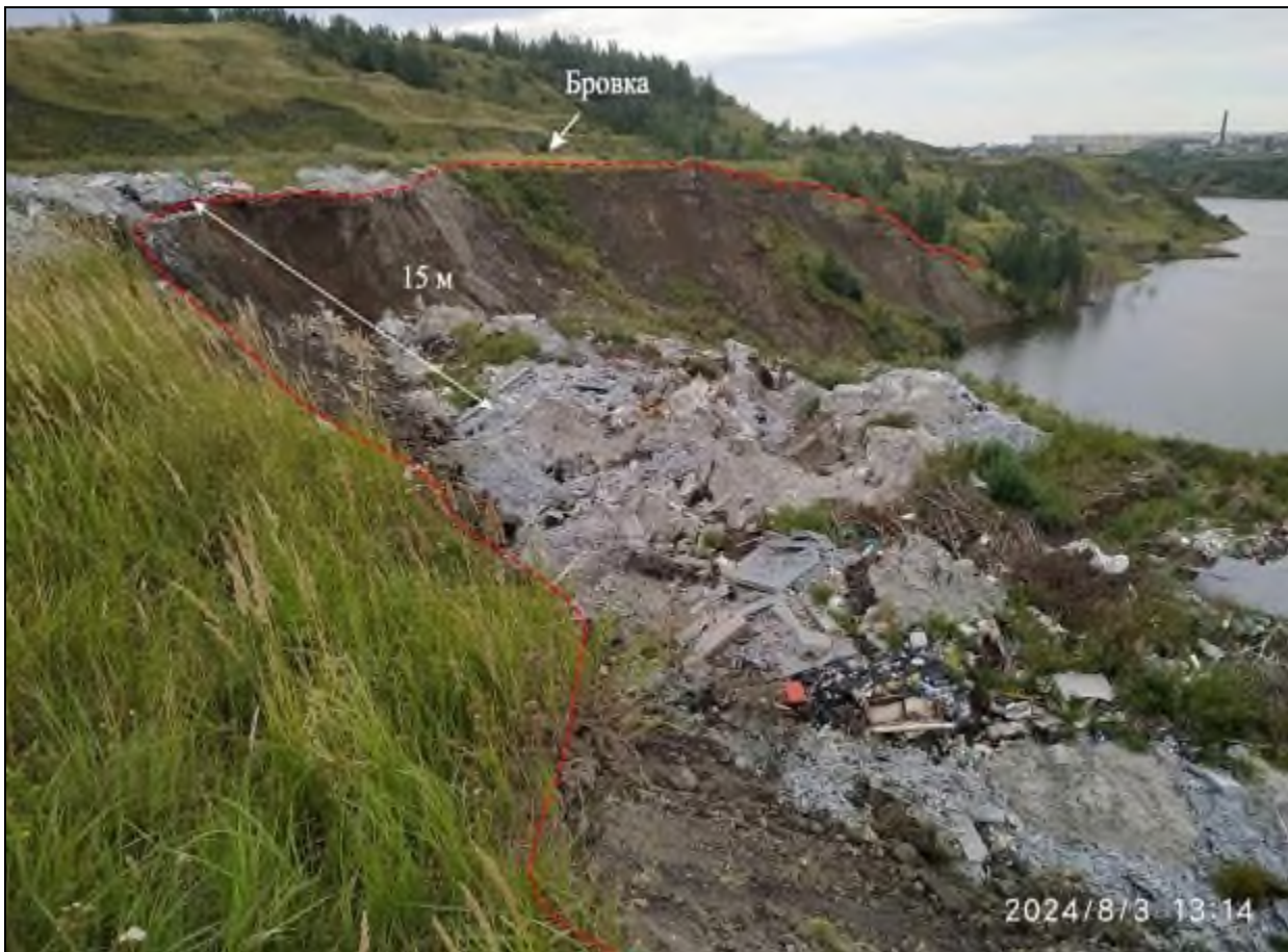
Фото 74-11-00068. Обрушение борта карьера в районе свалки отходов строительного мусора. Копейский участок оперативного обследования, Челябинская область
