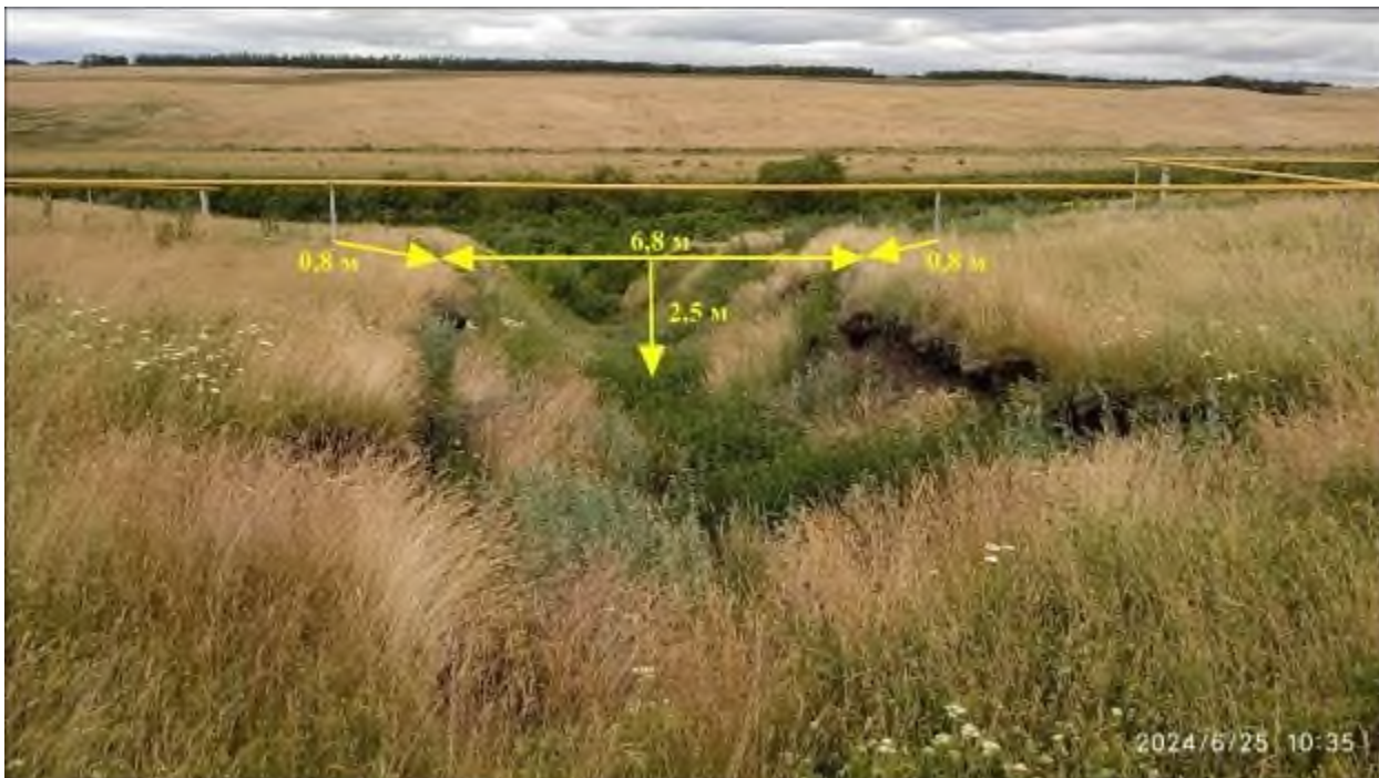
Фото 74-22-00253. Вид на овраг на участке пересечения с газопроводом в ТН 16. Участок Троицкий Челябинской области
