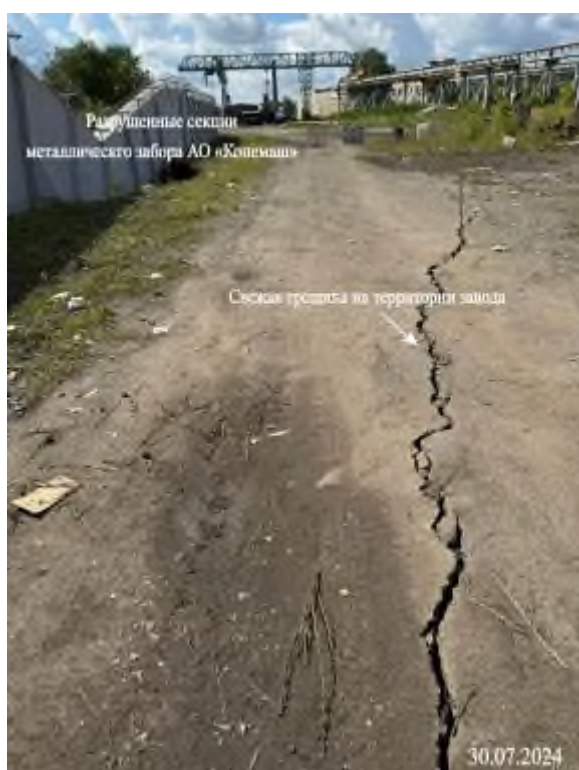
Фото 74-11-237. Трещины на технологической дороге АО «Копемаш». Копейский участок оперативного обследования, Челябинская область
