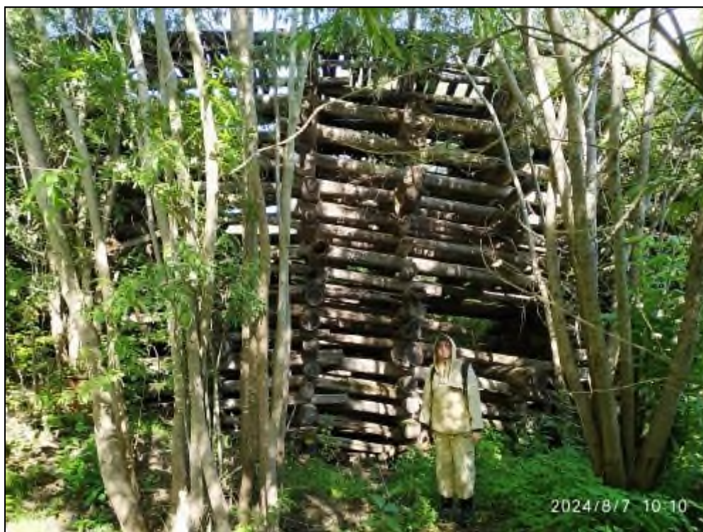
Фото 86-2024-01-001-9. Старый не эксплуатируемый мост на ряжах в устьевой части оврага в ТН 9 (вверху – вид сбоку, внизу – вид с тальвега оврага). Березовский участок ХМАО-Югра
