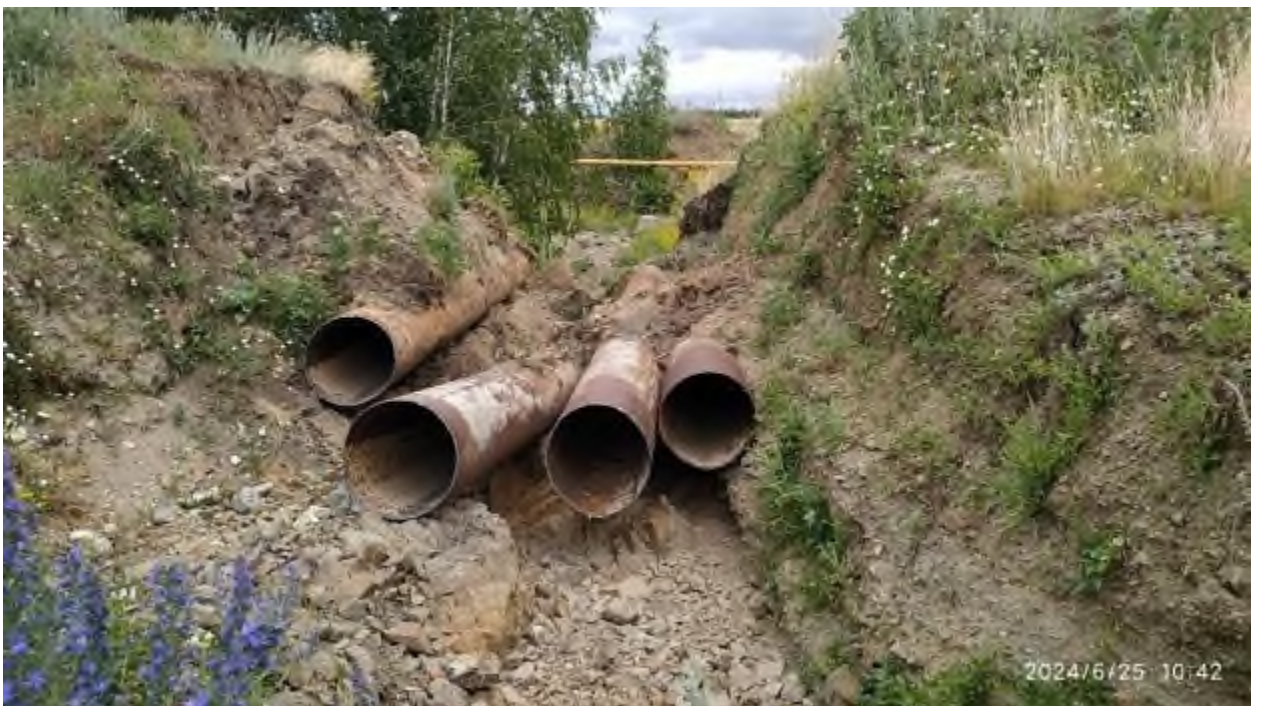
Фото 74-22-00254. Водопропускные трубы на участке разрушенной паводковым стоком дамбы в ТН 17. Участок Троицкий Челябинской области
