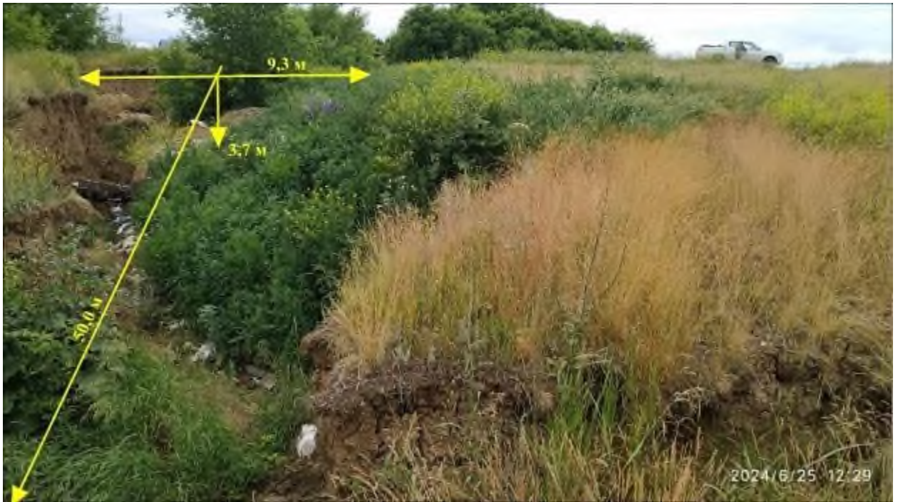
Фото 74-22-00262. Овраг в пос. Тогузак в районе дома № 2 по ул. Правобережная, в ТН 25. Участок Троицкий Челябинской области
