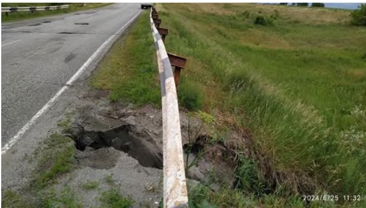
Фото 74-22-00259. Разрушение склона и обочины автодороги в ТН 22. Участок Троицкий Челябинской области
