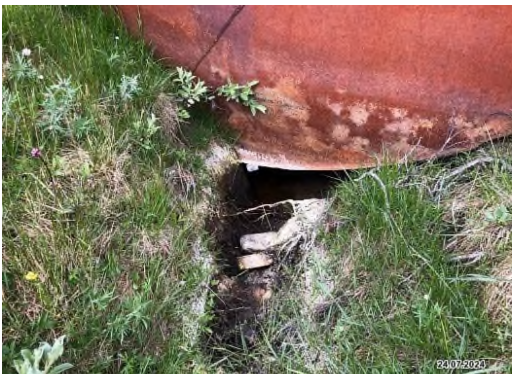
Фото 89-06-00227. Трещина протаивания на бугре пучения в ТН 2. Участок Сеяхинский, ЯНАО
