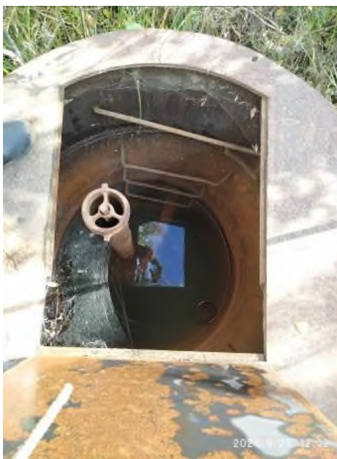
Фото 86-13-00035. Колодец пожарного гидранта в районе пересечения ул. Яковлева - Кондинская. Урайский участок ХМАО-Югра
