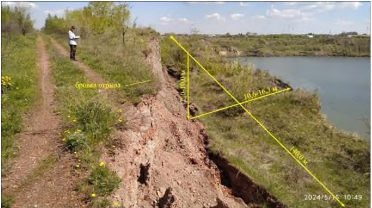
Фото 74-11-00067. Оползание борта Копейского разреза в ТН 12 с оползневой ступенью. Копейский участок Челябинская область
