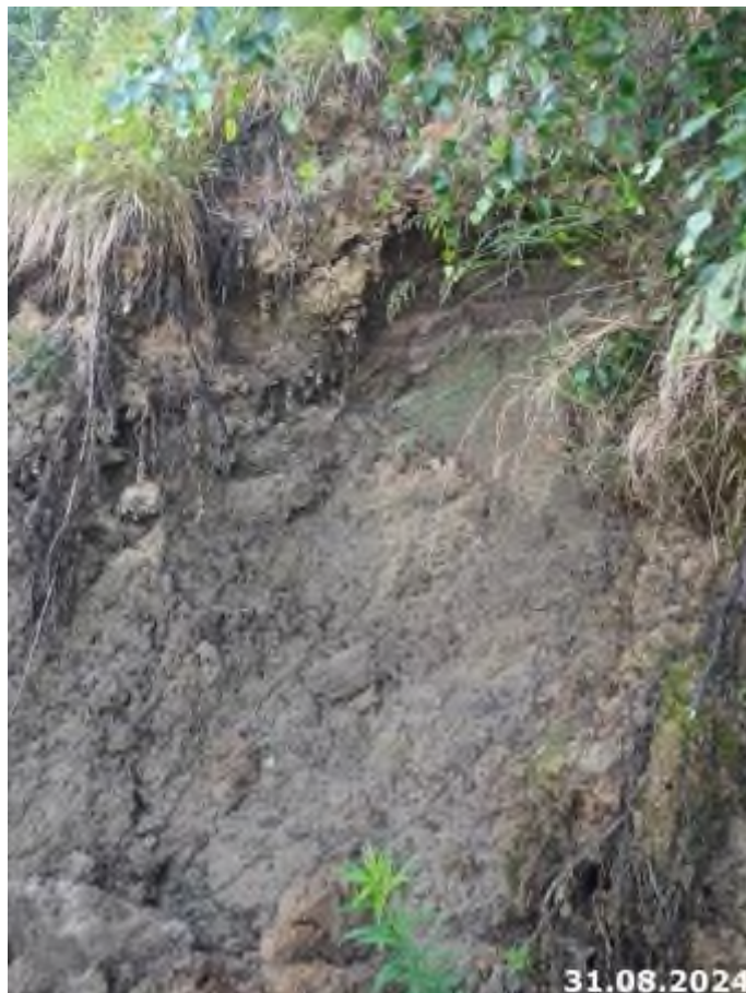
Фото 89-1210-0001-7. Бровка отрыва оползня в ТН 807. Участок Обский, ЯНАО
