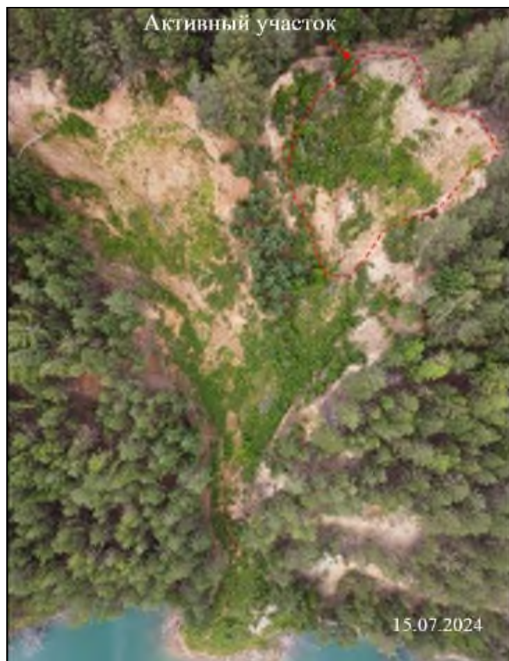
Фото 66-11-00309. Бровка отрыва (фото сверху) и оползневой склон (фото внизу). Липовский участок Свердловская область
