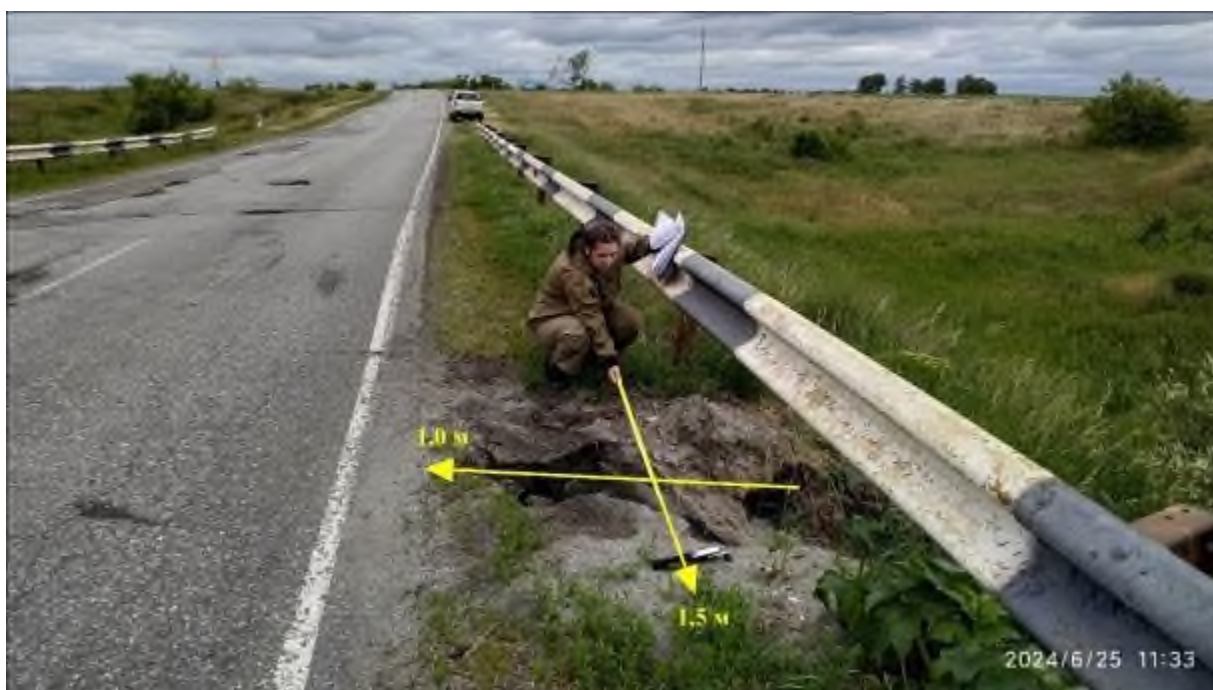
Фото 74-22-00259. Разрушение обочины автодороги в ТН 22. Участок Троицкий Челябинской области
