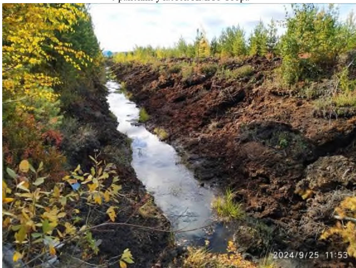
Фото 86-13-00035. Дренажная канава по периметру торфяного массива в ТН 13. Урайский участок ХМАО-Югра
