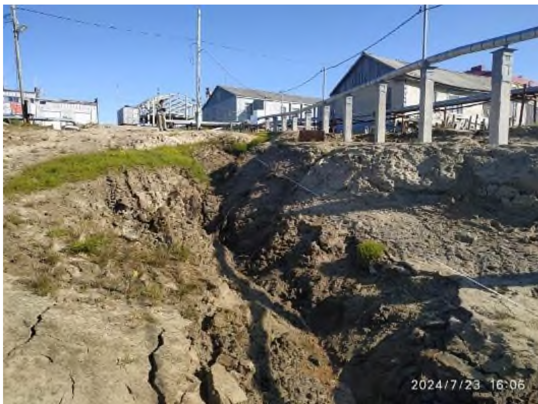
Фото 89-1210-0002-13а. Овражная термоэрозия на участке строительства водозабора в ТН 13а. Участок Сеяхинский, ЯНАО
