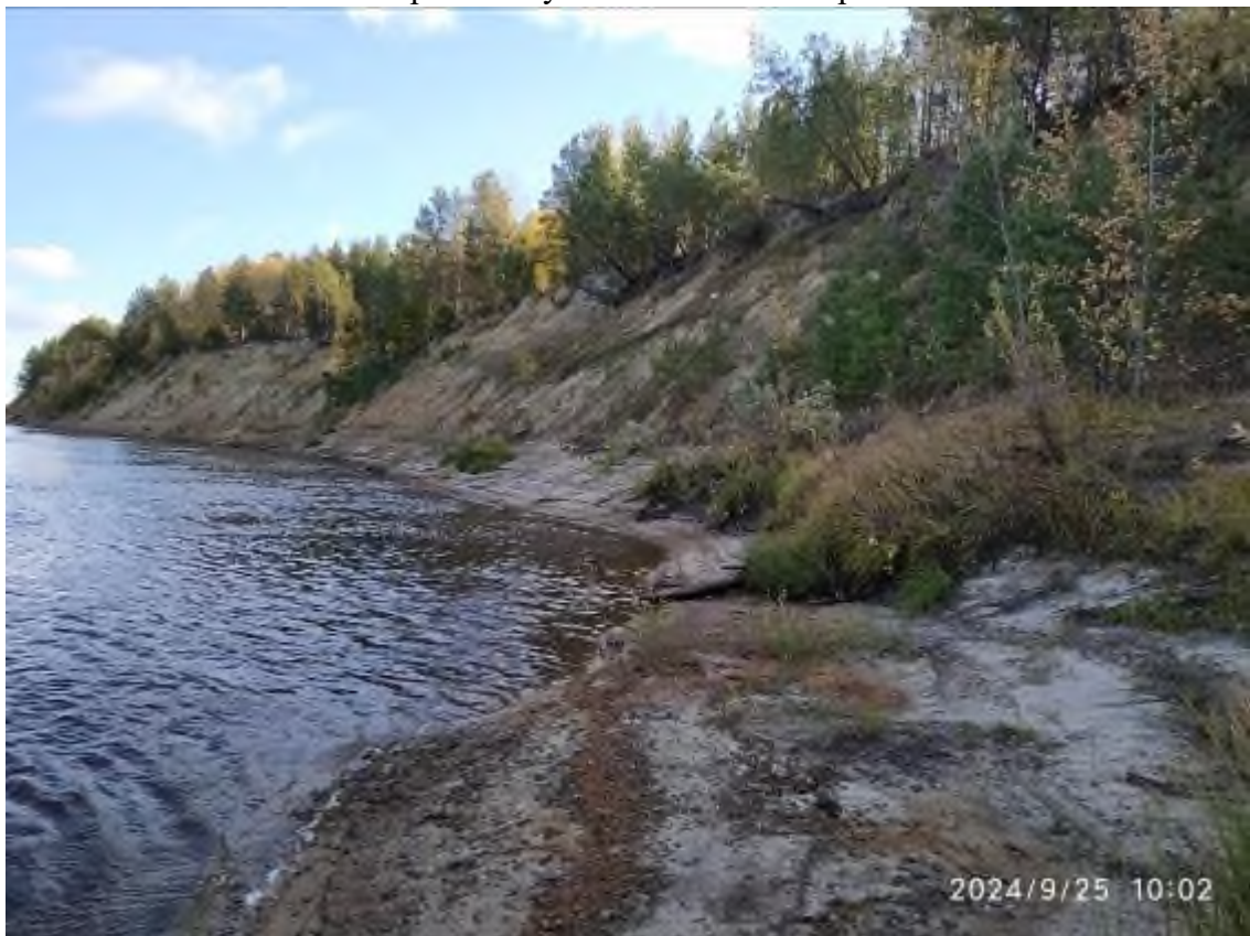
Фото 86-22-00126. Участок развития гравитационного комплекса процессов на правом высоком берегу р. Конда в ТН 6. Урайский участок ХМАО-Югра
