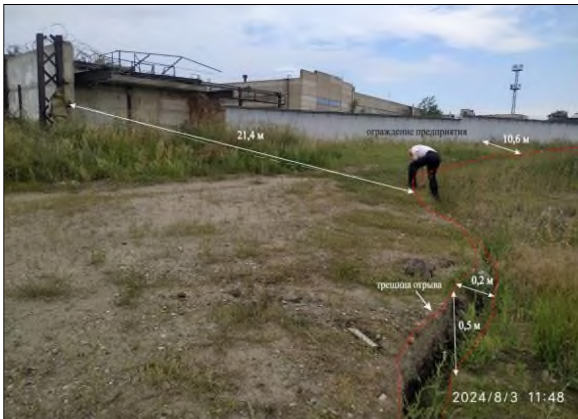
Фото 74-11-00069. Начало оползания отсыпанной площадки на участке АО «Копемаш» в ТН 15. Копейский участок Челябинская область
