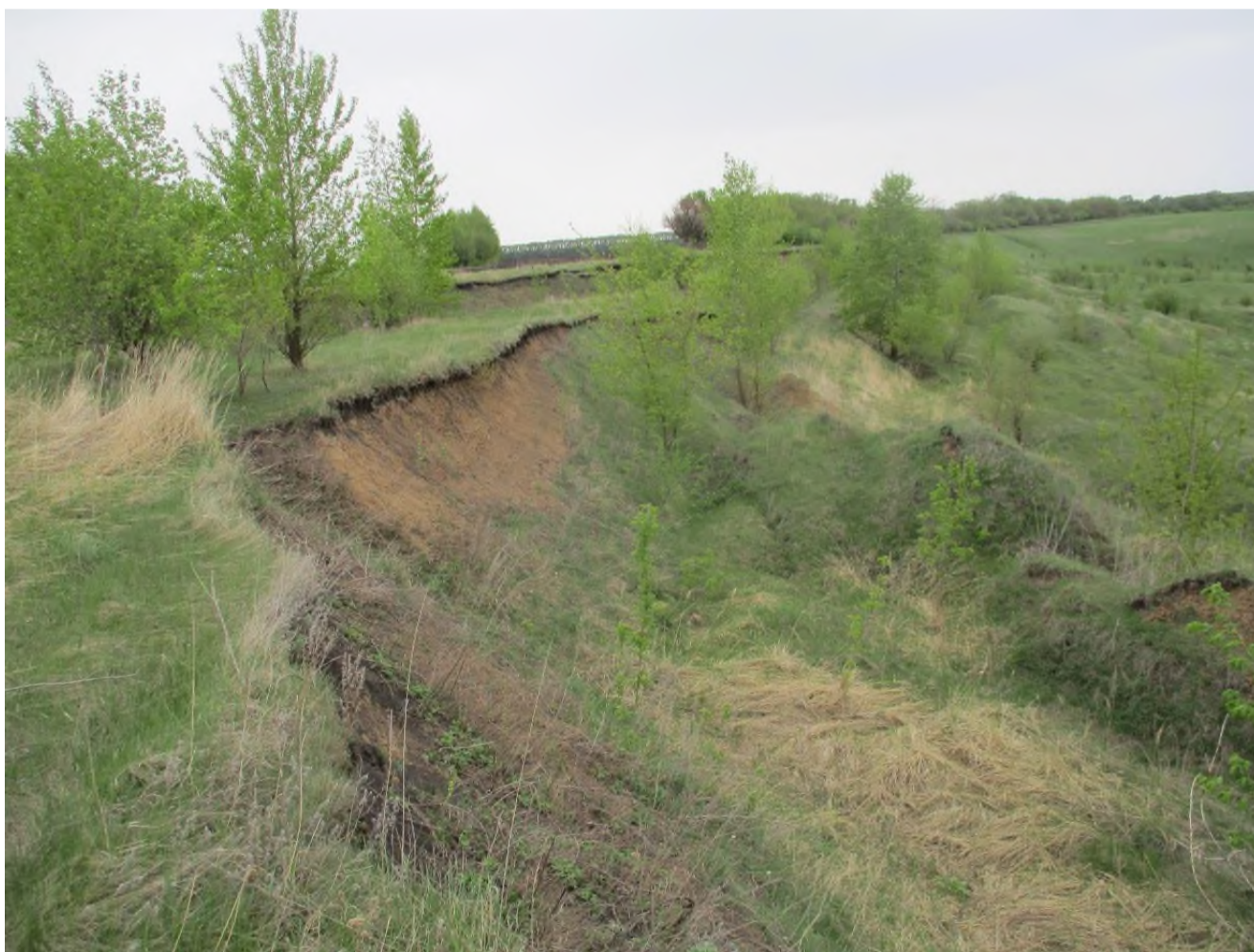
Фото 68-11-00046. Активный оползень в 1 км на запад от д. Красная Горка, Жердеевский район, Тамбовская область
