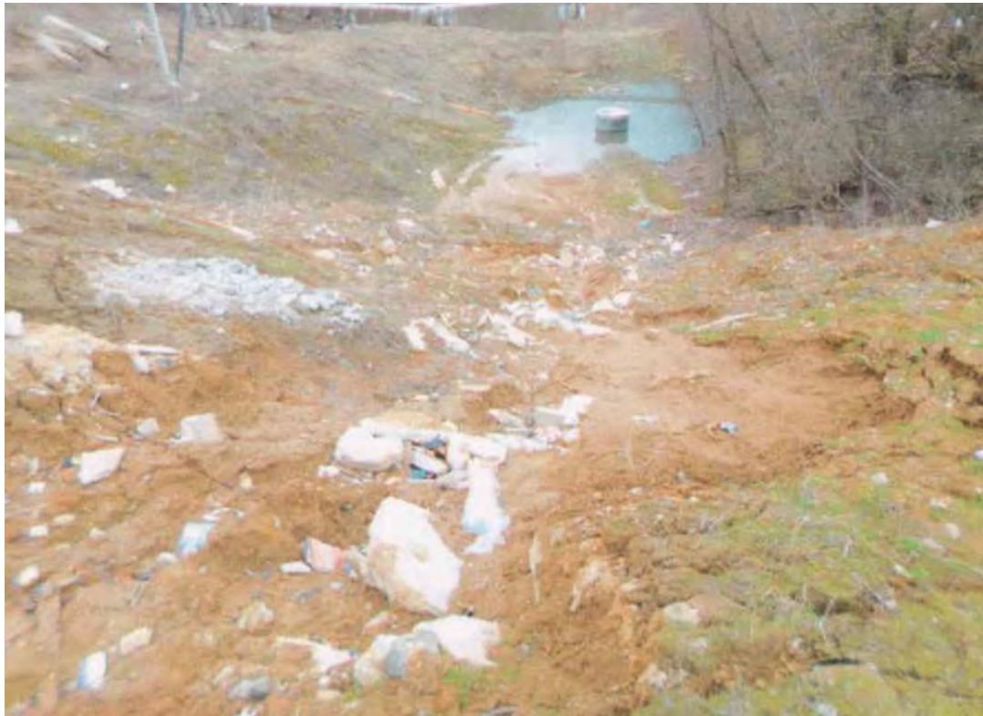
Фото 67-11-00146. Оползень по ул. Шевченко, г. Смоленск, Смоленская область
