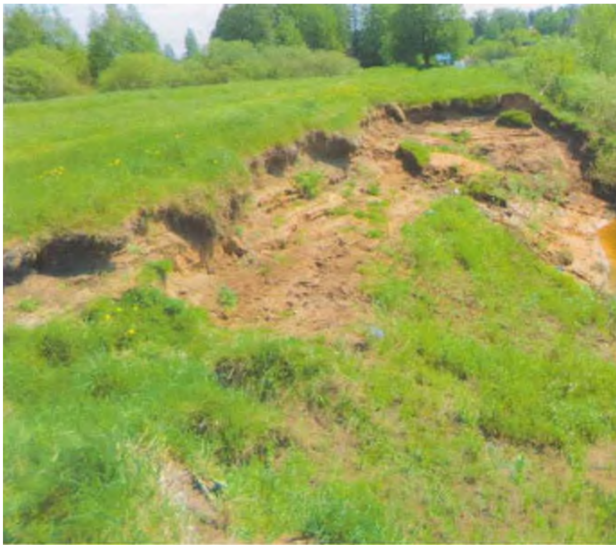
Фото 67-11-00150. Активный оползень по г. Дорогобуж, Дорогобужский район, Смоленская область
