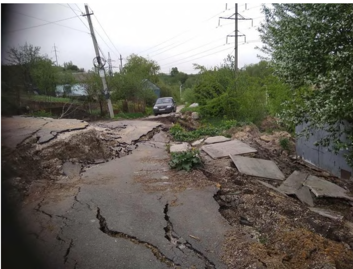
Фото 48-11-00117. Смещение оползневого блока пород в с. Сырское, ул. Речная д. 24, Липецкий район, Липецкая область
