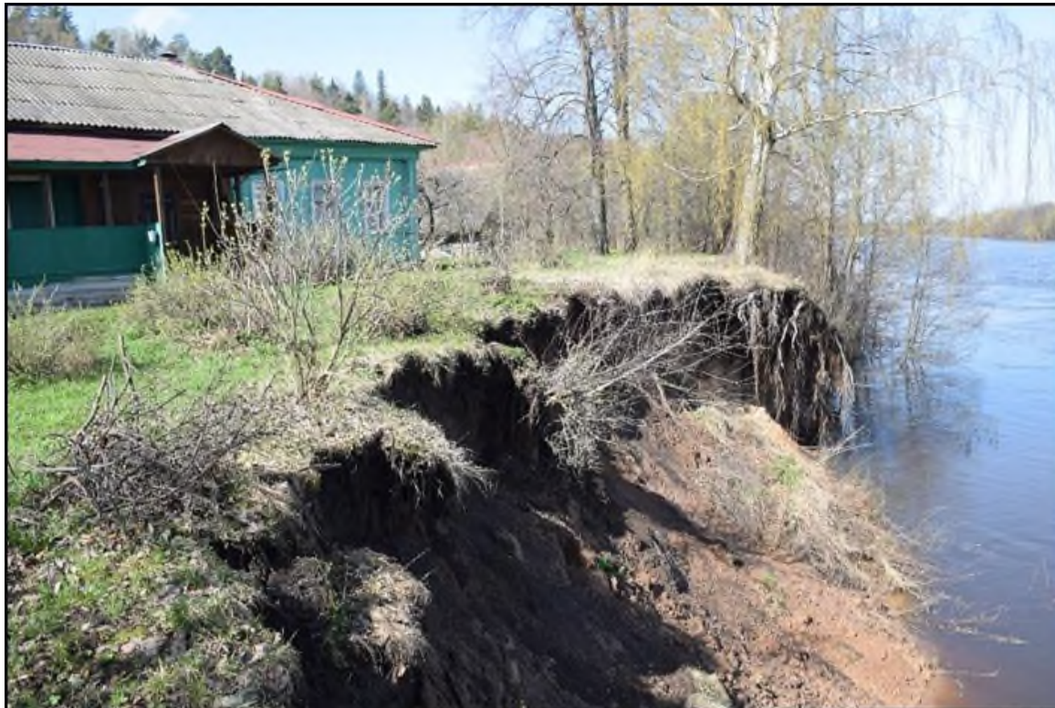
Фото 33.11.00135 Оползень в Вязниковском районе, северная окраина д. Олтушево, между д.№73 и №56, правый берег р. Клязьма, Владимирская область
