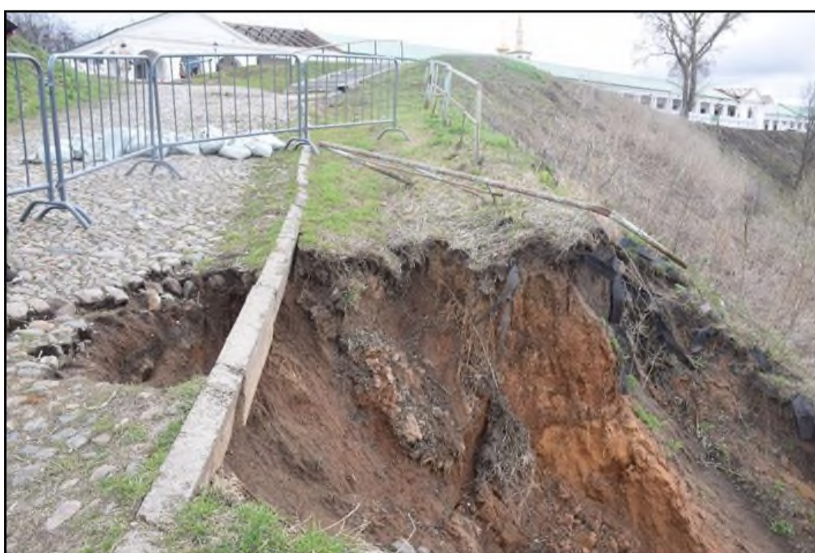
Фото 33.11.00140 Оползень в г. Суздаль, между улицами Ленина д.№63А и Набережная д.№1, левобережный склон р. Каменка, Владимирская область
