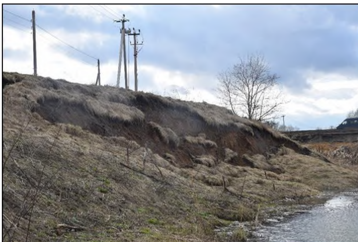
Фото 33.11.00150 Оползень в Суздальском районе, центральная часть с. Павловское, правый берег р. Чердыевка, Владимирская область
