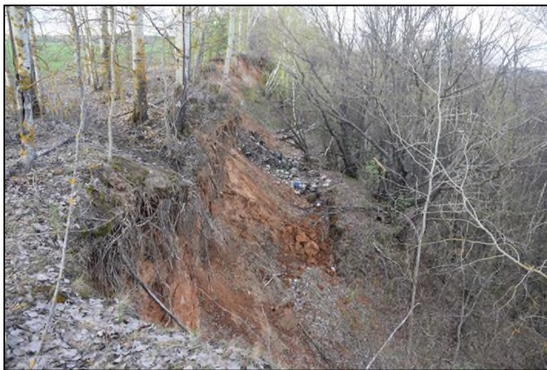
Фото 33.11.00148 Оползень в Меленковском районе, восточная окраина д. Окшово, ССВ смотровой площадки «Гандарейка», левобережный склон долины р. Ока, Владимирская область
