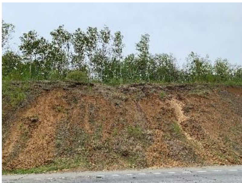
27-23-0001 Оползание откоса на 215 км А 370 в Бикинской районе 06.05.2024г.
