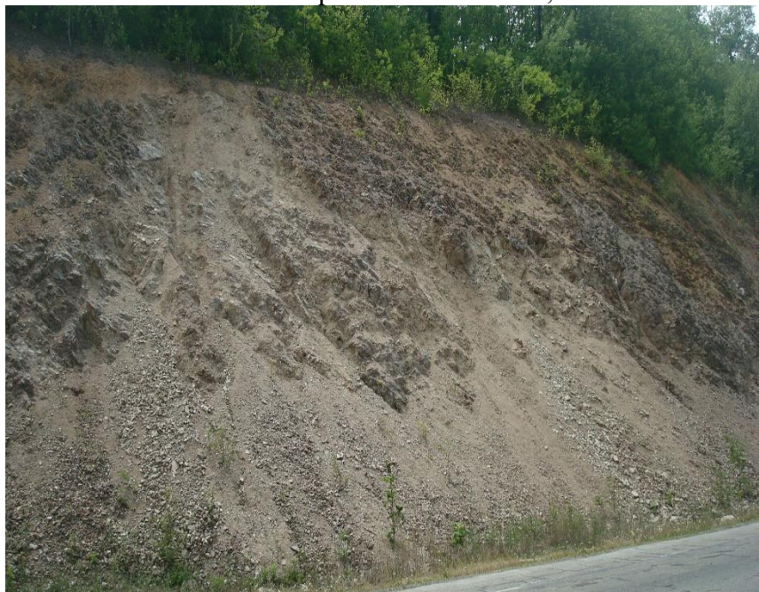
79-12-005 Осыпные проявления, 1872 км, 05.06.2024 г.
