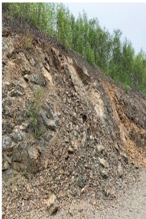
27-27-007 Проявления осыпного процесса на 220 км А 370 в Бикинской районе 06.05.2024г.
