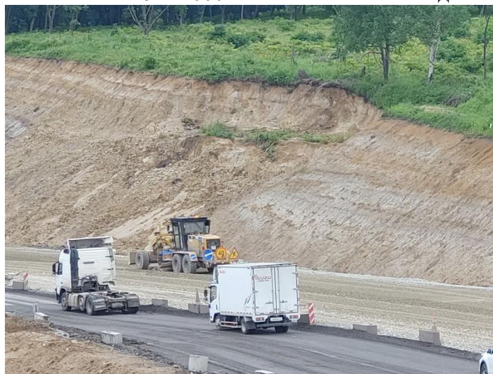
Б. Фото 25-11-0001 Оползни частный вид.
