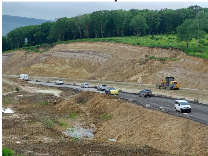
Фото 25-11-001. Активизация оползневой процесса на участке 689,75 км автодороги А-370 «Усури», в 0,2 км от начала обьездной дороги п. Раздольное автодороги по состоянию на 07.06.2024 г (общий вид.)
