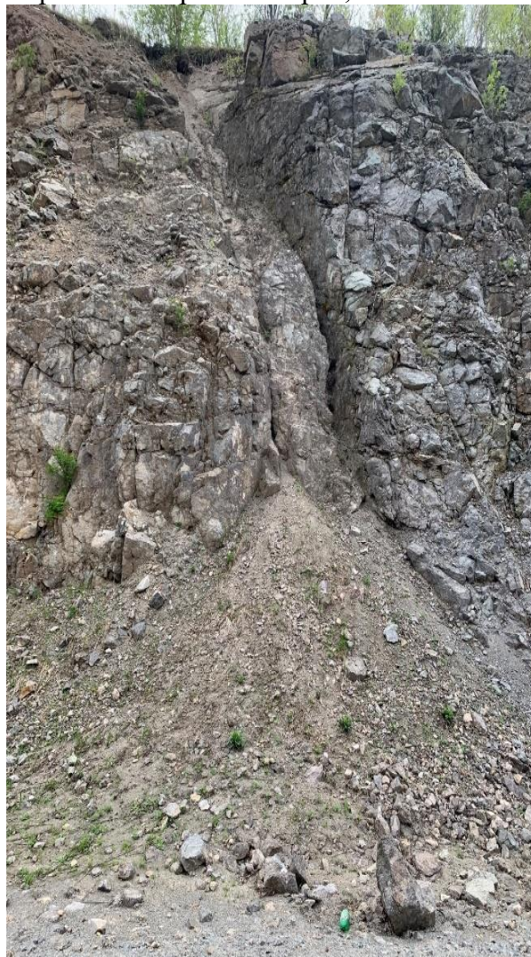
27-27-0003, Обвальнно-осыпной конус на участке 146 км А 370, Вяземский район Хабаровский край, 06.05.2024г.
