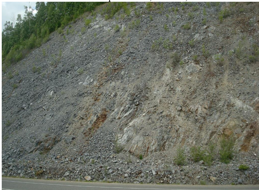
79-12-007 Осыпные проявления, 1836 (1896) км, 05.06.2024 г.
