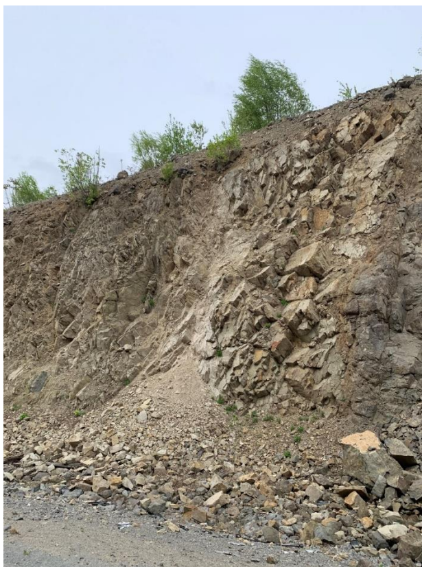
27-27-0005 Обвално-осыпной конус на участке 146 км А 370, Вяземский район Хабаровский край, 06.05.2024г.
