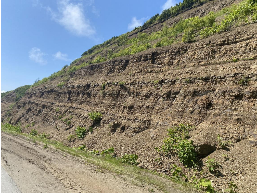
65-12-00001 Обвальнo-осыпной склон с обломочным материалом.
