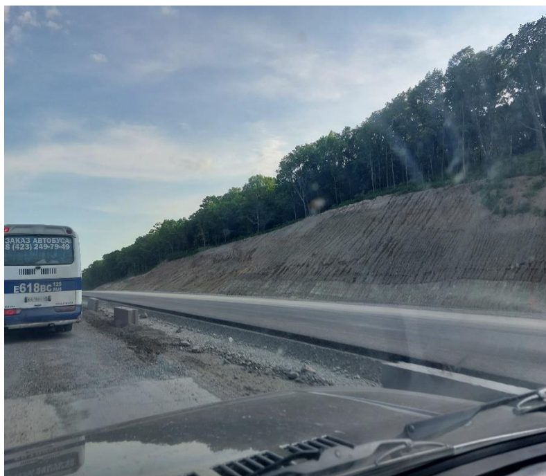
Б. Фото 25-11-002. Активизация оползневой процесса в парагенезе с началом активизации эрозийного процесса на участке 6,5 км объездной автодороге А-370 «Уссури» (в районе п. Раздольное) по состоянию на 27.06.2024 г.
