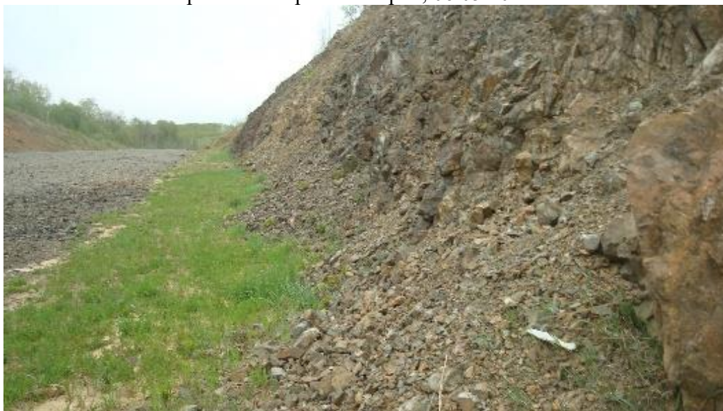
27-27-0006 Обвално-осыпной шлейф на участке 215 км А 370, Бикинский район Хабаровский край, 06.05.2024г.
