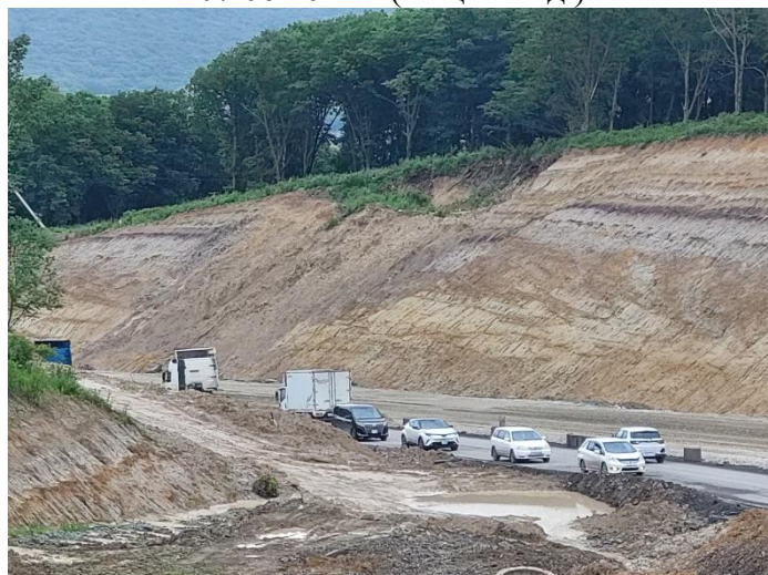
А. Фото 25-11-0001 Оползни частный вид.
